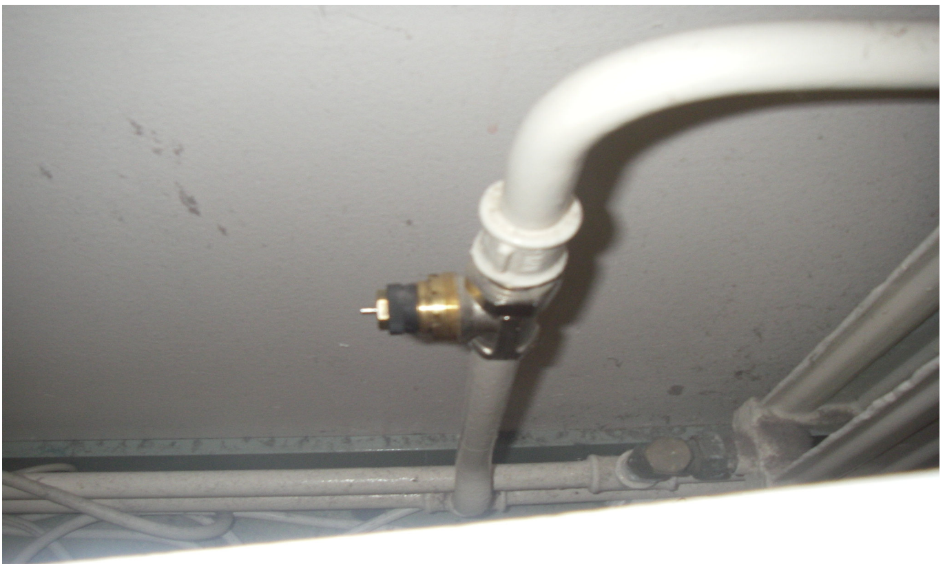
KUVA 42. Yleiskuva päärakennuksen rikkiäisestä patteriventtiilistä.
