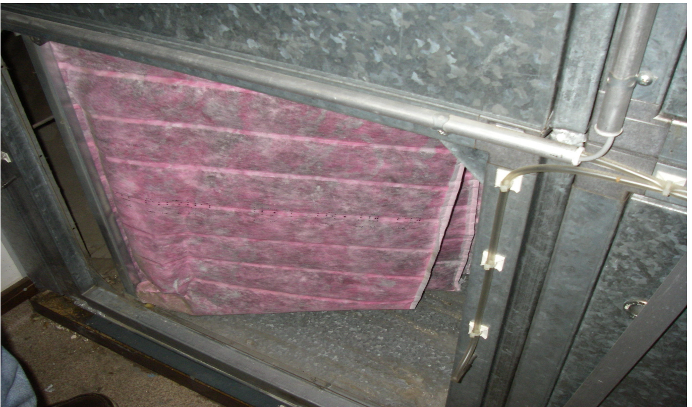
KUVA 17. Yleiskuva lisärakennuksen tuloilmakoneen suodattimista.
