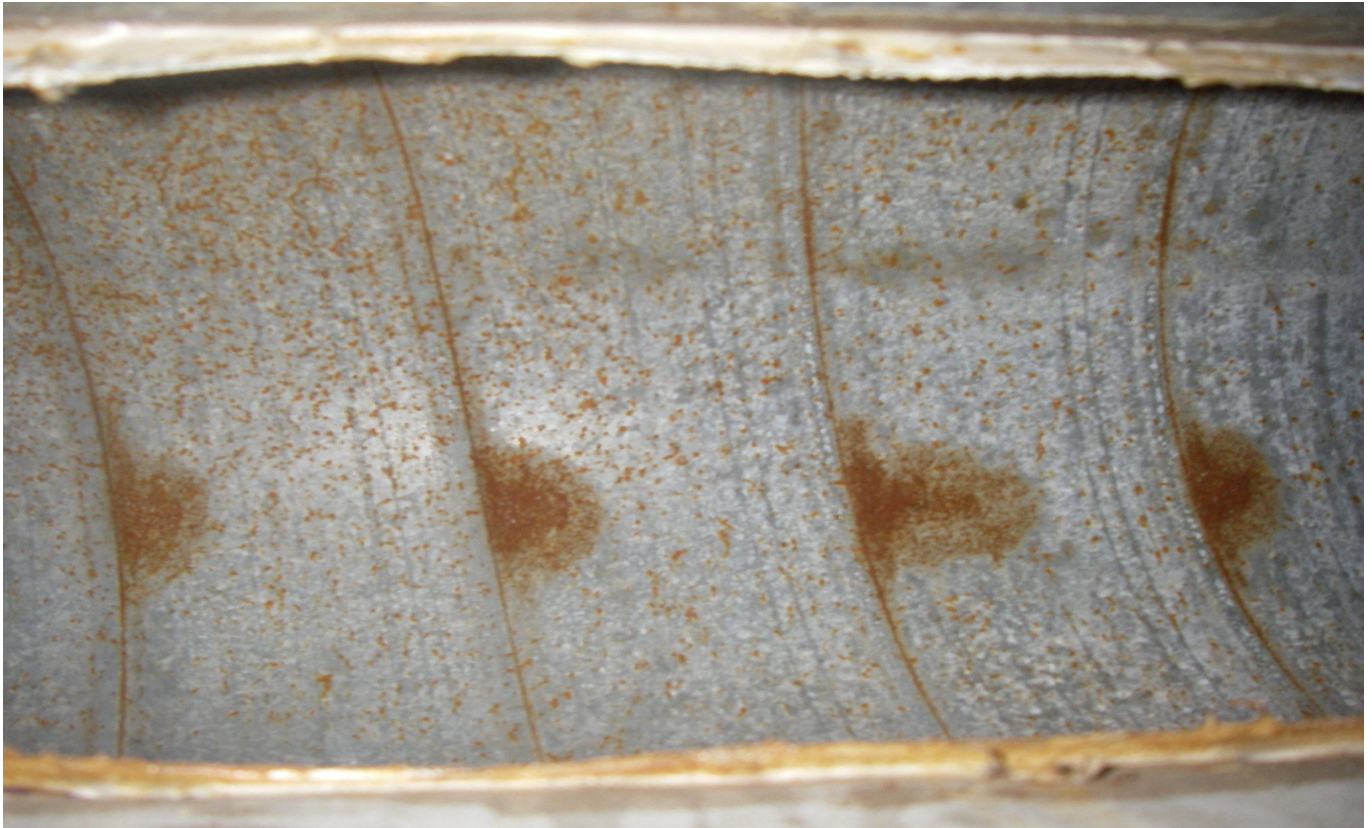
KUVA 31. Yleiskuva ryhmähuoneen n:o 38 tuloilmakanavasta.
