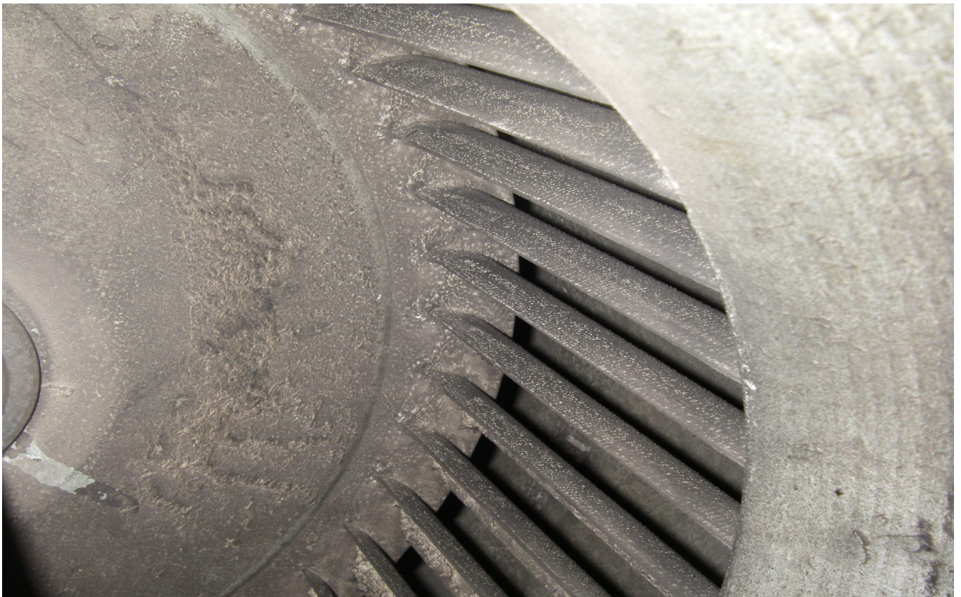
KUVA 9. Yleiskuva päärakennuksen tuloilmapuhaltimesta.
