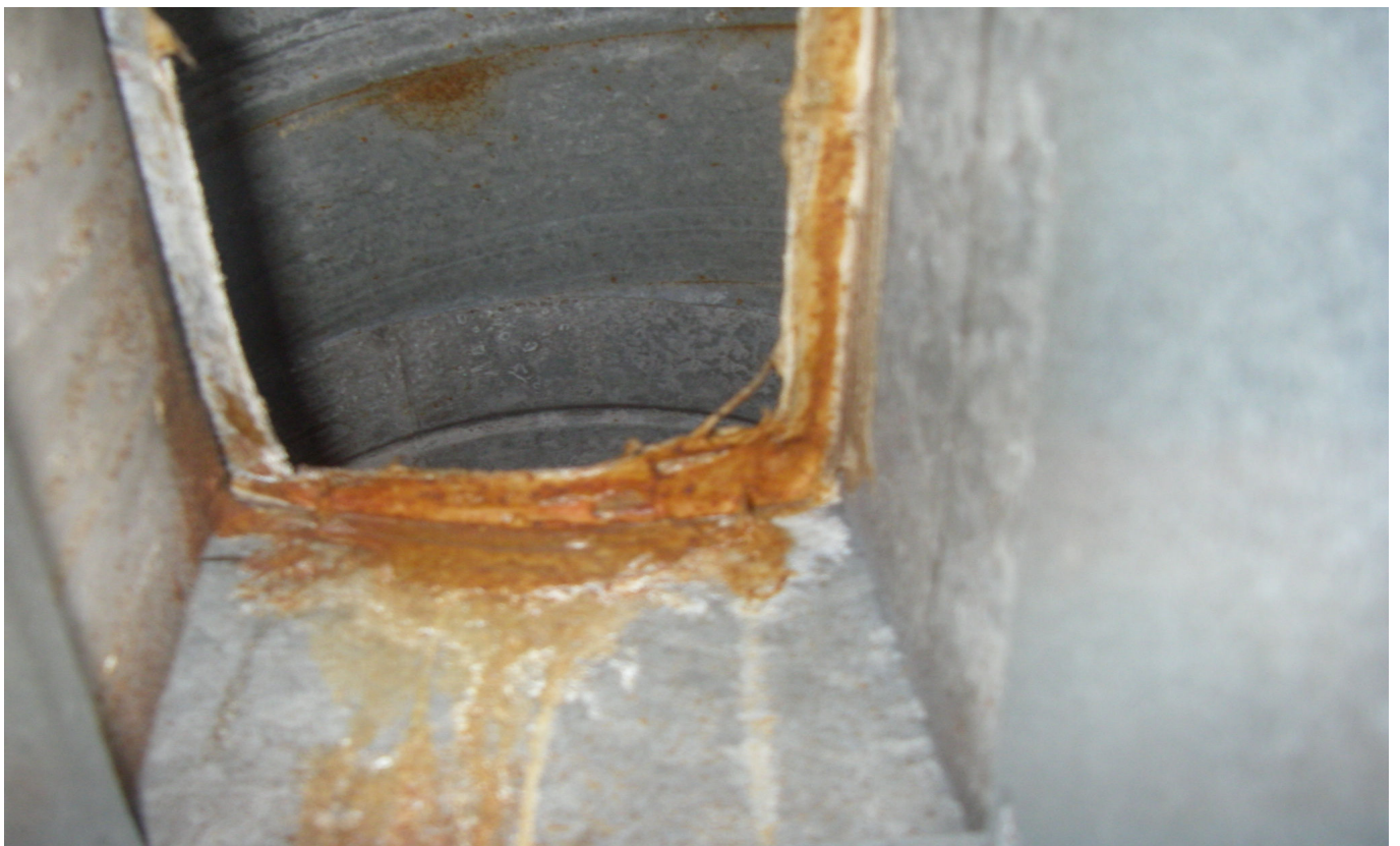
KUVA 30. Yleiskuva ryhmähuoneen n:o 38 tuloilmakanavasta.
