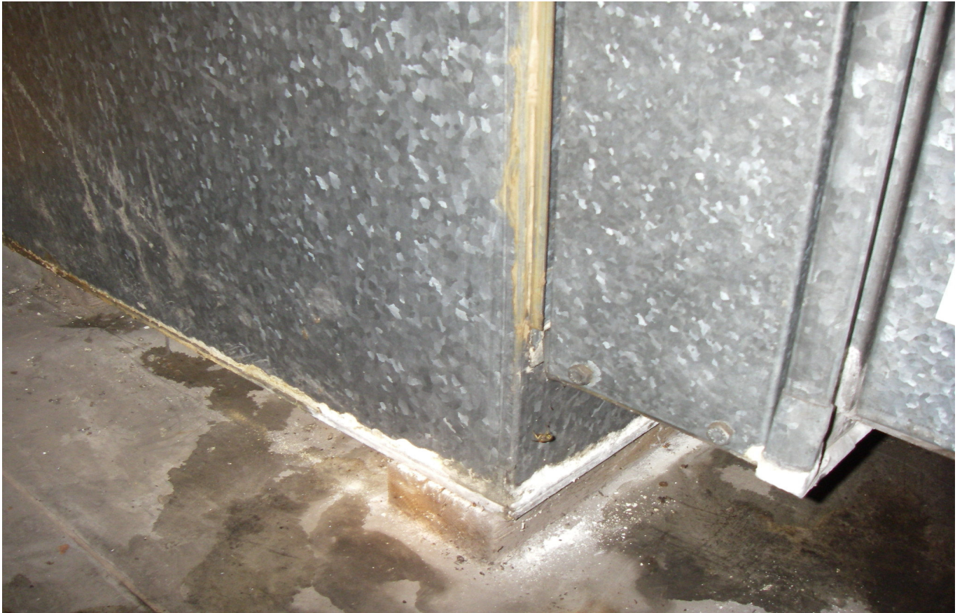
KUVA 5. Yleiskuva päärakennuksen tuloilmakoneen raitisilmakammista.
