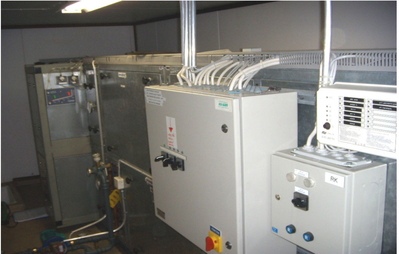
KUVA 3. Yleiskuva lisärakennuksen ilmastointikoneesta.
