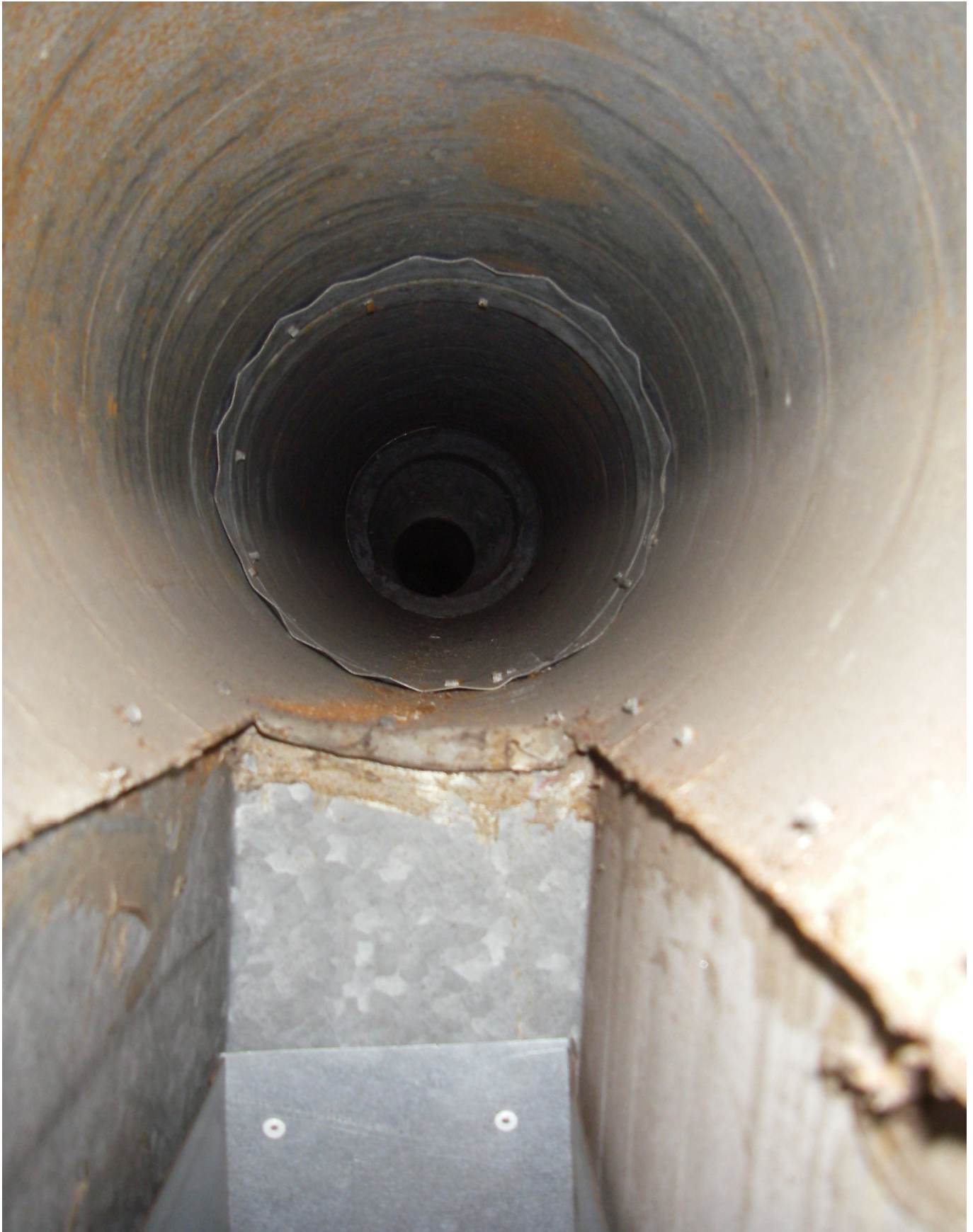
KUVA 26. Yleiskuva päärakennuksen tuloilmakanasta.
