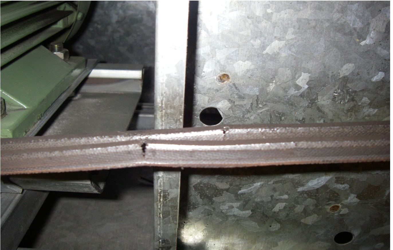
KUVA 20. Yleiskuva lisärakennuksen tuloilmakoneen hihnoista.
