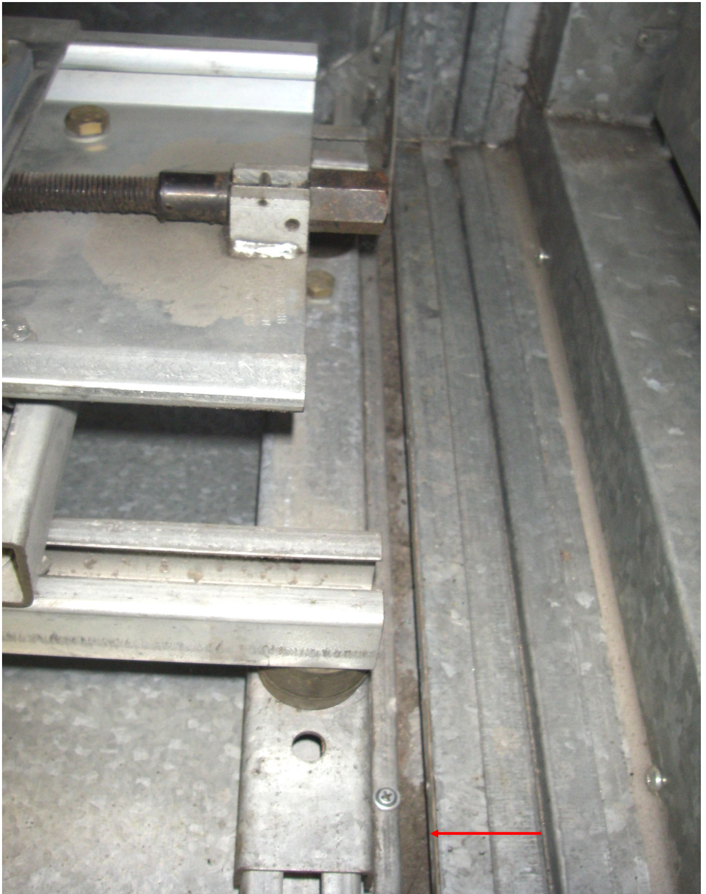
KUVA 18. Yleiskuva lisärakennuksen tuloilmakoneen kammiosta, jossa on roskaa.
