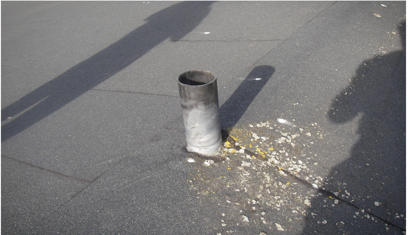
KUVA 39. Yleiskuva ullakkotilojen tuuletusputkesta, josta puuttuu sadehattu.
