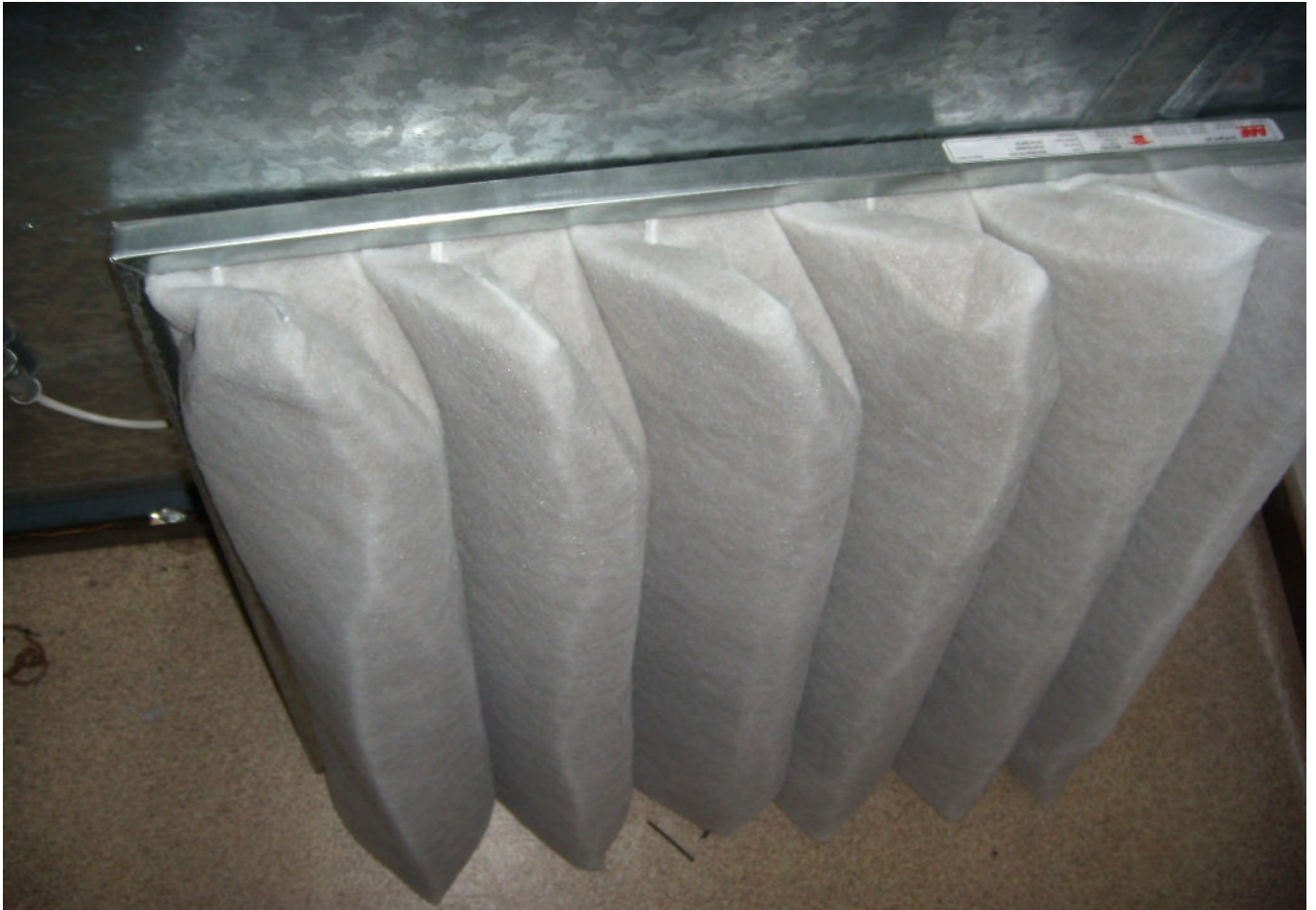
KUVA 22. Yleiskuva lisärakennuksen poistoilmasuodattimesta.
