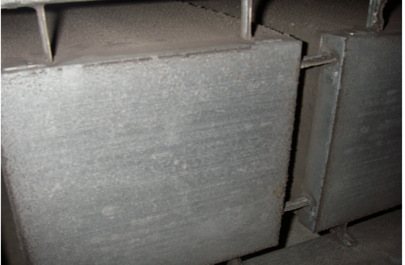
KUVA 24. Yleiskuva lisärakennuksen poistoilmakanavan äänenvaimentimesta.
