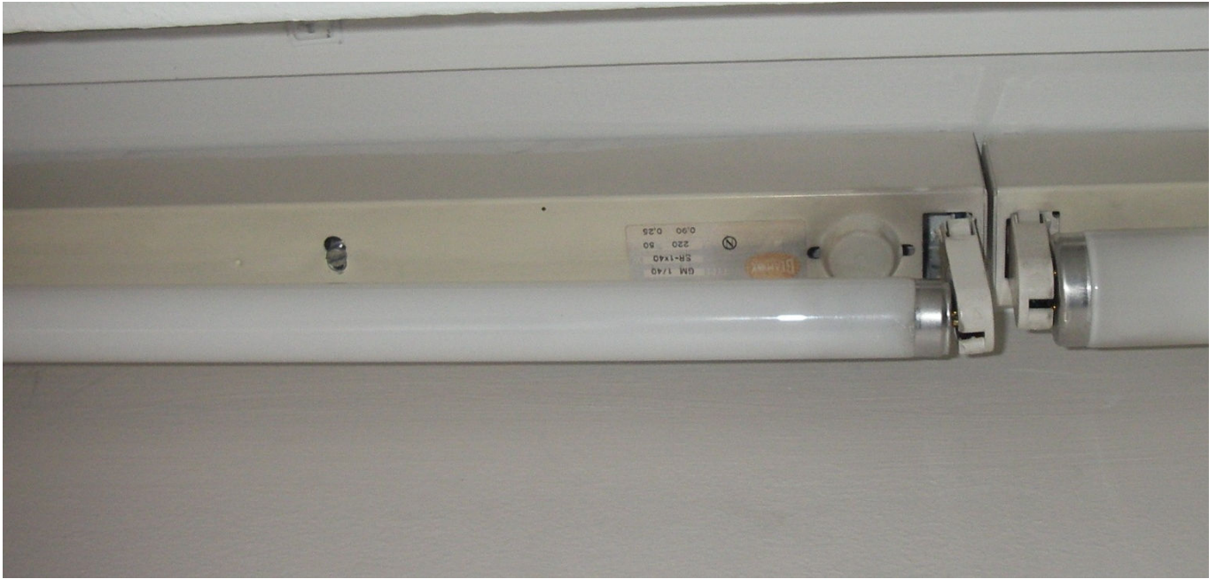
KUVA 43. Yleiskuva päärakennuksen ryhmähuoneen n:o 03 loisteputken kiinnityksestä.
