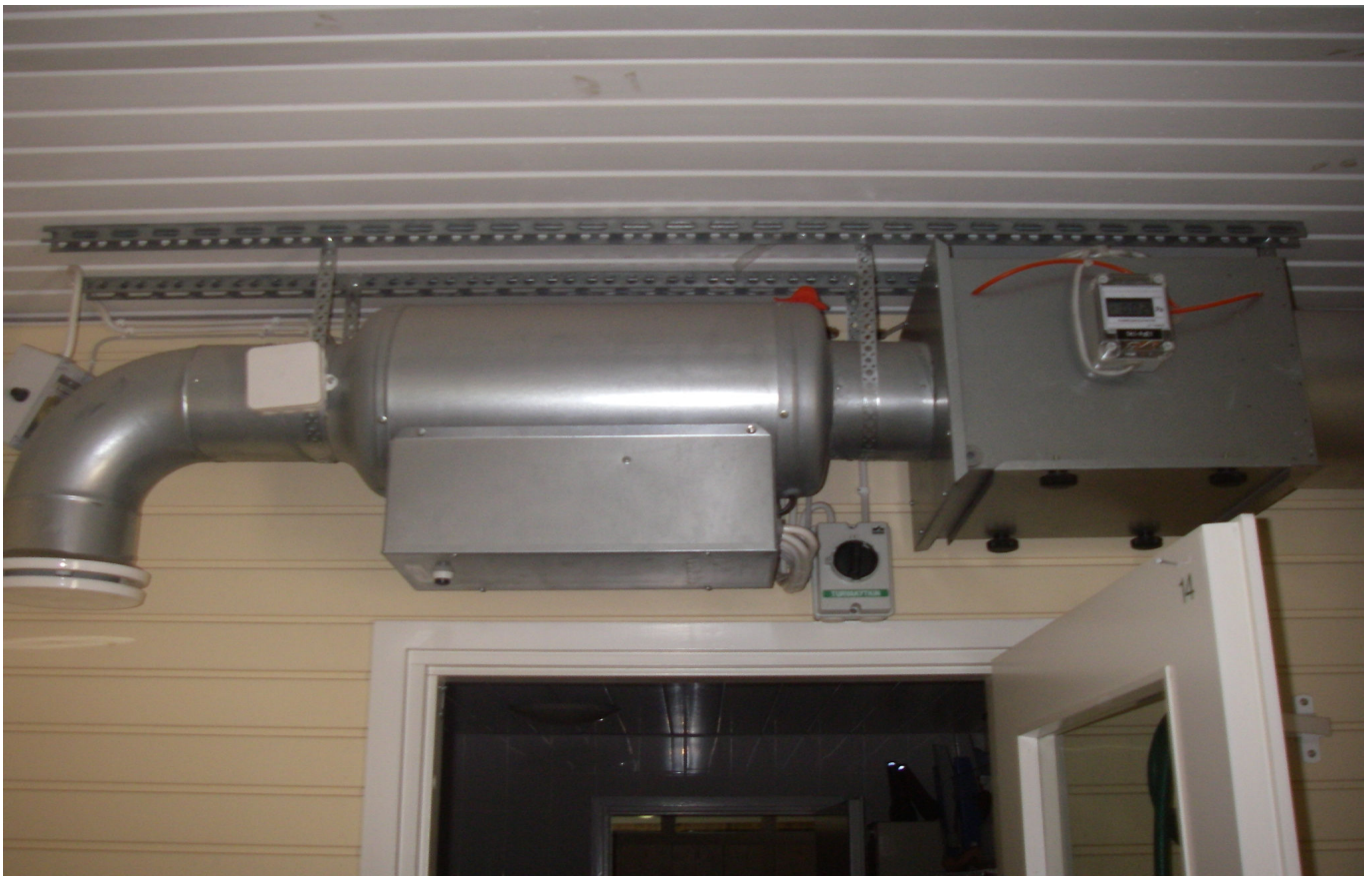
KUVA 44. Yleiskuva päärakennuksen huoneen n:o 14 tuloilmapuhaltimesta.
