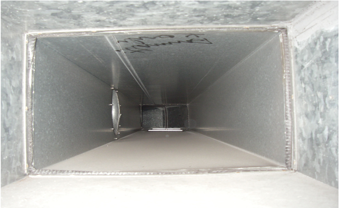
KUVA 33. Yleiskuva lisärakennuksen tuloilmakanavasta.
