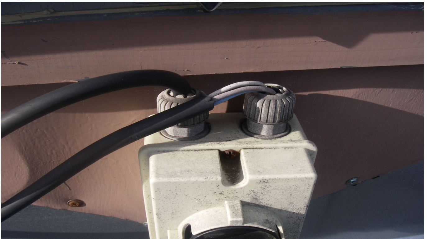
KUVA 15. Yleiskuva päärakennuksen huippuimurin sähköjohtojen kytkennästä.
