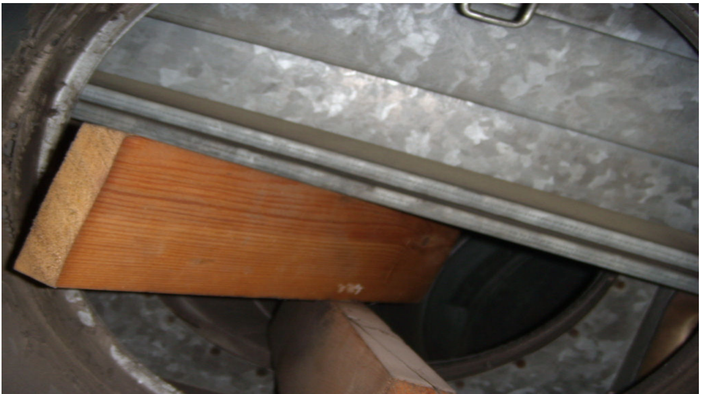
KUVA 13. Yleiskuva päärakennuksen ilmastointikanavan palopelistä.
