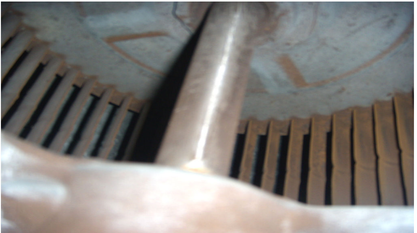
KUVA 23. Yleiskuva lisärakennuksen poistoilmapuhaltimesta.
