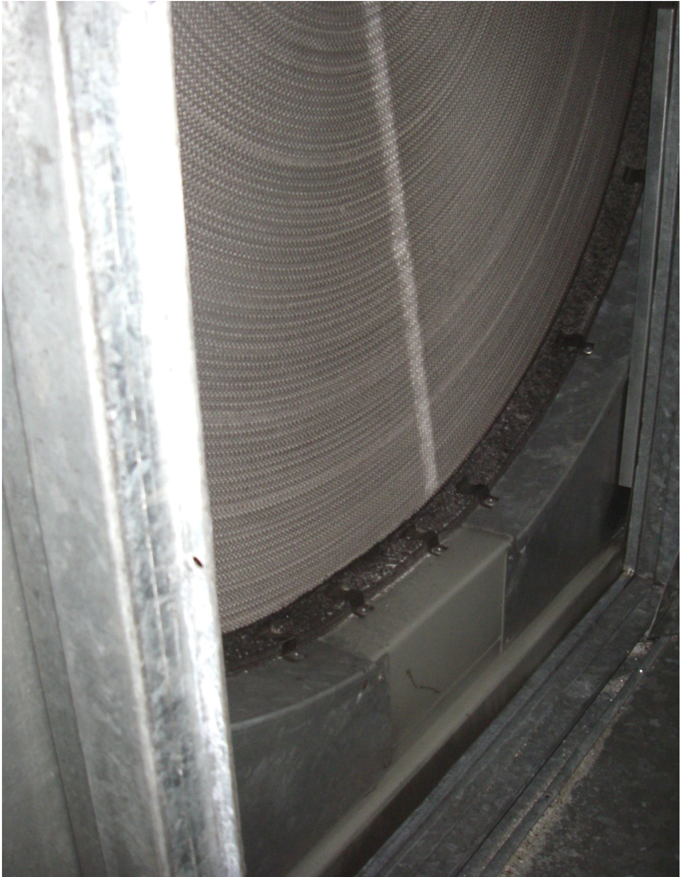
KUVA 19. Yleiskuva lisärakennuksen LTO- kiekosta.
