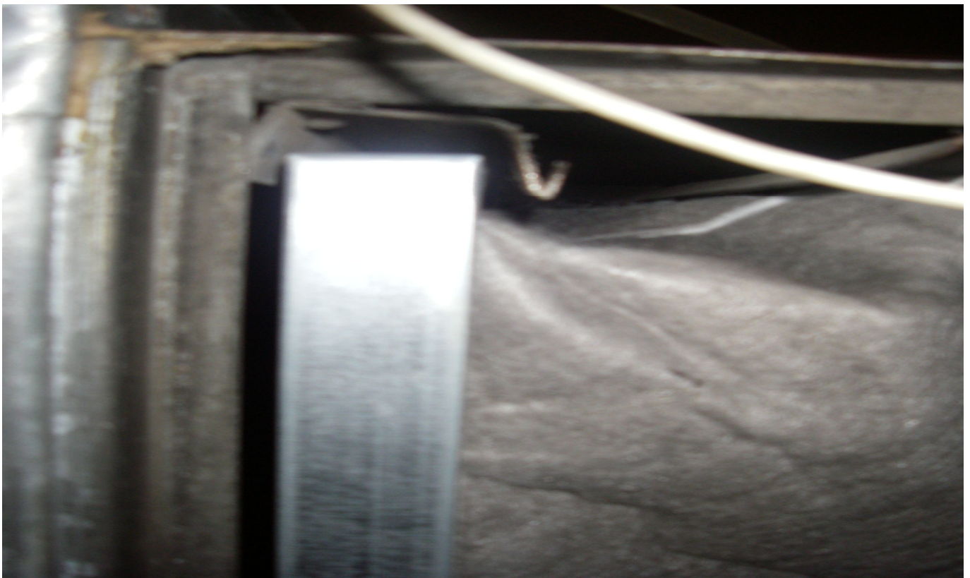
KUVA 6. Yleiskuva päärakennuksen tuloilmakoneen esisuodattimen kehikosta.
