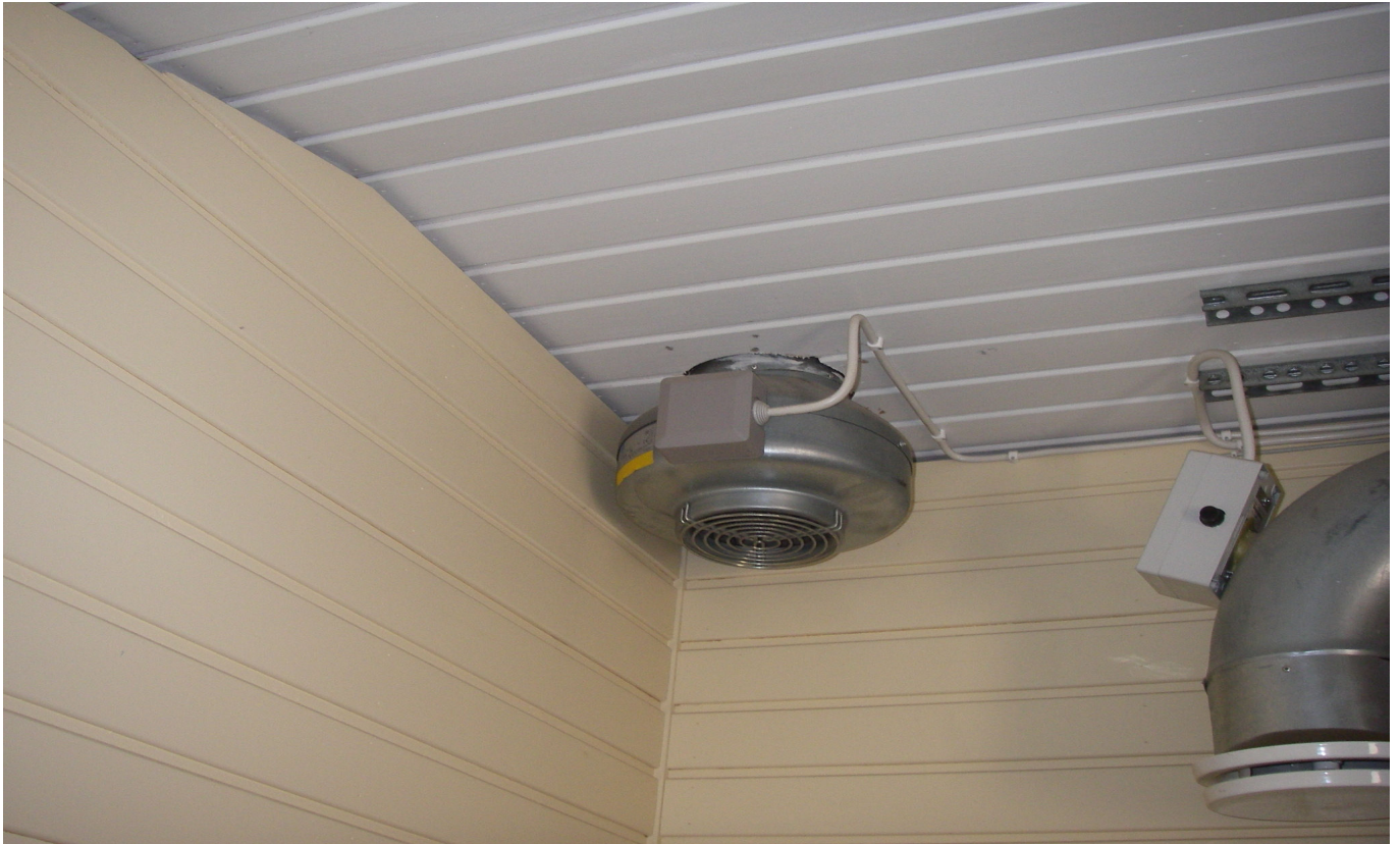
KUVA 45. Yleiskuva päärakennuksen huoneen n:o 14 poistoilmapuhaltimesta.
