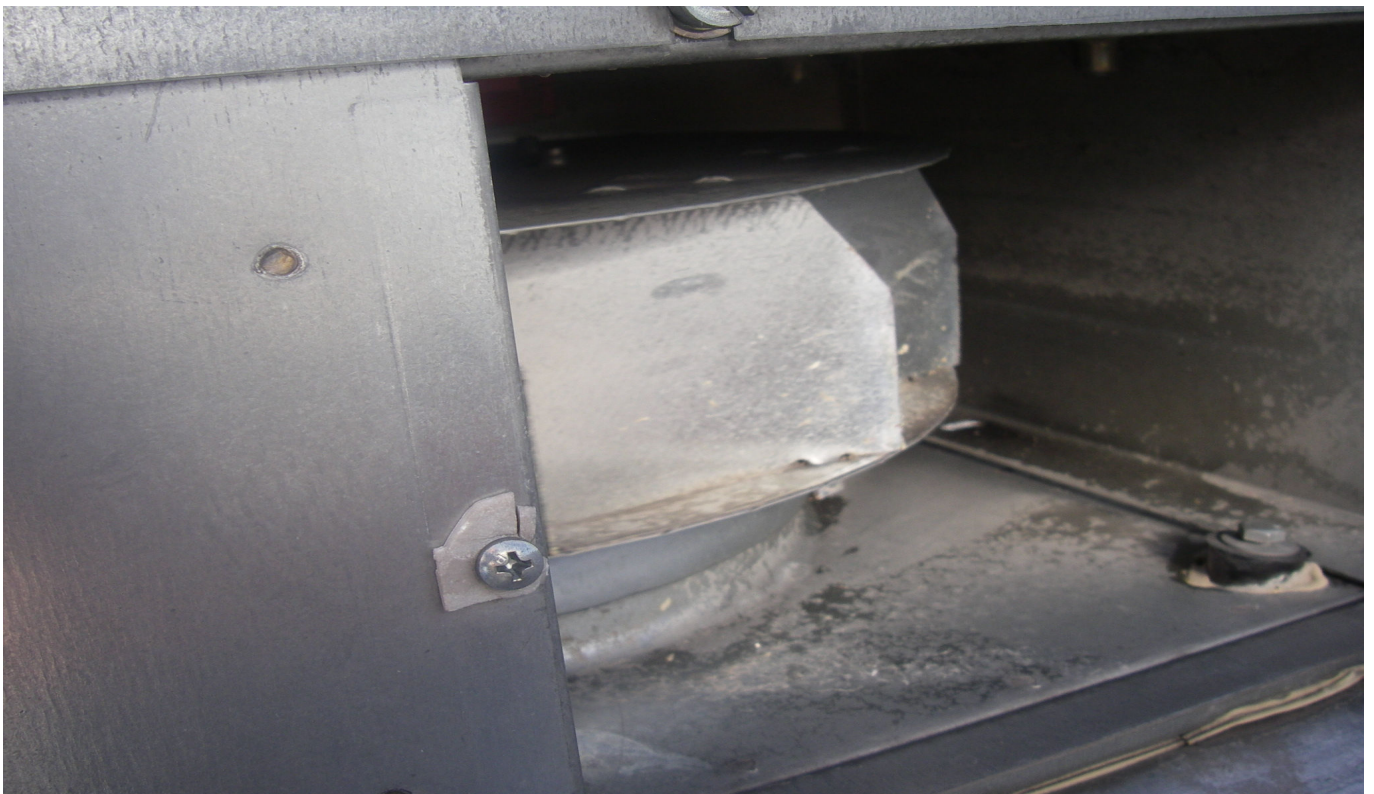
KUVA 25. Yleiskuva päärakennuksen vesikatolla olevasta huippuimurista, josta puuttuu suojaritilä.
