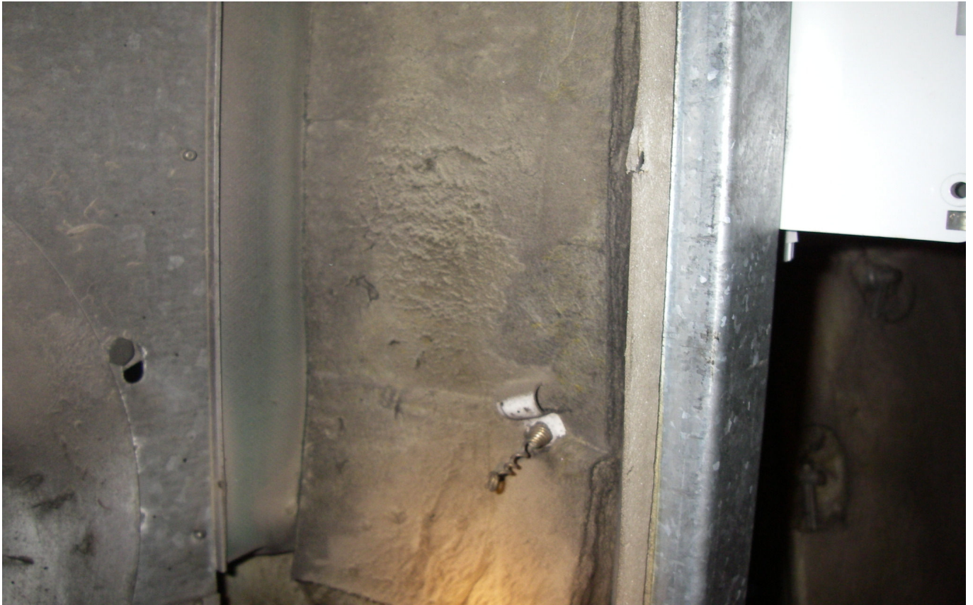
KUVA 8. Tuloilmakoneen kammiot ovat villapintaeristettä, joka on paikoin rikki.
