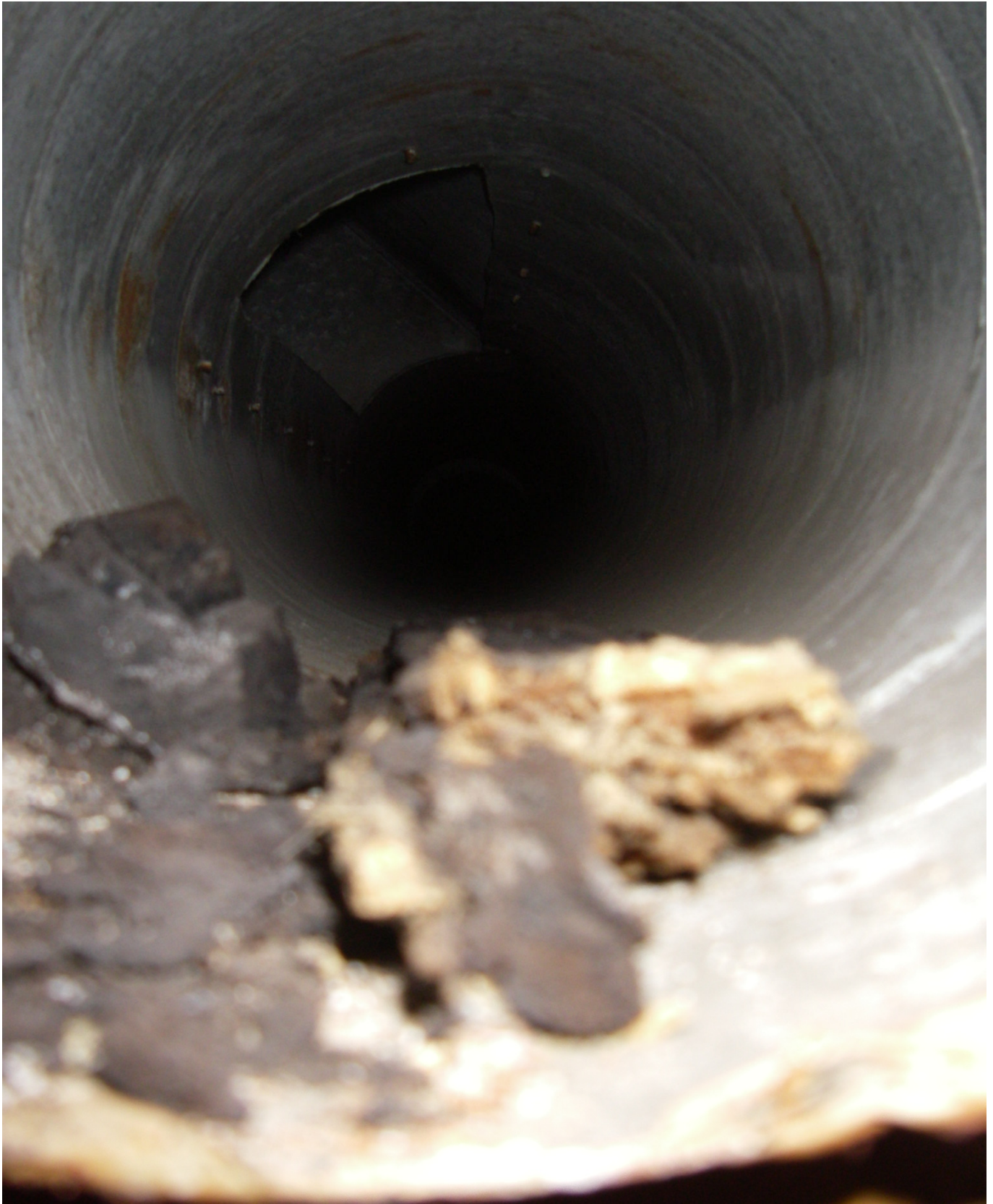
KUVA 28. Yleiskuva päärakennuksen ryhmähuoneen n:o 38 tuloilmakanavasta.
