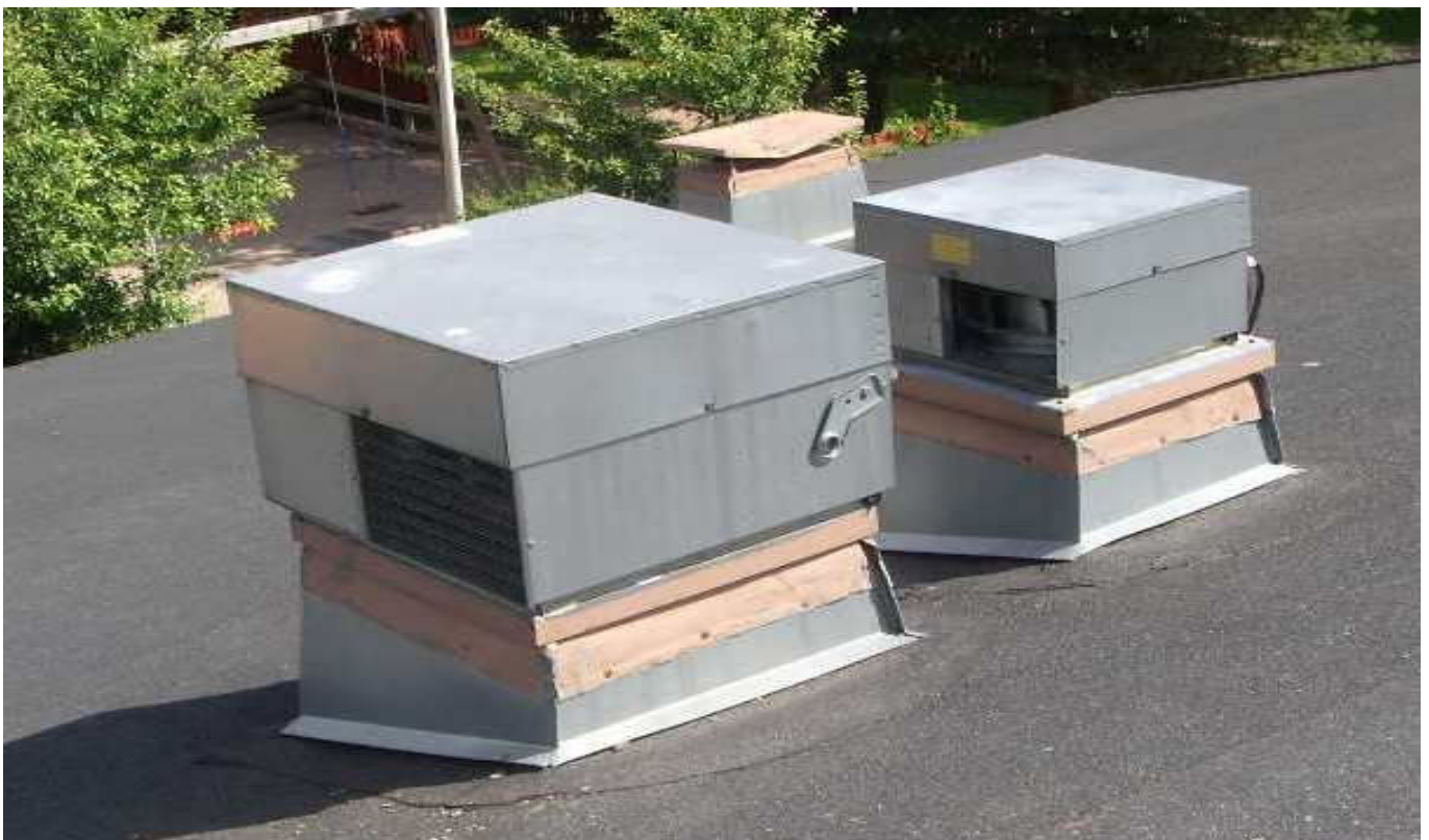
KUVA 2. Yleiskuva päärakennuksen vesikatolla olevista huippuimureista.
