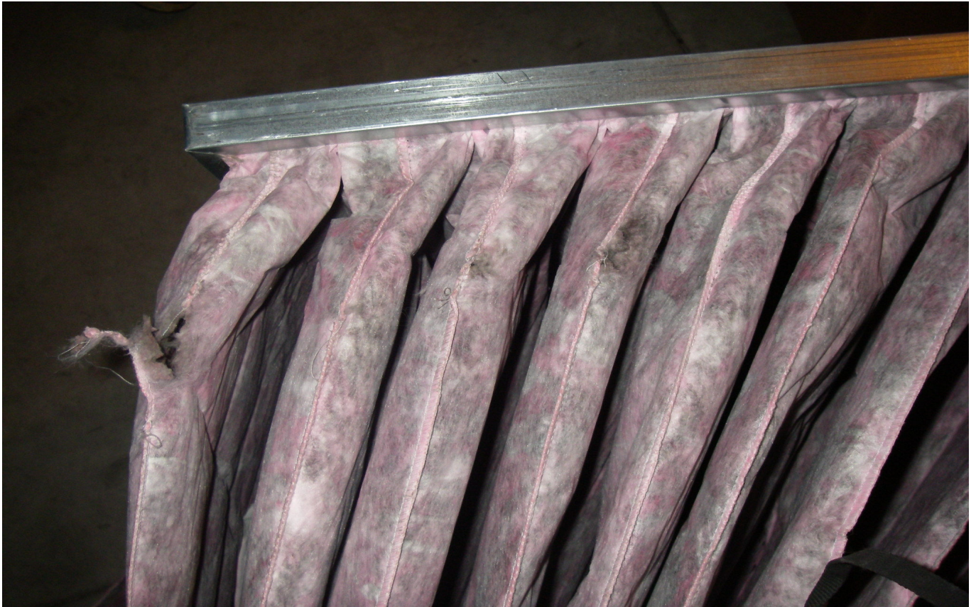
KUVA 10. Yleiskuva päärakennuksen tuloilmakoneen lisäsuodattimesta, joka on rikki.
