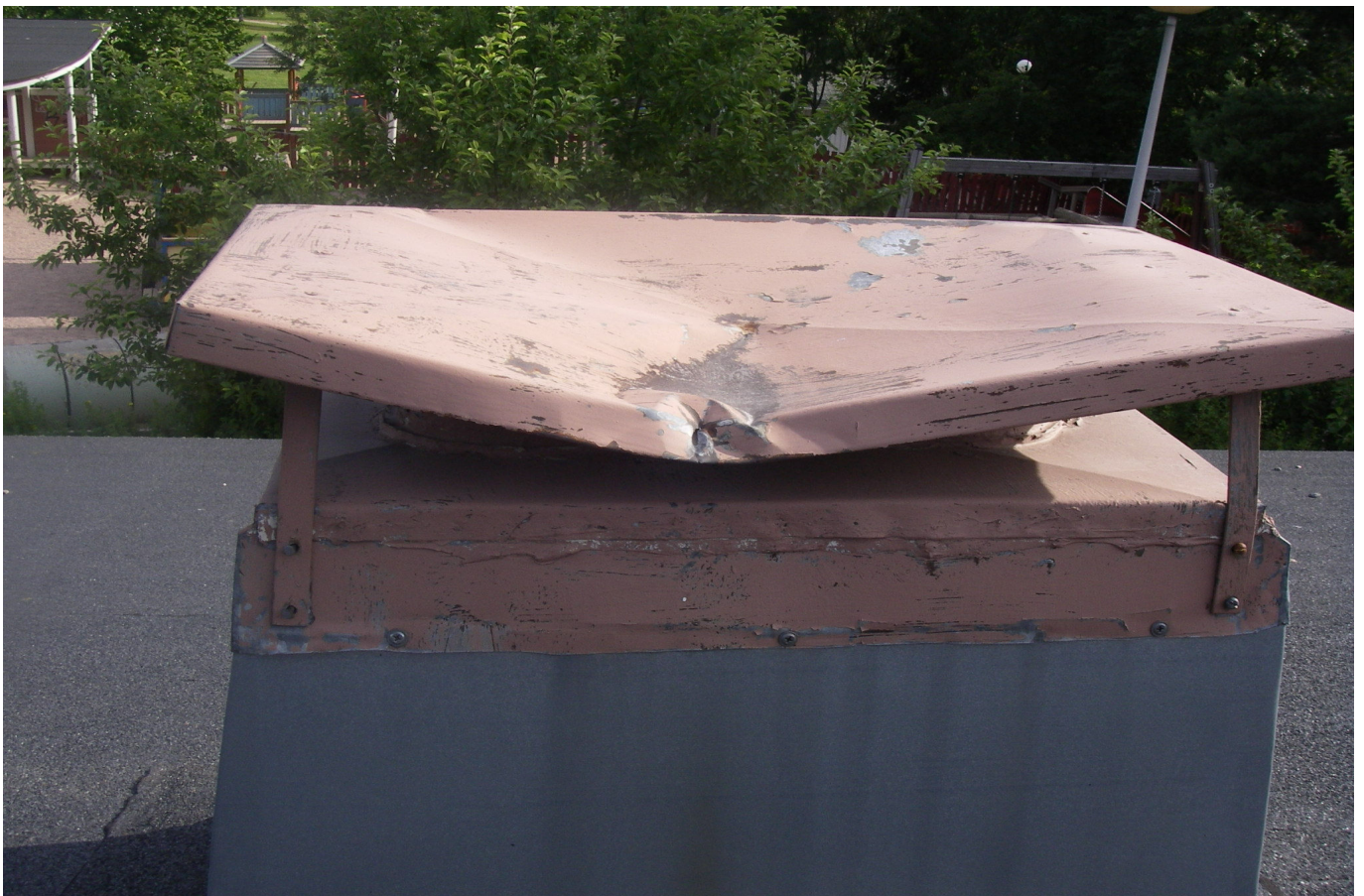
KUVA 40. Yleiskuva LJ- huoneen ilmastointihormin sadehatusta, joka on painettu kasaan.
