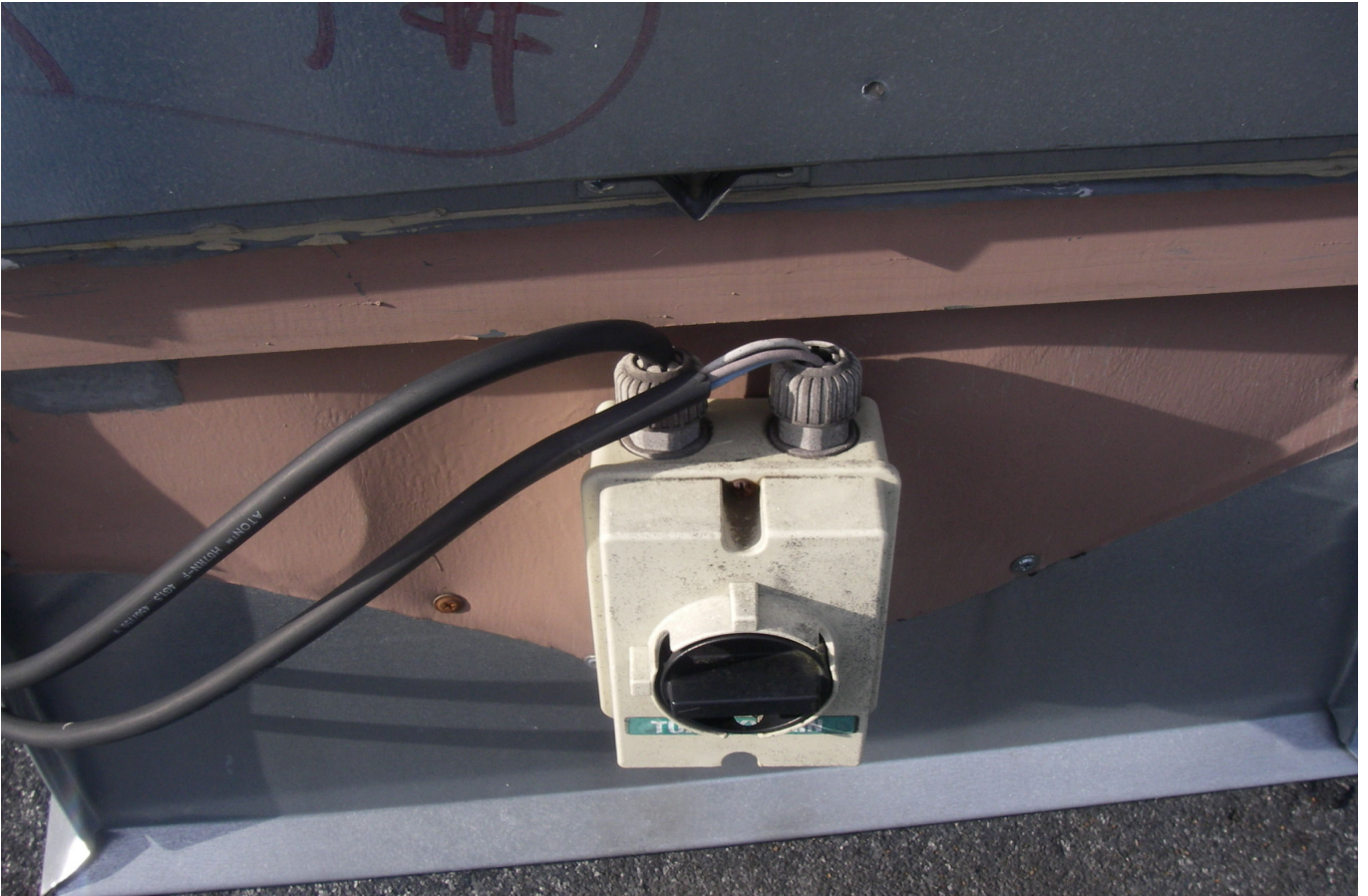
KUVA 16. Yleiskuva päärakennuksen vesikatolla olevista turvakytkimistä.
