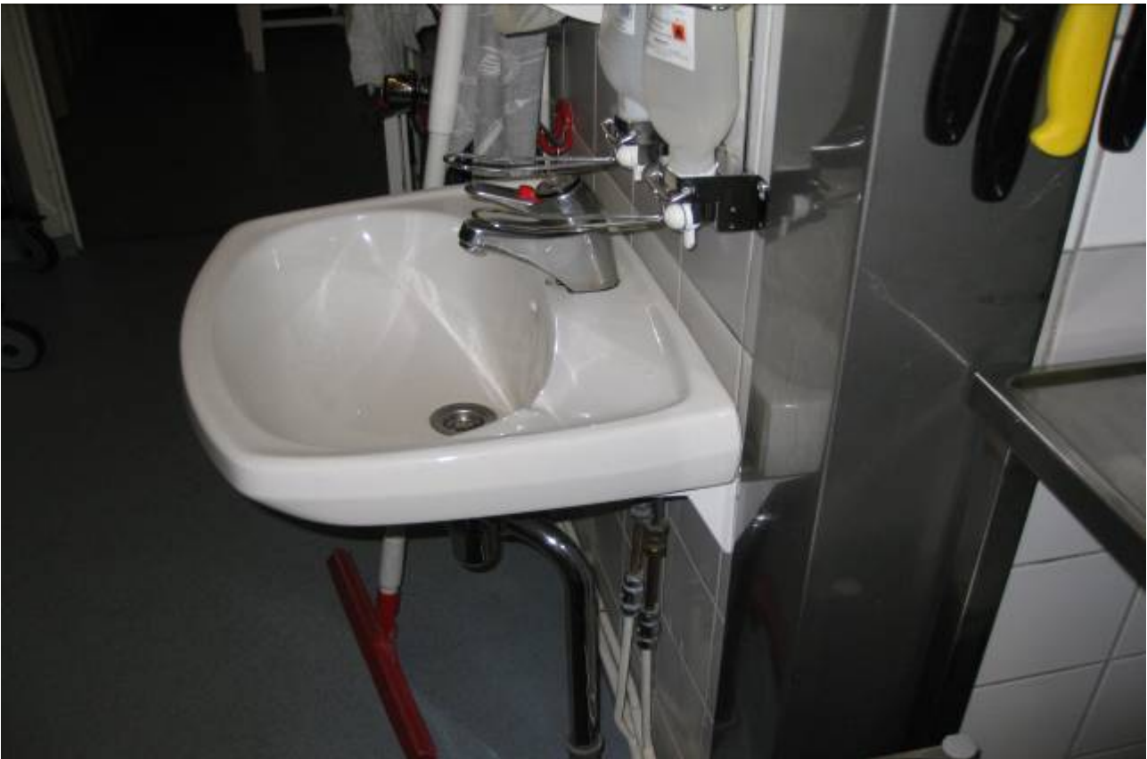
LVI-kuva 3. Yleiskuva vesikalusteista.
