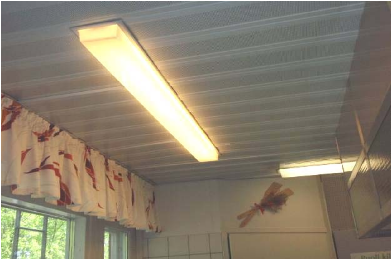
S-KUVA 8. Keittiön valaistus
