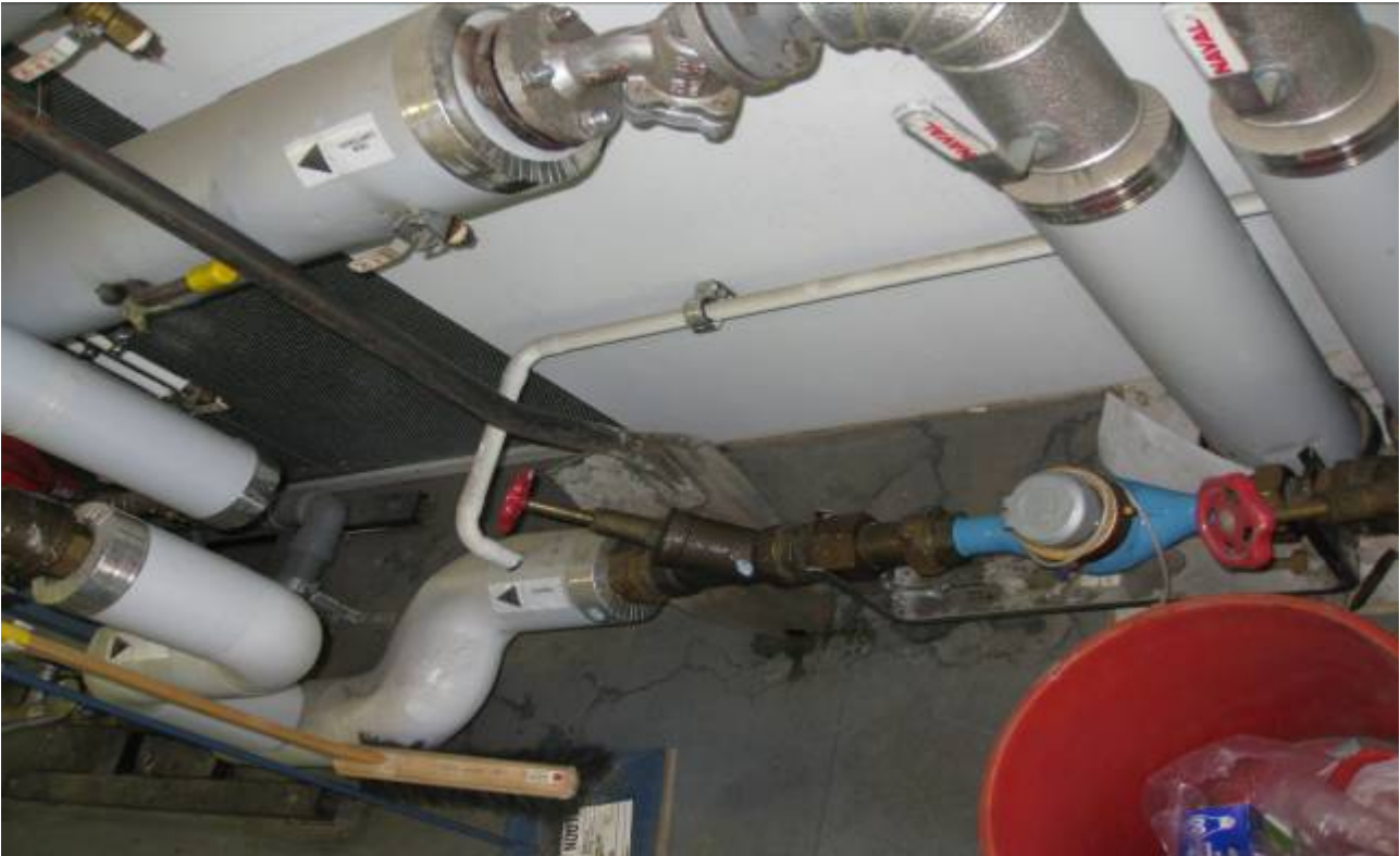
LVI-kuva 2. Yleiskuva vesimittarista ja pääsuluista.
