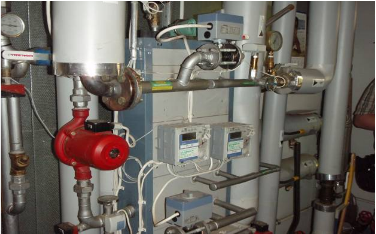
S-KUVA 14. Lämmönjaon yksikkösäätimet
