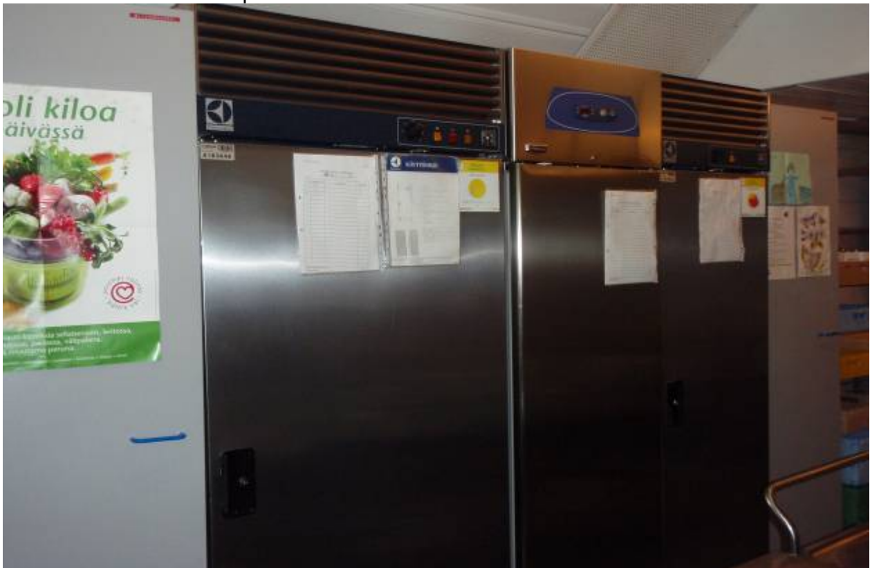
S-KUVA 11. Keittiön kylmälaitteet
