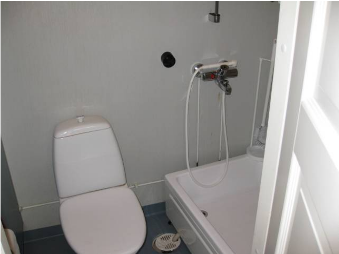
LVI-kuva 4. Yleiskuva vesikalusteista.
