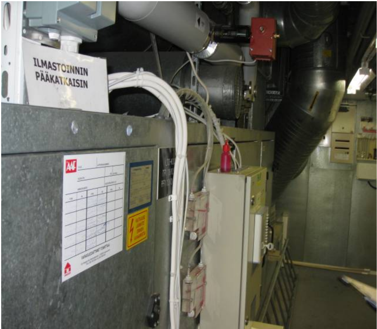
LVI-kuva 5. Yleiskuva IV- konehuoneesta.
