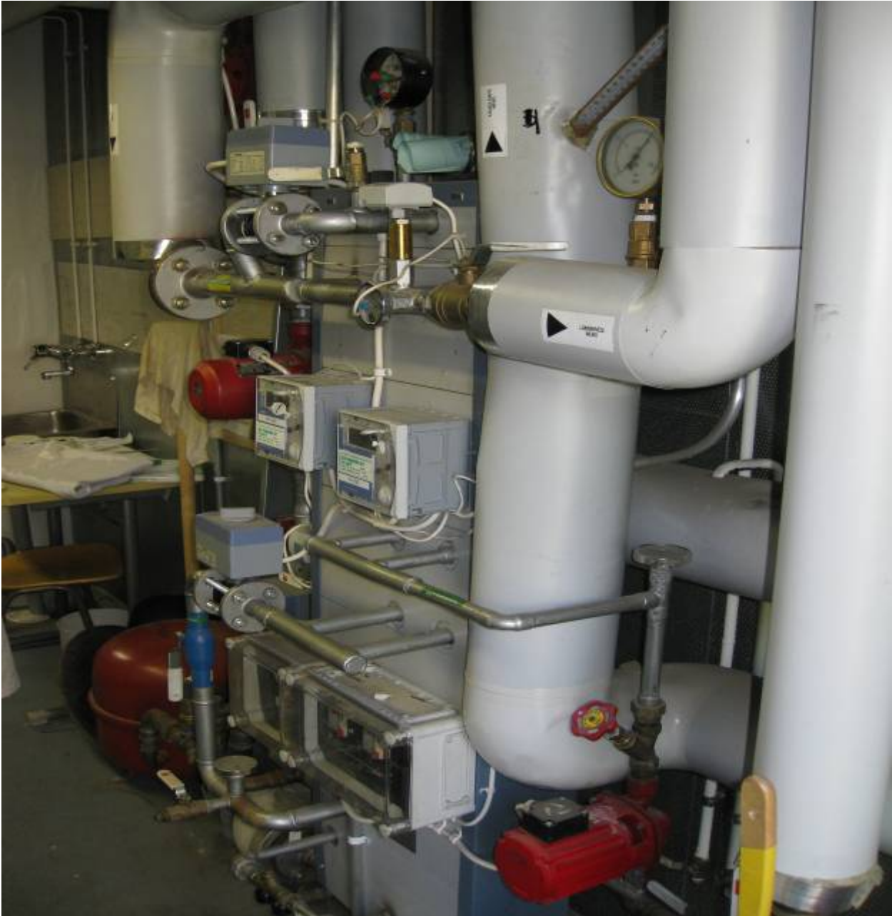
LVI-kuva 1. Yleiskuva lämmönjakohuoneesta.
