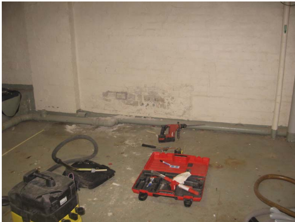
Kuva 4. Vanhoja kosteusjälkiä painesäiliöhuoneen ja polttoainevaraston väliseinässä.
