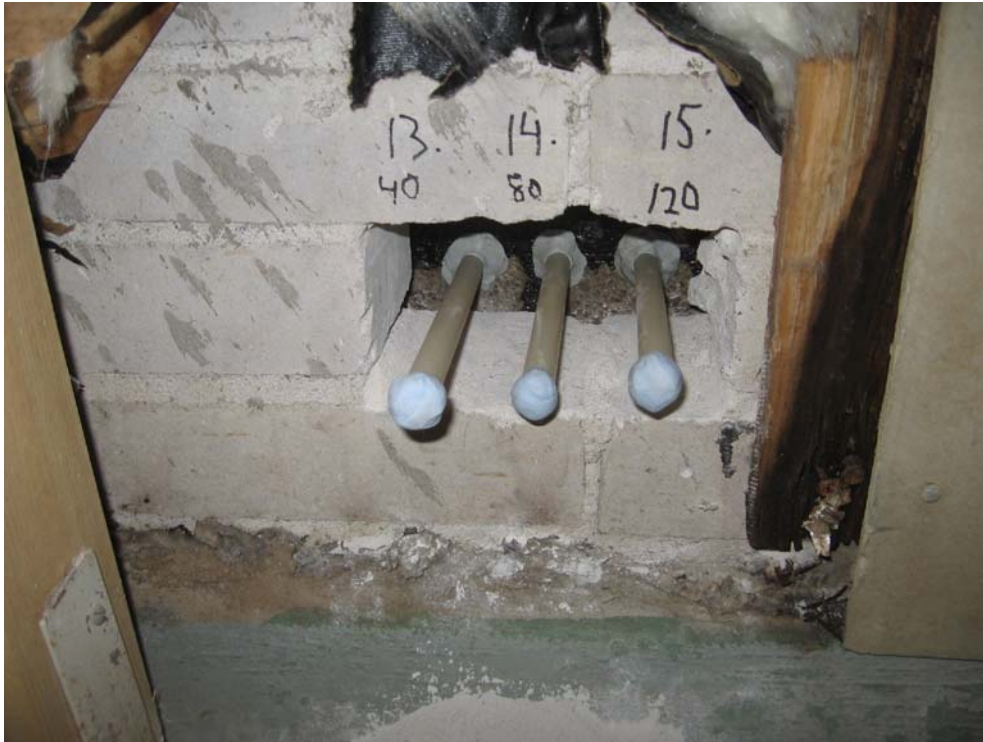
Kuva 3. Saunan seinän kosteusmittaus. 130 mm:n tiiliseinän ja reiästä näkyvän maanvastaisen betoniseinän välissä on n. 30-40 mm:n ilmarako.
