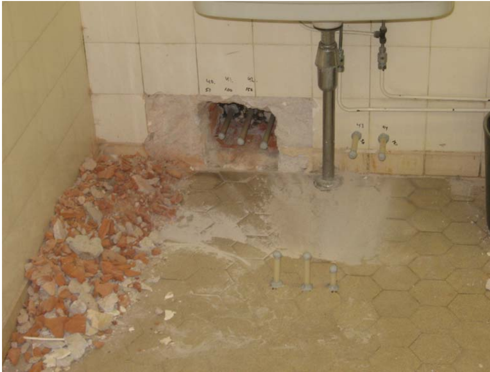
Kuva 1. Kosteusmittauksia poikien vanhassa WC-tilassa. Korkeita betonirakenteiden huokostilan suhteellisen kosteuden lukemia mitattiin molemmissa vanhoissa WC-tiloissa niin maanvastaisista betoniseinistä kuin lattiaistakin.
