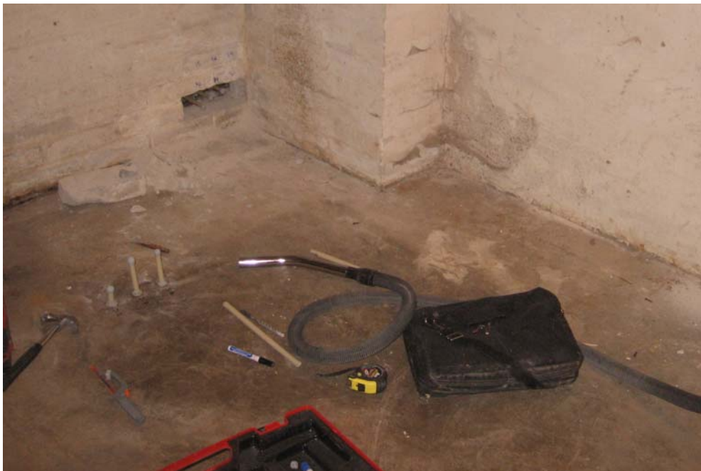
Kuva 2. Vanhan painesäiliöhuoneen maanvastaisista betonilattioista ja -seinistä mitattiin korkeita suhteellisen kosteuden lukemia.
