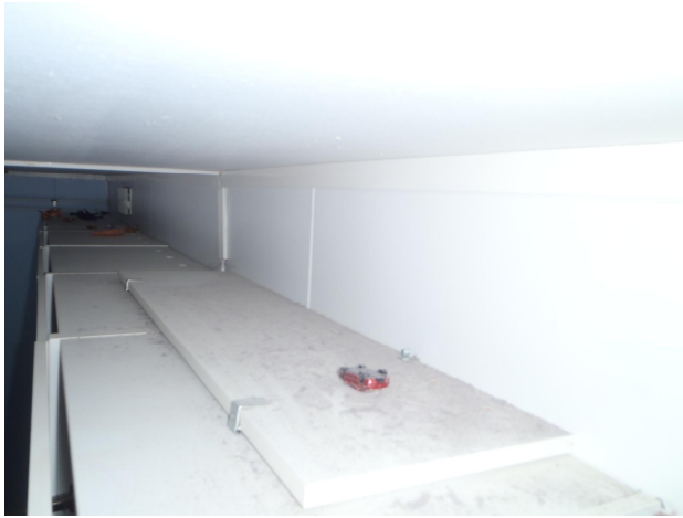
Kuva 20. Arkistokaappien päällä on pölykertymää.
