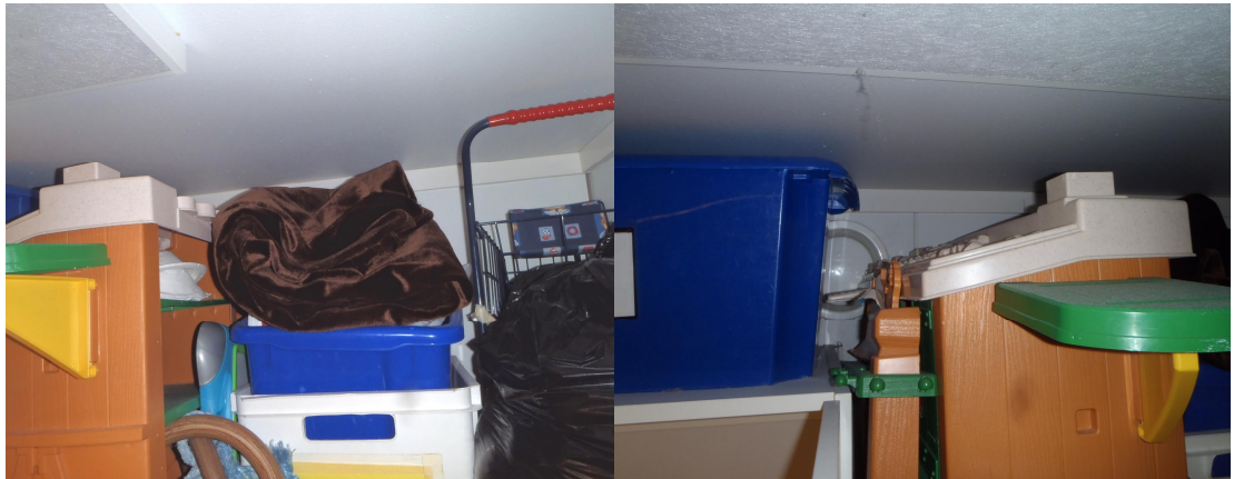
Kuvat 18-19. Poistoilman pääte-elimien eteen on kasattu melko paljon tavaraa.
