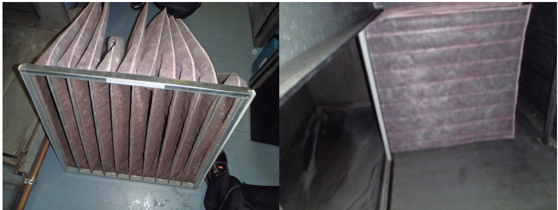
Kuva 3-4. Tuloilman suodatinkehikko on melko tiivis, eikä siinä havaittu ohivirtausta.
