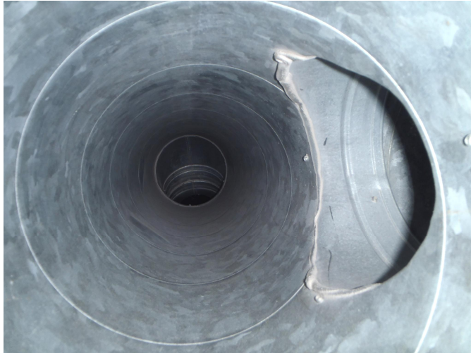
Kuva 15. Poistoilmakanavat ovat melko puhtaat.
