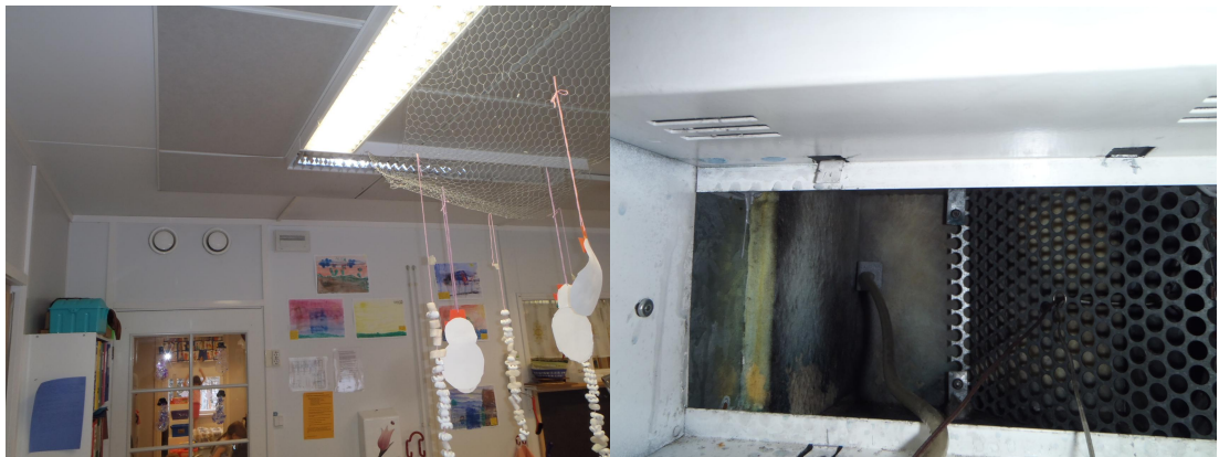
Kuvat 16-17. Tuloilman pääte-elimet, joiden tasauslaatikot on päällystetty mineraalivillalla.
