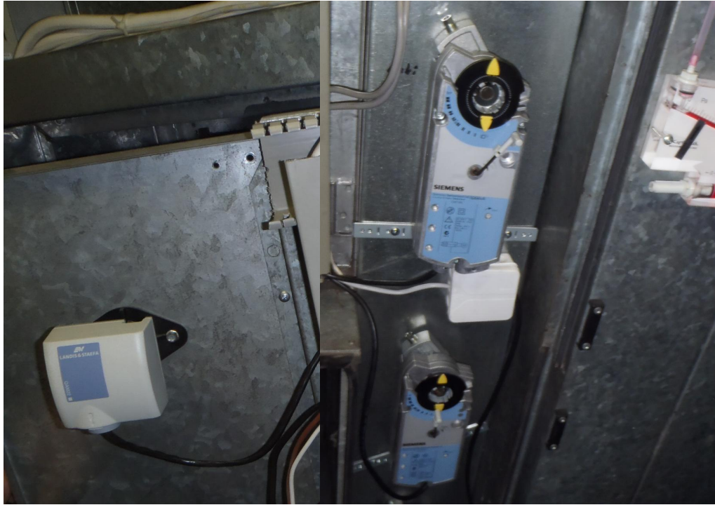
Kuvat 11-12. Ilmanvaihtokoneen peltimoottorit ja lämpötila-anturi.
