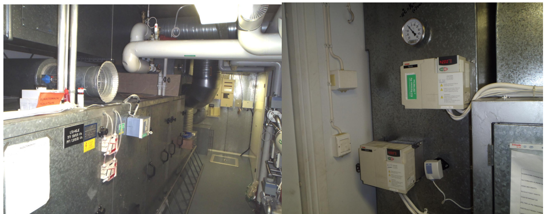
Kuva 1-2. Päiväkodin ilmanvaihtokone ja taajuusmuuntajat.
