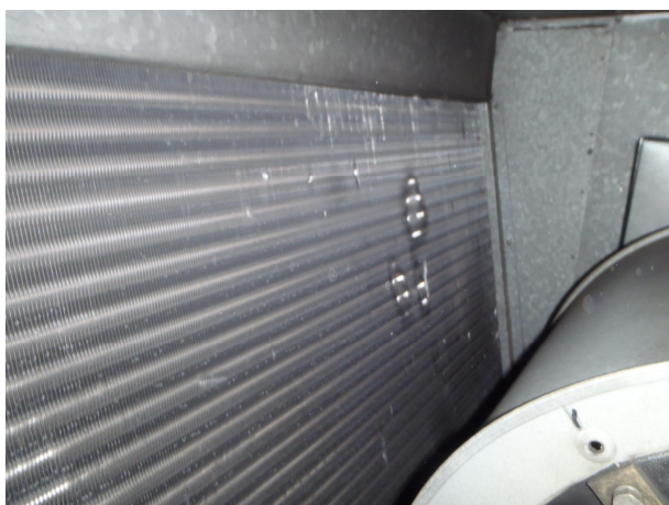
Kuva 7. Lämmityspatterissa on muutama pieni kolhu.
