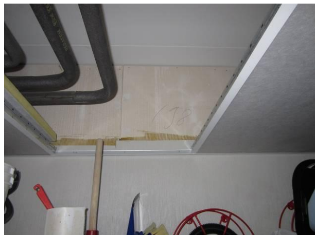
Kuva 40 Käyttövesiputkia alakattotilassa siivouhuoneen 29 kohdalla.
