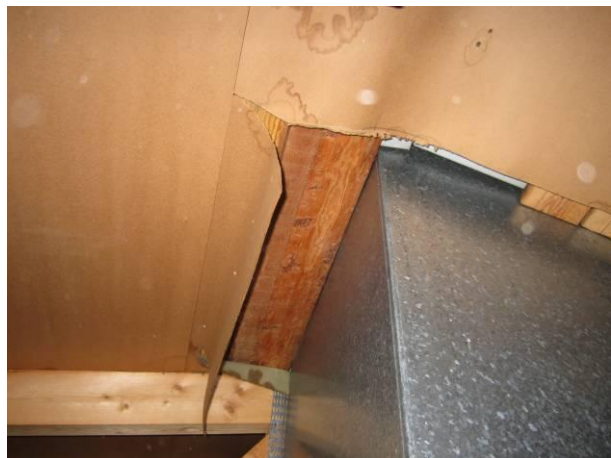
Kuva 22 IV-piipun kohdalla aluskatteen huono läpivienti.
