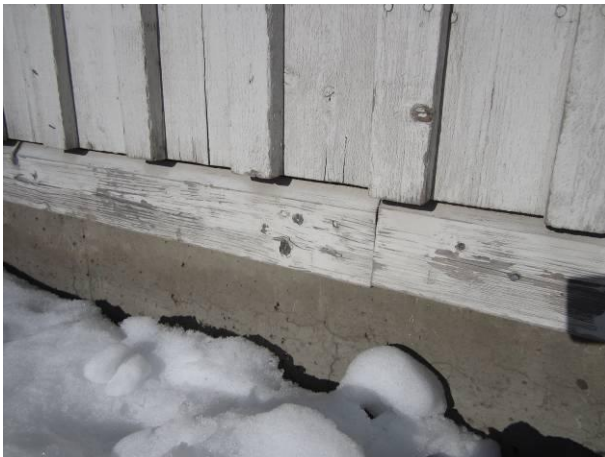
Kuva 11 Maalipinnat ovat kuluneet ja on halkeamia lautojen päissä.
