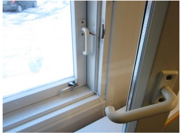
Kuva 16 Tuuletusikkunan vastalevy on painunut, ei sulkeudu tiiviisti.
