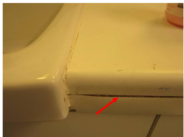
Kuva 32 Uusitun lavuaaritason alla oleva levy on turvonut.
