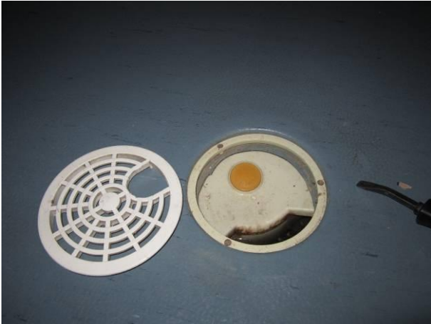
Kuva 27 Märkätilan muovinen lattiakaivo.
