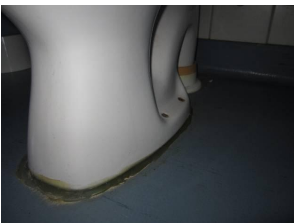
Kuva 31 Wc-pytyn juurikittaus on kulunut.
