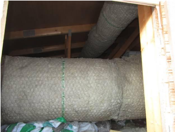
Kuva 19 Nivelosan kulkuluukun edessä oleva IV-kanava.
