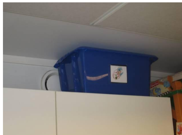
Kuva 36 Tavaraa poistoverkkoventtiilien edessä.
