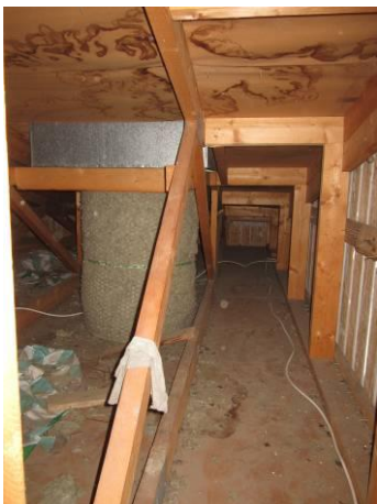
Kuva 21 Vuotojälkiä teknisen tilan IV-piipun ympärillä.
