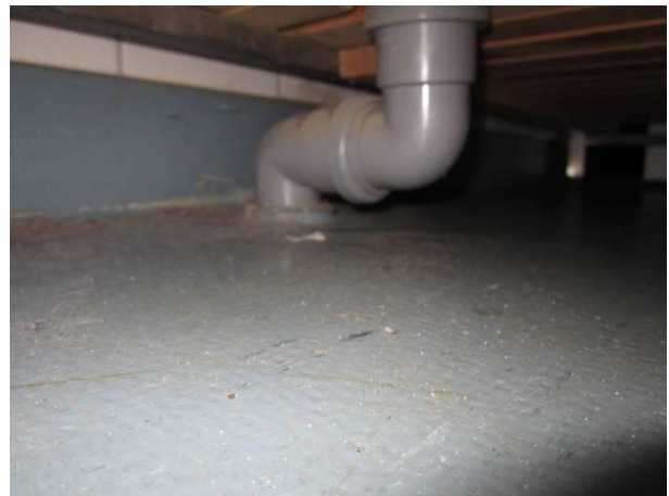
Kuva 30 Märkäeteisen lavuaarin viemäri- läpiviennin kalusteen alla.
