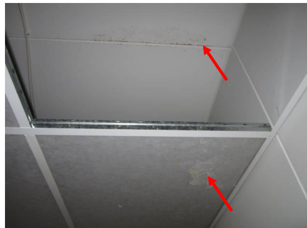
Kuva 26 Vesivuotojälkiä katoissa, tila 7.
