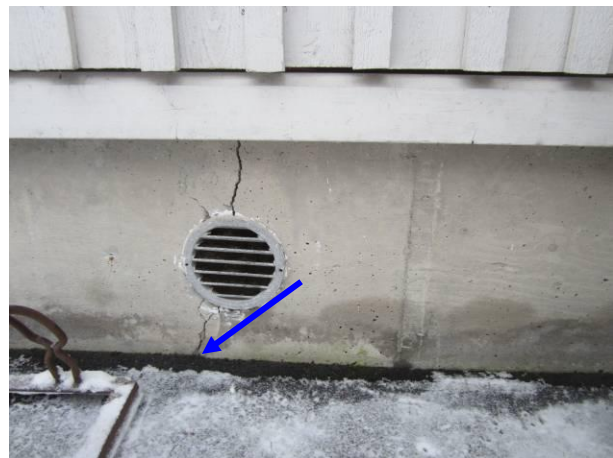
Kuva 8 Henkilöstötila 23 kohdalla tuuletusventtiili on riittävän ylhäällä, halkeama.
