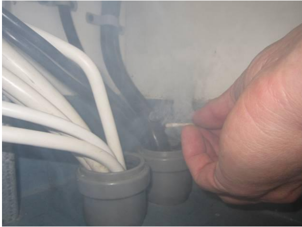
Kuva 13 Sähköpääkeskuksen läpivienneistä tuli ilmaa alustatilasta.
