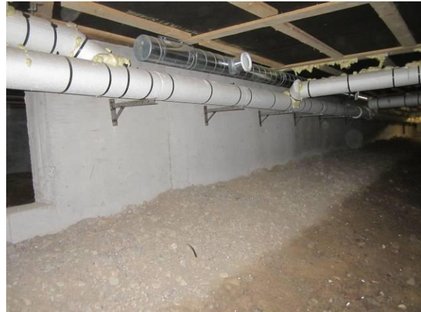
Kuva 10 Itälohkon keskialueen alustatilaan eteisen 44 alla. Ilmanpoistokanava.
