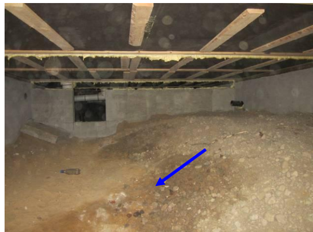
Kuva 22 Kosteaa maata painanteessa ja mikrobikasvustoa itälohkon pohjoissivun alustatila henkilöstötila 23 alla. Perällä poikittainen tuentapalkki.
