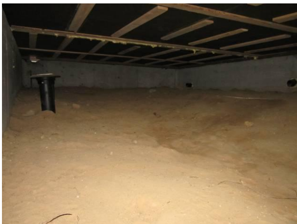
Kuva 3 Salaojan tarkastuskaivo, länsilohko.
