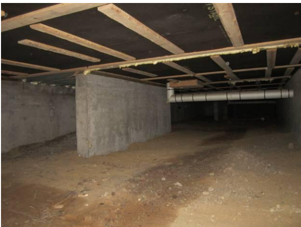
Kuva 21 Itälohkon länsipuolinen alustatila, kosteaa hiekkaa ryhmähuone 48 alla.
