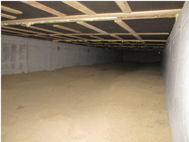
Kuva 15 Itälohkon hyväkuntoista alustatila leikki/ lepohuone 41 alla.
