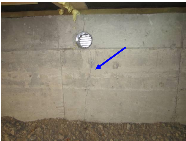
Kuva 7 Tuuletusventtiili ja halkeama perusmuurissa.
