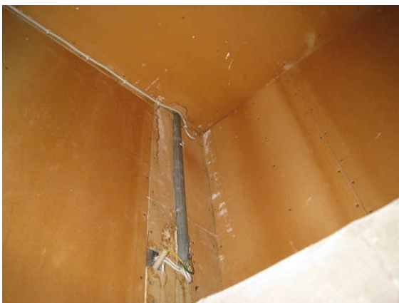
Kuva 15 Vesivuotoa on tapahtunut myös antenniputken kohdalta.
