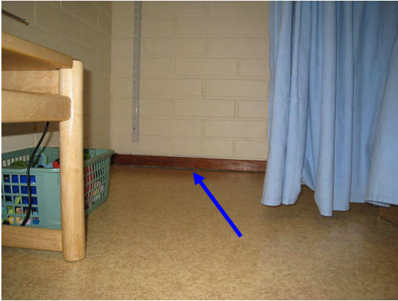
Kuva 3 Lattia on painunut varastossa 48.
