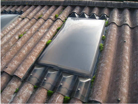
Kuva 11 Vesikatteen pinnalla kasvaa sammalta.
