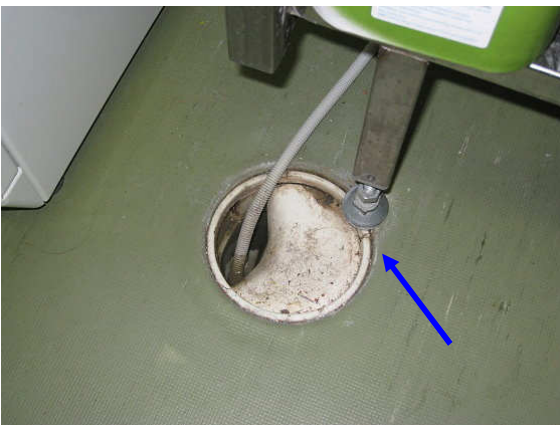
Kuva 27 Lattiakaivot ovat muovia. Kiristysrennas on murtunut.
