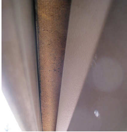
Kuva 17 IV-konehuoneen kohdalla kattorakenteen tuulettumisesta ei saatu selvyyttä.
