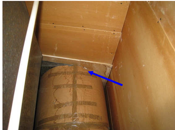
Kuva 14 Vanha vesikattovuoto kohta IV-konehuoneessa.
