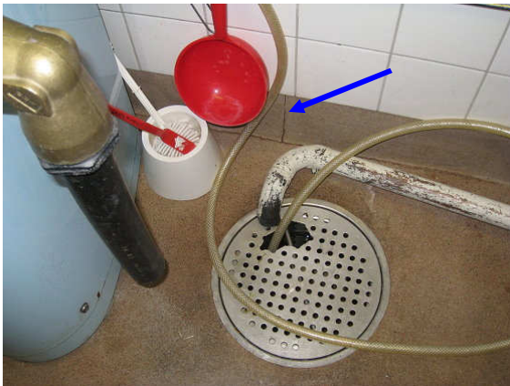
Kuva 21 Keittiön akryylibetonin ylösnostossa on halkeama.
