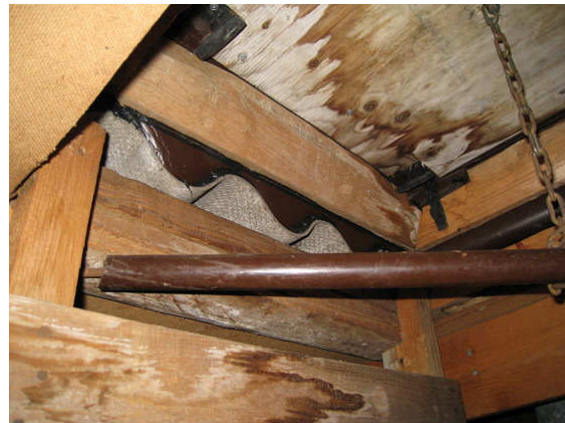
Kuva 10 Kattoluukun kautta on tapahtunut vesivuotoja.
