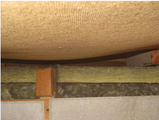
Kuva 13 Liikuntasalin kohdan yläpohjarakenteen tuulettumisesta ei saatu täyttä varmuutta.
