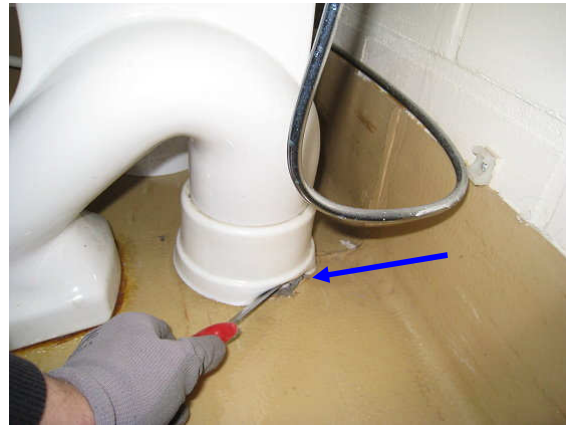
Kuva 26 Tilassa 28 olevan WC-istuimen liitos viemäriin on epävarma.
