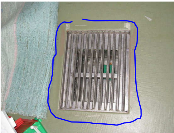
Kuva 19 Vesileikkitila 41 lattiakaivon ympärillä on muovimattoa irti alustastaan. Pintakosteus hieman normaalia korkeampi.
