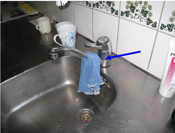
Kuva 25 Pesuallashanojen kiinnityksissä havaittiin puutteita. Huulitiivisteissä on myös vuotoja.
