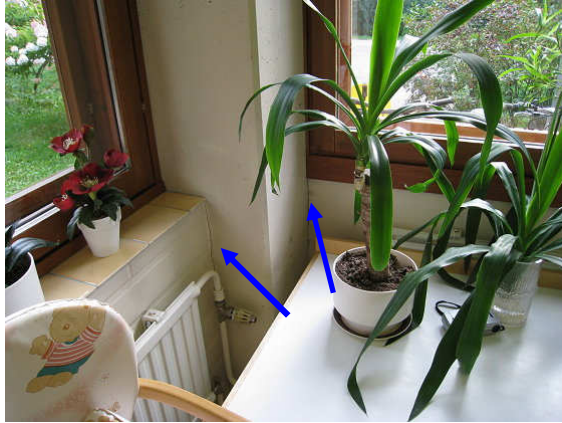
Kuva 7 Eri puolilla kohdetta on teräsbetonipilareiden ja ulkoseinärakenteiden sisäverhousmuurauksien ja kipsilevyjen liitoskohdissa rakoja.
