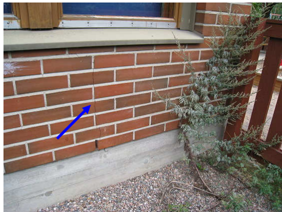
Kuva 6 Julkisivumuurauksessa on pystysuuntainen halkeama
