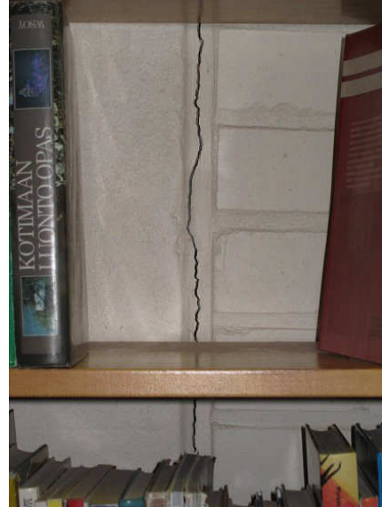
Kuva 8 Myös väliseinämuurauksien ja pilareiden väleissä on rakoja.
