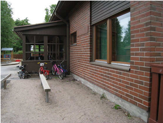
Kuva 1 Maanpinnat ovat kohdilla, joissa ei ole soraa, painuneet ja maa viettää rakennukseen päin.
