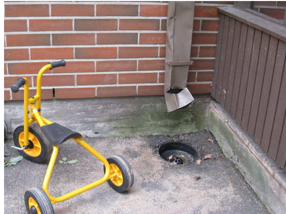
Kuva 2 Rikkoontunut syöksytyrven vedenheitin. Maanpinta on painunut.
