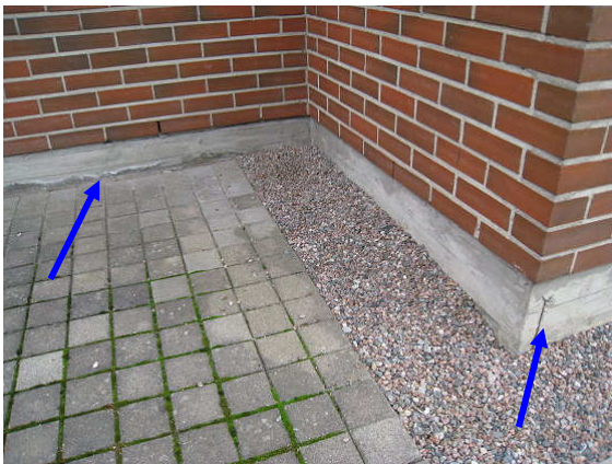
Kuva 5 Sokkelissa on näkyvillä kalkkihärmettä ja ruostunutta raudoitusta.
