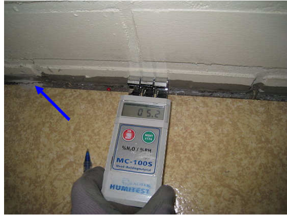
Kuva 4 Alimman näkyvillä olevan tiilen pintakosteus on normaalia korkeampi. Lattian ja seinän rajapinnassa on rako.
