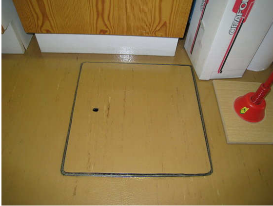
Kuva 29 Putkikanaalin tiivistämätön tarkastusluukku on tilassa 23.
