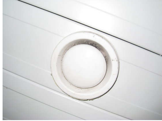
Kuva 24 Poistoilmaventtiilit ja kanavat ovat likaiset.
