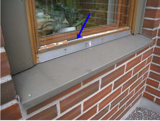
Kuva 23 Ikkunoiden kittauksia on monin paikoin irronnut.
