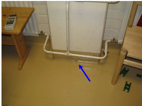
Kuva 22 Muovimatossa reikiä tilassa 42 (verstas).
