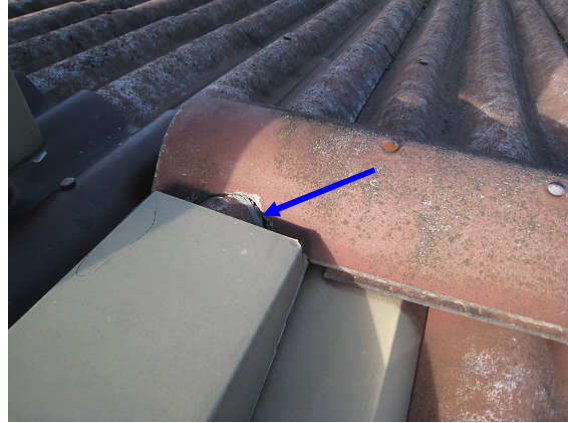
Kuva 12 Harjalevyn puutteellinen tiivistys.
