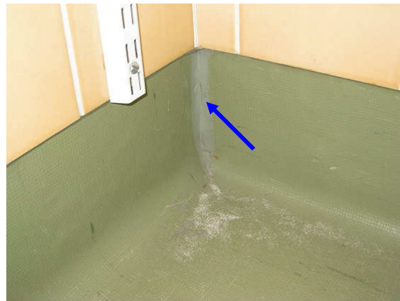
Kuva 20 Em. tilassa muovimaton ylösnostojen väleissä on rakoja.
