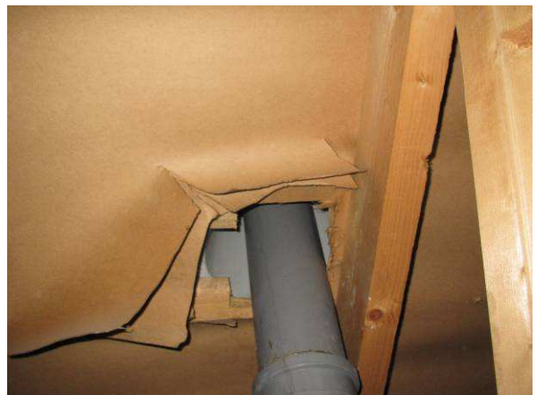
Aluskatteen päällä ei ole korotusrimoja, tuuletusputkea ei ole eristetty ja sen kannakointi on puutteellinen
