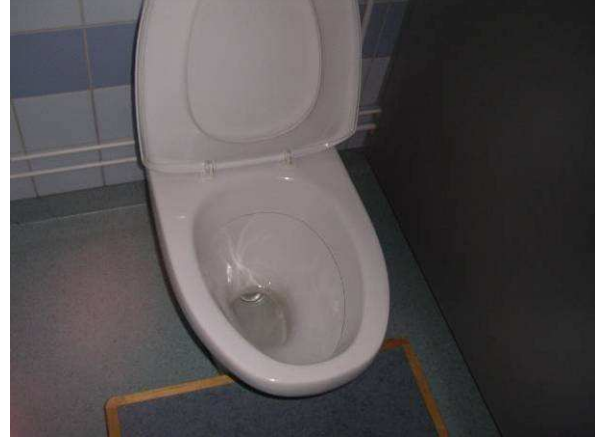
Vuotavia wc-istuimia havaittiin 3 kpl.
