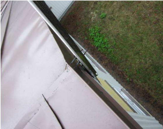
Antennin kiinnikkeet ovat irtoamassa otsa-laudasta
