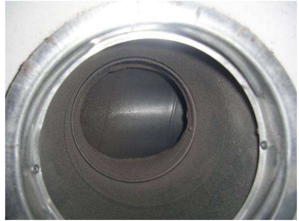
Ilmanvaihtokanavissa oli lievää pölykertymää.
