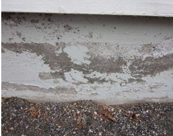
Maalipinnoite hilseilee sokkelista
