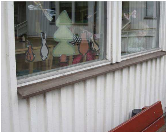
Ikkunapellityksien kallistukset ovat turhan loivia
