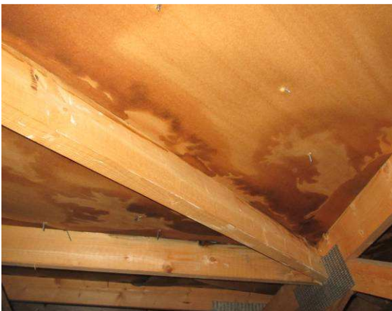
Jiirin kohdalla aluskatteessa on laajasti kosteusjälkiä
