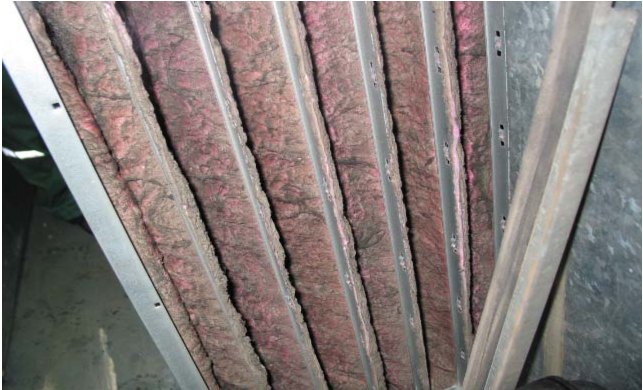
KUVA 2. Tuloilmakoneen suodattimet ovat hieman pölyiset.
