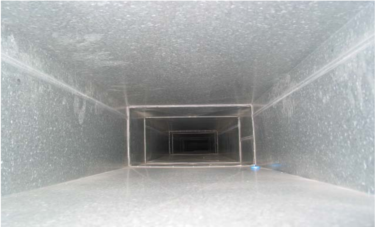
KUVA 5. Tuloilmakanavat ovat melko puhtaita.
