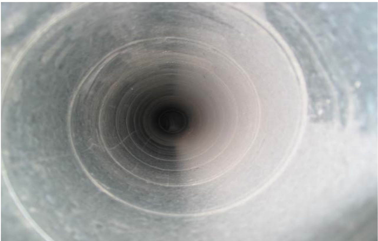
KUVA 6. Poistoilmakanavissa on hieman pölykertymää.
