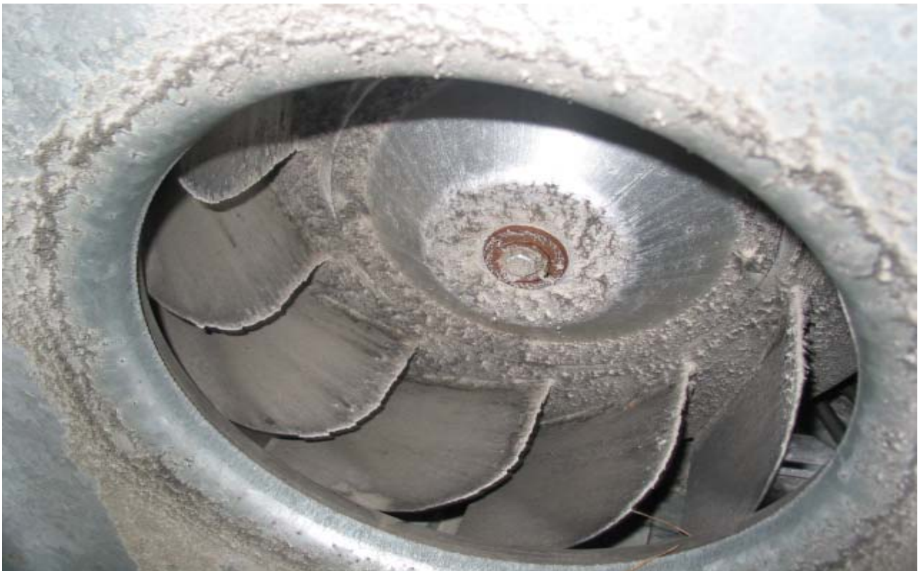
KUVA 4. Keittiön poistoilmapuhallin on melko likainen.
