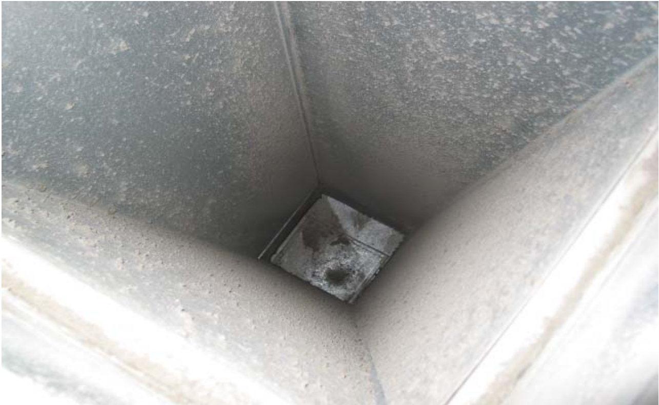
KUVA 7. Keittiön poistoilmakanava on pölyinen.
