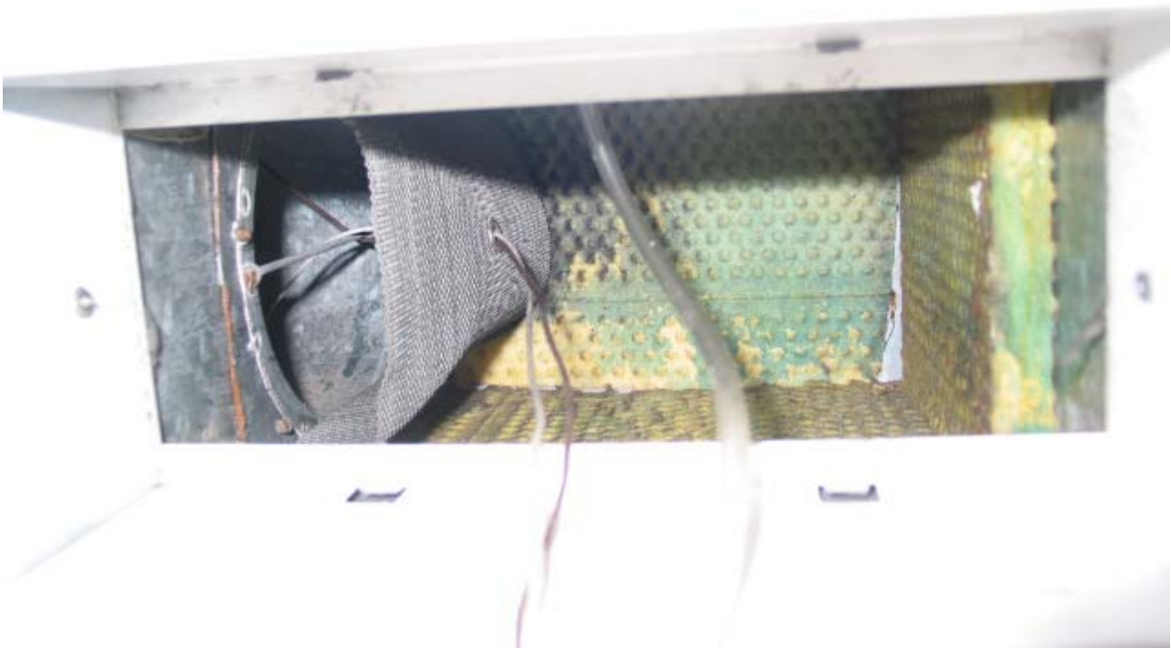
KUVA 8. Tasauslaatikot ovat melko puhtaita ja villapinnat on käsitelty suoja-aineella.
