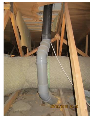
Kuva 36 Eristämätön ja tukematon tuuletusviemäri, aluskate laajalti rikki.
