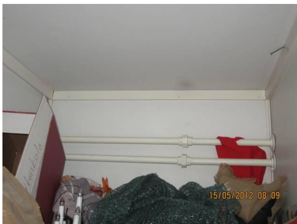
Kuva 51 Eristämättömiä lämpöjohtojen runkoputkia.
