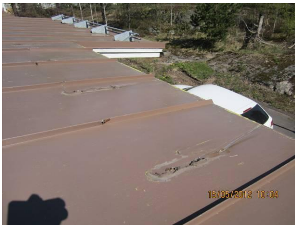
Kuva 29 Lumieste on irti, läpireiät paikkaamatta.
