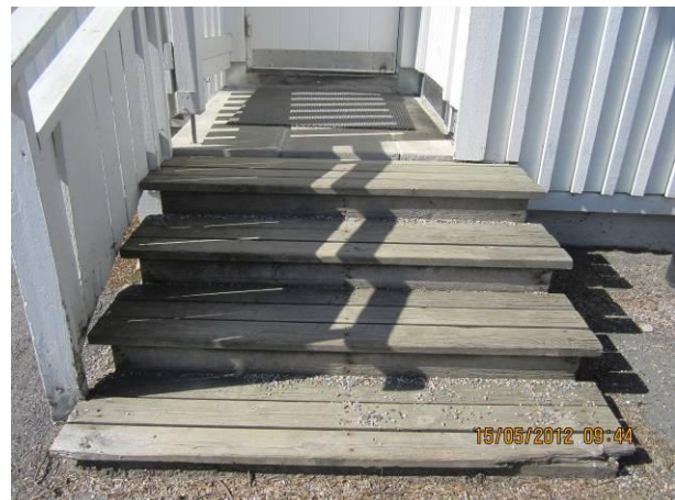
Kuva 26 Keittiön kuluneet ulkortaat.
