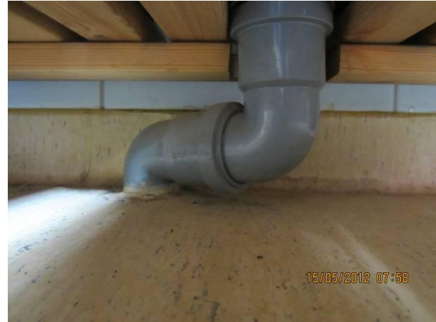
Kuva 16 Märkäeteisen lavuaariviemäri liittymä on tiivis.
