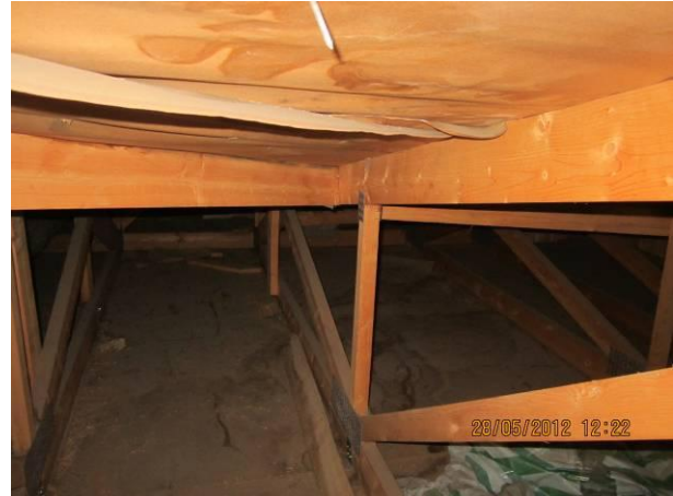
Kuva 32 Vuotojälkiä jiirin alla aluskatteessa ja yläpohjan levypinnalla.
