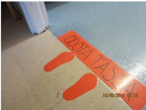
Kuva 13 Wc-pesuhuoneen ja käytävän välissä ei ole kynnystä.
