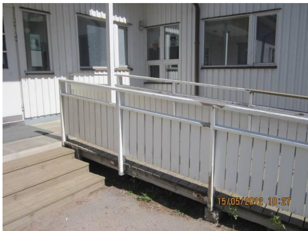
Kuva 25 Sisäpihan puuportaat ja luiska, kaiteissa selvästi pintalahoa.
