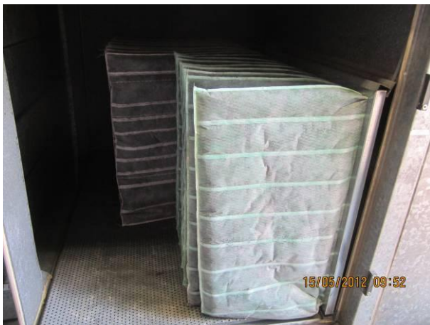
Kuva 47 Epätiivis IV-suodattimen ja kanavan liittymä ei ole tiivis.
