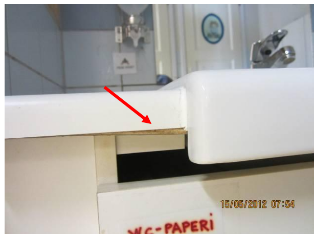
Kuva 40 Kosteudesta turvonnut allastason laminaattilevy.
