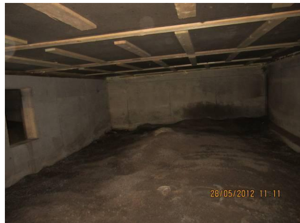
Kuva 10 Ryhmähuone 3 alapuolella kiviä tai kalliota esillä, mikrobikasvua maanpinnassa, ohuelti kevytsoraa.
