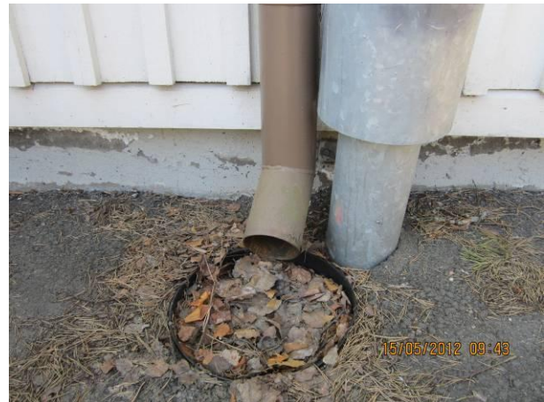
Kuva 4 Rännikaivo huoltamatta, matalassa sokkelissa kalkkijälkiä.
