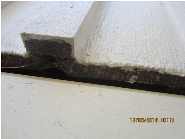
Kuva 19 Lautojen päät huonosti maalattu.
