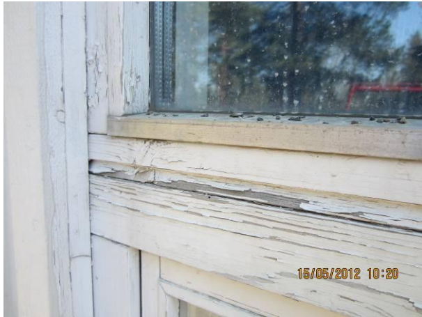
Kuva 23 Ulkopinnassa on jo pieniä kosteusvaurioita.
