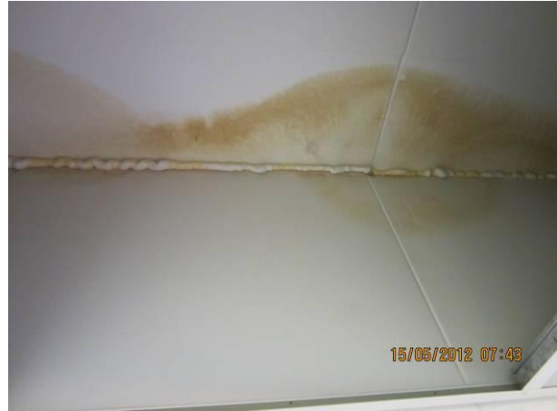
Kuva 46 Vuotojälkiä ulkoseinällä kotikeittiö 49 päätyseinällä.
