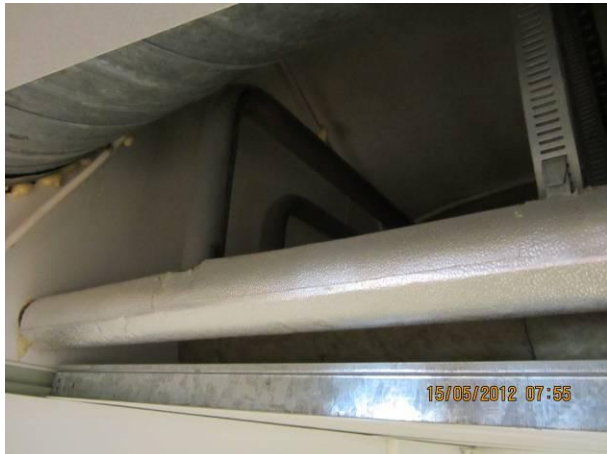
Kuva 49 Eristettyjä lämpö- ja kv-putkia.
