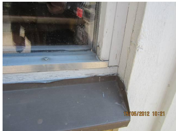
Kuva 22 Lähes tasainen vesipelti, epätiiviyttä liittymiä..
