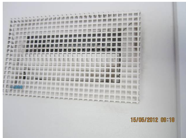
Kuva 48 Tuloilmasäleikössä on likaa.
