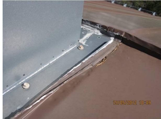
Kuva 28 Iv-läpiviennin tiiveys on kitin varassa
