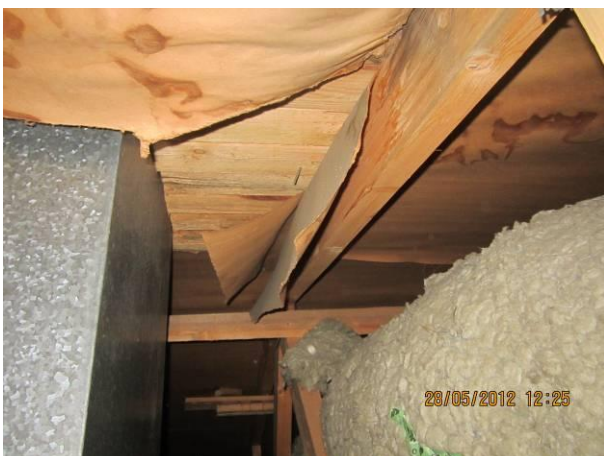
Kuva 35 Iv-kanavan läpivienti ei ole tiivis, repeämä aluskatteessa.
