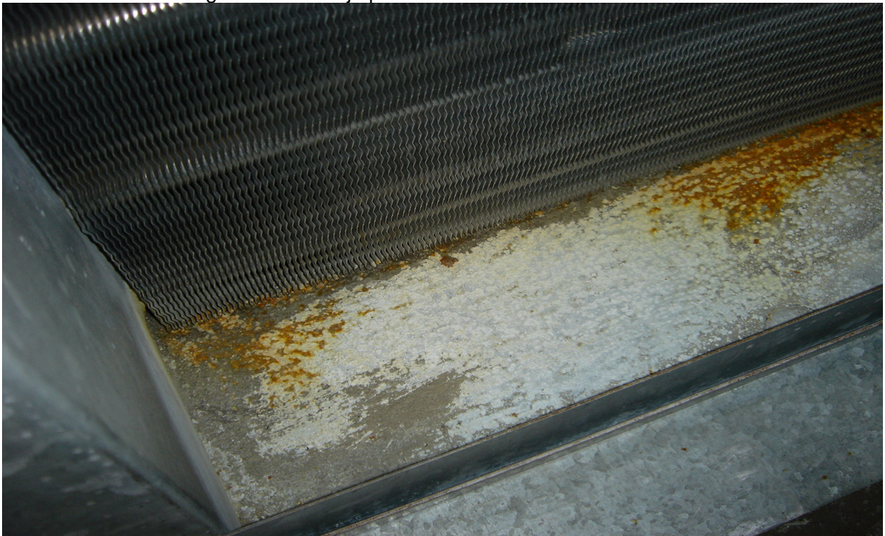
KUVA 2. Jäähdytyspatterin jälkeisessä rungossa on hapettumaa, joka tulisi puhdistaa.
