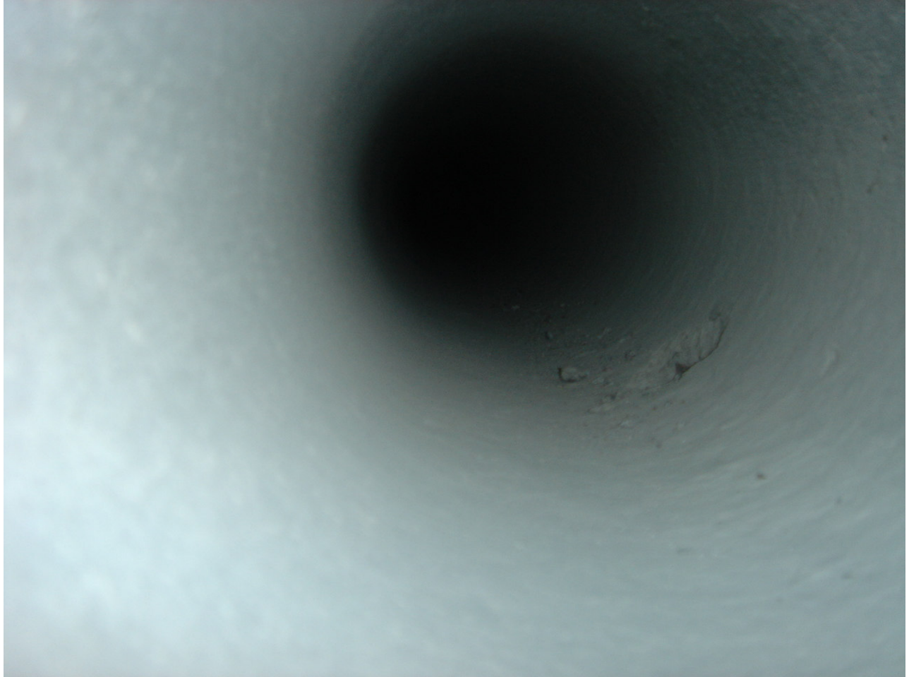
KUVA 12. Onteloiden pinta on paikoin kolhiintunut.
