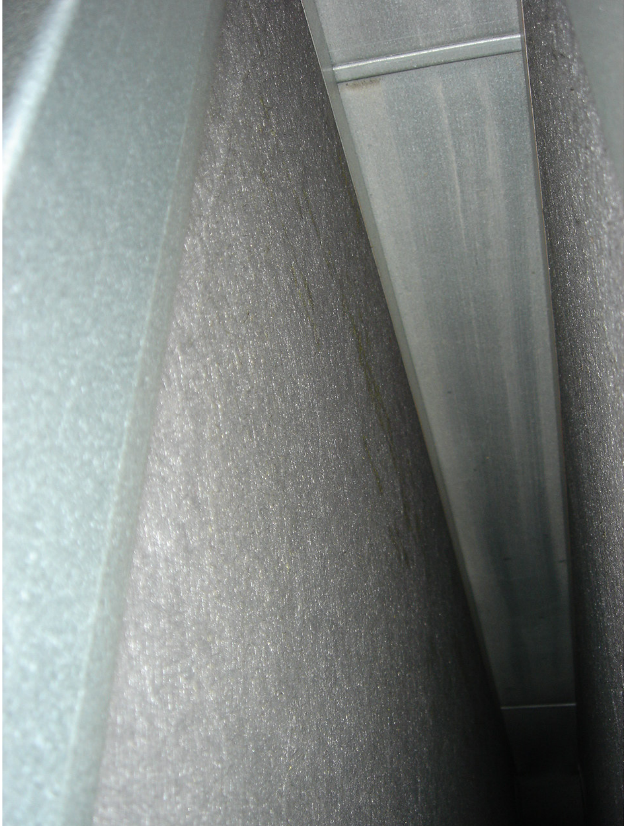
KUVA 5. Äänenvaimentimien pinta on kuitupintaista.
