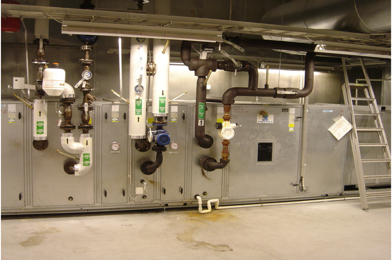
KUVA 1. Yleiskuva ongelmahuonetilaja palvelevasta tuloilmakoneesta.
