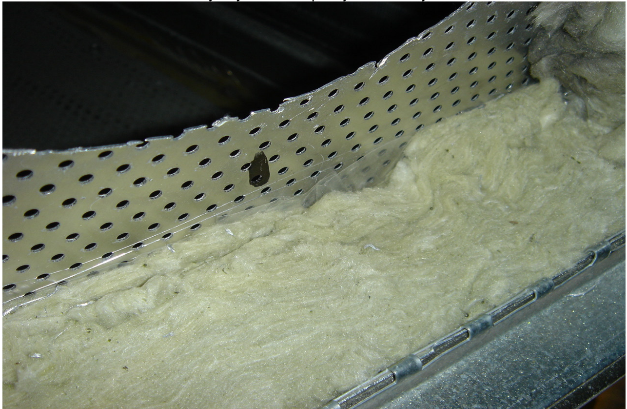
KUVA 7. Puhdistusluukun teon yhteydessä villapintoja ei ole suojattu asianmukaisesti. Alkuperäiset pinnat on suojattu muovikalvolla.
