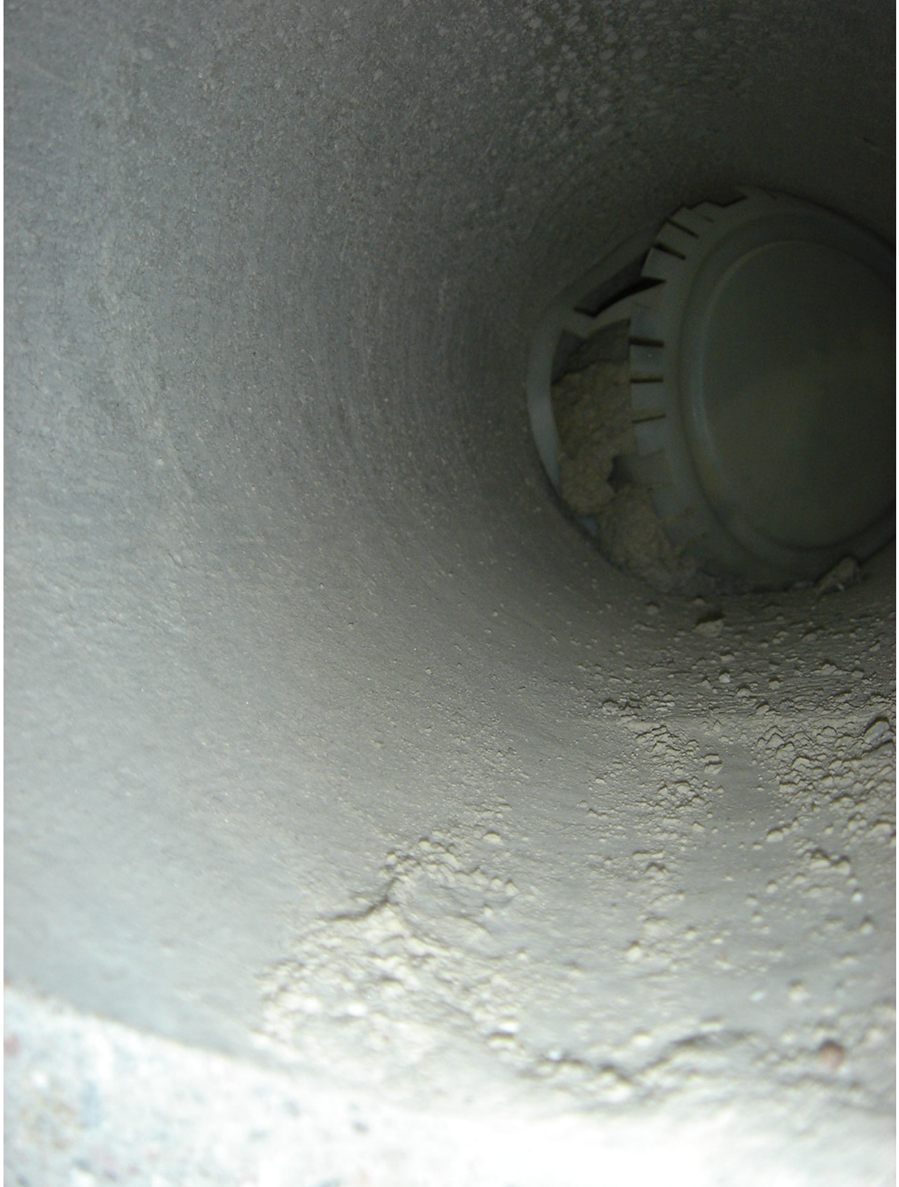
KUVA 13. Onteloissa on runsaasti hienojakoista betonipölyä.
