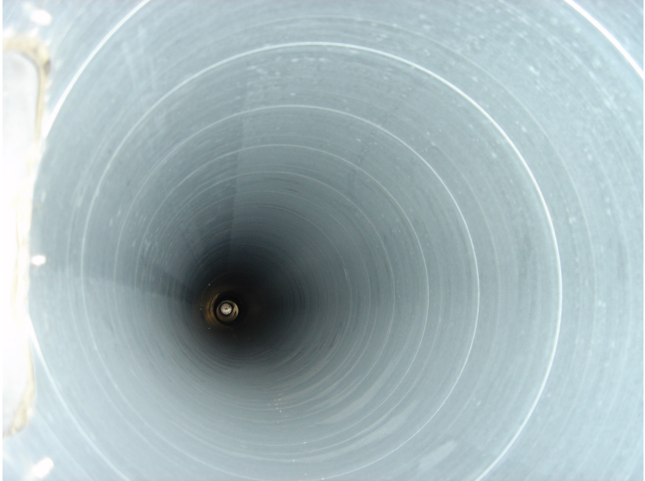
KUVA 10. Peltiset tuloilmakanavat ovat melko puhtaita.
