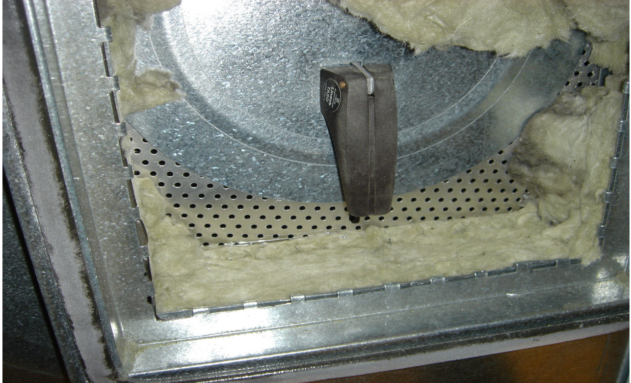
KUVA 6. Puhdistusluukun teon yhteydessä villapintoja ei ole suojattu asianmukaisesti.
