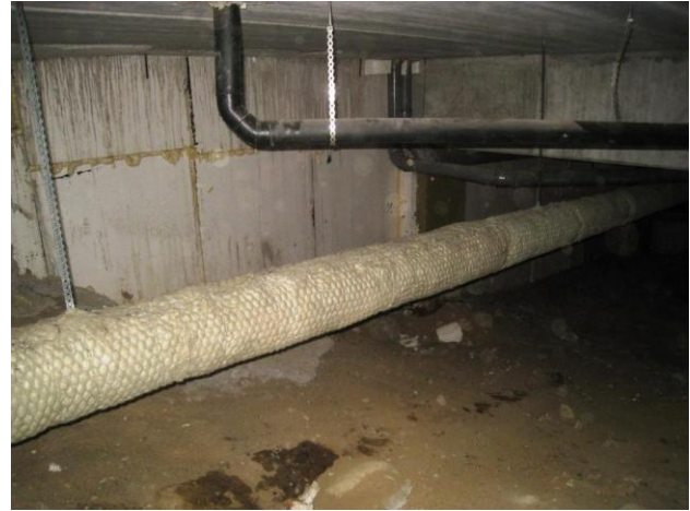
Kuva 4 Mineraalivillaeristeen putki sokkelipalkin alta VSS-tilaan. Eriste on märkä alapuolelta.
