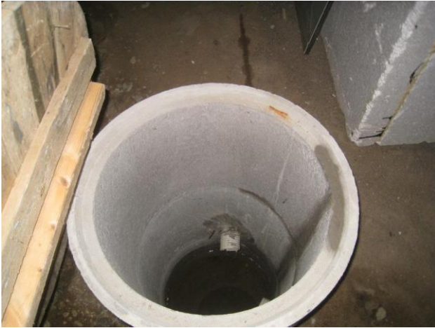
Kuva 11 Salaojaputkien tarkastuskaivo D-osalla. Pohjalla vettä.
