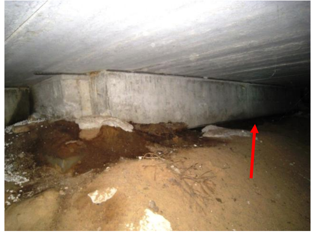
Kuva 25 Sokkelin vastatäyttö puuttuu.
