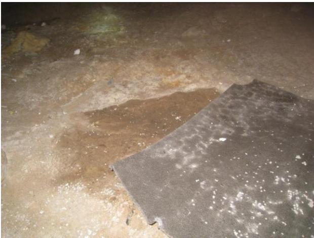
Kuva 40 Märkää ja mikrobikasvustoa sisältävää maata solumuovimaton alla.
