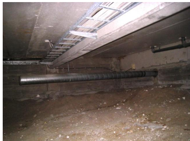
Kuva 34 Ilmaputki C-osan näyttämön kohdalla päädyssä
