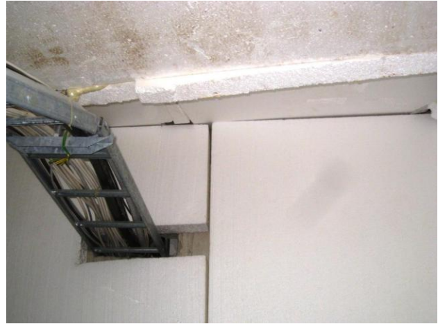
Kuva 42 Tiivistämätön sähkökaapelihyllyn läpivienti pohjakerroksen sähköpääkeskukseen.
