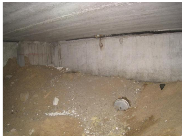
Kuva 2 Tuloilmaputki on osittain hiekan peitossa A-osalla.
