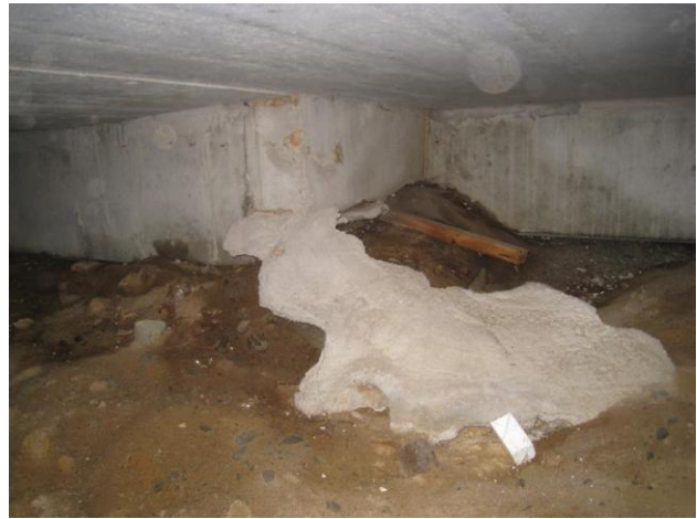
Kuva 10 Sokkelipalkkien vierustoilla maanpinta kosteaa ja pinnalla on mikrobikasvustoa. Vaalea möykky on betonia.
