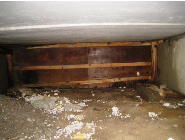
Kuva 16 Kosteus- ja mikrobivaurioitunutta muottivaneria D-osan päädyssä.
