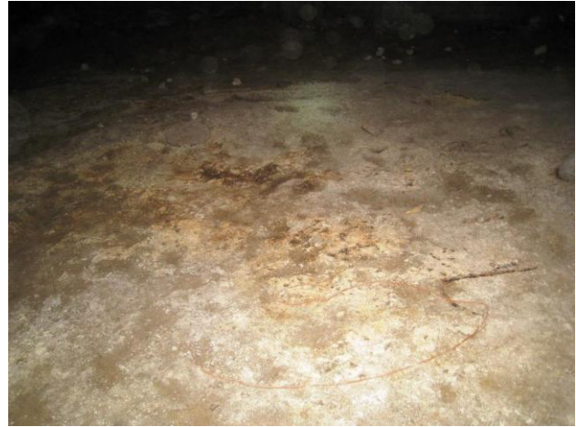
Kuva 32 E-osalla mikrobivaurioitunutta kovaa maata.
