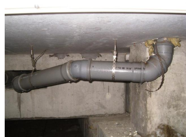
Kuva 23 Viemäriputkessa on vastakaato.
