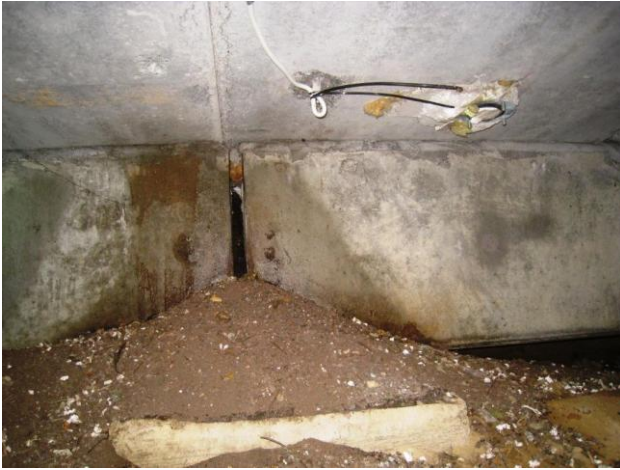
Kuva 24 Sokkelipalkkien väli on tiivistämättä.
