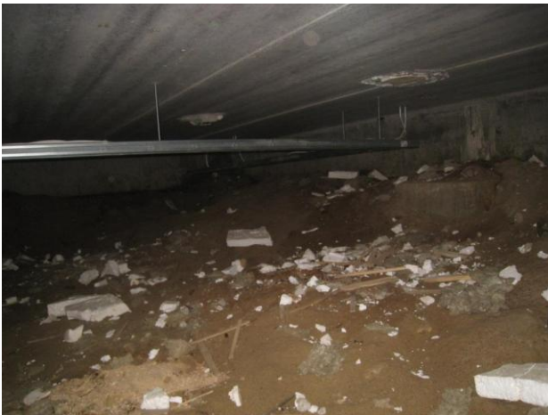
Kuva 13 Alustatilassa on runsaasti rakennusjätettä.
