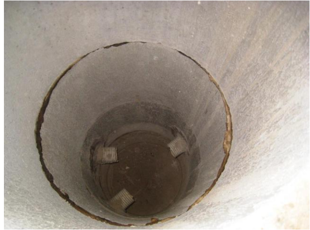
Kuva 12 Kuiva salaojaputkien tarkastuskaivo A-/B-osalla.
