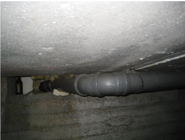
Kuva 43 Viemäriputkessa on vastakaato.
