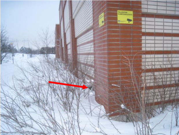
Kuva 35 E-osan kohdalla on ulkona osittain lumen peitossa oleva alustatilan ilma-putki.
