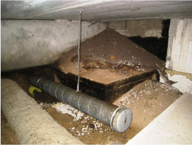
Kuva 3 Tuloilmakanava lähellä maanpintaa D-osan kulmassa. Mineraalivillaeristeen putki on vasemmassa reunassa.
