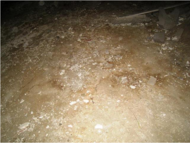
Kuva 31 C-osalla näyttämän alla mikrobivaurioitunutta maata.
