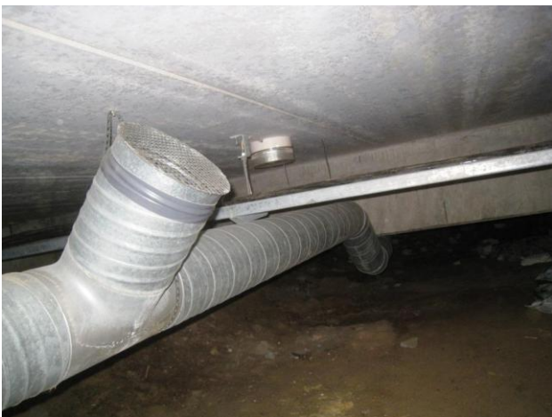
Kuva 1 D-osan poistoilmakanavaa. Kanavan ilmavirtaa voidaan säätää.
