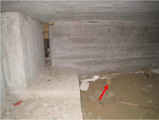
Kuva 14 D-osan porrashuoneen kohdalla on jäljellä valun aikaisia alasidepuita.
