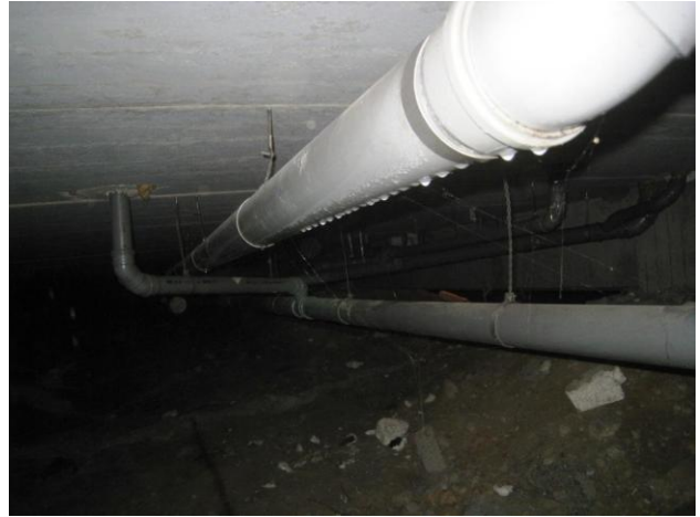
Kuva 19 Kattosadevesiviemäreiden alapinnoissa on vesipisaroita.
