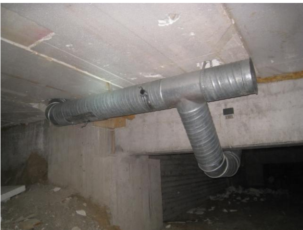
Kuva 33 Poistoilmakanavistoa C- ja E-osien rajalla. Kanavan ilmavirtaa voidaan säätää.
