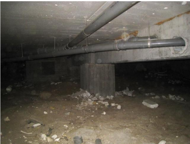
Kuva 36 Alustatilassa on rakennusjätettä.
