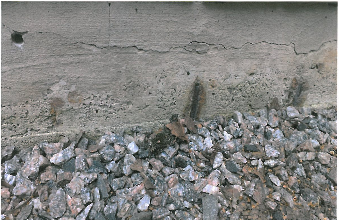
Kuva 18. Aivan pinnassa olevia teräksiä. Betoni on lisäksi pinnaltaan harvaa, mikä edistää kosteuden ja hiilidioksidin diffuusiota rakenteeseen.
