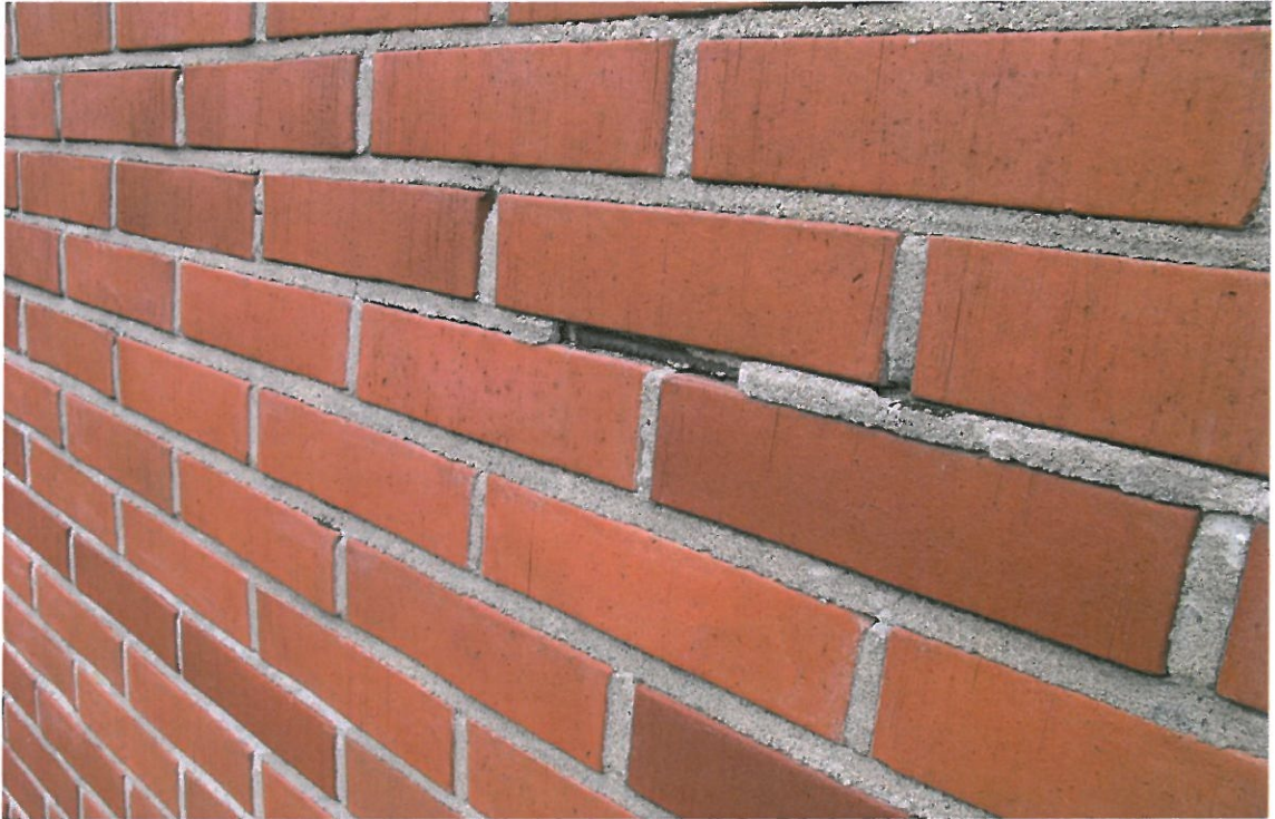
Kuva 5. Tiilikuoren saumateräkset ovat korroosiotilassa. Teräkset ovat tiilen paksuuteen nähden liian lähellä ulkopintaa ja saumalaasti todettiin tutkimuksissa jo läpikarbonatsoituneeksi.
