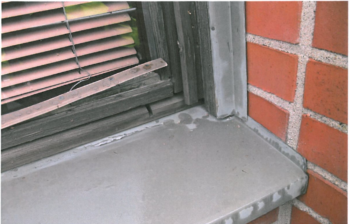
Kuva 11. Ikkunoiden vesipeltien kallistus on niukka ja eri pellitysosien liitosten kunto on heikko. Puuaines ikkunapuitteissa on kuitenkin kohtalaisen kovaa.
