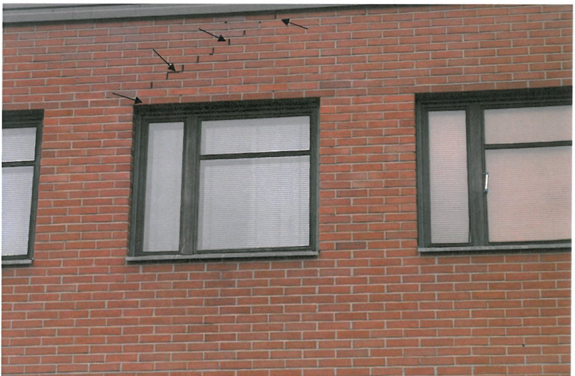
Kuva 2. Tiilikuoren halkeama rakennuksen kaakkoissivun keskiosalla. Halkeama alkaa ikkunan yläreunasta ja jatkuu läpi rakenteen aina räystäälle asti.
