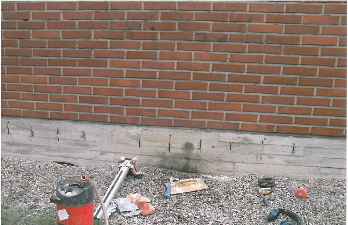
Kuva 15. Runsaasti näkyviä korroosiovaurioita rakennuksen pohjois-luoteispuoleisella seinustalla.
