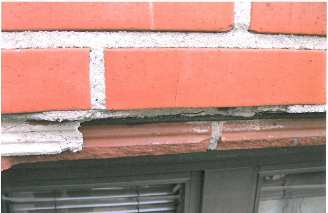
Kuva 8. Ikkunanylityspalkki. Tiilikourun puhtaudesta huomataan, että muurauslaasti ei ole koskaan täyttänyt teräksen alapuolista tilaa kokonaan.
