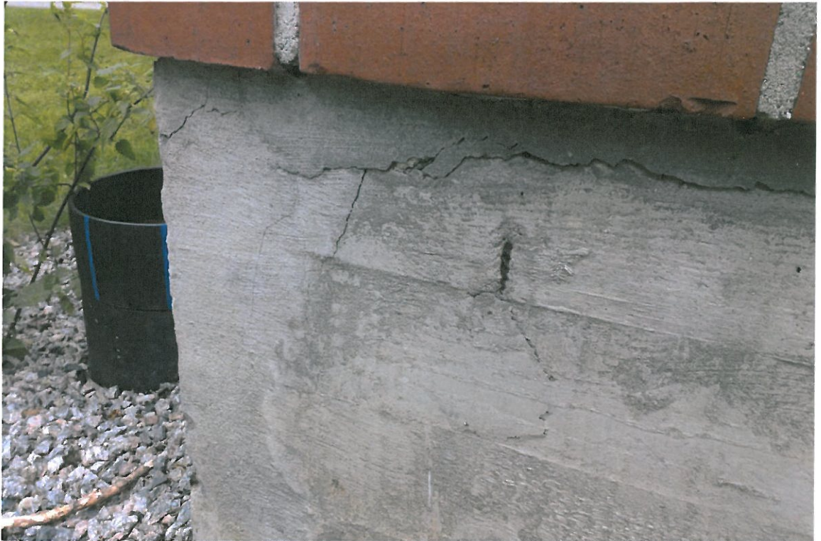
Kuva 17. Sokkelin yläreunassa kulkee halkeama muurauslaastin ja sokkelibetonin rajapinnassa lähes kaikkialla koko rakennuksen ympäri.
