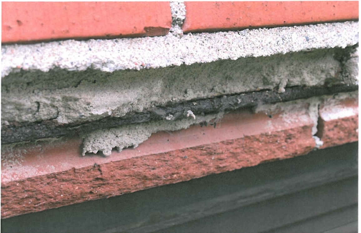
Kuva 9. Lähikuva ikkunanylityspalkin teräksen korroosiotilasta. Ruostekerros on jo melko paksu.
