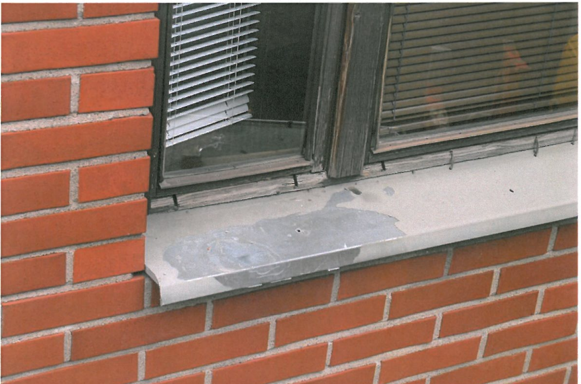
Kuva 12. Vesipellin pinnoite hilseilee, ikkunan alapuite on hyvin ravistunut ja maaliton, mutta puuaines kuitenkin kohtalaisen kovaa.
