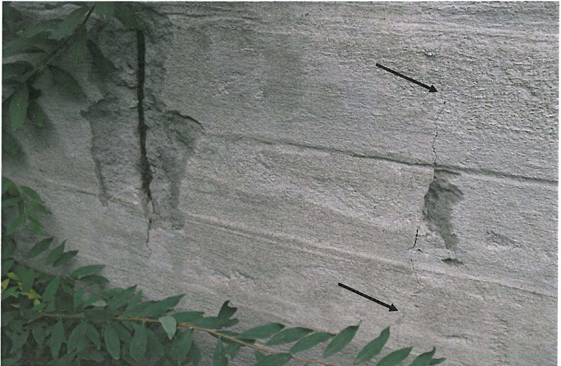
Kuva 14. Korroosiovaurioita sokkelissa. Näkyvän vaurion viereinen halkeama (nuolet) on teräksen päällä.
