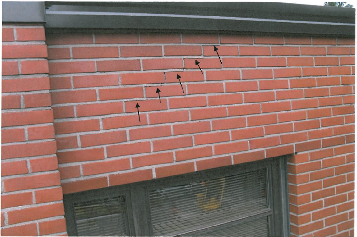
Kuva 1. Tiilikuoren halkeama rakennuksen kaakkoissivulla (lähellä pohjoispäätä).
