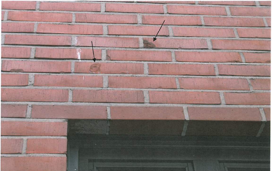
Kuva 7. Tiilipinnoissa on satunnaisia, yksittäisiä pieniä pintarapautumia.
