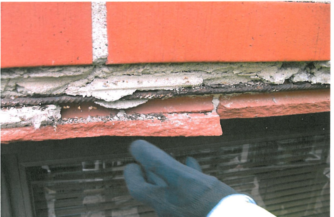
Kuva 10. Ikkunanylityspalkki. Myöskään tässä kohtaa ei laasti ole täyttänyt tiilen uraa täysin, jolloin palkkiteräs on ruostunut.
