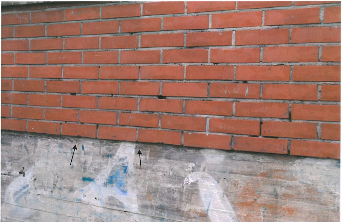
Kuva 3. Rakennuksen kaakkoissivun julkisivupintaa. Tiilisaumat ovat vajaita ja murentuneita, sokkelin yläreunassa on pitkä halkeama.
