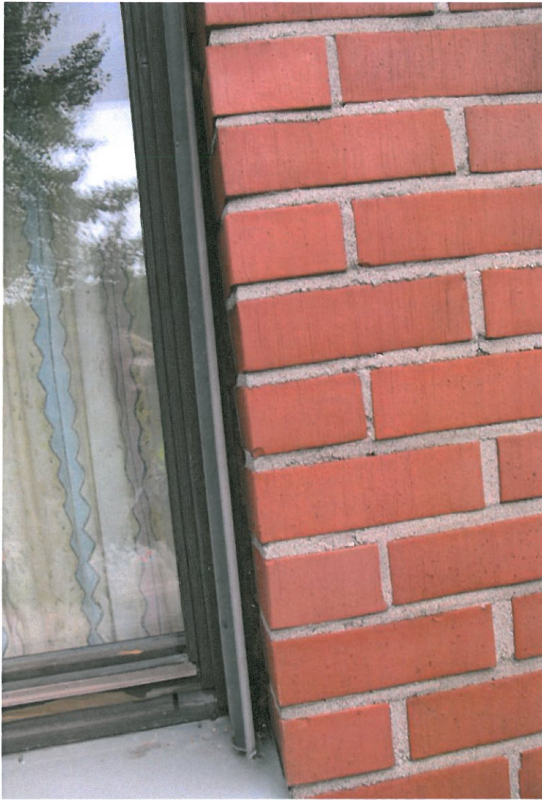
Kuva 13. Suojapelti on irti ja vesi tai lumi pääsee esteettä ikkunan ja tiilen väliseen saumaan.
