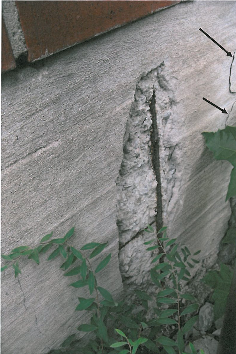
Kuva 16. Eteläsivun korroosiovaurioita sokkelissa pensaiden takana. Nuolen osoittamassa kohdassa on jo seuraava vauriokohta.
