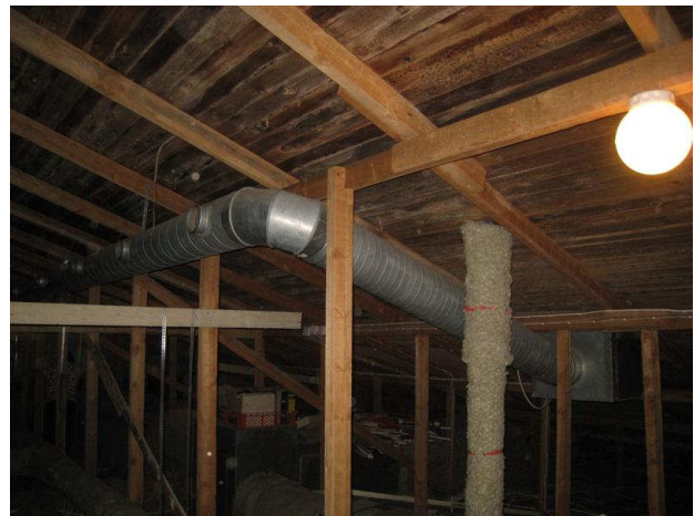
Kuva 20 Yläpohjaontelon poistokanava on vedetty vinosti alas poistopuhaltimelle.
