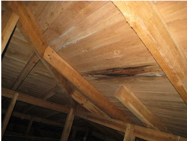
Kuva 17 Yksittäinen vuotokohta salilaajennuksen yläpuolella.
