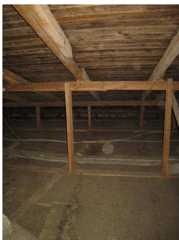
Kuva 21 Tippuvesijälkiä villojen päällä sauna-päädyssä aula H10/ pukuh H14.
