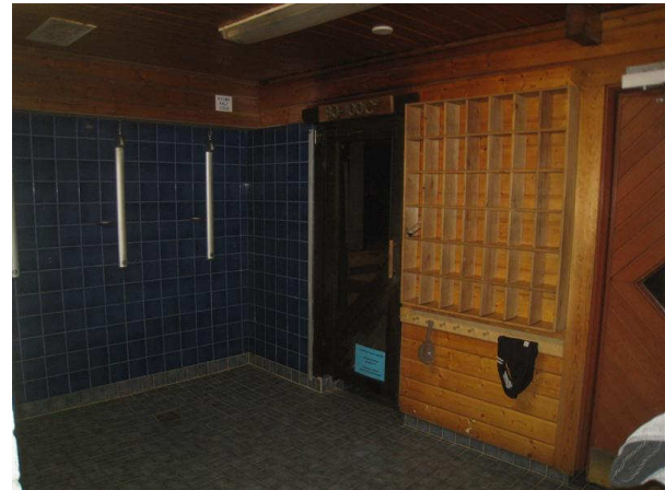
Kuva 4 Jossain vaiheessa kunnostettu pesu- huone.
