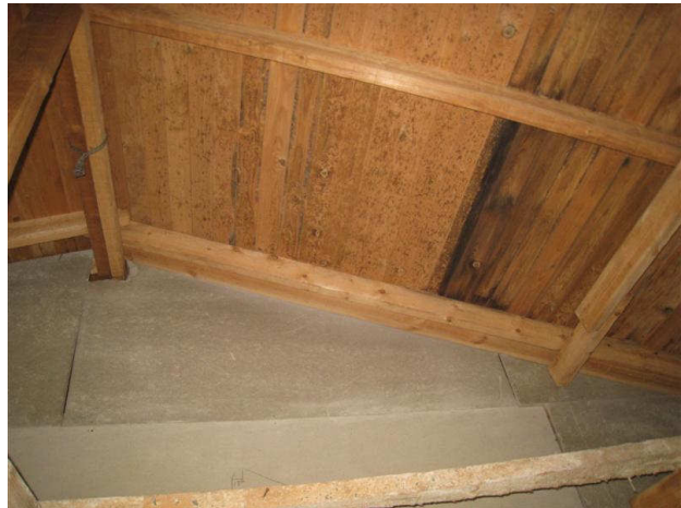
Kuva 18 Yksittäinen vuotokohta palokatkon rajalla sos.tila H31 yläpuolella
