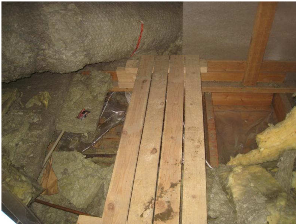
Kuva 7 Vastaanottotilan H7 putkikorjauskoh- ta, yläpohjan eristeet olivat asenta- matta.
