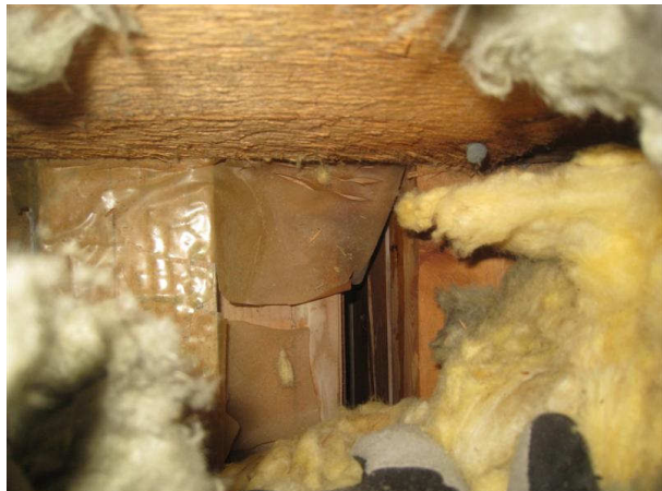
Kuva 26 Valmiiksi rikkinäinen höyrysulkumuovi saunan H25 kohdalla, josta tuli kuumaa ilmaa. Alla voi olla kotelo. Suoraan alla on seinäpanelointia. Höyrysulun alla on ilmarako.
