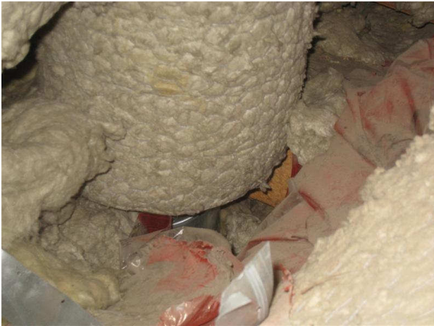
Kuva 11 Epätiivis IV-läpivienti ja huono lämpöeristys.
