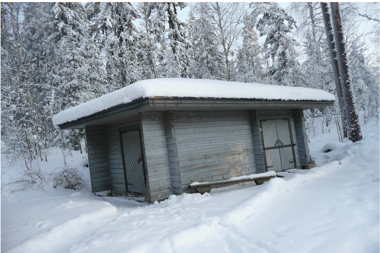
RAK-kuva 4. Rakennusten ulkoseinät ovat kuluneet.
