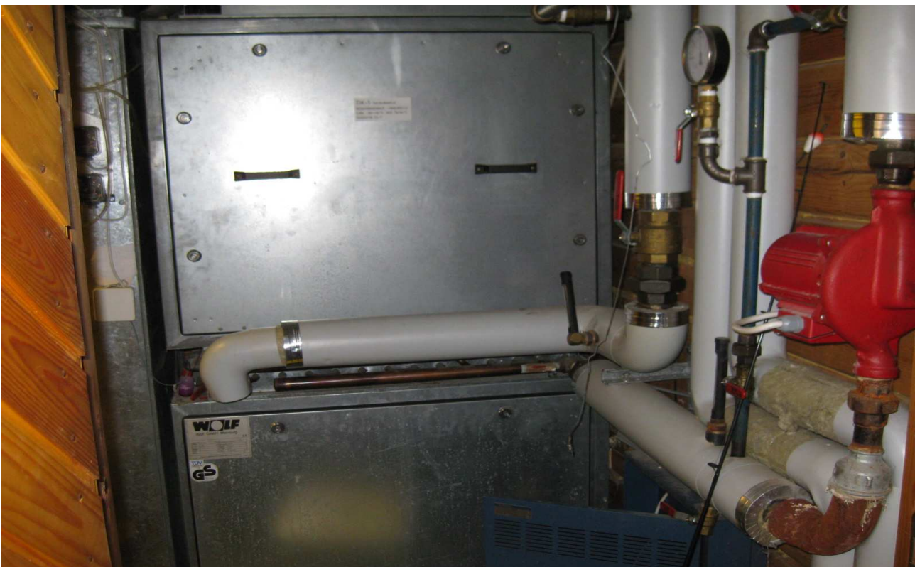
LVI-kuva 15. Yleiskuva IV- koneesta.
