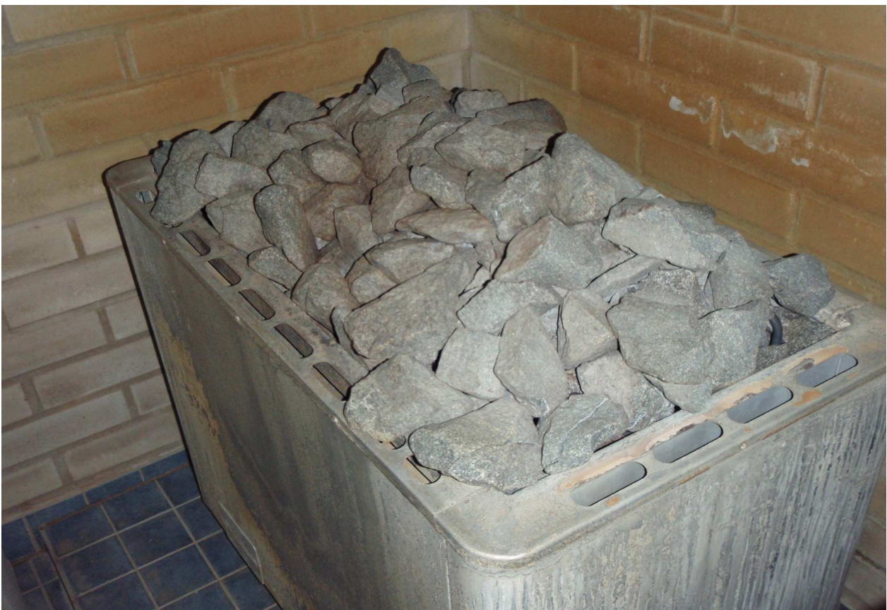
S-kuva 19. Päärakennuksen saunan kiuas.
