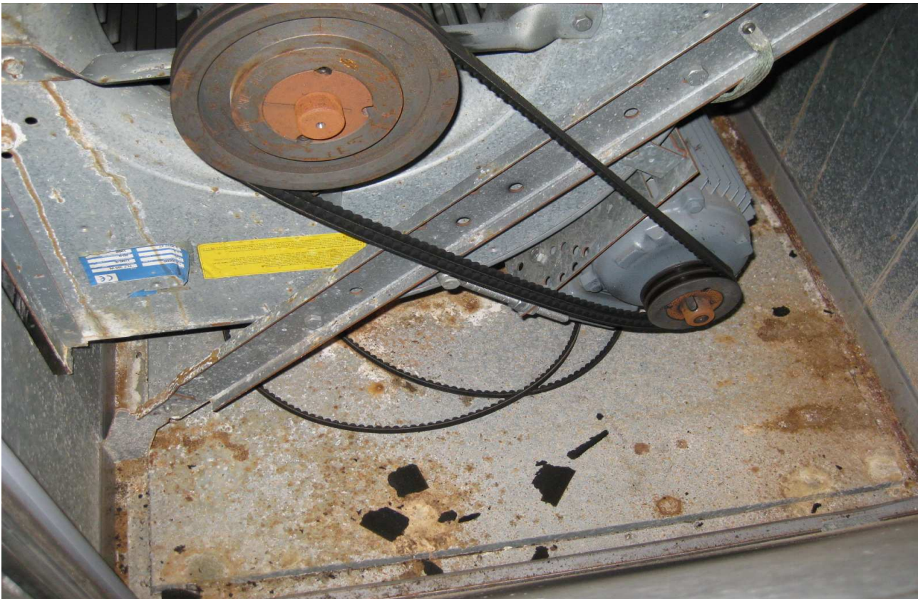
LVI-kuva 18. Yleiskuva tuloilmakoneesta.
