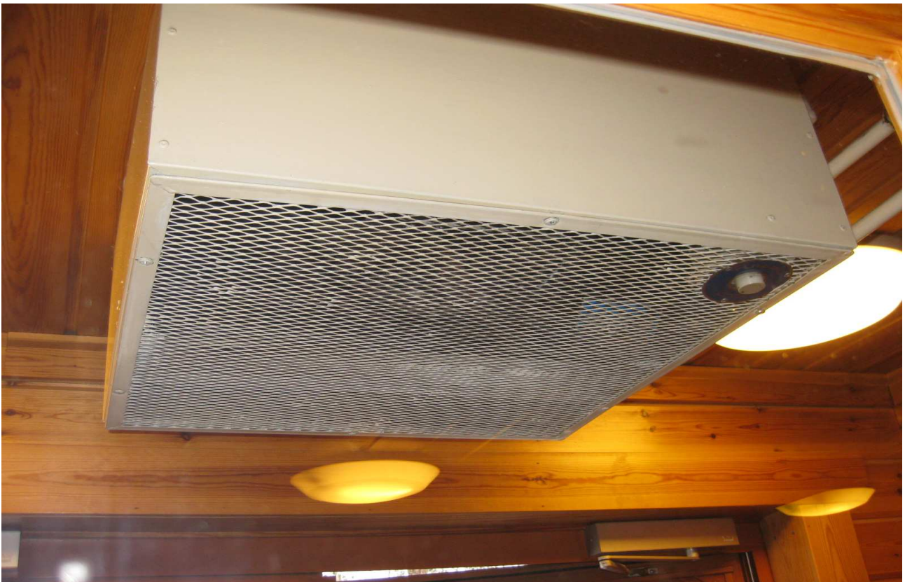
LVI-kuva 13. Yleiskuva päärakennuksen tuulikaapin kiertoilmapuhaltimesta.
