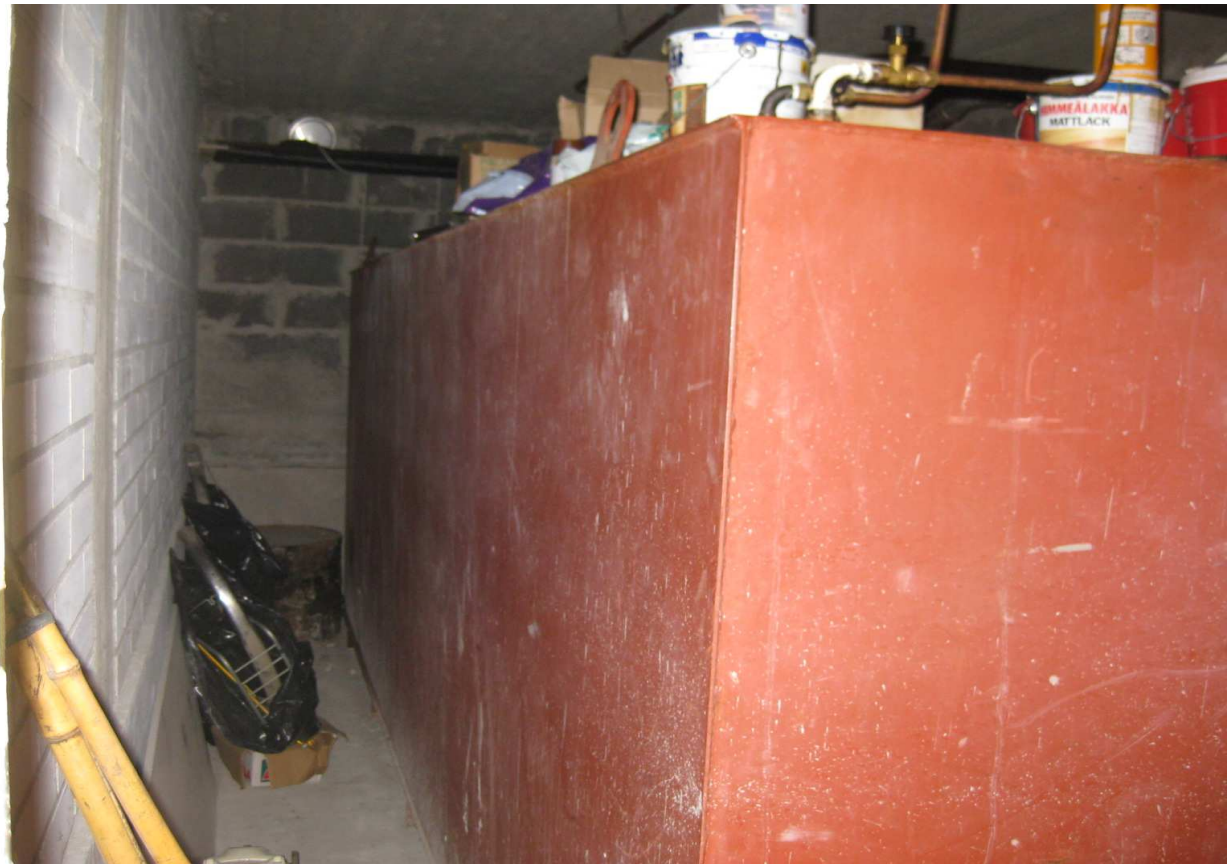
LVI-kuva 3. Yleiskuva öljysäiliöstä.
