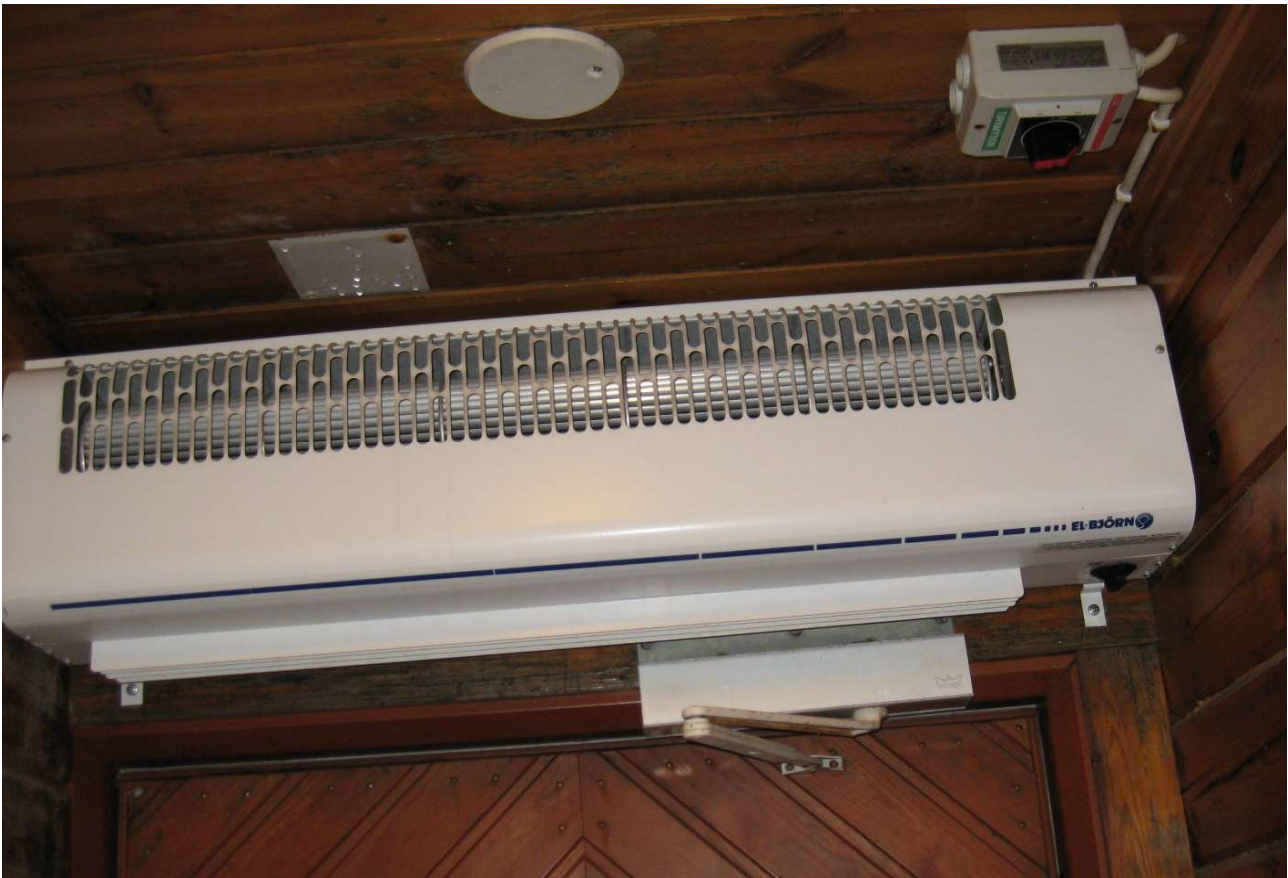
LVI-kuva 14. Yleiskuva saunan eteisen oviverhopuhaltimesta.
