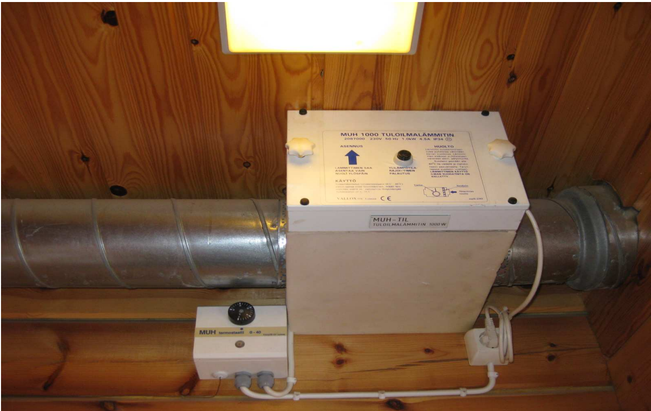
LVI-kuva 16. Yleiskuva pukuhuoneiden tuloilmalämmittimestä.
