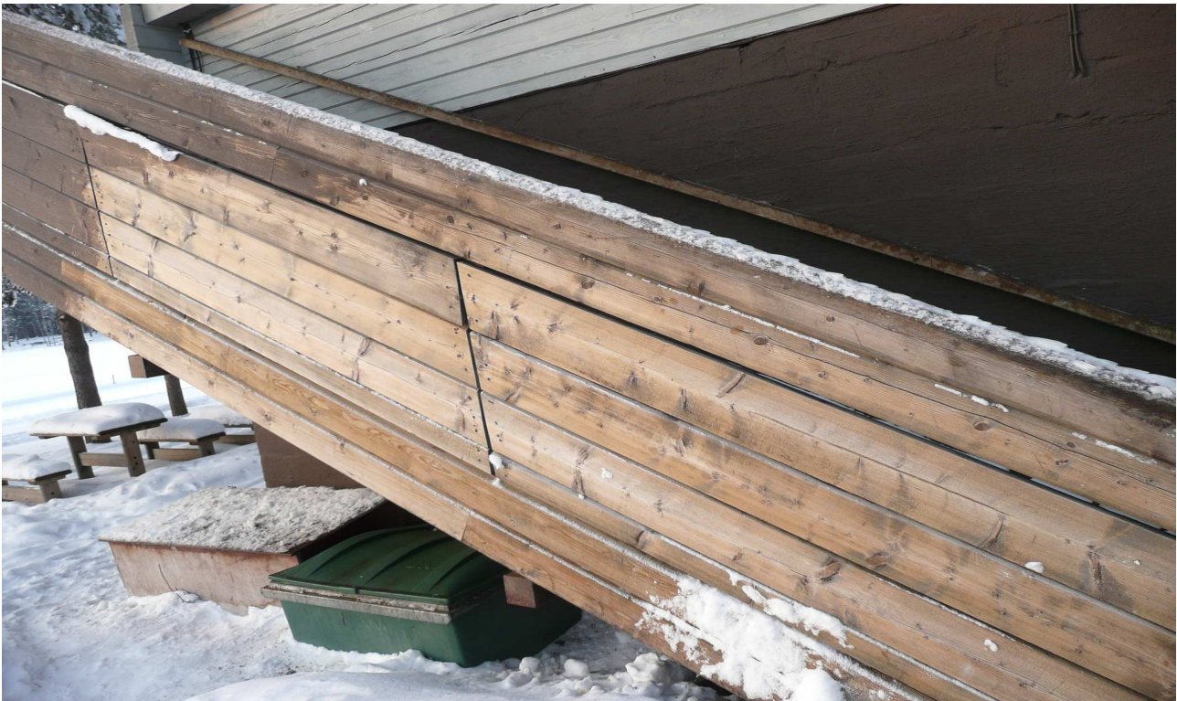
RAK-kuva 3. Kaiteen puuosissa esiintyy pinnan kulumia.
