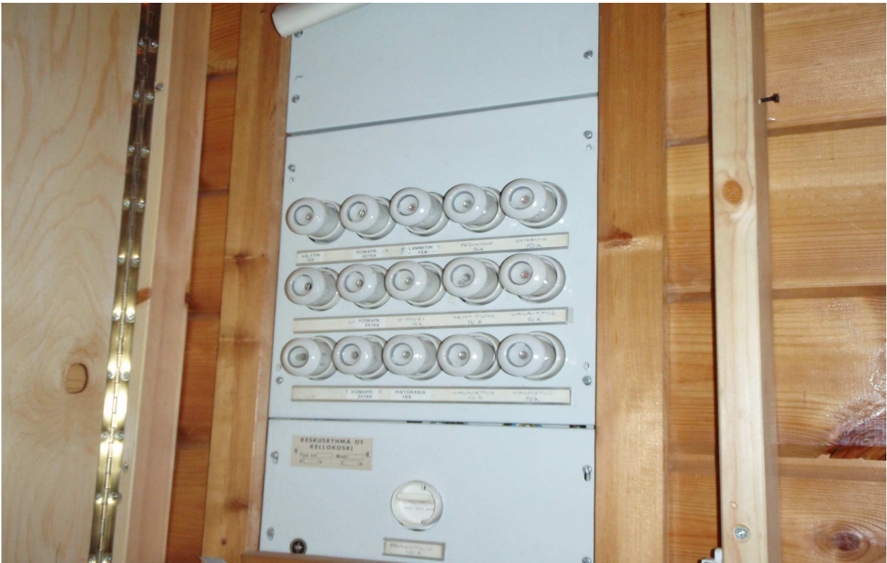
S-kuva 6. Kokoustalon sähkökeskus.
