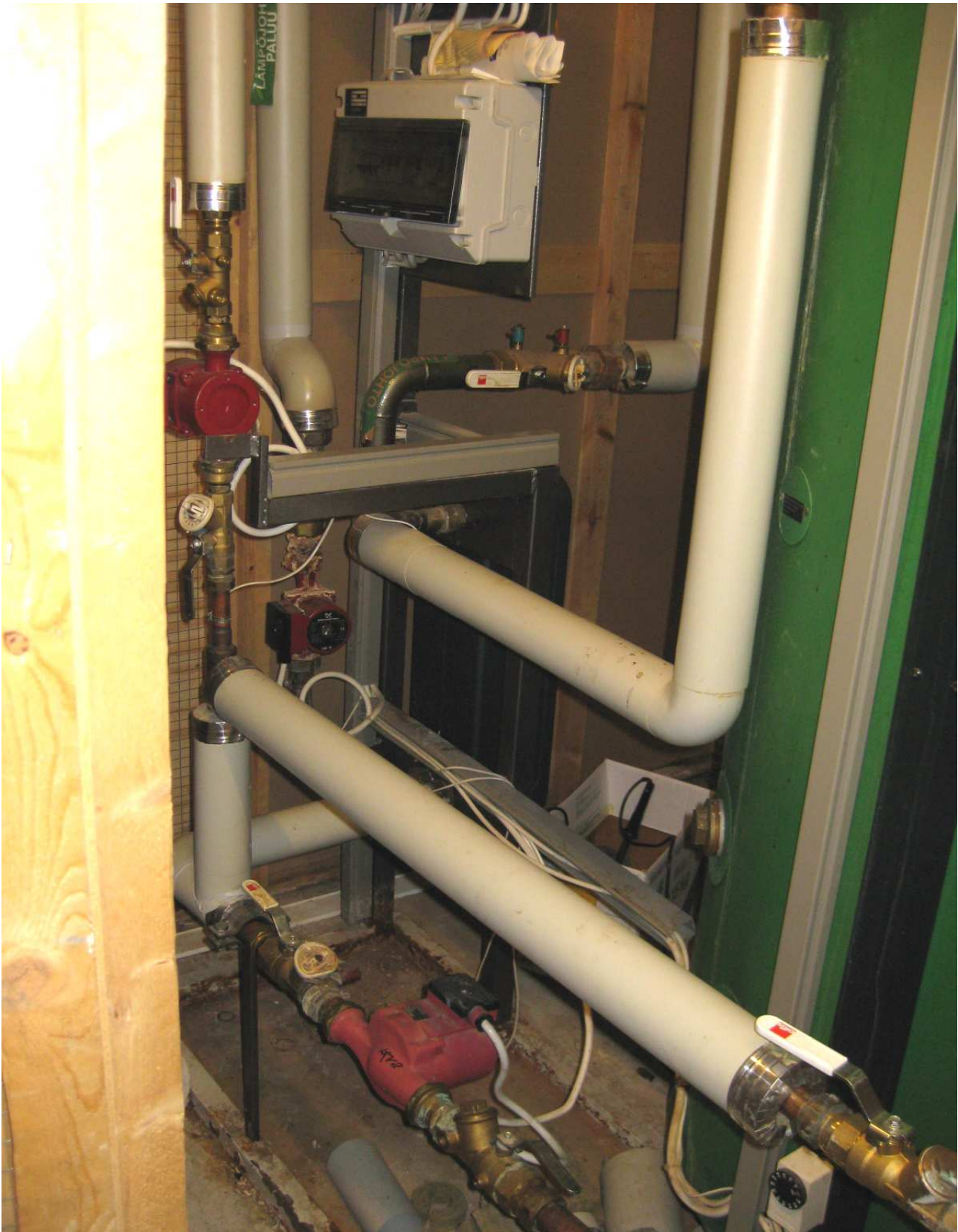
LVI-kuva 7. Yleiskuva käyttöveden lämmönsiirtimestä.
