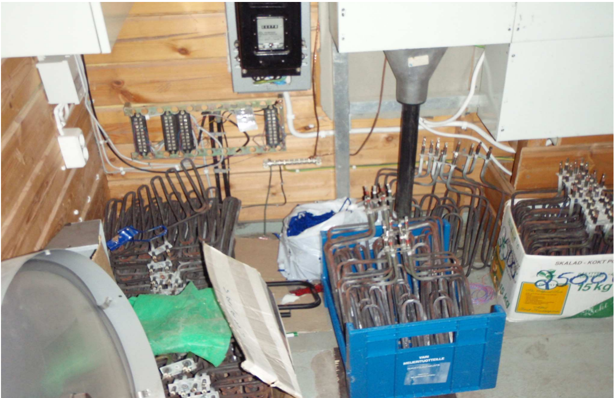
S-kuva 4. Pääkeskustilaan on varastoitu ylimääräistä tavaraa.
