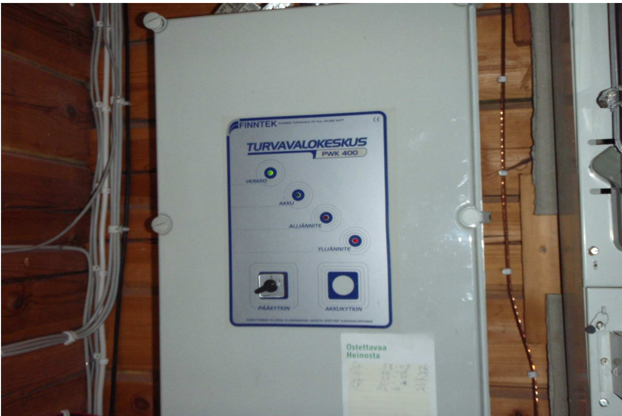
S-kuva 23. Turva ja ovimerkkivalaistusjärjestelmän keskus.
