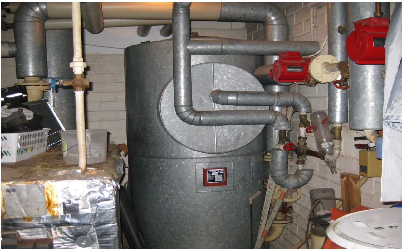
LVI-kuva 2. Yleiskuva varaajasäiliöstä.
