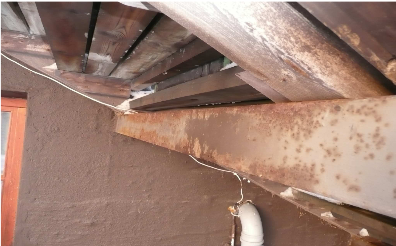
RAK-kuva 2. Kantavissa metalliosissa on ruosteen aiheuttamia vaurioita.
