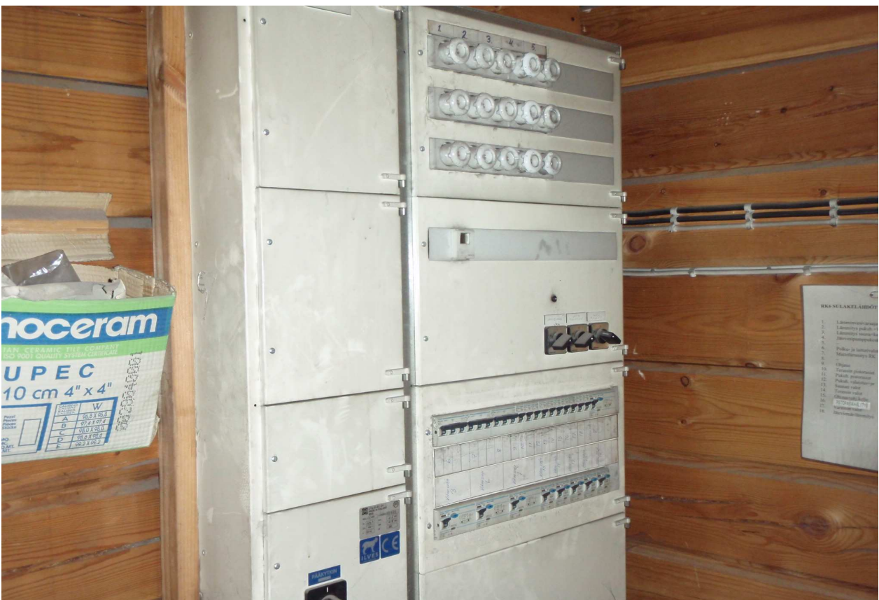
S-kuva 7. Savusaunarakennuksen sähkökeskus.
