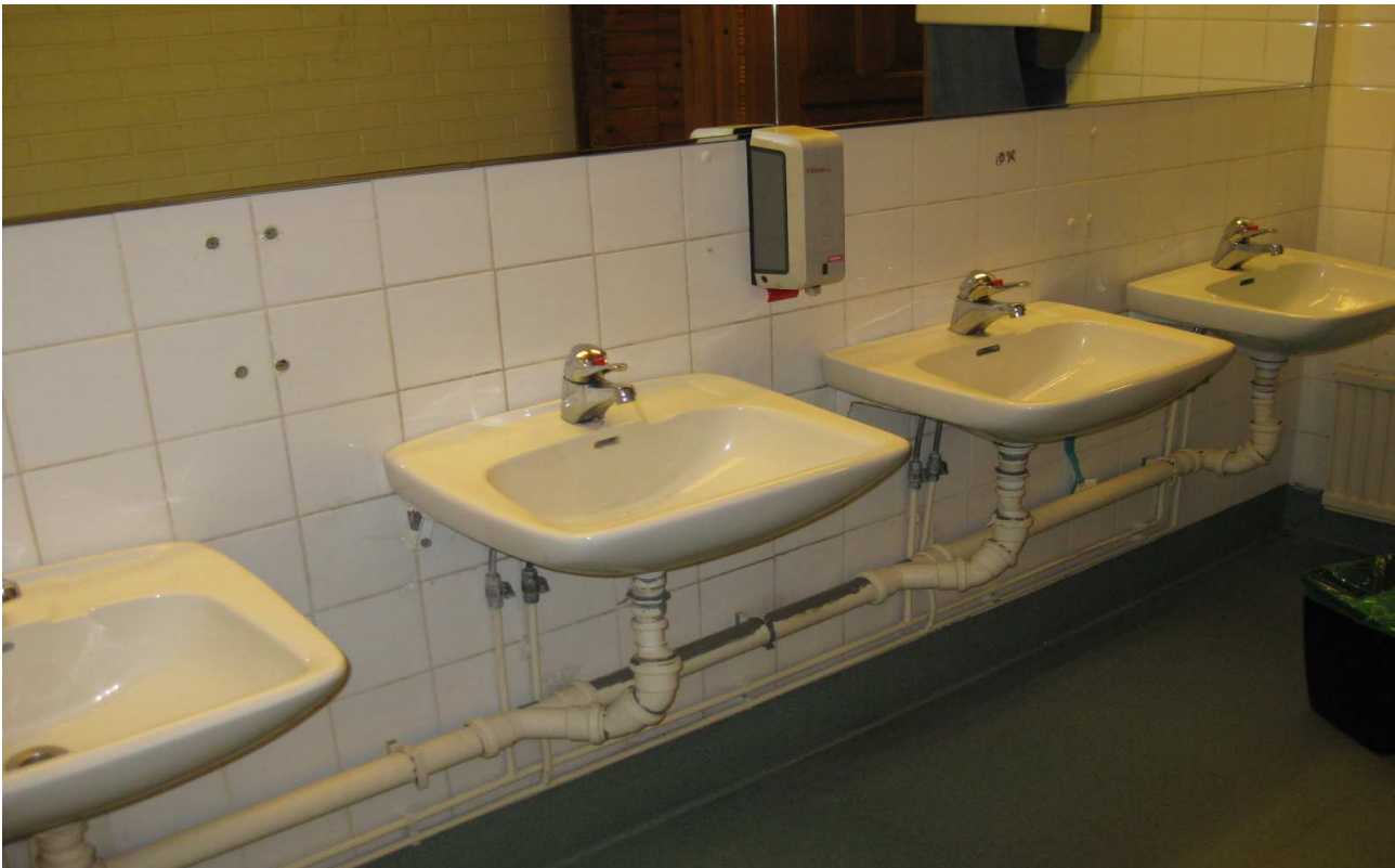
LVI-kuva 9. Yleiskuva vesikalusteista.
