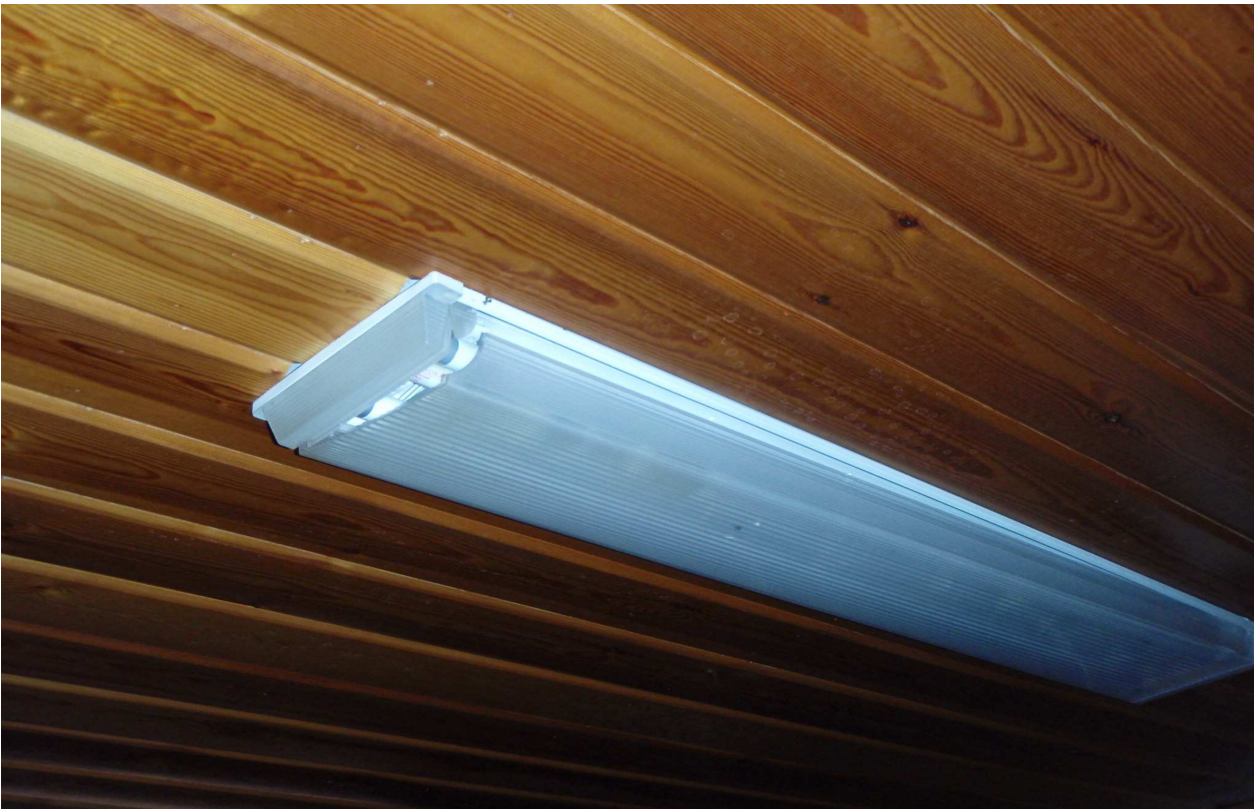
S-kuva 14. Saunaosaston pesuhuoneen valaistus, valaisimen kupu on rikki.
