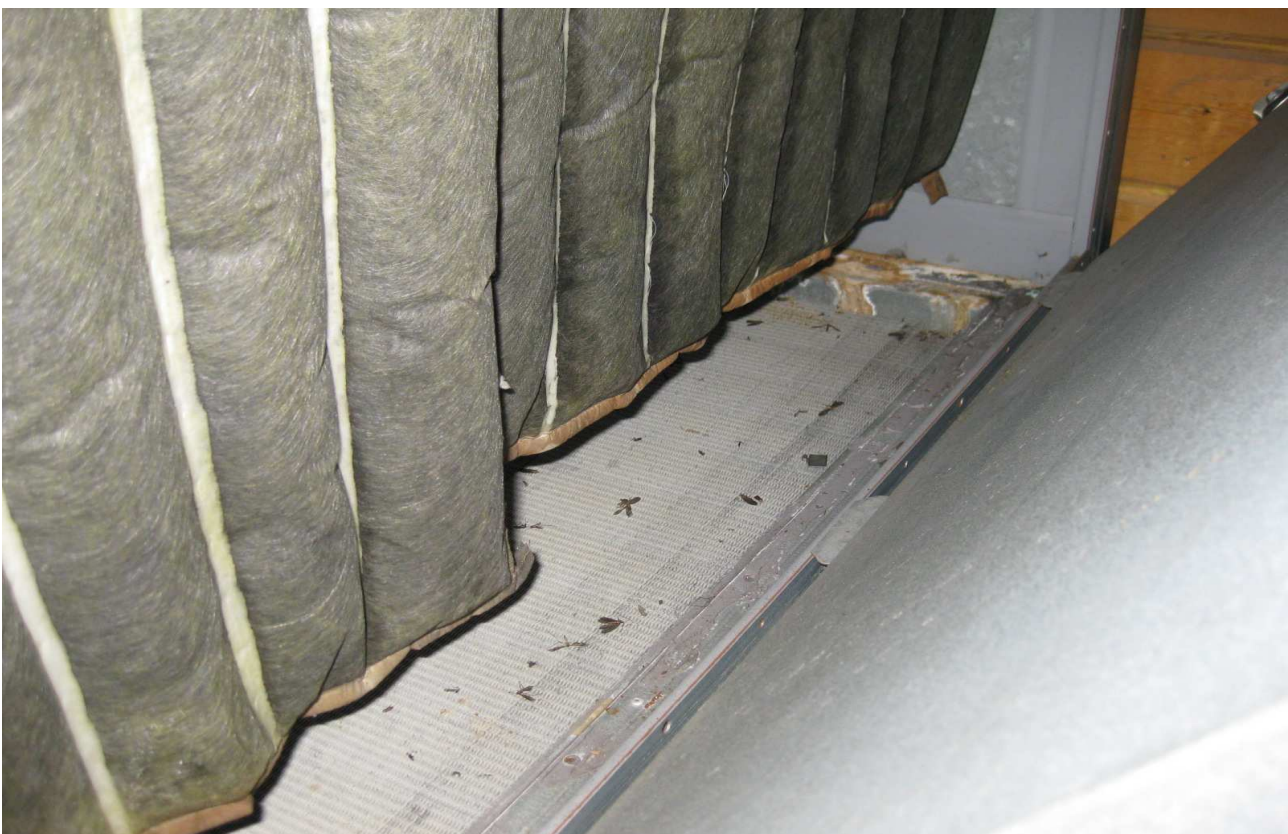
LVI-kuva 19. Yleiskuva tuloilmakoneen sisältä.
