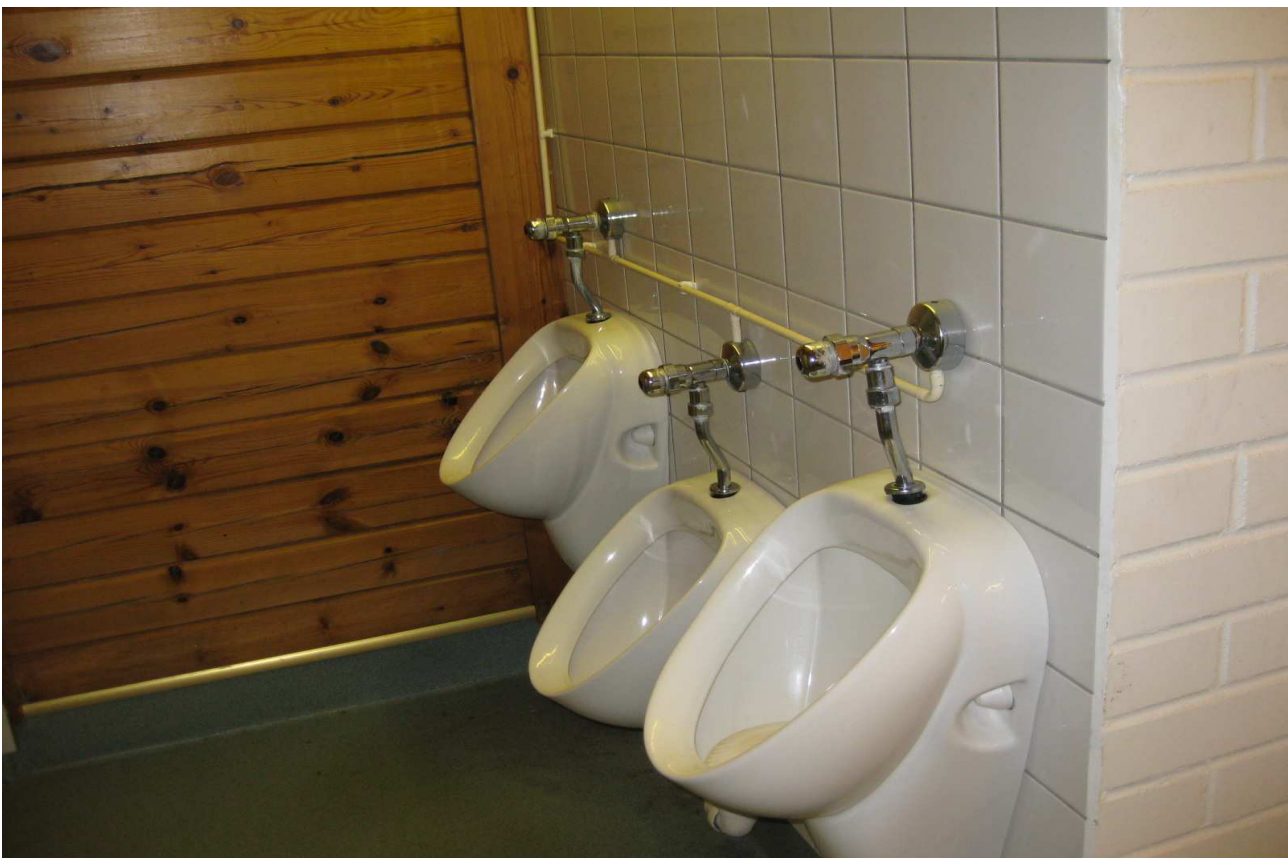
LVI-kuva 10. Yleiskuva vesikalusteista.
