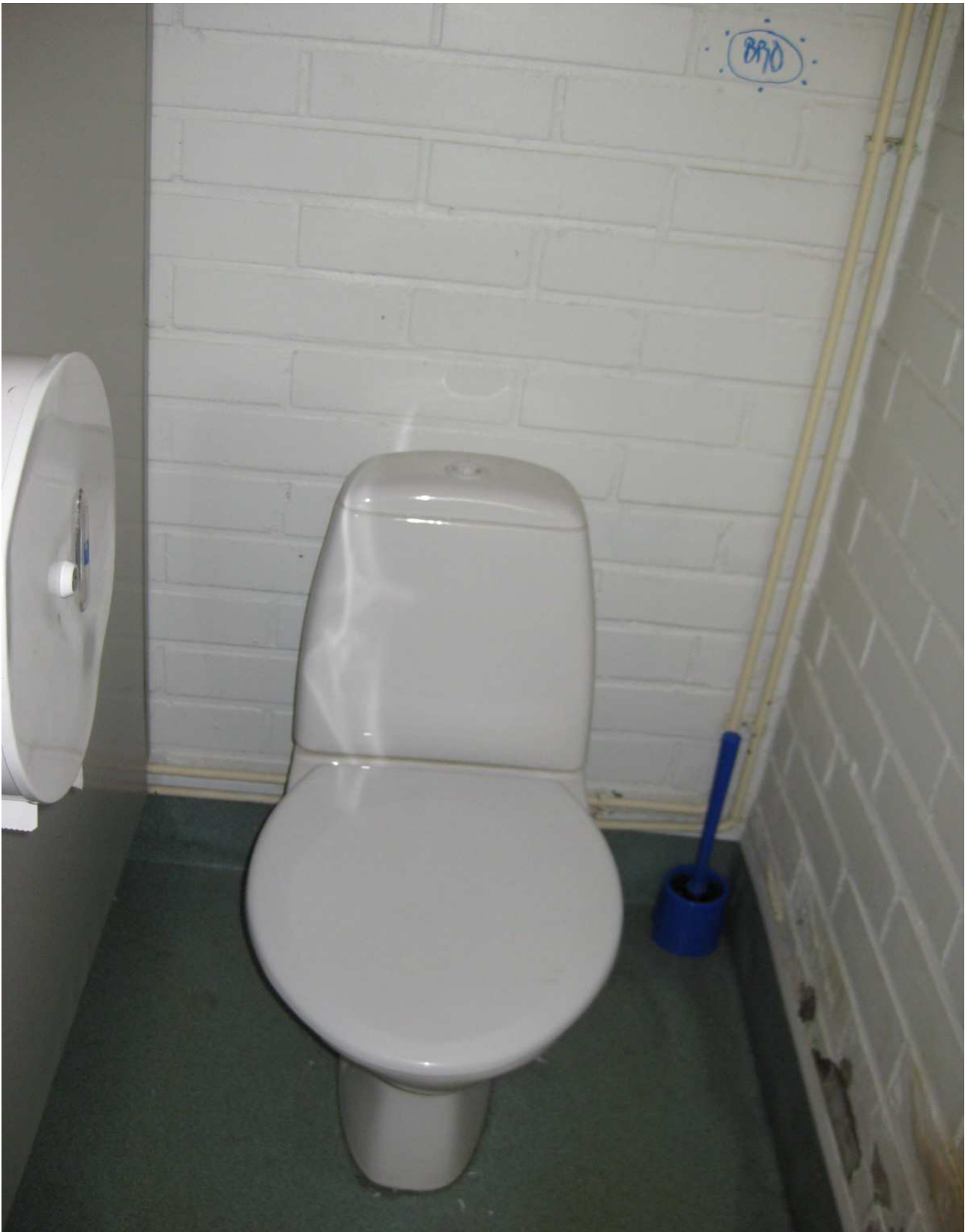
LVI-kuva 11. Yleiskuva vesikalusteista.
