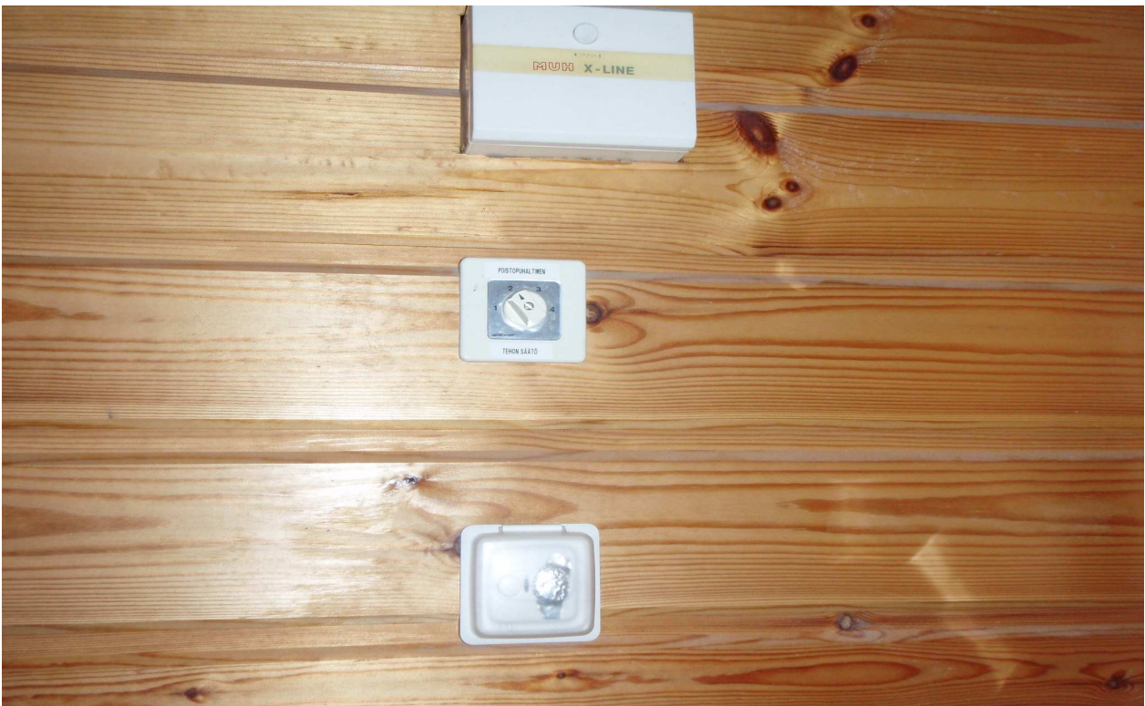
S-kuva 21. Lattialämmitystermostaatti ja IV- ohjaukset.
