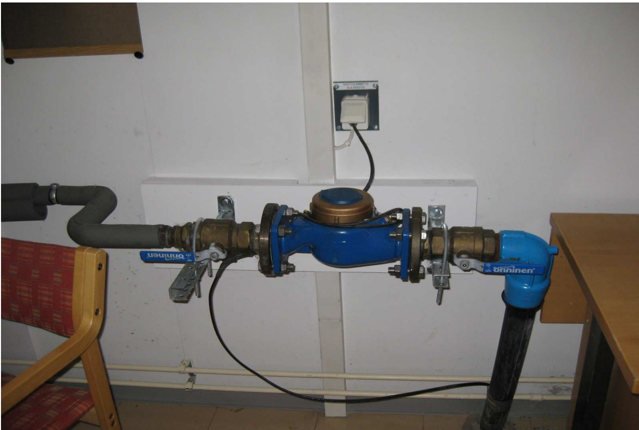
LVI-kuva 6. Yleiskuva vesimittarista ja pääsuluista.
