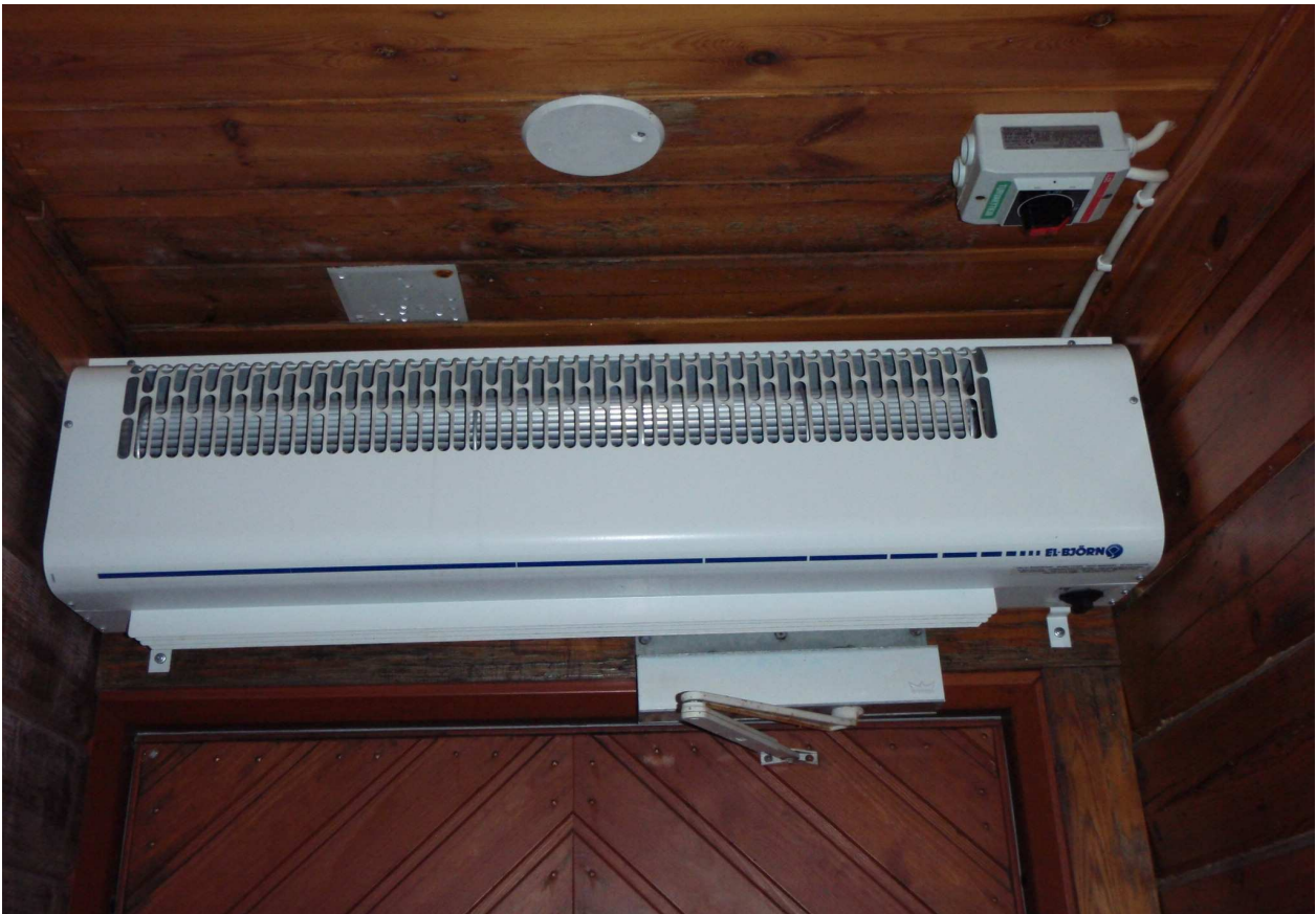
S-kuva 20. Päärakennuksen saunaosaston oviverhopuhallin.
