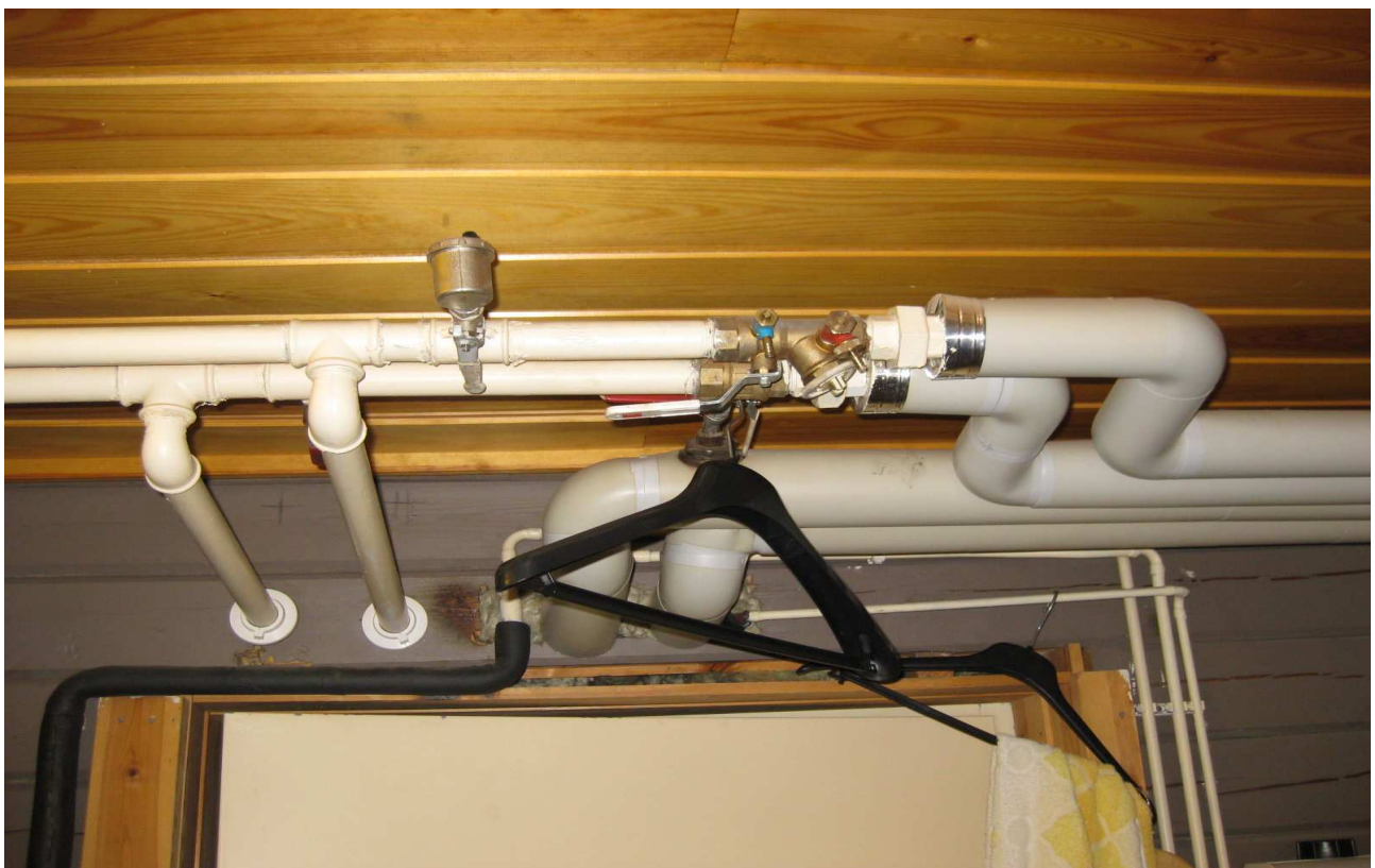
LVI-kuva 4. Yleiskuva lämpöjohtoverkoston venttiileistä.
