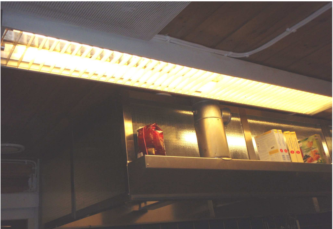
S-kuva 17. Keittiön valaistus.
