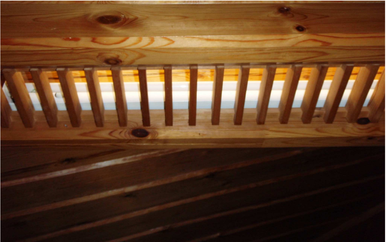
S-kuva 12. Kahvion loistelamppuvalaistus kotelossa.
