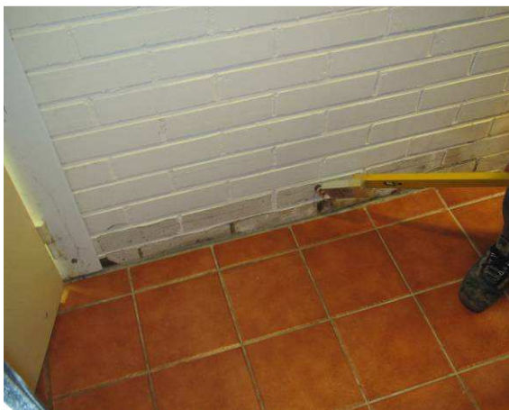
Tiskaustilan vastaisen seinän alareunassa kosteutta (maalipinnoitteet on jo poistettu)
