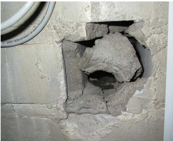
Käytöstä poistettu, tiivistämätön läpivienti lämmönjakohuoneessa
