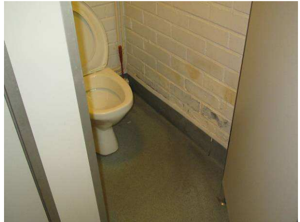
Suihkuvedet tulevat seinän läpi (wc-tila H18)
