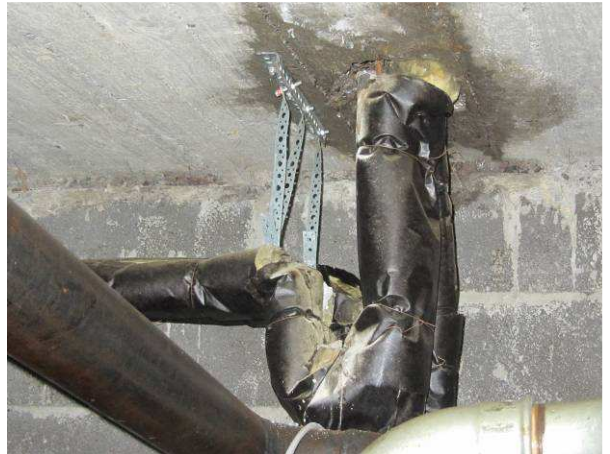
Polttoainetilan katossa havaittiin putkivuoto
