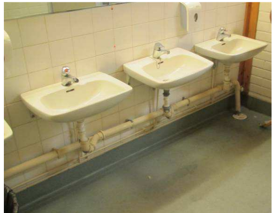
Kohonneita kosteuspitoisuuksia havaittiin niinkään wc-tiloissa H18 ja H19
