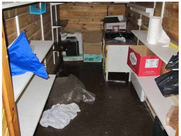
Asuinrakennuksen etuvaraston lattiassa havaittiin kohonnutta kosteutta
