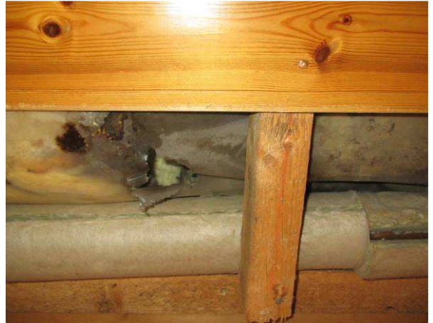
Kuvaa mahdollisesta putkivuotokohdasta
