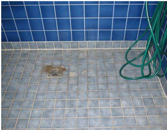
Pesuhuoneiden pinnoilla havaittiin yleisesti kohonneita kosteuspitoisuuksia (H27)
