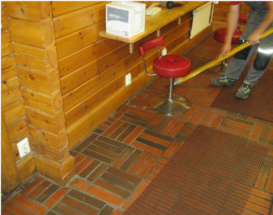
Kohonneita kosteuspitoisuuksia naisten pukuhuoneen luoteisnurkassa (H14)
