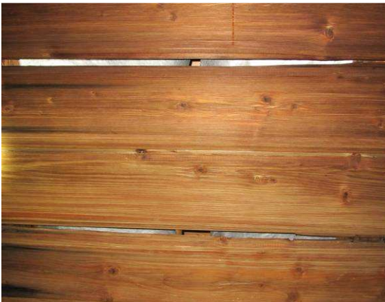
Saunan paneelien alla oleva höyrynsulku ei ole tiivis, sauna H20
