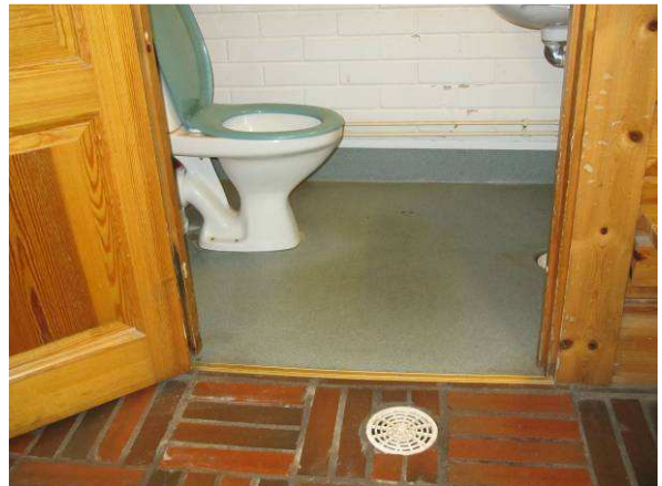
Naisten wc- tilan lattiassa ja kaivon ympärillä havaittiin kohonneita kosteuspitoisuuksia (H16)
