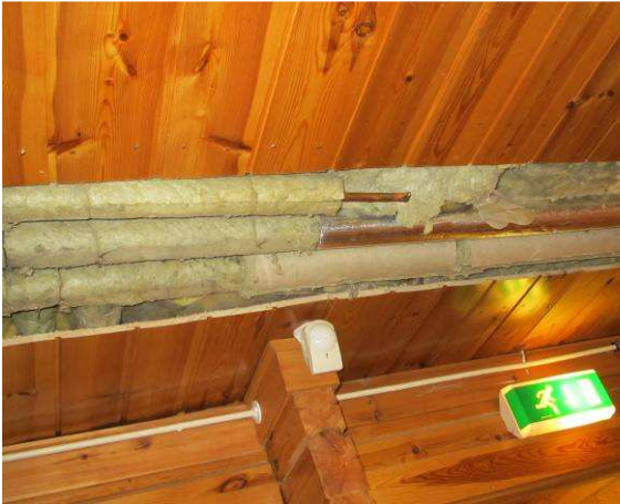
Eteistilan kattoa on avattu putkivuodon takia
