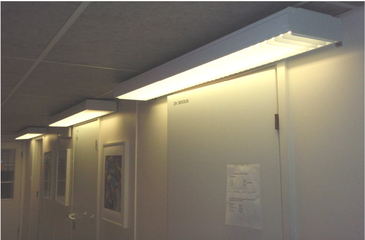
S-kuva 6. Käytävän valaistus.
