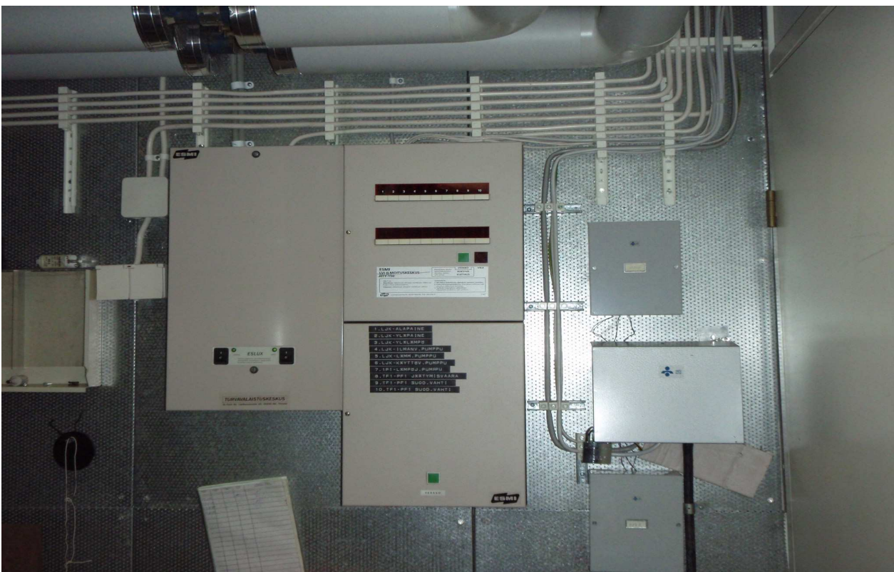
S-kuva 13. Turvavalaisituksen keskus ja LVI- hälytyskeskus.
