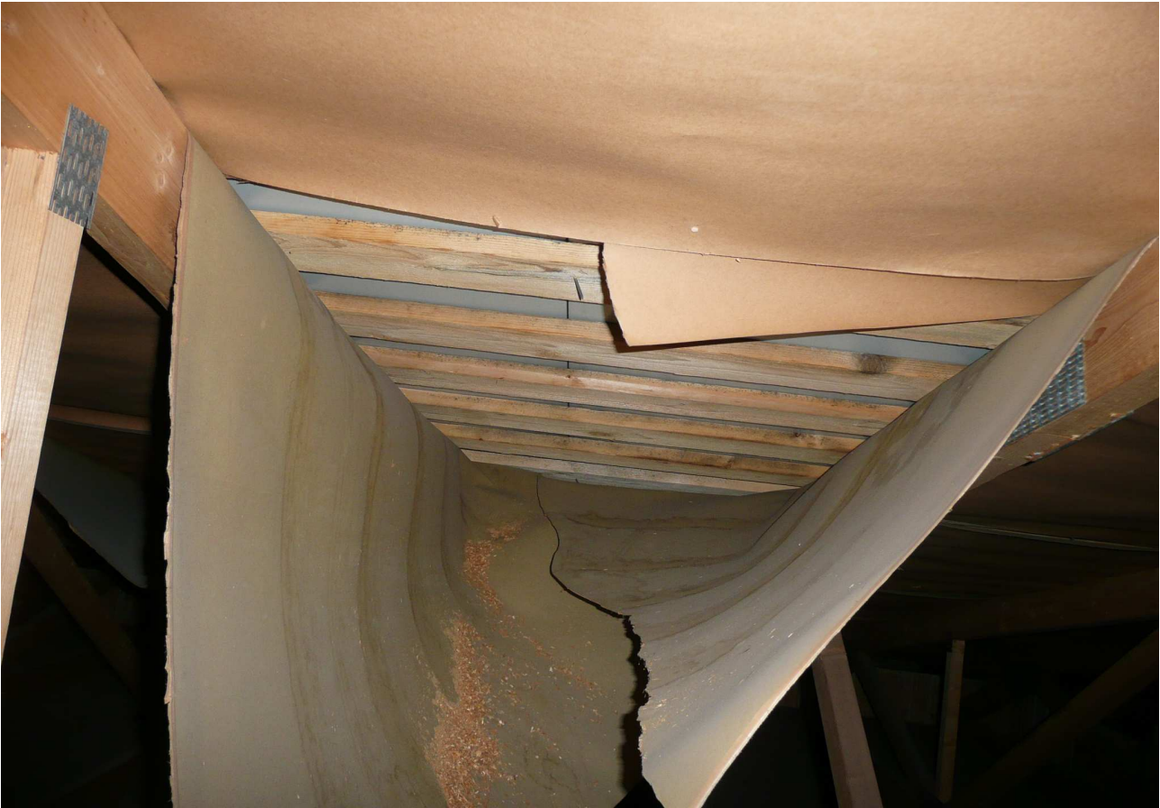
RAK- kuva 7. Yläpohjatilassa aluskate on paikoitellen repeytynyt.
