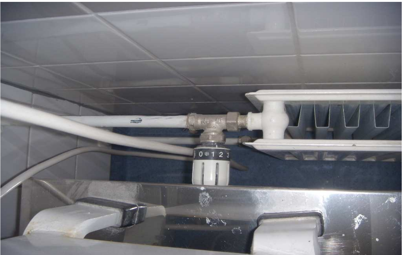
LVI-kuva 3. Yleiskuva patteriventtiilistä.
