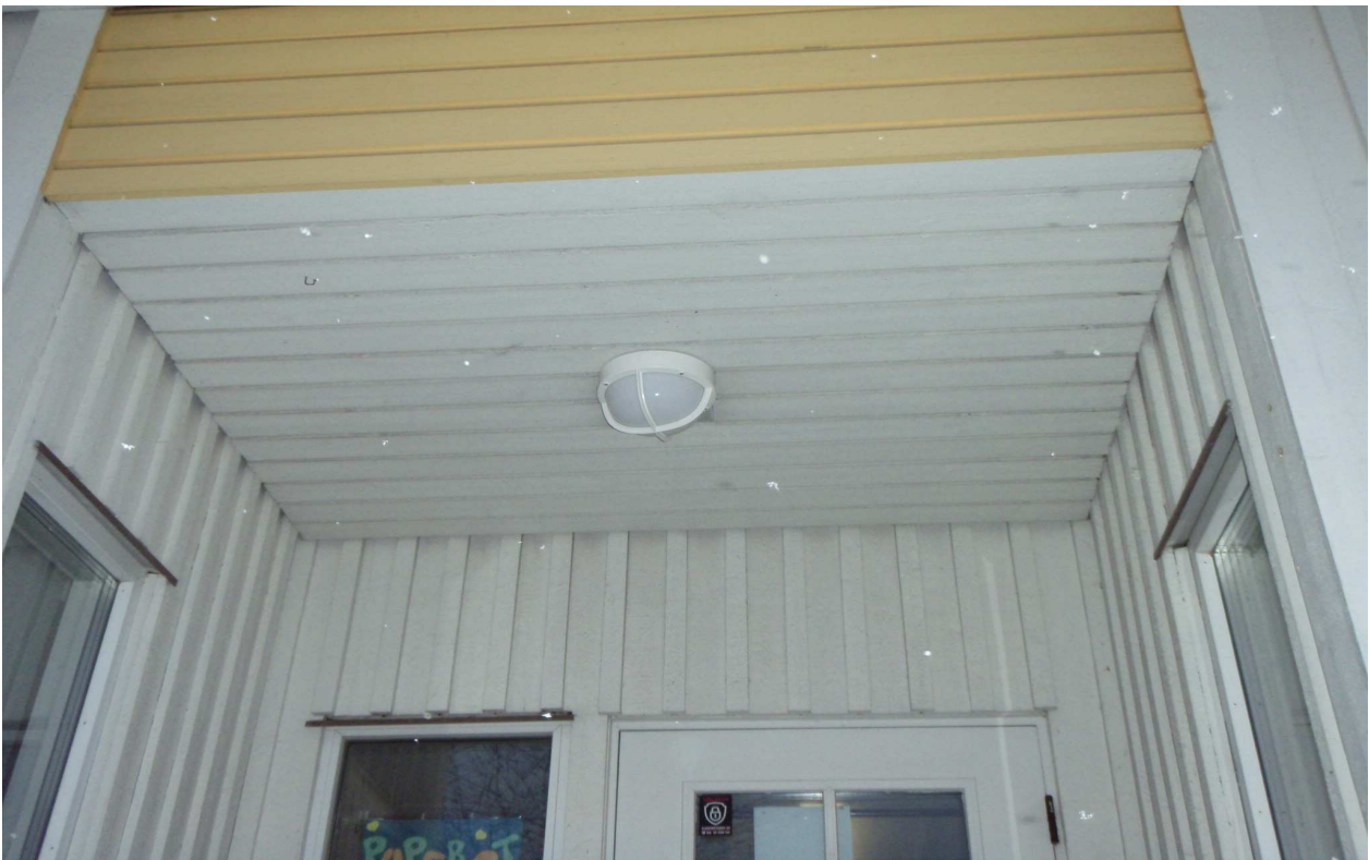
S-kuva1. Sisäänkäynnin valaistus.
