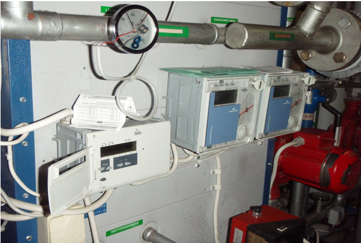
S-kuva 14. Lämmönjaon yksikkösäätimet.
