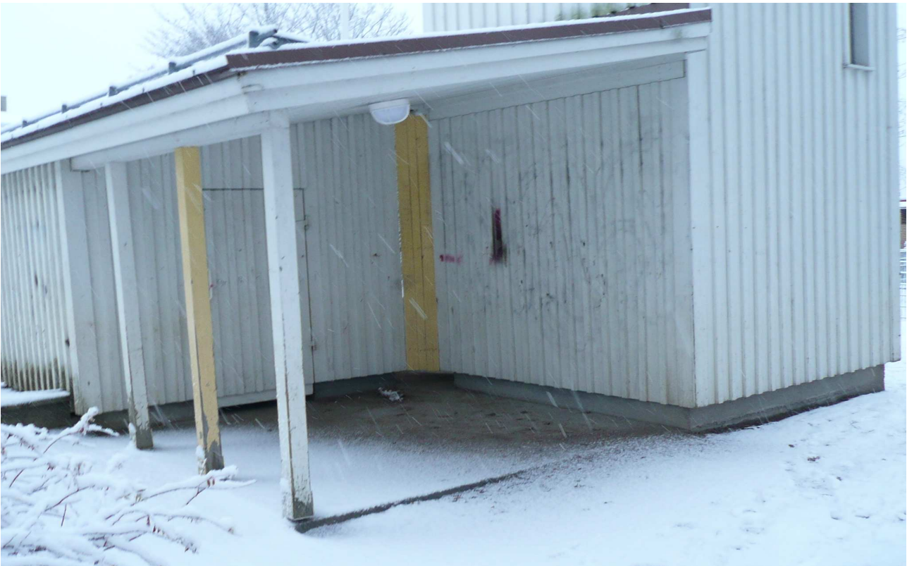
RAK- kuva 3. Maalattun varaston julkisivussa esiintyy väri vaihteluja ja pinnan tummumista sekä maalipinnan kulumia.
