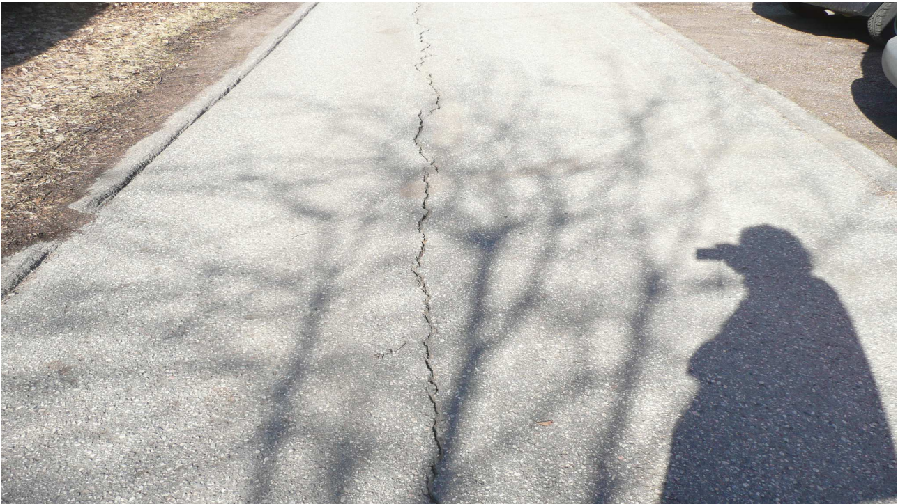
RAK- kuva 1. Asfaltissa esiintyy paikoitellen halkeamia.
