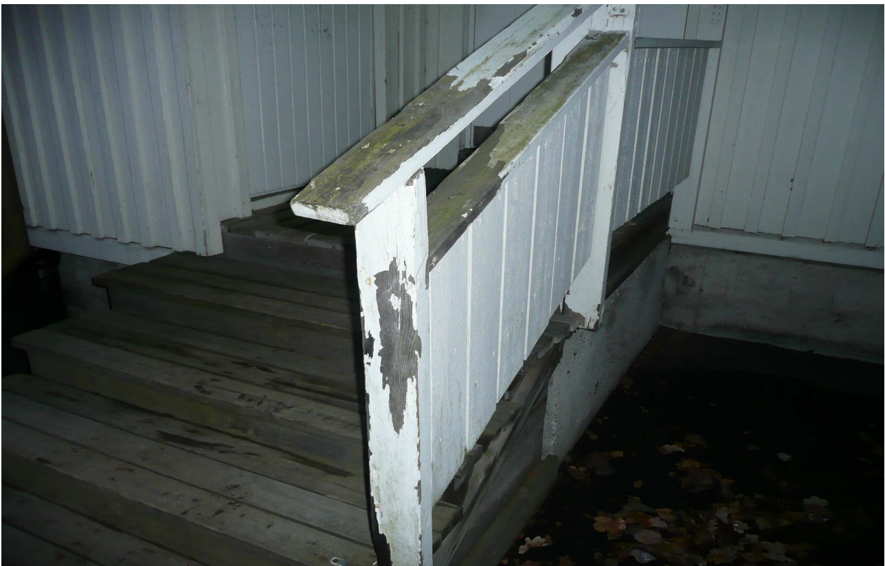
RAK- kuva 2. Portaan kaiteiden maalipinnassa on eriasteisia kulumia.
