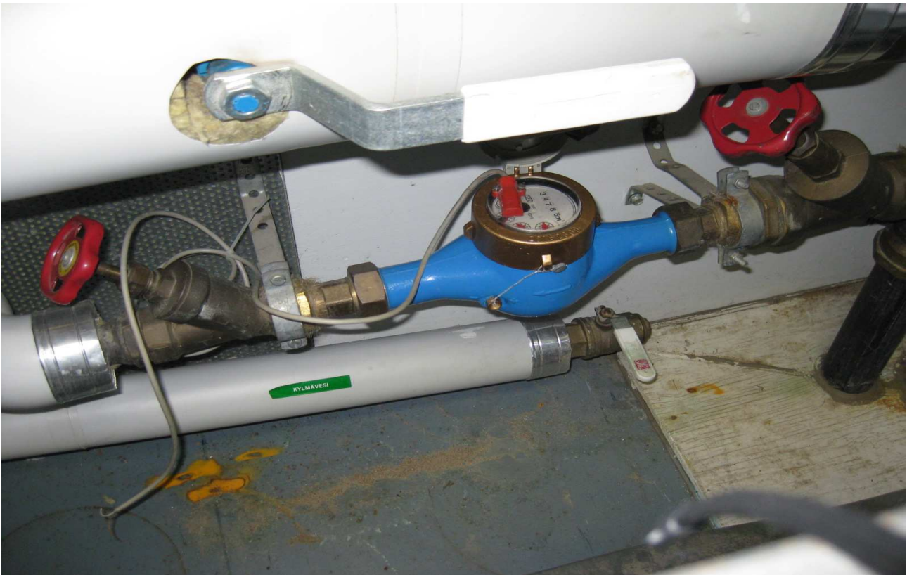
LVI-kuva 4. Yleiskuva vesimittarista ja pääsuluista.
