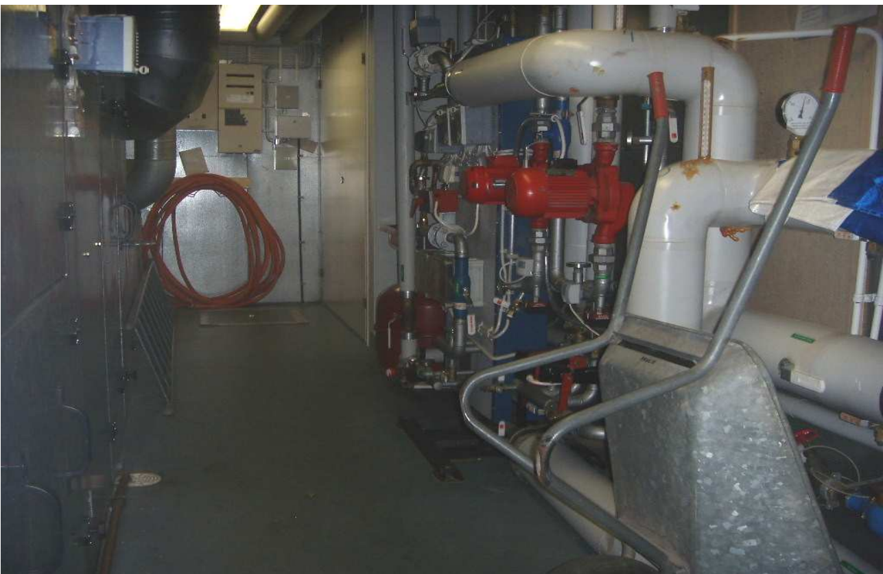
LVI-kuva 1. Yleiskuva lämmönjakohuoneesta.
