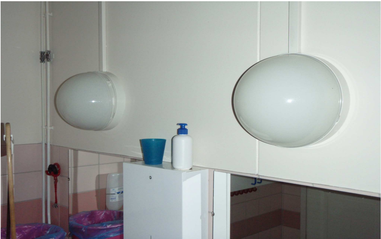
S-kuva 8. WC-tilojen peilivalaisimet, valaisimista on lohjennut kupuja.
