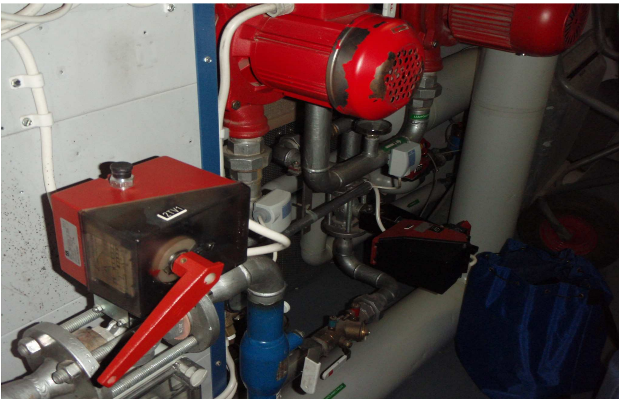
S-kuva 15. Yleiskuva kentälaitteista.
