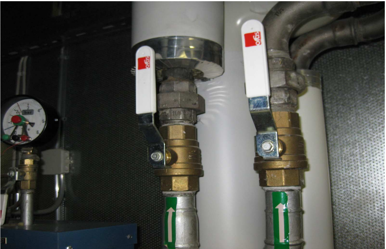
LVI-kuva 2. Yleiskuva lämpöjohtoverkoston venttiileistä.
