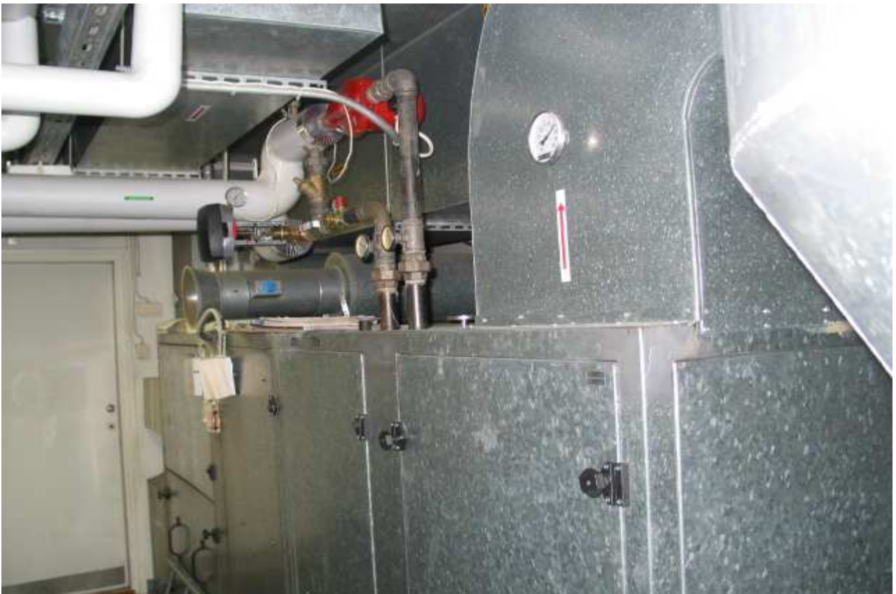
LVI-kuva 9. Yleiskuva IV- konehuoneesta.
