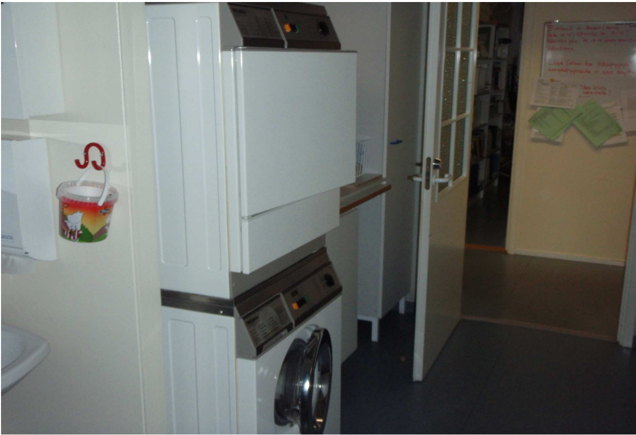
S-kuva 12. Pesukone ja kuivausrumpu.
