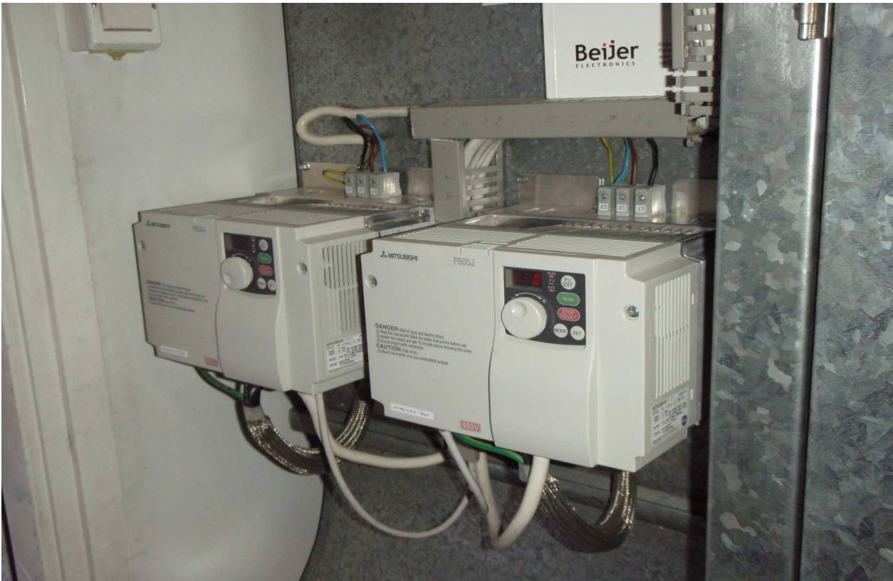
S-kuva 16. Ilmanvaihtokoneiden taajuusmuuttajat.
