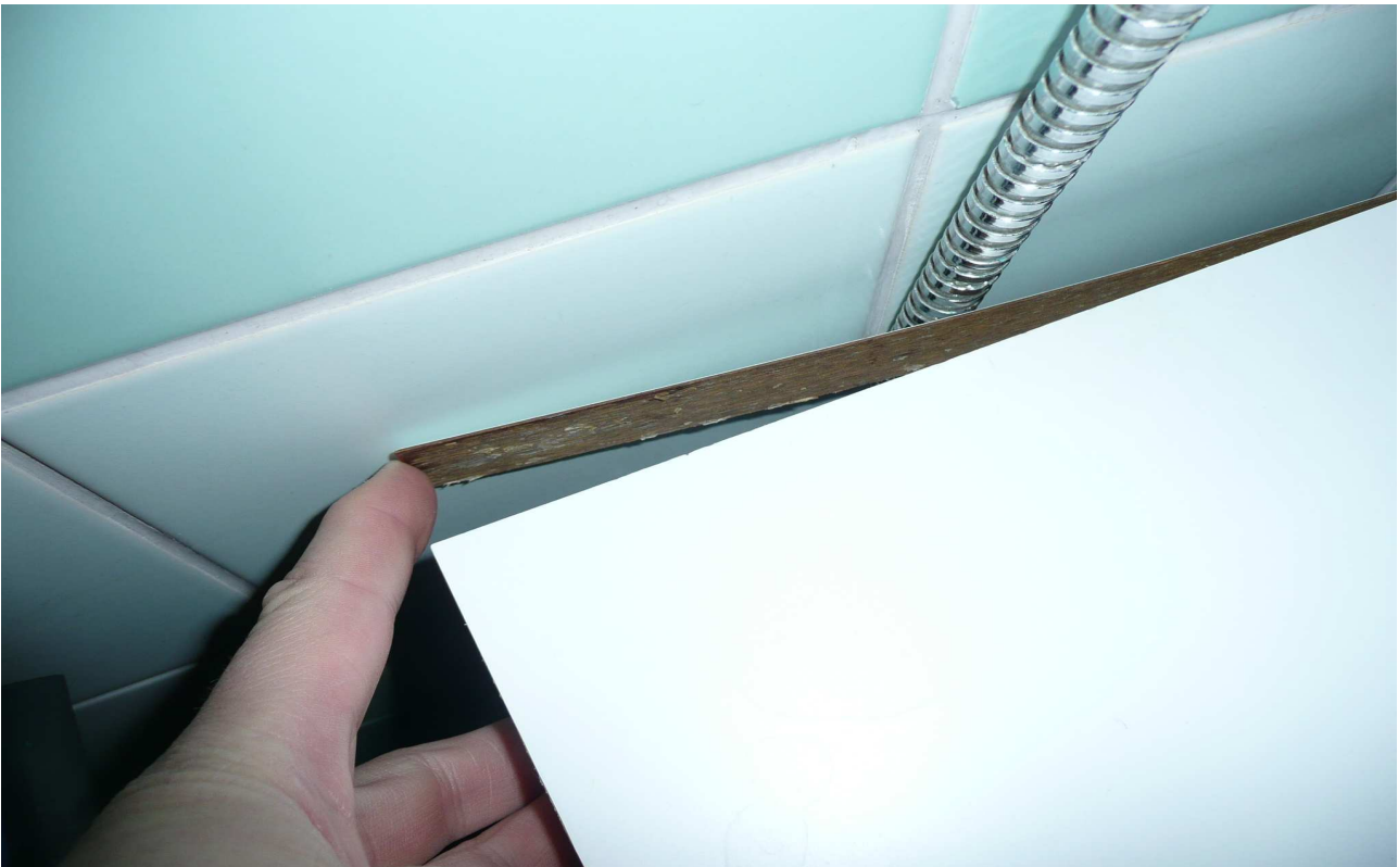
RAK- kuva 9. Pesuhuoneen pesupöydän päätylista on irti.
