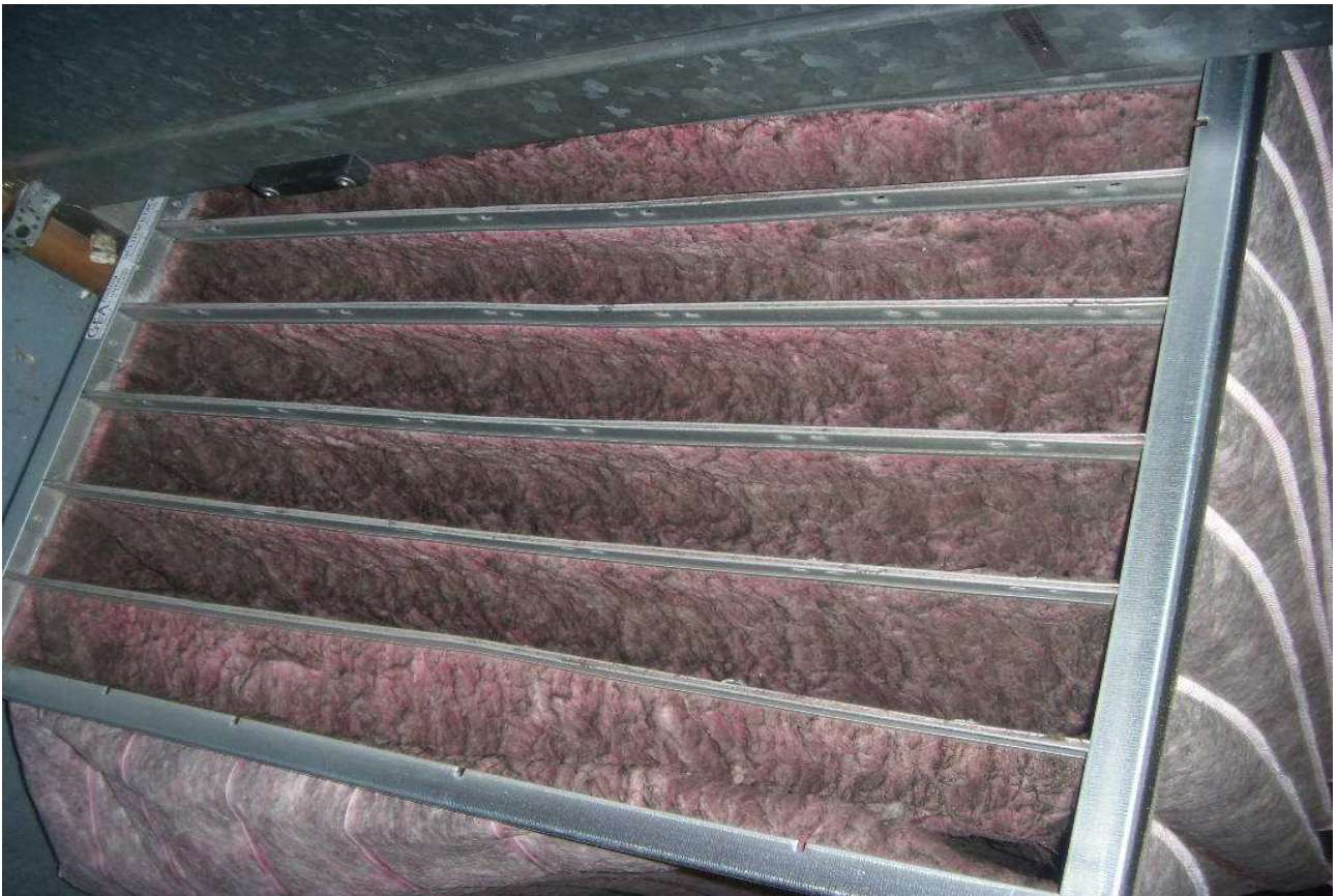
LVI-kuva 10. Yleiskuva tuloilmasuodattimesta.
