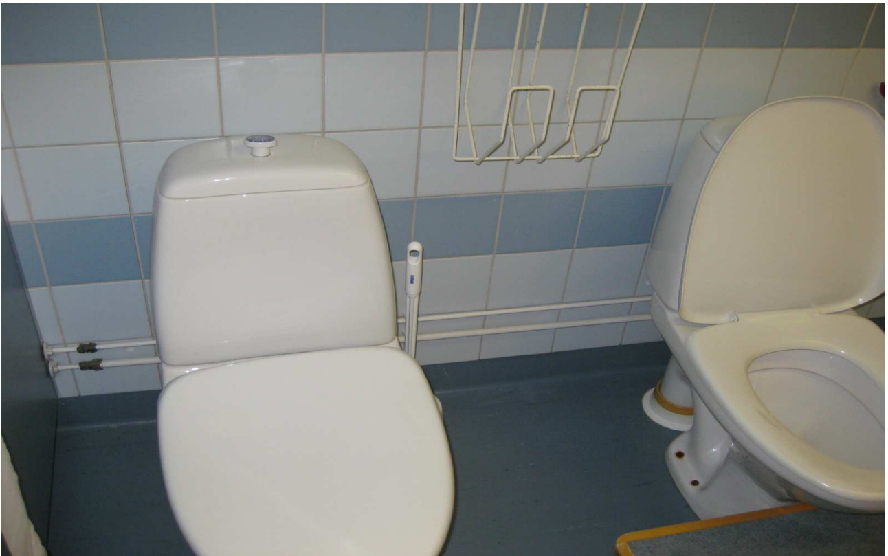
LVI-kuva 8. Yleiskuva vesikalusteista.
