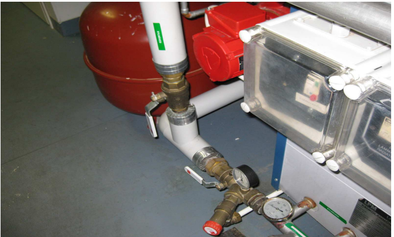
LVI-kuva 5. Yleiskuva käyttöveden sulkuventtiilistä.
