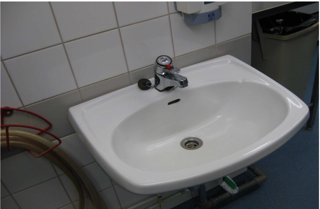
LVI-kuva 7. Yleiskuva vesikalusteista.
