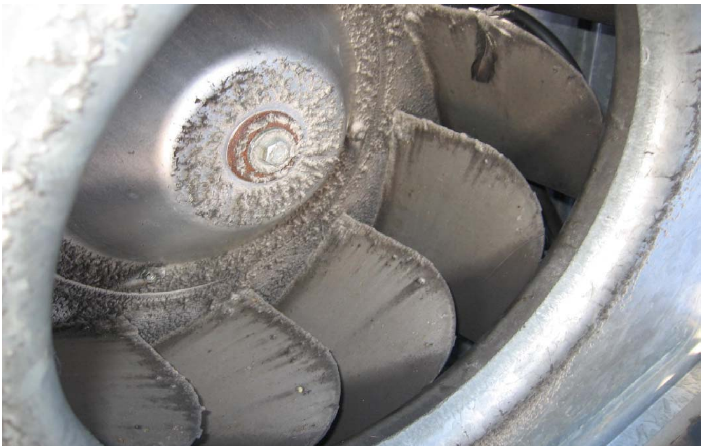
KUVA 4. Keittiön poistoilmahuuhallin on melko likainen.
