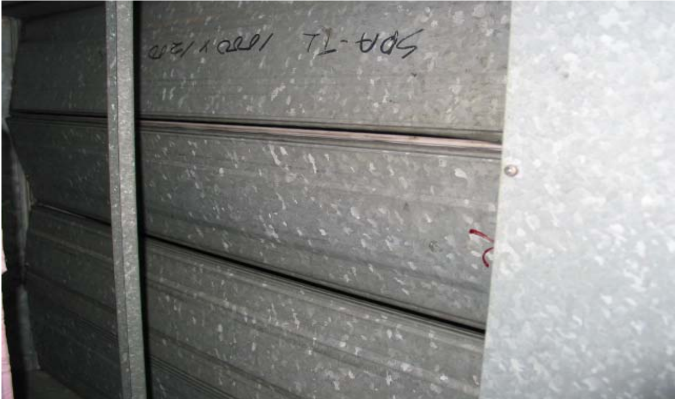
KUVA 1. Tuloilmakoneen sulkupelti ei sulkeudu täysin.
