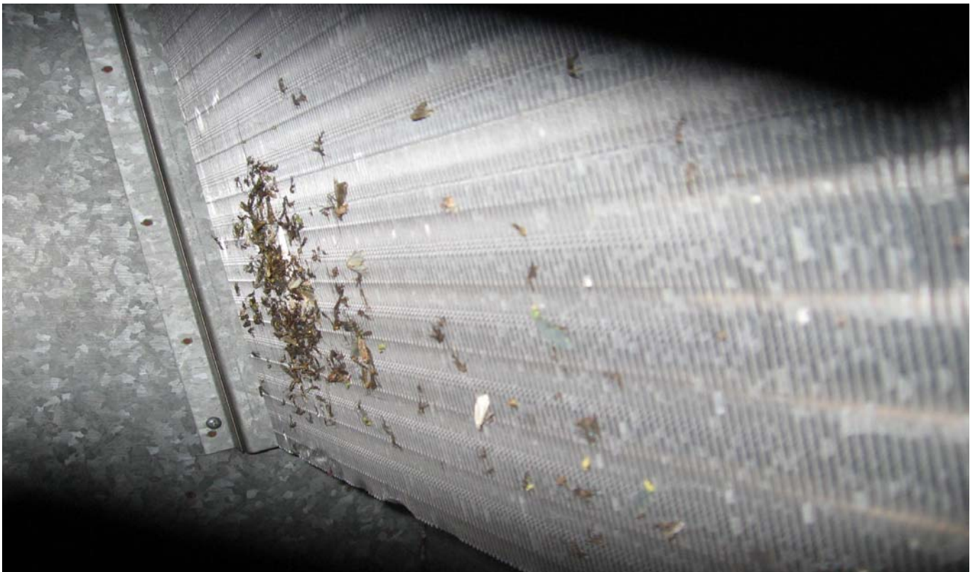
KUVA 2. Lämpöpatterissa on roskaa.
