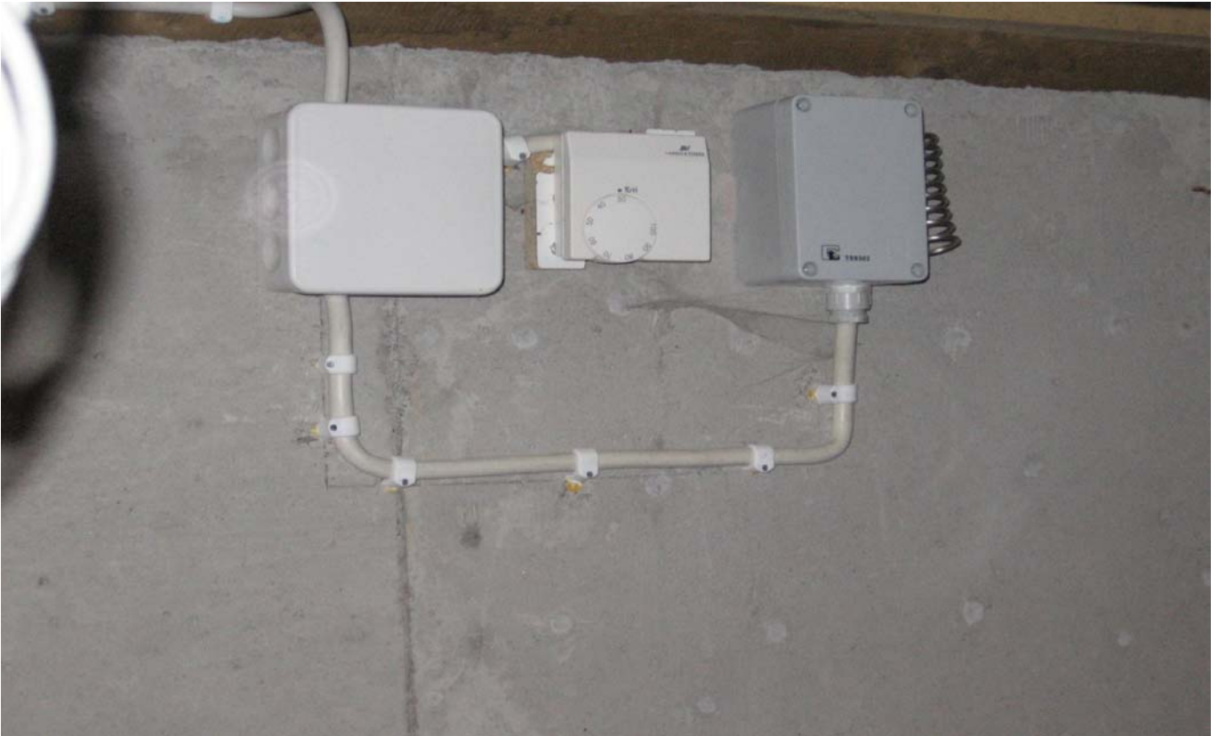
KUVA 5. Alustilan poistopuhaltimen kosteus- ja lämpötilasäätimet.
