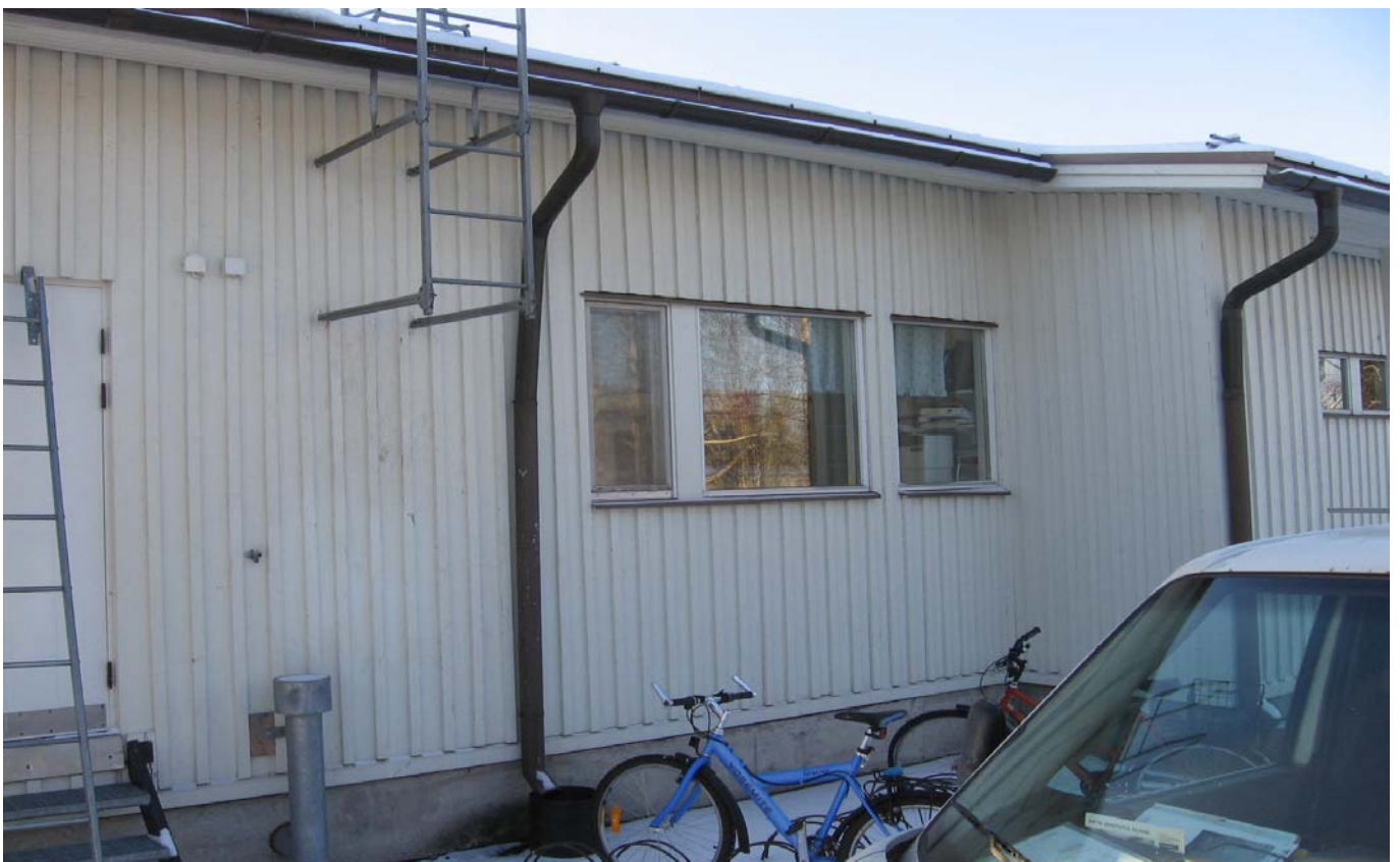
KUVA 10. Päiväkodin vesikatolle pääsyä tulee rajoittaa.
