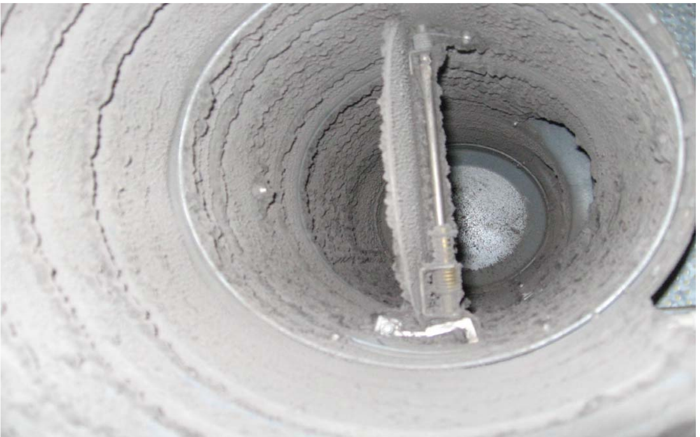
KUVA 6. Poistoilmakanavissa on runsaasti pölykertymää.
