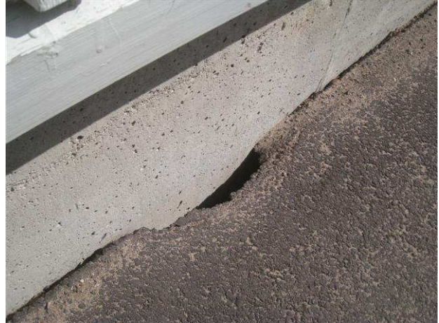
Kuva 8 Maanpinta on vajonnut asfaltin alta.
