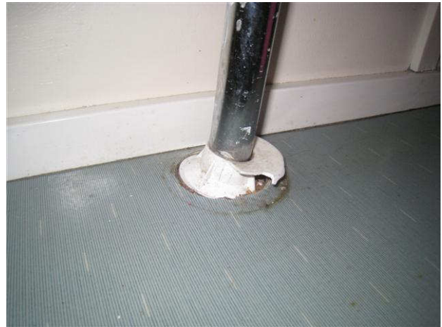
Kuva 26 Lavuaarin viemärin epätiivis liittymä.
