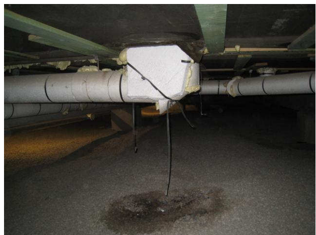
Kuva 30 Ryömintätilan puolella oleva viemäri- vuoto likimain wc-sh-tilan 47 kohdalla.
