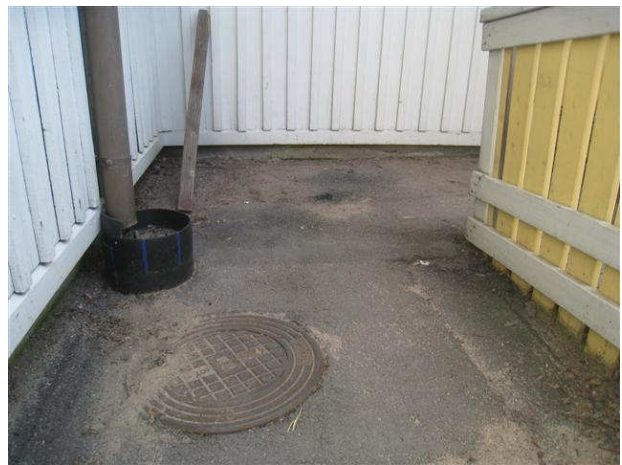
Kuva 2 Sisäpihan kulmalla ulkuvuoraus on lähellä asfalttipintaa, on roiskevesiriski.
