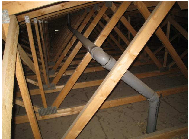
Kuva 22 Eristämätön ja riittämättömästi tuettu tuuletusviemäri.
