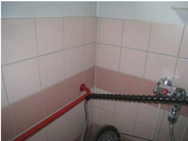
Kuva 35 Laatoituksen nurkkasauma on halki tilassa 7 wc-sh.
