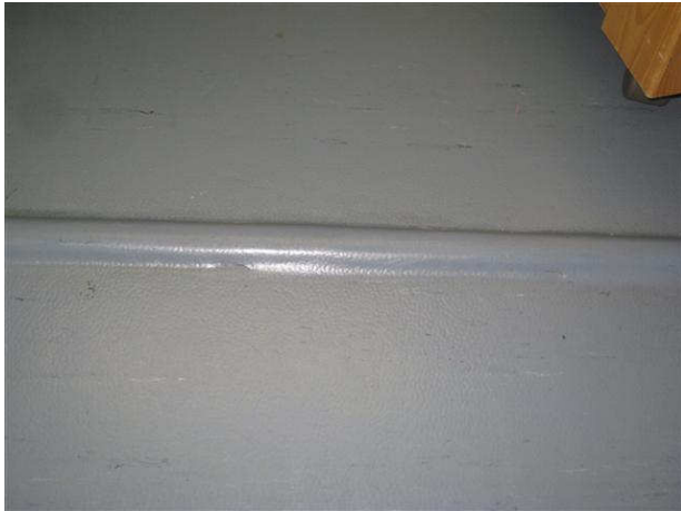
Kuva 33 Vesileikkitilan korotuskynnyksessä on saumavika.
