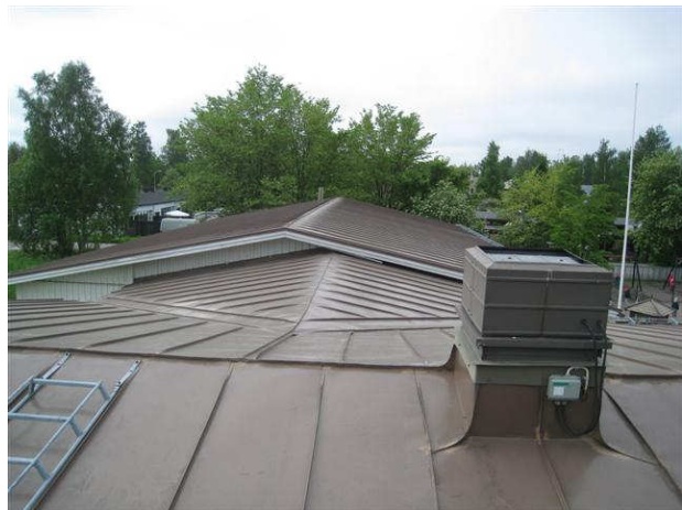
Kuva 16 Yleiskuva vesikatolta, kulkusilloja ei ole huoltokohteille.
