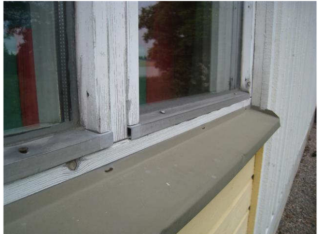
Kuva 10 Ikkunapinnat ovat kuluneet, alkuperäisen vesipelti ei ole tiiviisti liitetty.
