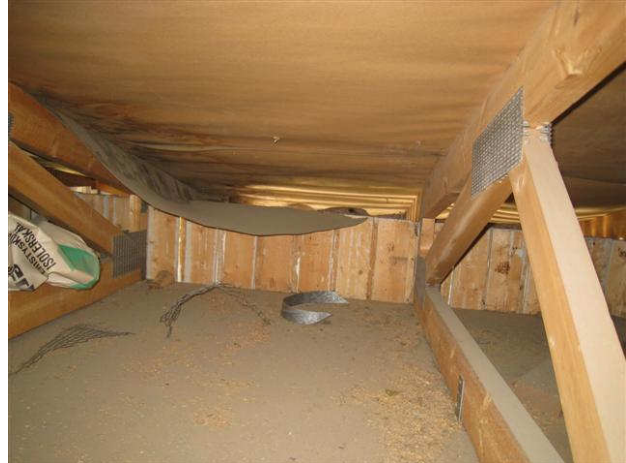
Kuva 20 Aluskatteen liepeen yläpuolella on kondenssi- tai vuotojälkiä, tuuletusreitti räystäältä on kuitenkin hyvä.
