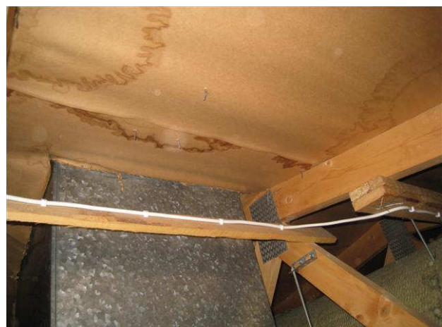
Kuva 24 IV-piipun läpivienti on tiivis. Aluskatteen sa on vanhoja kosteusjälkiä.
