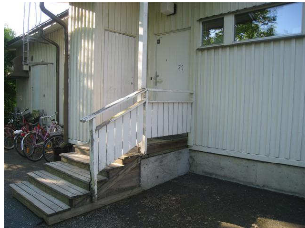
Kuva 14 Ulkoportaait ja kaiteet ovat kuluneet.
