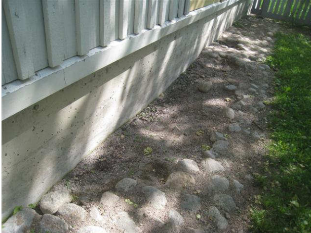
Kuva 7 Maanpinnan painuma/ kiviä poistettu kotikeittiö 49 kohdalla.
