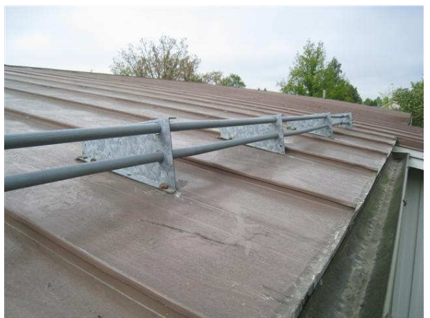
Kuva 18 Lumiasteiden kiinnityskohdat ovat vuotokaskeja, pieniä naarmuja pinnoitteessa.
