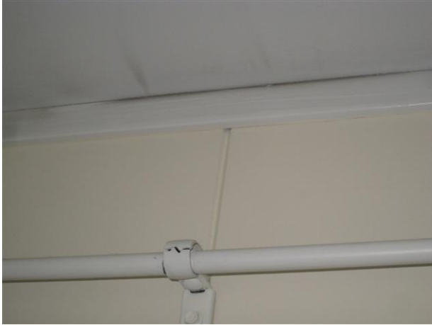
Kuva 37 Ilmavuotojälkiä katon rajassa.
