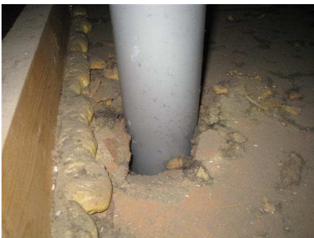
Kuva 23 Tuuletusviemäriin läpivienti yläpohjassa ei ole tiivis.
