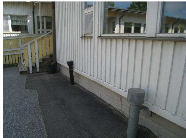
Kuva 4 Alustatilaan liittyviä tuuletusputkia, asfaltti on uusittu, on painuma.
