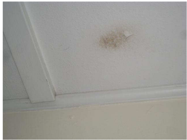
Kuva 38 Vesivuotojälki liikuntatilan 30 katossa.
