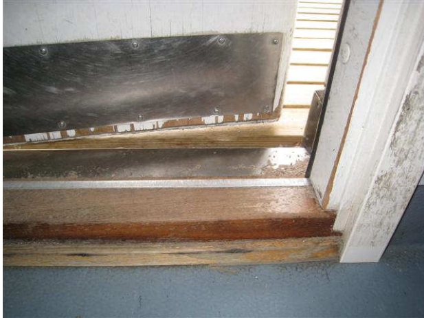
Kuva 13 Ulko-oven sisäpinta on alaosaltaan kulunut.
