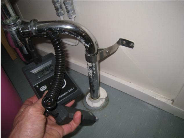
Kuva 25 Lavuaarin viemärin juuressa pintakosteus oli normaali viasta huolimatta.
