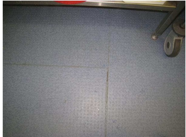
Kuva 34 Keittiön lattiamaton sauma on rikki.
