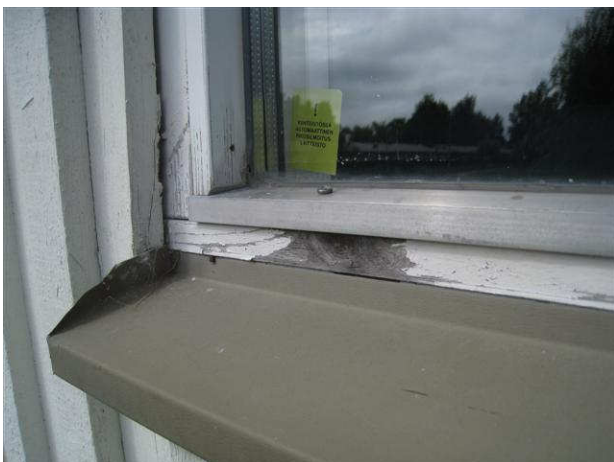
Kuva 11 Ikkunapielet eivät ole tiiviit, epätiivis vesipeltiliittymä, pellit ovat loivasti.
