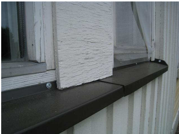
Kuva 9 Huonokuntoinen ikkunavälin vaneri, vesipelti on uusittu, mutta ei ole tiivis. Ikkunoiden alaosat kastuvat.
