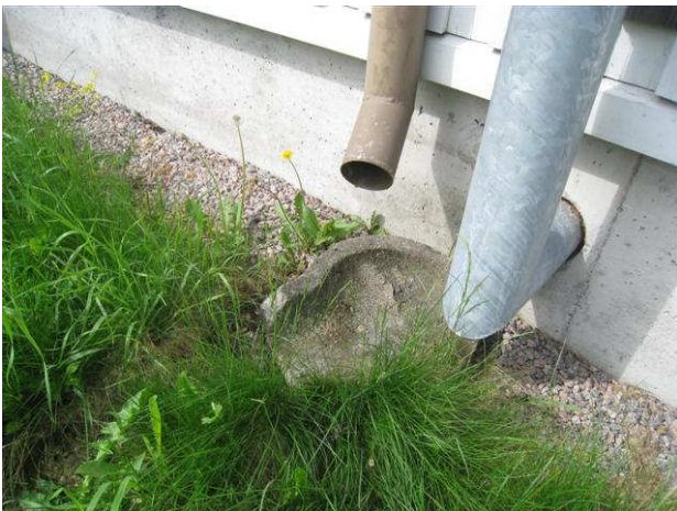
Kuva 3 Takasivulla loiskekourut ovat liikkuneet, vedet valuvat sokkelin juureen.
