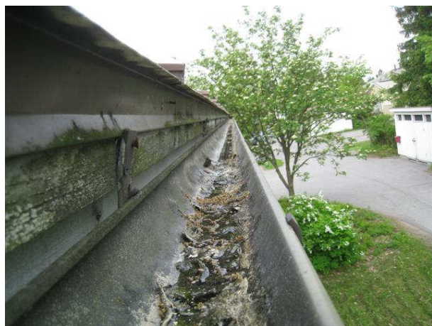
Kuva 17 Osin laho otsalautaa, sadevedet valuvat osin rännin ohi, ränni on liian alhaalla.
