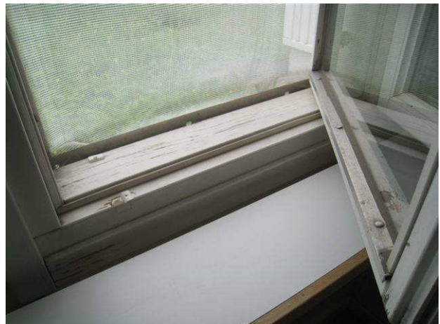
Kuva 12 Tuuletusikkunaa on pidetty sateilla auki ja on tullut maalivaurioita. Hyönteisverkko on rikki.
