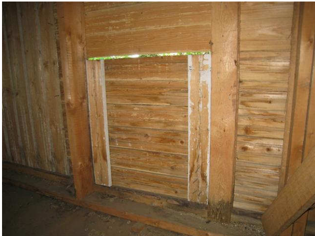
Kuva 15 Päätyseinän kulkuluukku on vuotanut, seinäpaneeleissa on vesijälkiä.
