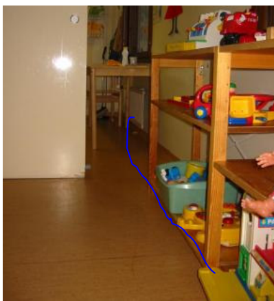
Kuva 5 Tilojen 132 ja 133 kohdilla lattian pintakosteus koholla.
