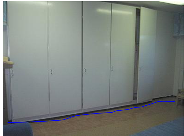
Kuva 4 Tilan 122 lattiassa lähellä ulkoseinää pintakosteus koholla.
