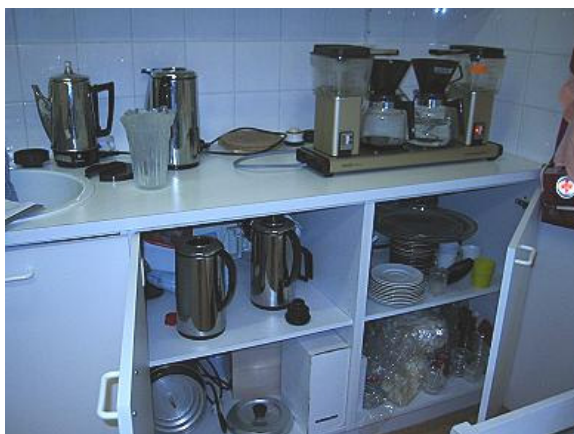
Kuva 11 Kahvihuoneen tiskipöydän kaapistossa kosteusvaurioon viittaavaa hajua. Kaapin sokkelirakennetta ei avattu.
