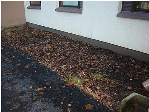
Kuva 3 Tilojen 105, 108 ja 110 kohdalla maan vietto puutteellinen.
