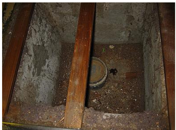
Kuva 12 Keittiön kohdalla käytävässä pohjaviemärin tarkastusluukku/ potero. Voimakas maakellarimainen kosteusvaurioon viittaava haju.
