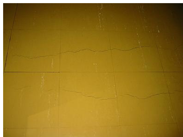
Kuva 6 Eteisen 113 kohdalla lattiassa rakentei- den liikkeistä johtuvia halkeamia. Pinta- kosteus koholla.
