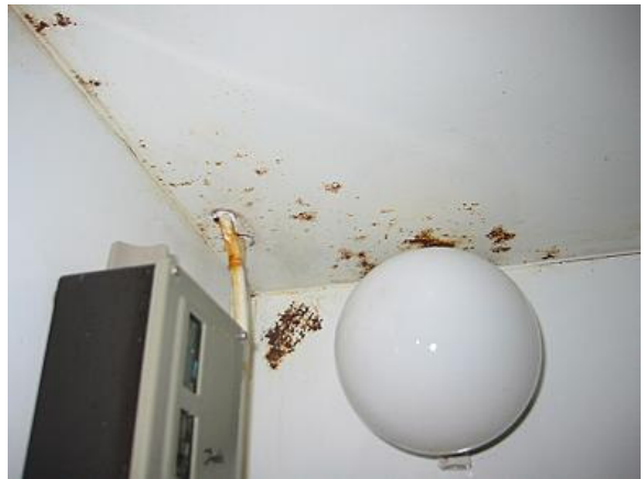
Kuva 10 Kylmäkaapissa nro. 2 ruostetta ja toisessa maakellarimaista kosteusvaurioon viittaavaa hajua.
