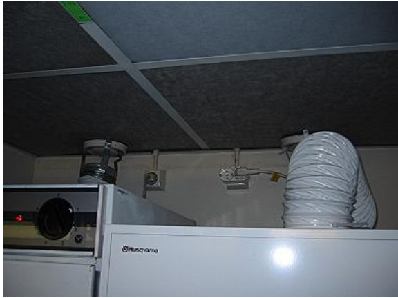
Kuva 7 Kuivauskaappien poistoilma johdetaan IV-kanaviin.
