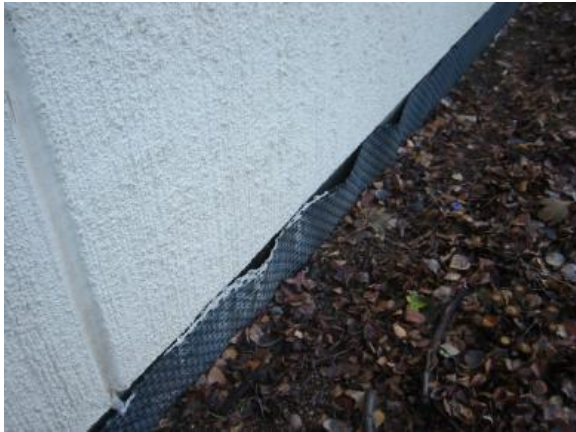
Kuva 1 Huoneen 122 kohdalla puutteellisesti asennettua patolevyä. Vietto rakennuksesta pois päin puutteellinen.
