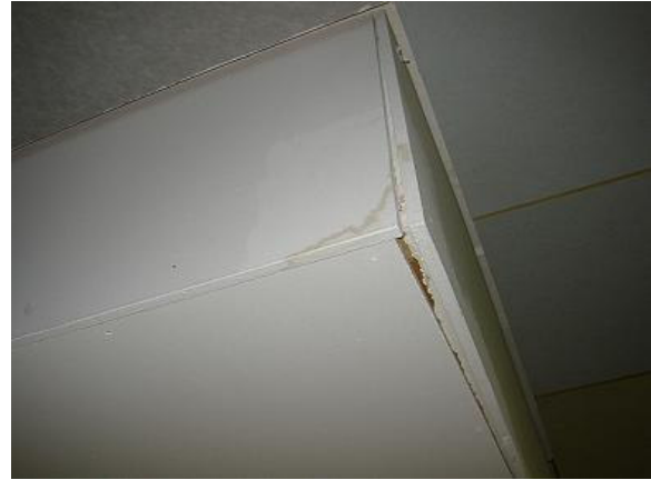
Kuva 8 Eri tiloissa oli lastulevyrakenteisissa koteloiden näkyvillä kosteuden/valumaveden aiheuttamia, jo kuivuneita tummentumia.
