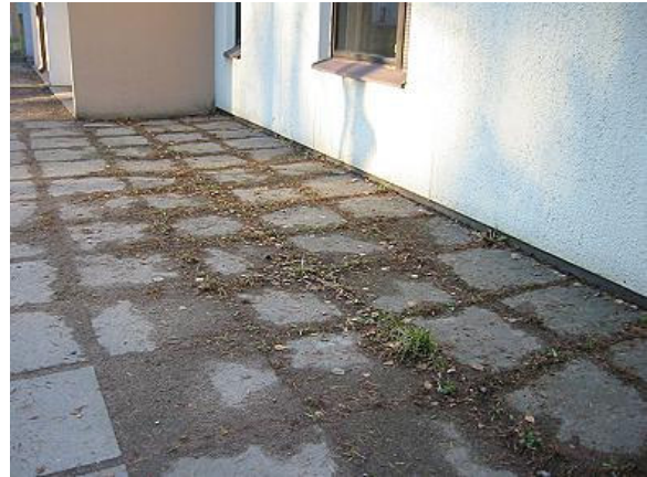
Kuva 2 Huoneiden 132 ja 133 kohdilla pihalaa- tut viettävät rakennukseen päin. Patole- vyjen olemassaolosta ei varmuutta.
