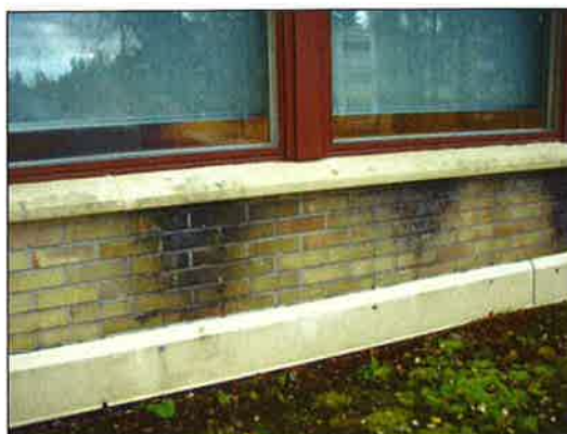
Kuva 8. Liikuntasalin pohjoispuolen korotuksessa valunut vesiä seinäpintaa pitkin.
