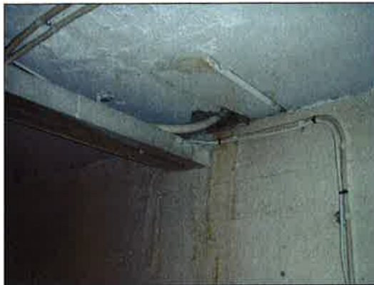
Kuva 10. Kellarin lämmönjakuhuoneessa vuotojälkiä läpiviennin ympärillä.
