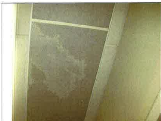
Kuva 1. Kirjastossa 1.26 sisäkatossa vuotojälkiä.
