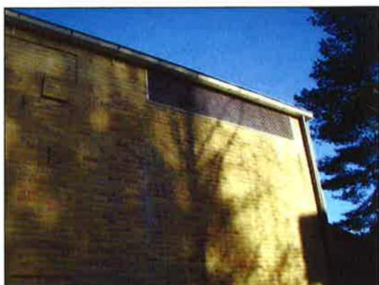
Kuva 7. Liikuntasalisiiven eteläseinustan pinnalle kertynyt suoloja.
