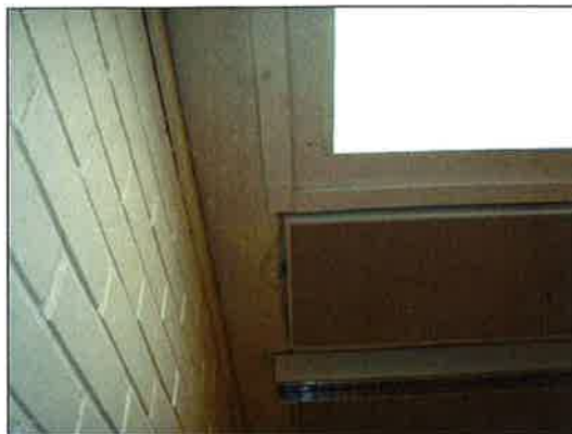
Kuva 2. Vuotojälkiä käytävän 1.05 kattoikkunan ympärillä.
