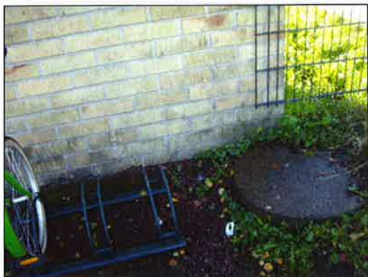
Kuva 5. Rakennuksen luoteisnurkassa vietää maanpinta ulkoseinää päin.
