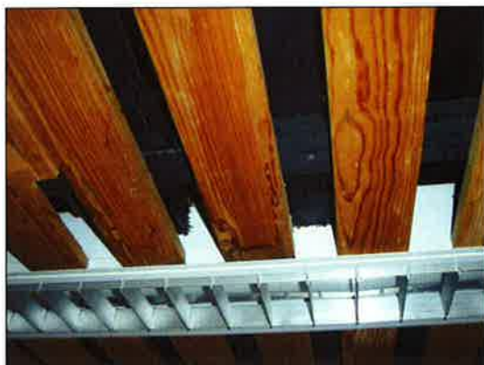
Kuva 3. Taukotilan 1.38 kattoikkunan ympärillä sisäkatossa vuotojälkiä.
