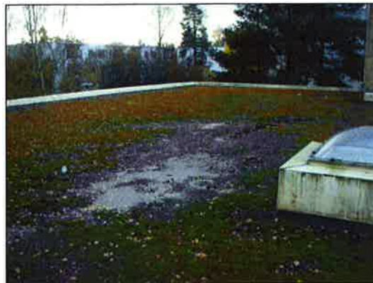
Kuva 4. Vesikatolla lammikoitumista ja runsasta sammaloitumista.
