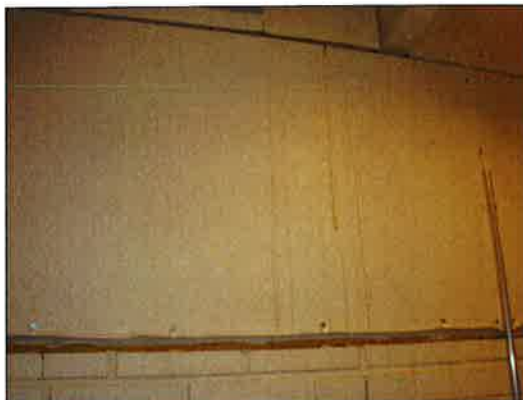
Kuva 6. Liikuntasalin varastohuoneessa 1.68 valumajälkiä.
