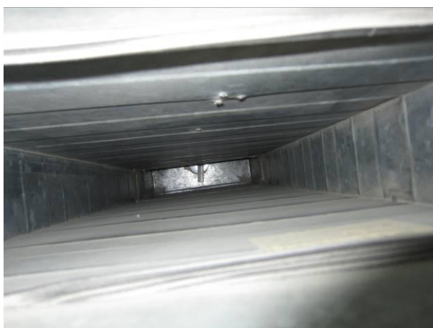
Kuva 21. Poistoilmakanavissa on havaittavissa hieman pölykertymää.
