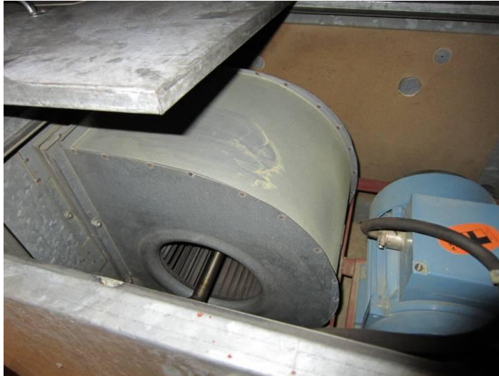
Kuva 11. Tuloilmakoneen puhaltimissa ja kammioissa on havaittavissa pölyä.
