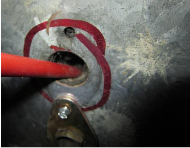
Kuvat 8. Tuloilmakammio on päällystetty reikäpellillä, jonka alla on suojaamaton mineraalivilla.
