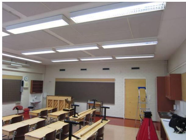
Kuva 22. Yleiskuva opetustilan pääte-elimistä.
