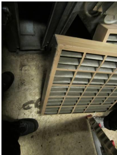
Kuva 12. Tuloilmakoneen suodatinkehikko ei ole tiivis, tapahtuu ohivirtausta.
