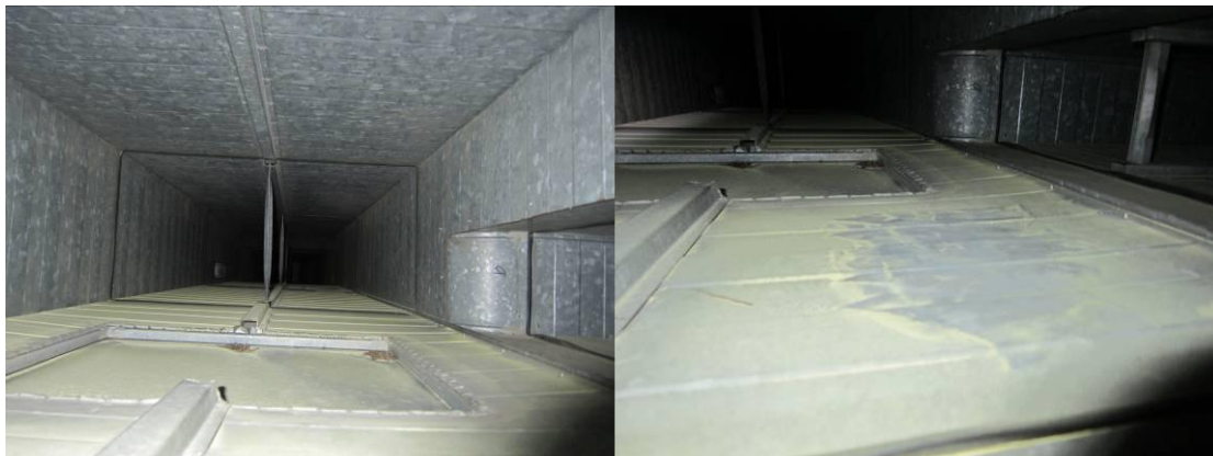
Kuvat 19-20. Yleiskuvat tuloilmakanavasta.
