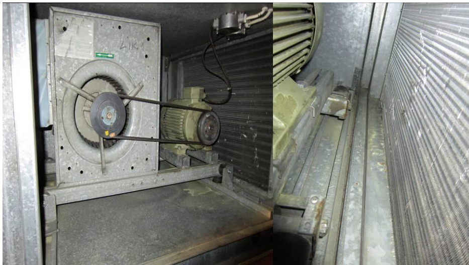
Kuva 3-4. Ilmanvaihtokoneen puhaltimissa ja kammioissa on havaittavissa pölyä ja roskaa.
