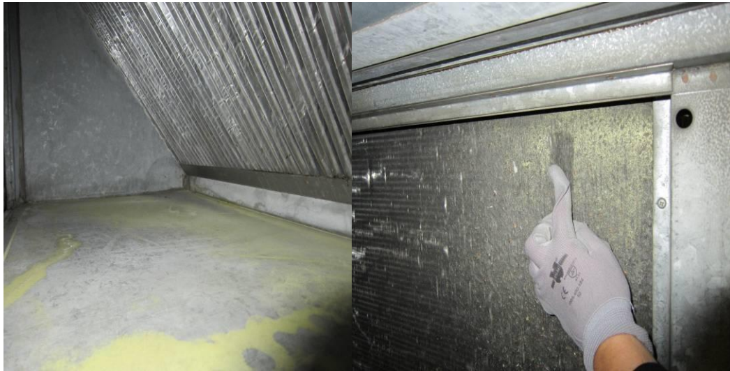
Kuva 15-16. LTO- kuutio ja lämmityspatteri ovat pölyiset.
