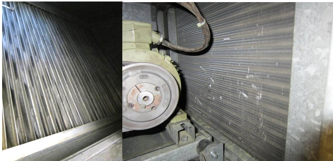
Kuva 5-6. LTO- kuutio on pölyinen ja lämmityspatterissa on pieniä kolhuja sekä roskia.
