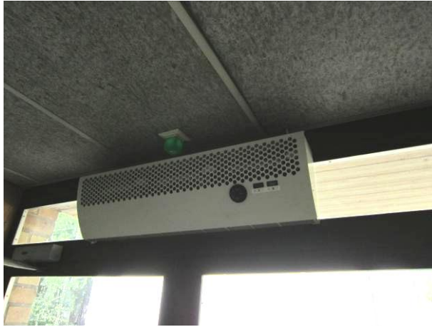
Kuva 28. Yleiskuva tuulikaapin kiertoilmakoneesta.
