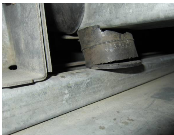
Kuva 7. Poistopuhaltimen kumityyny ovat osittain rikki.
