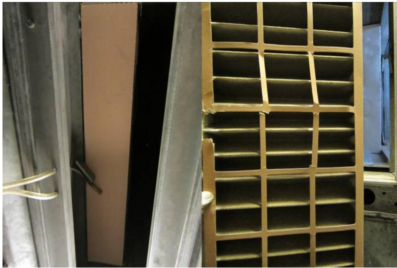
Kuva 1-2. Tuloilman suodatinkehikko ei ole tiivis, tapahtuu ohivirtausta. Suodattimen pahvikehikko on rikkoontunut.
