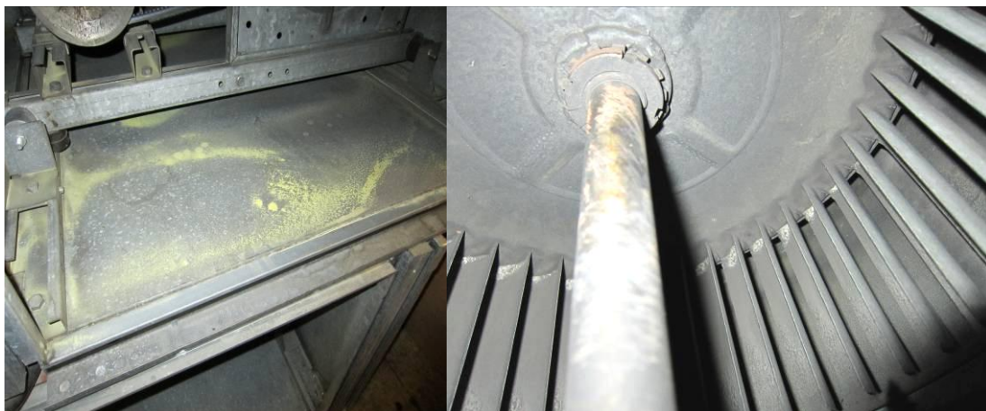
Kuva 13-14. Ilmanvaihtokoneen puhaltimissa ja kammioissa on havaittavissa pölyä ja roskia.
