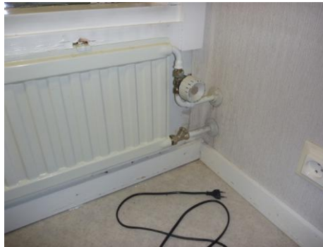
KUVA1: Tilan 16 ulkoseinän sisäpinnassa havaittiin maalin hilseilyä.
