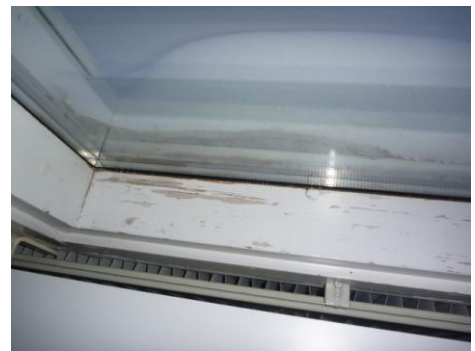
KUVA2: Ikkunan karmeissa maalin hilseilyä.
