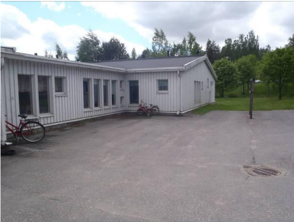
Kuva 1. Asfaltoiduilla alueilla rakennuksen vierustan maanpinta viettää pääosin riittävästi pois päin rakennuksesta
