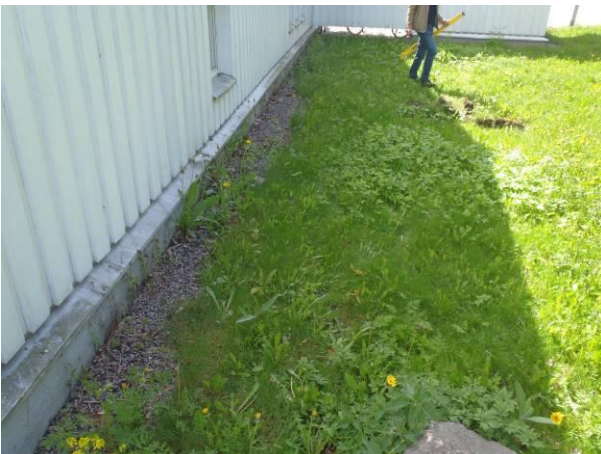
Kuva 7. Kohdassa P10 sepelikaista on muuta maanpintaa alempana. Viettokaltevuus on pääosin riittävä, joskin yksittäisiä painumia on. Rakennuksen vieressä on kumpu, joka viettää niskaojaan ja kuvassa näkyvään sadevesiviemäriin.
