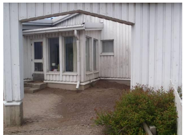
Kuva 6. Kohta P6 on betonilaatoitettu ja kallistus on riittävä, mutta vieressä on kuoppa, johon vesi lammikoituu.
