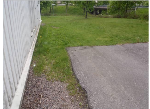
Kuva 2. Kohdassa P2 vierustan maanpinta on kovin tasainen. Lisäksi noin viisi metriä rakennuksesta kohoaa kumpu, jossa maanpinta viettää rakennukseen päin.
