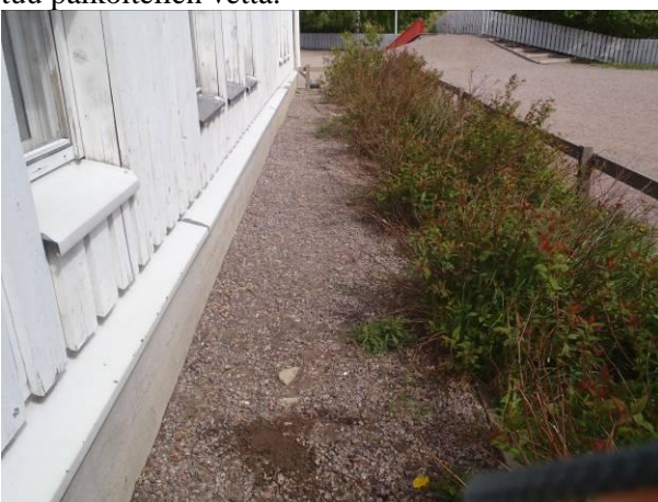
Kuva 5. Kohdassa P5 rakennuksen vierusta on hieman kuppimainen, joten vesi lammikoituu.
