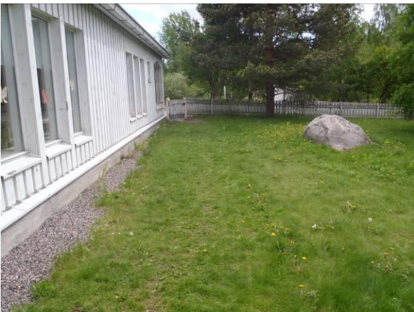
Kuva 3. Kohdassa P3 kallistukset ovat laajasti ottaen riittävät, joskin sepelikaistaleelle lammikoituu paikoitellen vettä.
