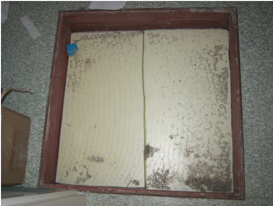
Kuva 3 Kulkuluukku alustatilaan. Lämmöneristeenä Finnfoam-levyä. Luukussa ei tiivistettä.
