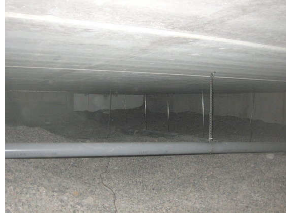
Kuva 8 Sisäpihan puoleinen alustatila/ lohko. Viemärit ovat eristämättömiä.
