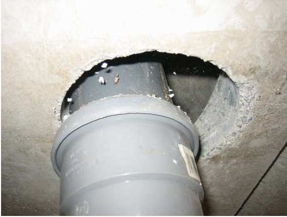
Kuva 7 Lämpivientejä ei ole tiivistetty.
