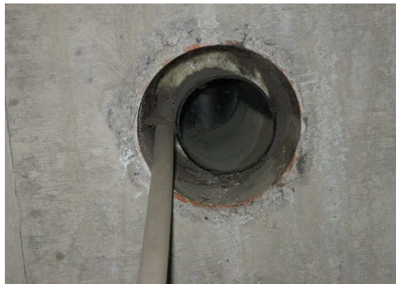
Kuva 6 Sokkelin läpi viety korvausilmaventtiili.
