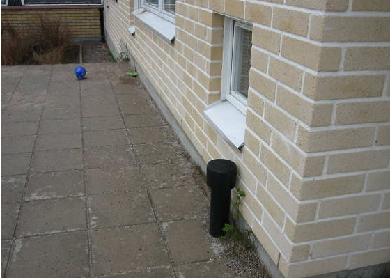
Kuva 1 Sisäpihan puolella kerhuhuoneen kohdalla betonilaatat viettävät rakennukseen päin.
