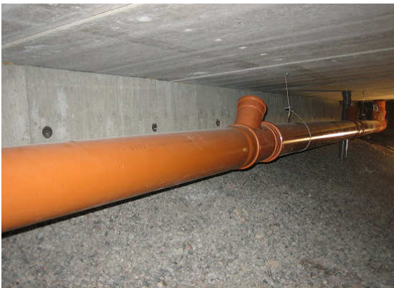
Kuva 5 Alustatilassa ilmanvaihtokanavana toimivaa viemärintiputkea, jossa haaroituskappaleet toimivat venttiileinä.
