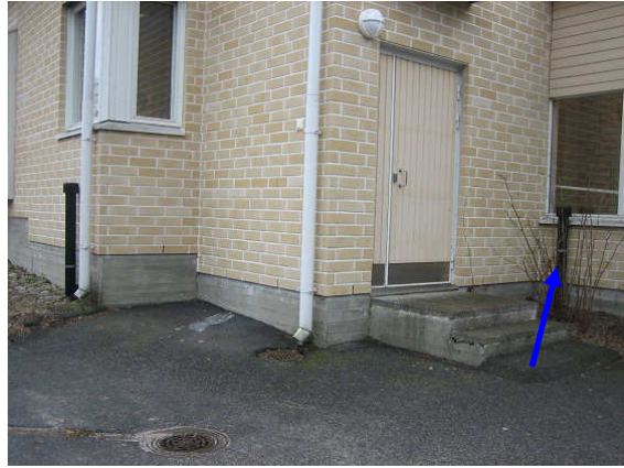
Kuva 10 Takapihan/ kadun puolelta sisäänkäynti. Oikealla yhdyskäytävän alustatilan tuuletusputki. Em. alustatilaan ei pääsyä.
