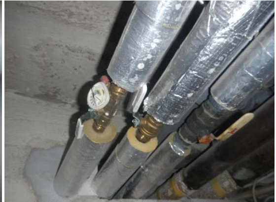
Kuva 13. Käyttövesiverkoston linjasulku- ja säätöventtiileitä.
