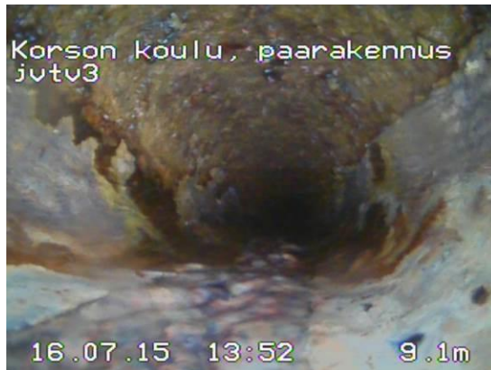
Kuva 24. Valurautainen pohjaviemäri on sisäpinnaltaan ruosteinen.
