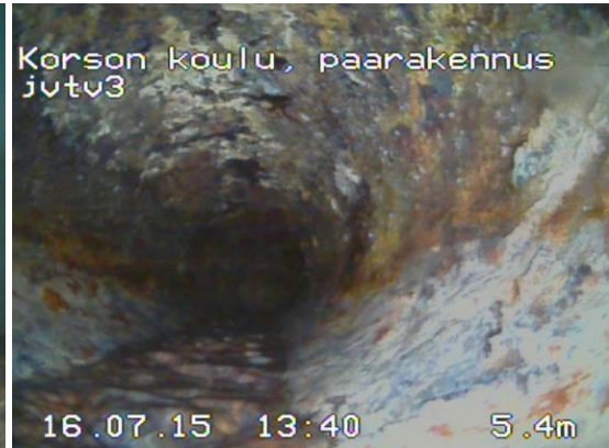
Kuva 23. Valurautainen pohjaviemäri on sisäpinnaltaan ruosteinen.
