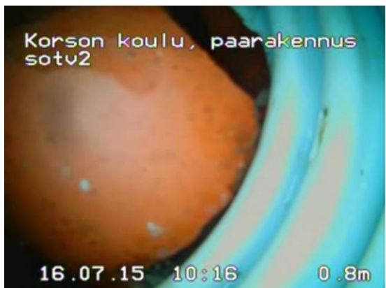
Kuva 31. Ruukkuputken pala on tukkinut salaojalinja sotv2.
