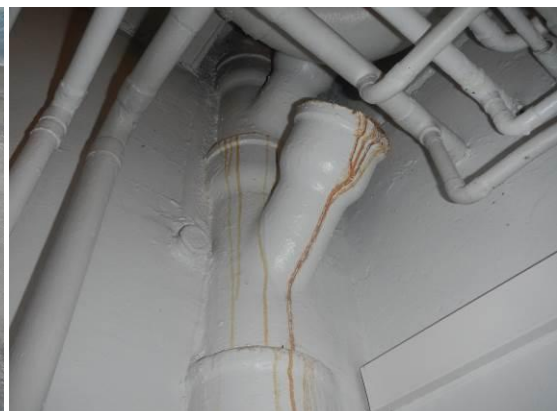
Kuva 21. Valumajälkiä ja halkeama kellarikerroksen valurautaviemärissä.
