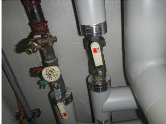
Kuva 4. Linjasulku- ja säätöventtiileitä.
