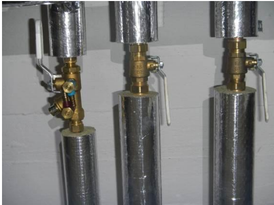
Kuva 14. Käyttövesiverkoston linjasulku- ja säätöventtiileitä, kotitalousluokkakäytävä.
