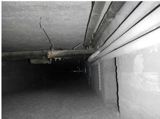
Kuva 10. Käyttöveden runkojohtoja ryömintätilassa.
