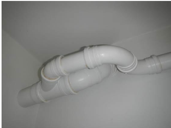
Kuva 18. Muoviviemäriä kellarikerroksen wc-tiloissa.
