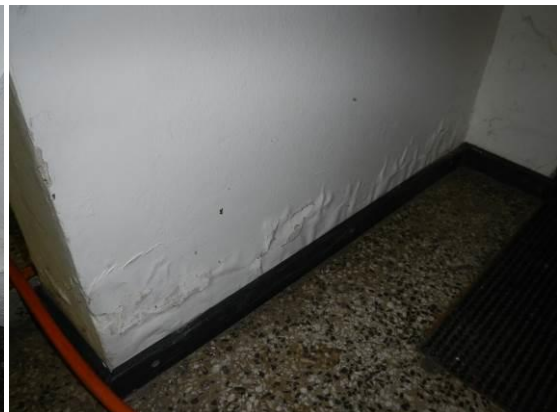
Kuva 29. Kosteusjälkiä kellarikerroksen seinillä.
