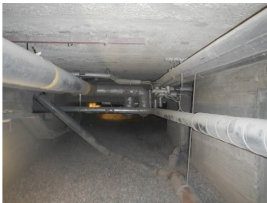
Kuva 2. Lämpö- ja käyttövesirunkojohtoja ryömintätilassa.
