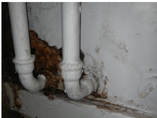
Kuva 8. Vuotojälkiä lämpöjohtojen seinälä- piviennissä kellarikerroksessa.
