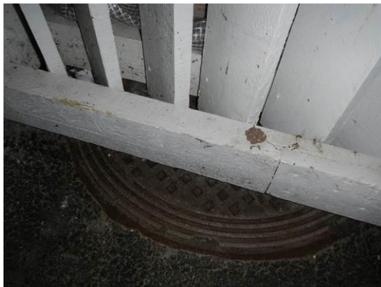
Kuva 28. Salaojakaivon sok3 kansi vaikeasti luoksepäästävä.
