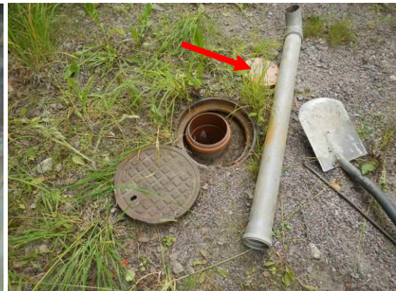
Kuva 25. Tarkastusputken kehys on liikunut, muovinen kierrekansi rikkoutunut.
