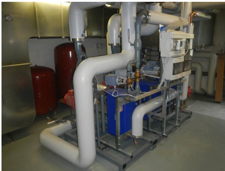
Kuva 1. Kaukolämmön alajakokeskus varusteineen.
