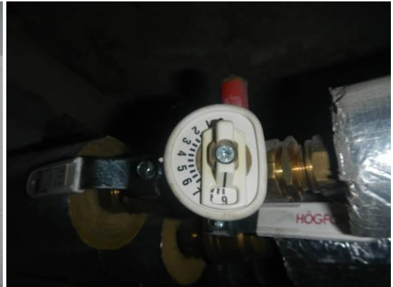
Kuva 15. Kiertoveden linjasäätöventtiili on täysin auki.
