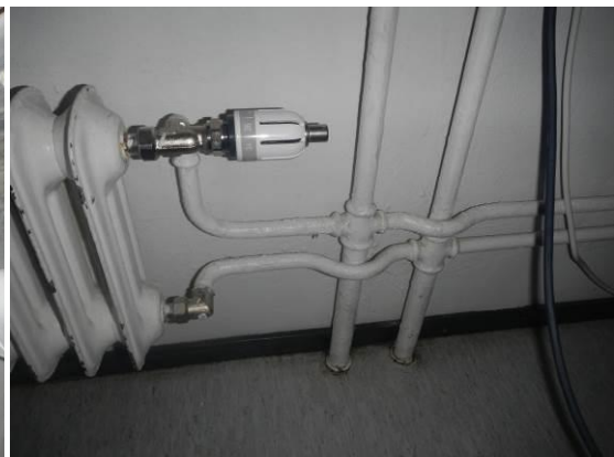
Kuva 3. Lämpöjohdot nousevat lattialäpivientien kautta lämpöpattereille.
