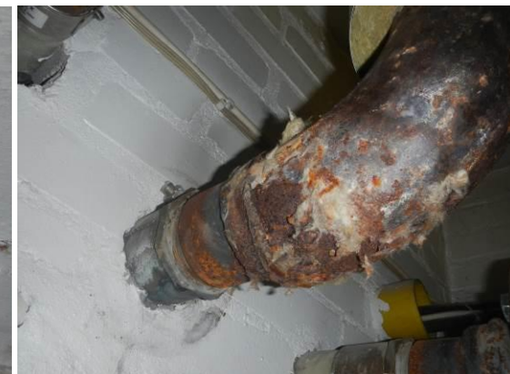
Kuva 9. Vuotojälkiä ja ruostetta lämpöjoh- don pinnalla, putki sijaitsee varastotilassa lämmönjakuhuoneen vieressä.
