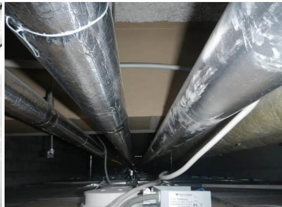
Kuva 11. Käyttöveden runkojohtoja alakattojen takana.
