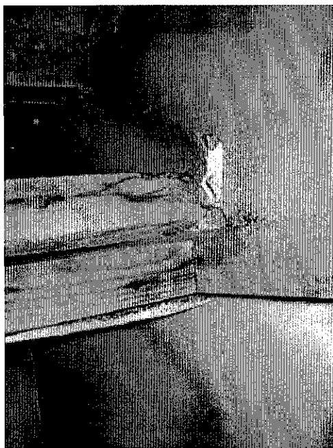
Kuva 6. Tyttöjen wc-tilan (huonetila 12) alakatossa oli merkkejä rakenteeseen päässeestä kosteudesta.
