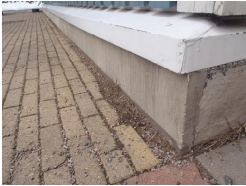
Kuva 1. Slammattu ja korjattu harkkosokkeli
