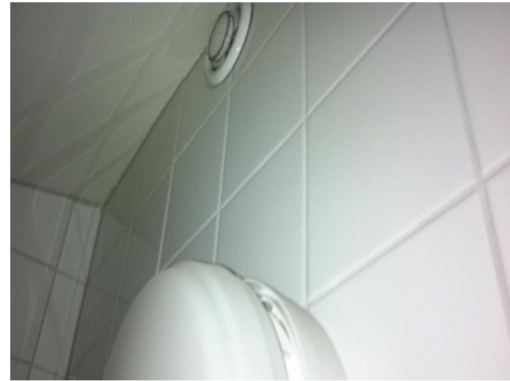
Kuva 12. Paikoin poistoilmaventtiilit ovat puhdistamisen tarpeessa
