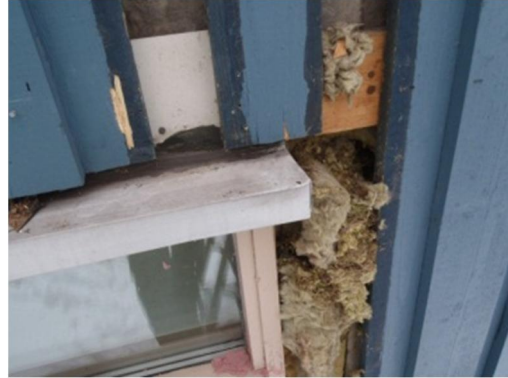
Kuva 6. Toimistohuoneen ulkoseinän sisässä on linnunpesä sekä pieneläinten jätteitä.
