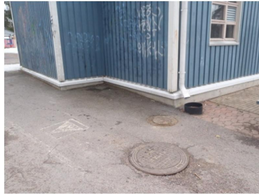
Kuva 2. Puutteita maanpintojen kaadoissa ja koroissa
