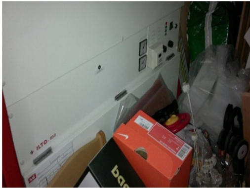
Kuva 11. Ilmanvaihtokone sijaitsee melko täydessä varastotilassa
