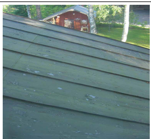
Kuva 12: Laajennusosan hilseilevä kattomaalipinta (4.5).
