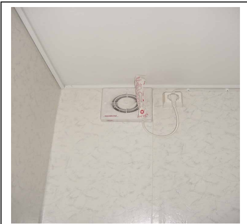
Kuva 27: Kerhotilojen WC:n tuuletin (4.3.1).
