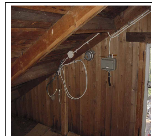
Kuva 36: Purkamatta jääneitä asennuksia ullakolla (5.4.1).
