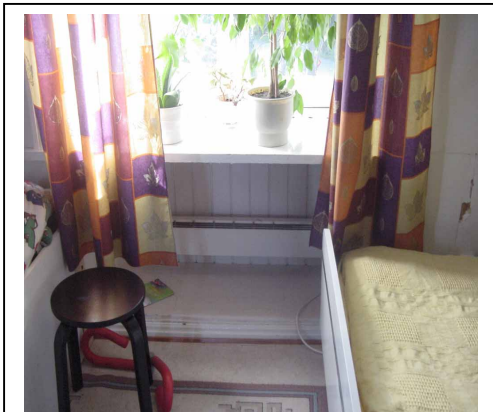
Kuva 39: Yläkerran MH: n pistotulppaliitäntäinen lämmitin (5.4.2).
