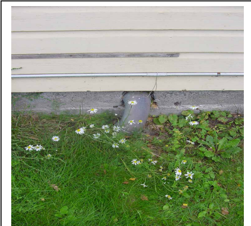
Kuva 25: Eristämätön viemäri ulkotilassa (4.2.4).
