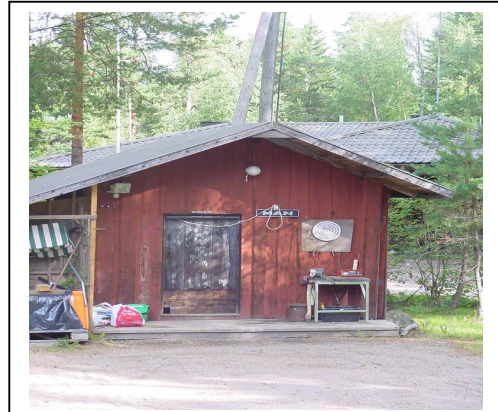
Kuva 44: Ulkovalaston ulkovalaisin ja maadoittamaton jatkojohto (5.4.3).
