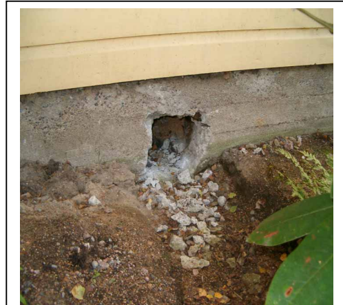
Kuva 8: Laajennusosan betonisokkeliin tehty reikä (3.2.1).
