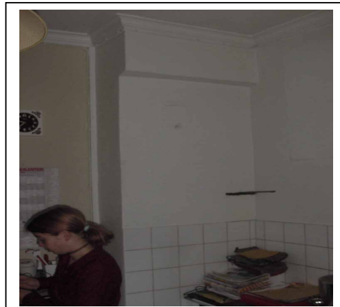
Kuva 28: Asunnon keittiön poistoilmasäleikkö (4.3.1).
