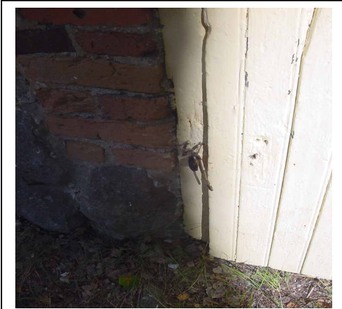
Kuva 13: Rikkoutunut kellaritilan ovi ja lukko (3.2.4).
