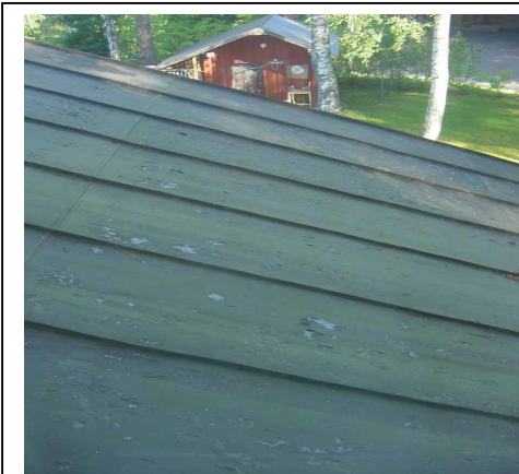
Kuva 15: Laajennusosan hilseilevä kattomaalipinta (3.2.4).
