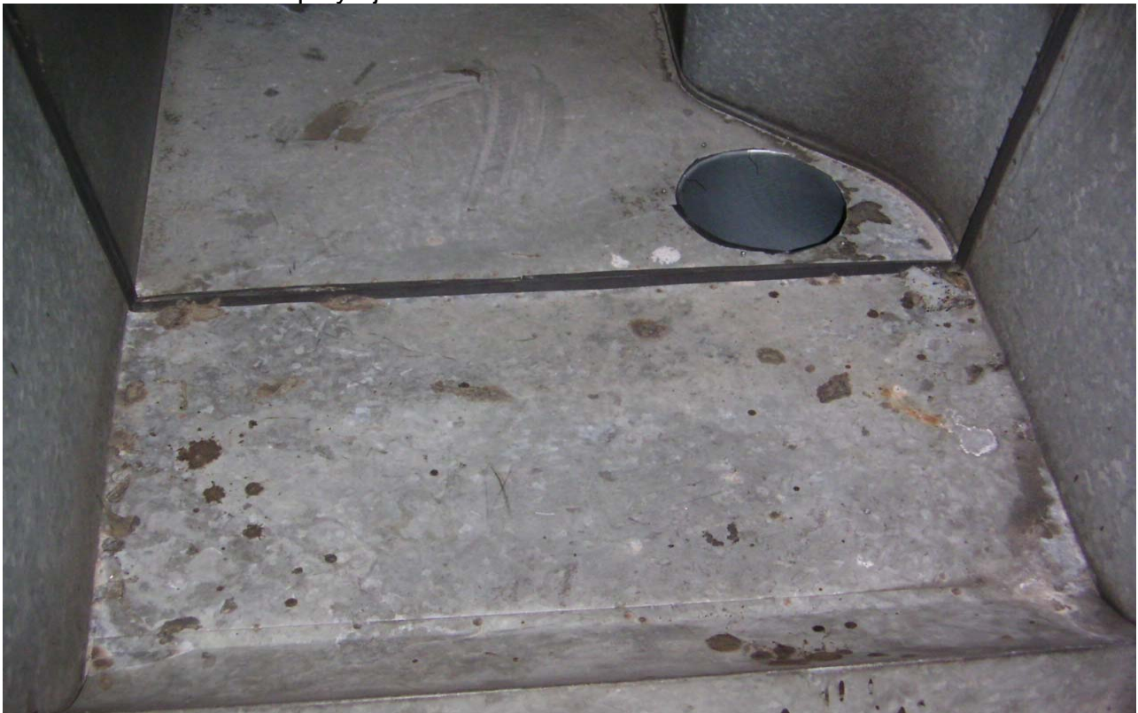
KUVA 2. Kanavissa on villapölyä ja rakennusjätettä.
