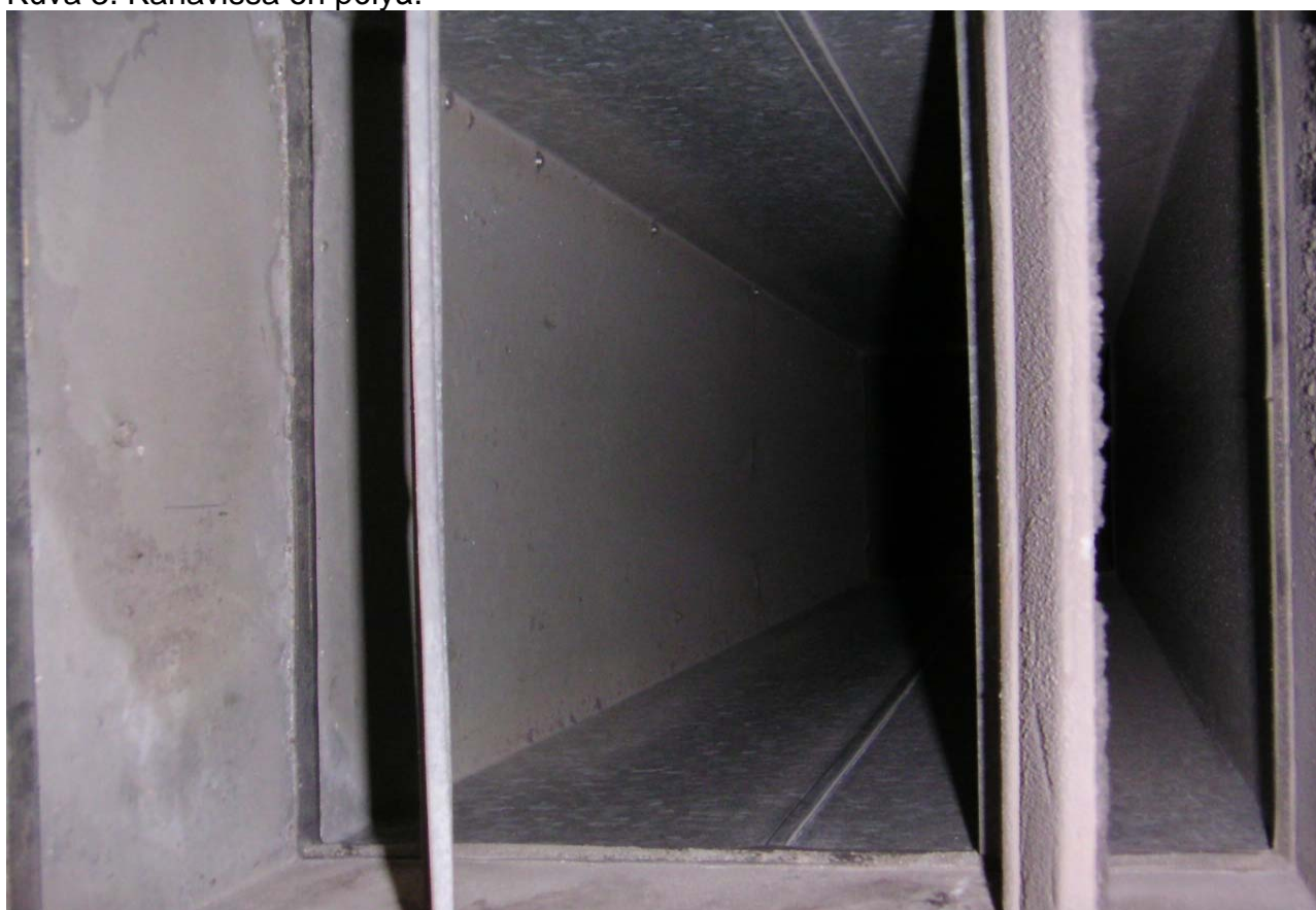
KUVA 4. Kanavissa on pölyä.
