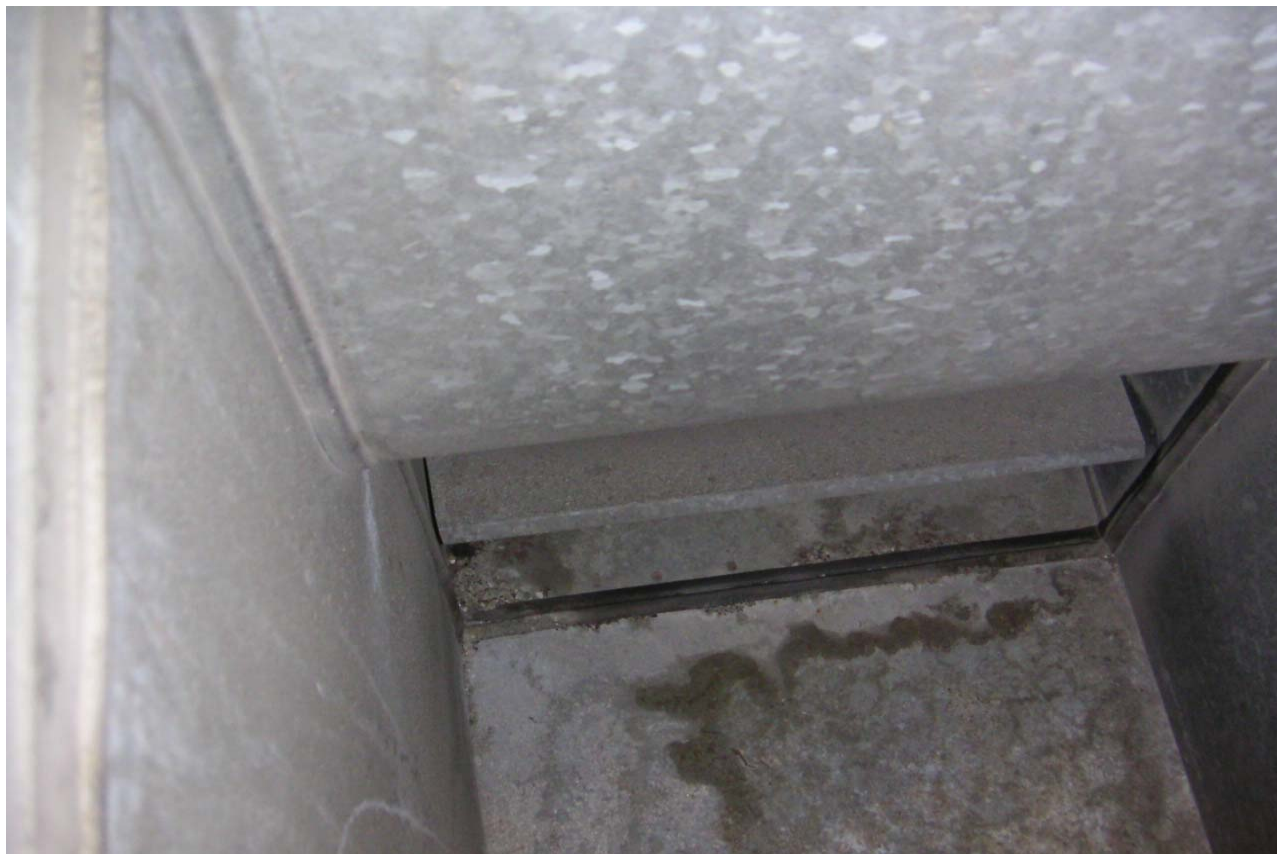
Kuva 3. Kanavissa on pölyä.
