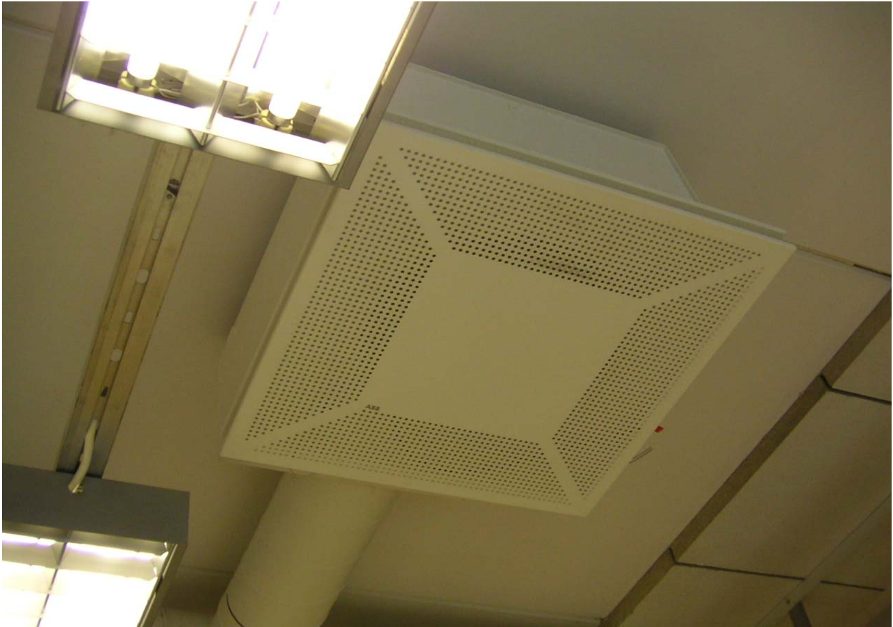
Kuva 5. Pääte-elimet ovat osin uusittuja.
