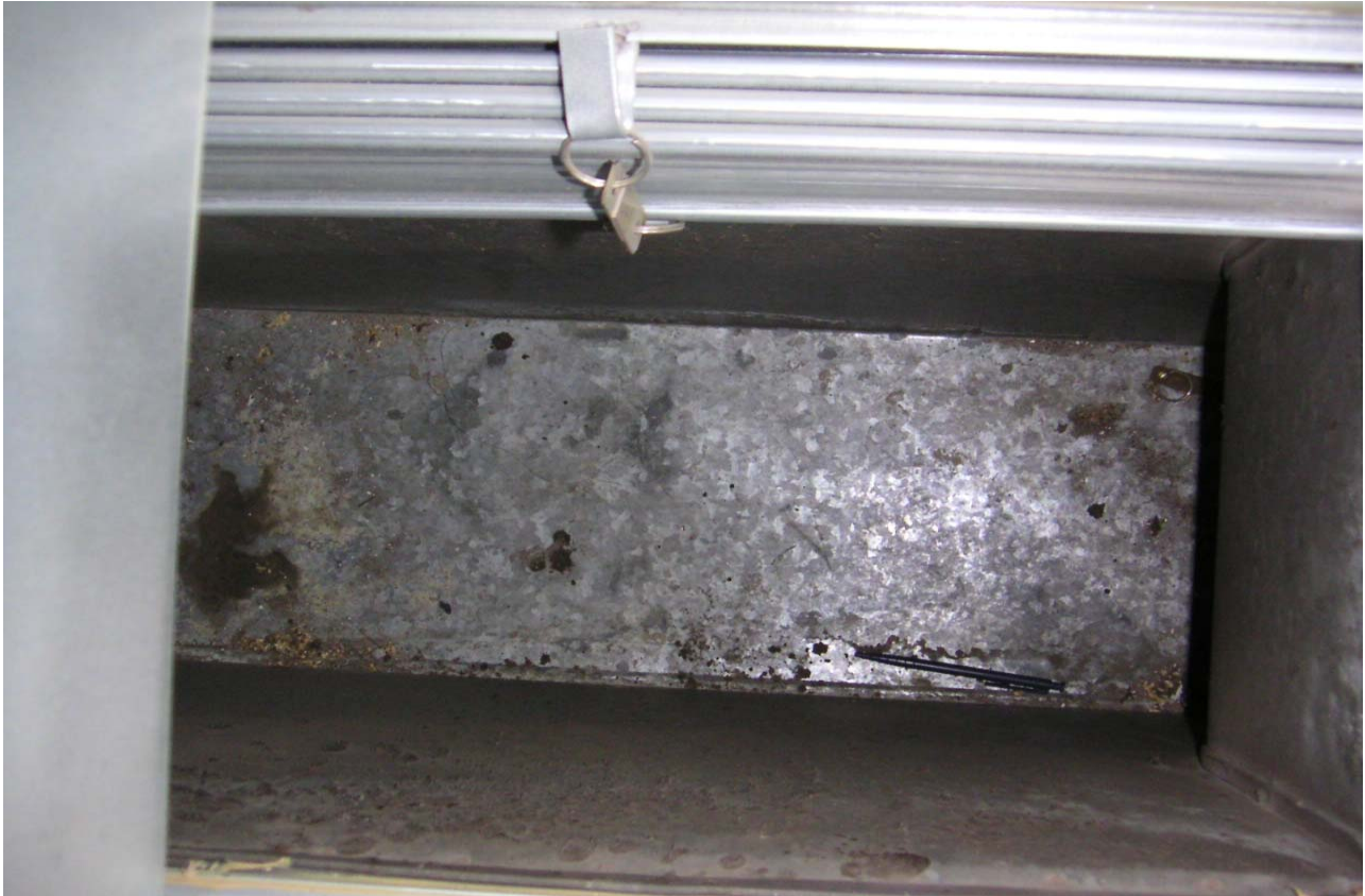
KUVA 1. Kanavissa on pölyä ja roskaa.
