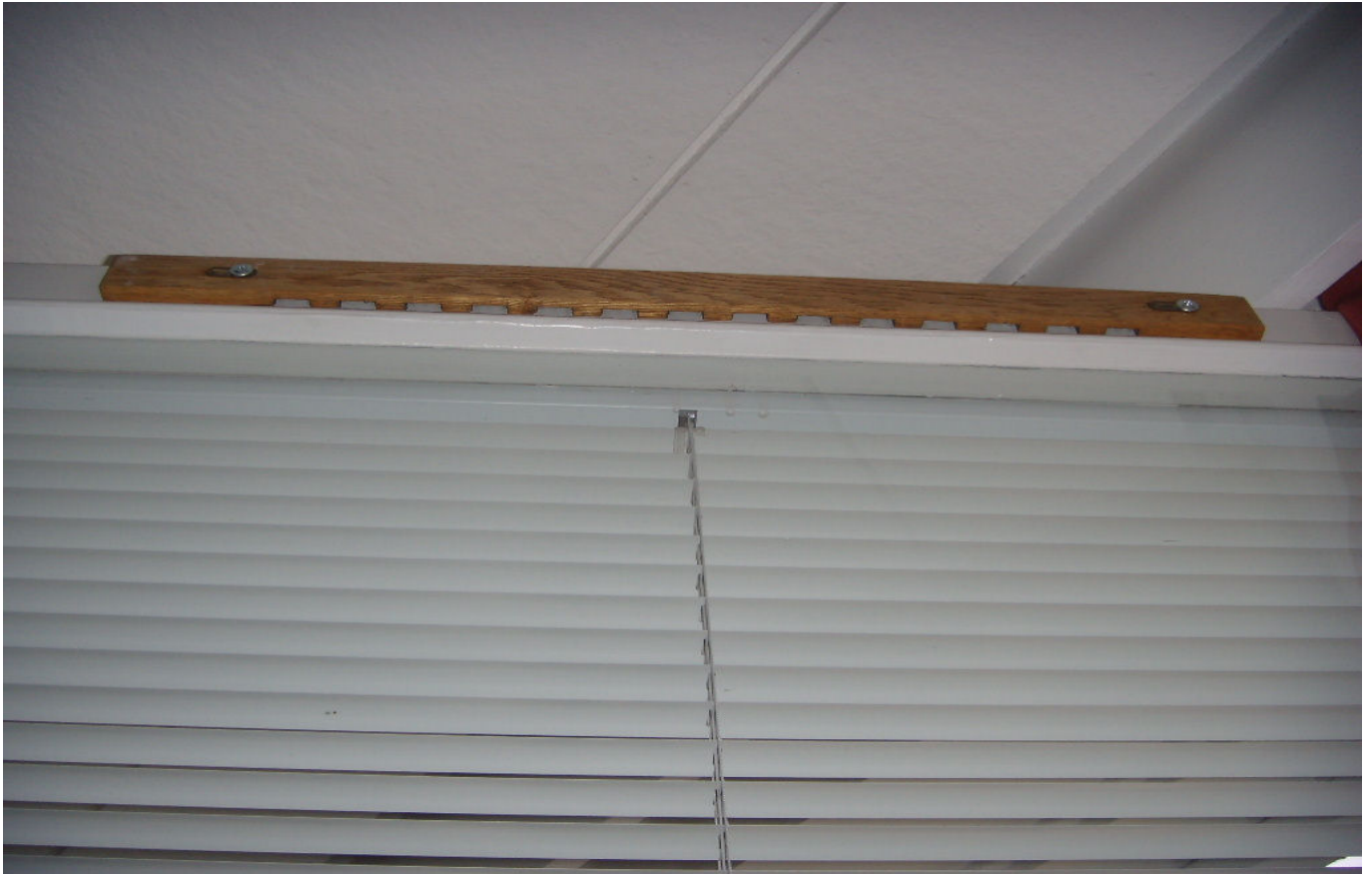
KUVA 11. Yleiskuva luokan korvausilmaventtiilistä.
