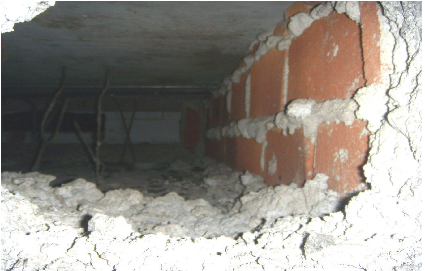
KUVA 9. Yleiskuva rakenneaineisesta tuloilmakanavasta.
