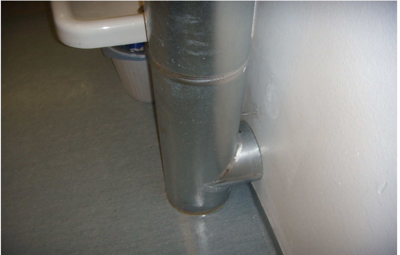
KUVA 13. Yleiskuva alustatilan poistoilmakanavasta.
