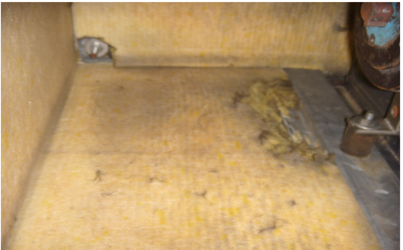
KUVA 4. Tuloilmakoneen villapinnat ovat paikoin kolhiintuneita.
