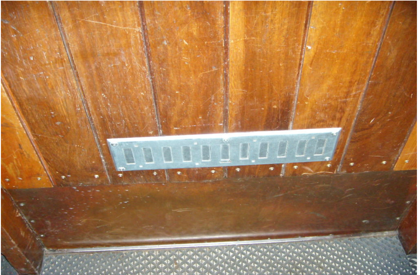
KUVA 15. Yleiskuva ulko-oven korvausilmaventtiilistä.
