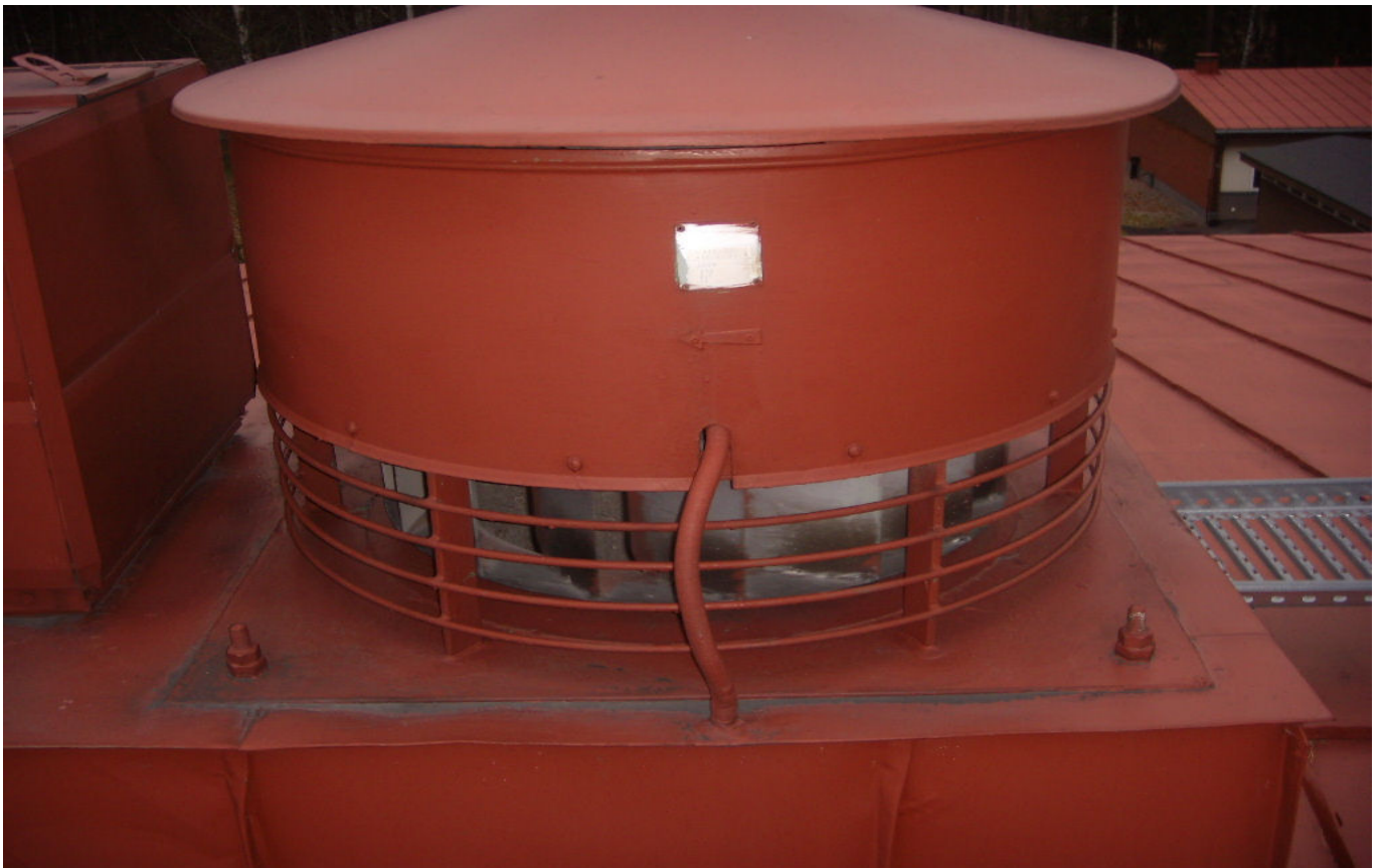
KUVA 6. Yleiskuva vesikatolla olevasta huippuimurista.
