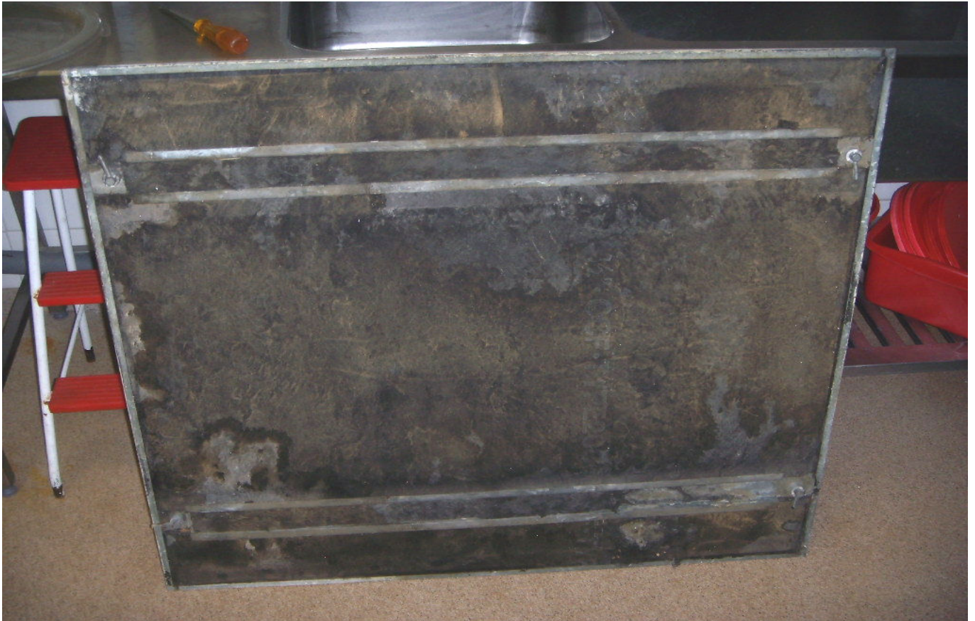
KUVA 5. Tuloilmakoneen villapinnat ovat paikoin kolhiintuneita.
