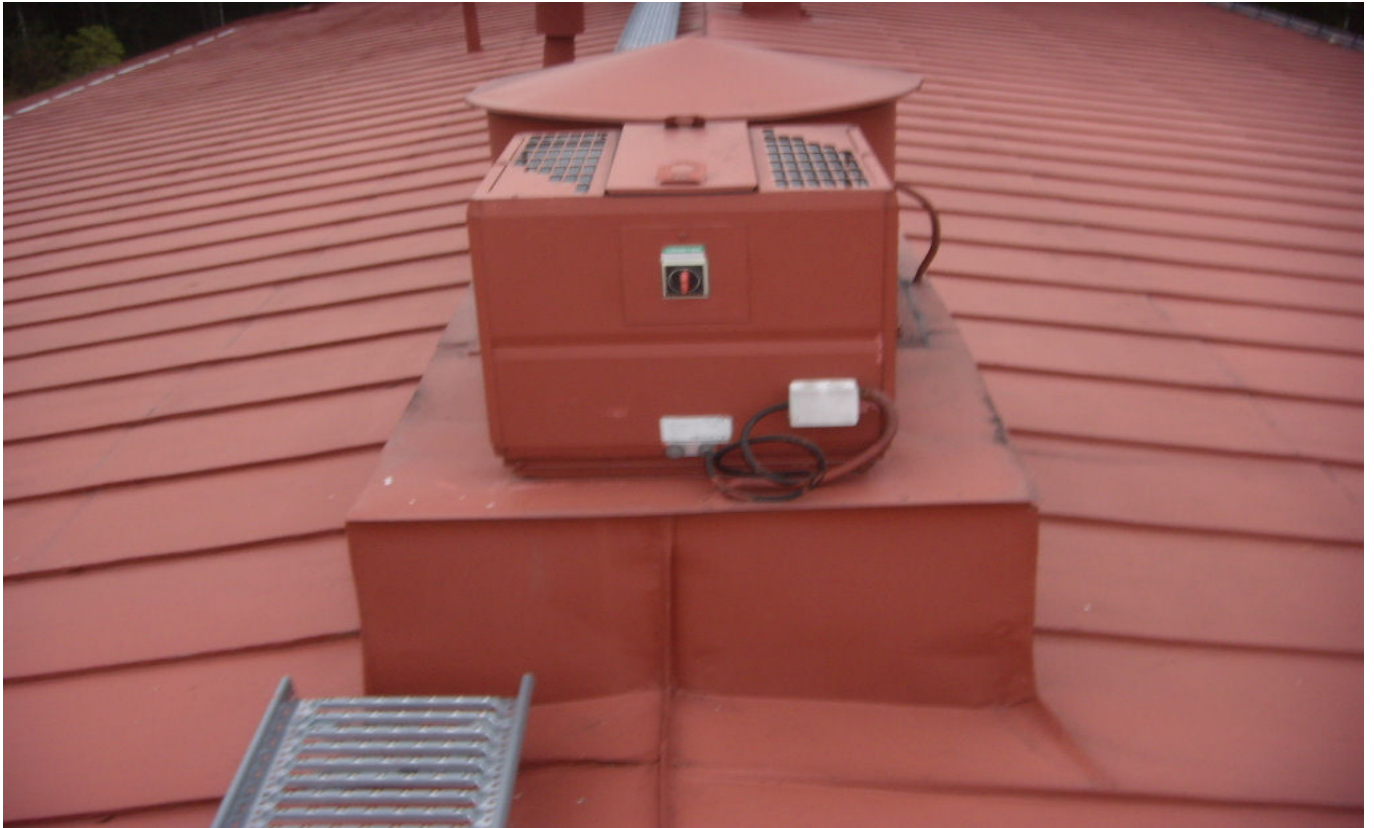
KUVA 7. Yleiskuva vesikatolla olevasta uusitusta huippuimurista.
