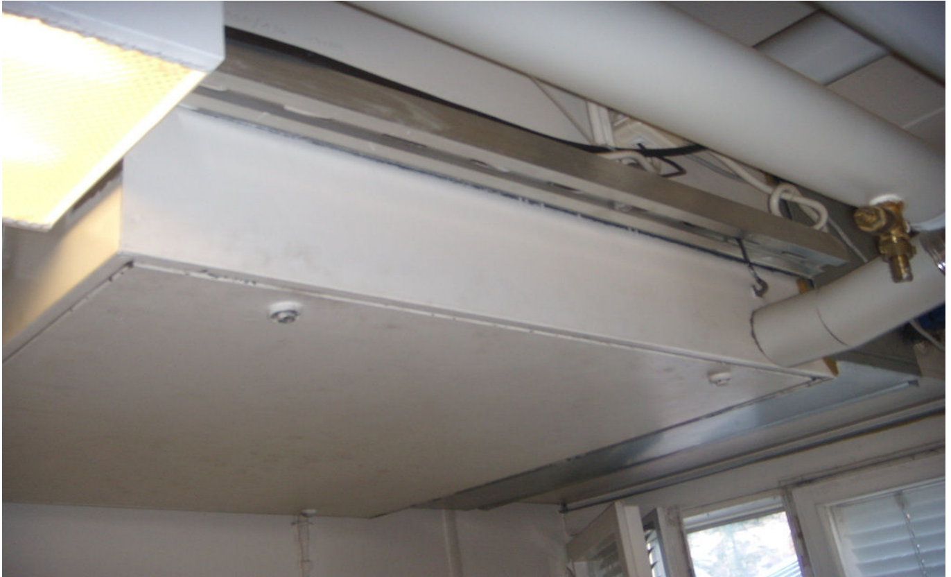
KUVA 1. Yleiskuva ruokalan tuloilmakoneesta.
