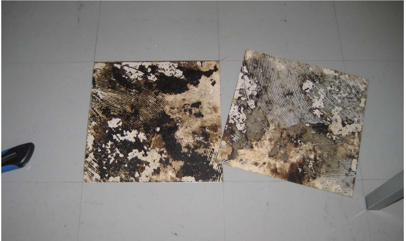
Kuva 6. Luokan 206 asbestivinyylilaatta. Laatta irtosi lattiasta helposti.
