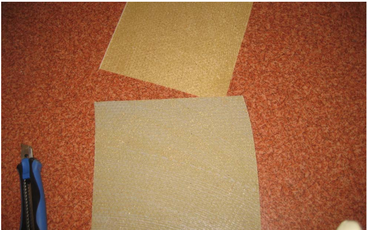
Kuva 2. Erityisluokan muovimatto, joka irtosi lattiapohjasta helposti ja kokonaisena.
