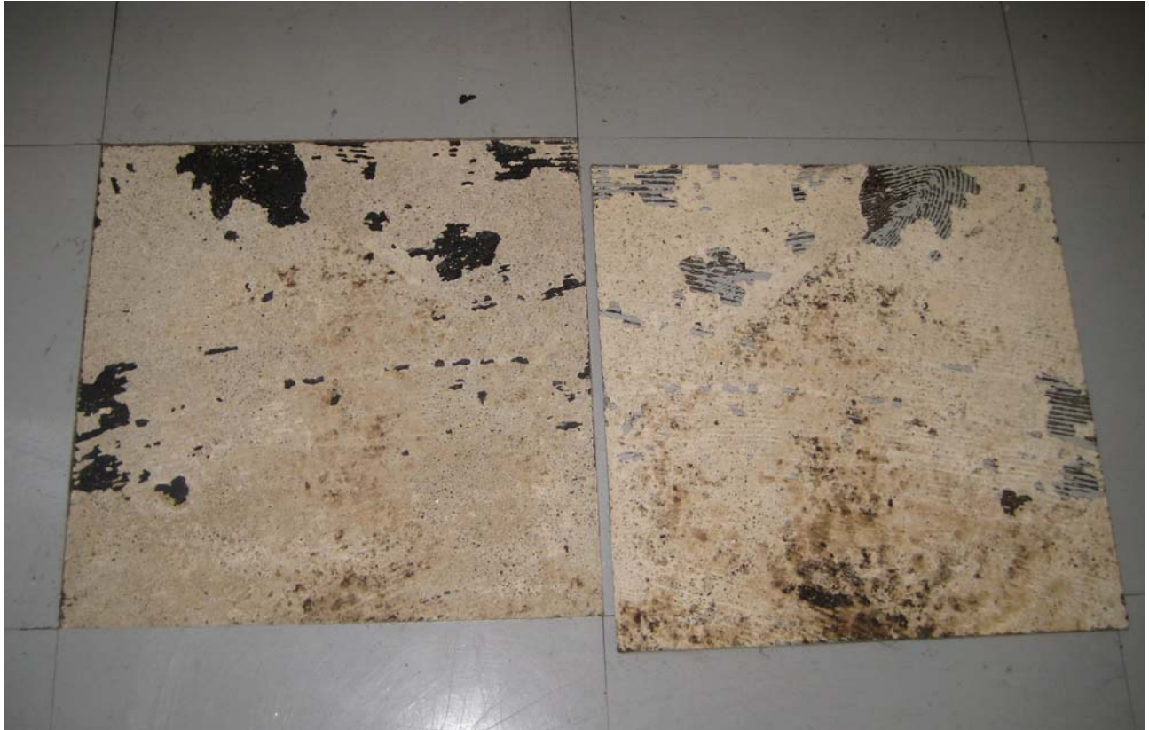
Kuva 7. Luokan 211 asbestivinyylilaatta, jonka alapinta näyttää vaurioituneelta.
