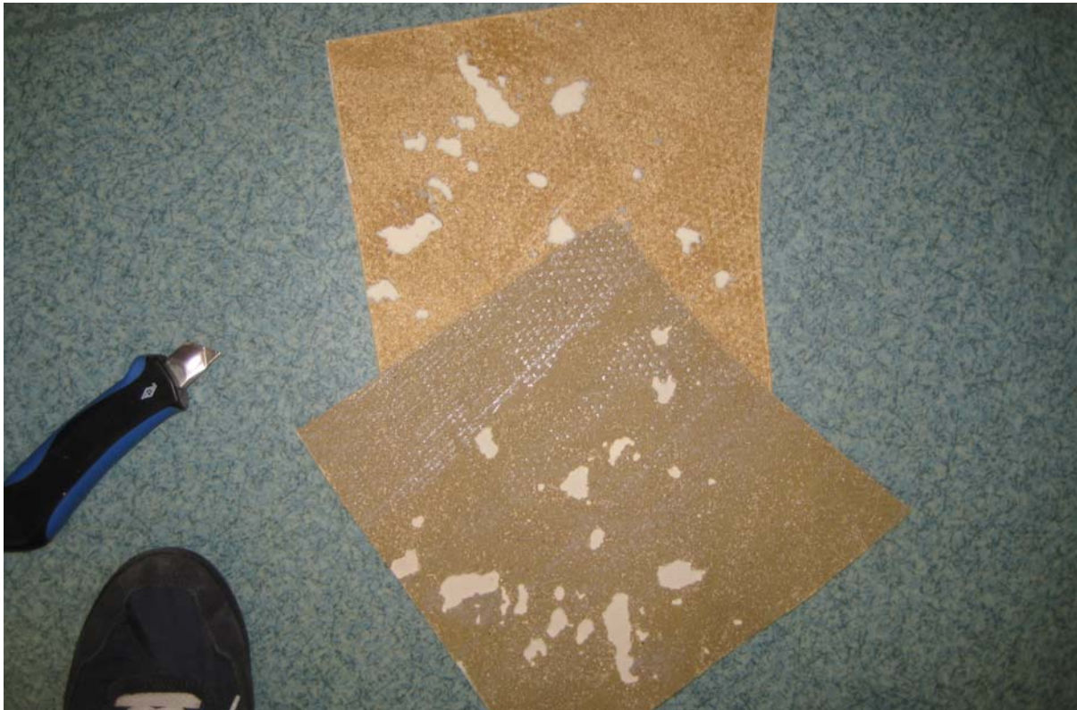
Kuva 1. Luokkahuoneen 1B muovimatto, joka oli kovaa kiinni alustassa ja osa muovimatosta jäi lattiaan kiinni.
