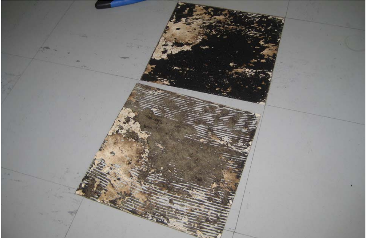
Kuva 5. Luokan 203 mustaliimalla kiinnitetty asbestivinyylilaatta. Laatan alapinnassa on havaittavissa mikrobivaurion jälkiä. Laatta irtosi lattiasta hyvin helposti.
