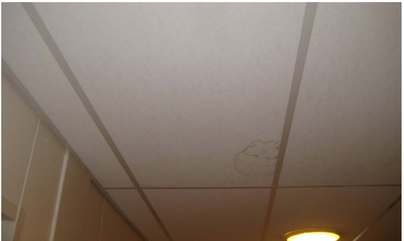
Kuva 8. Kosteusvauriojälki kattolevyssä. Kattolevyjen päällä oli höyrynsulkumuovi, jonka saumasta vesi oli mahdollisesti vuotanut.
