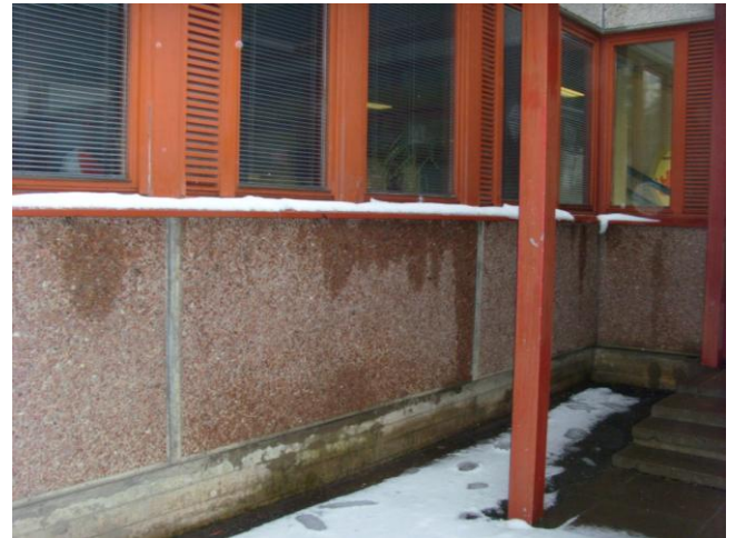
Kuva 4. Vuotavat pellitykset kastelevat seinäpinnat
