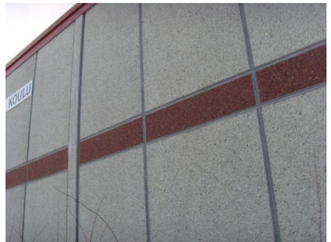
Kuva 5. Elementtisaumoista puuttuvat tuuletusputket
