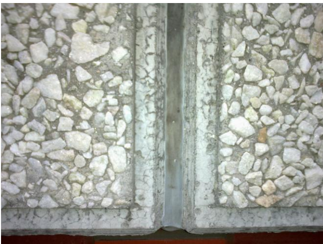
Kuva 2. Elementtien reunoilla on verkkohalkeilua
