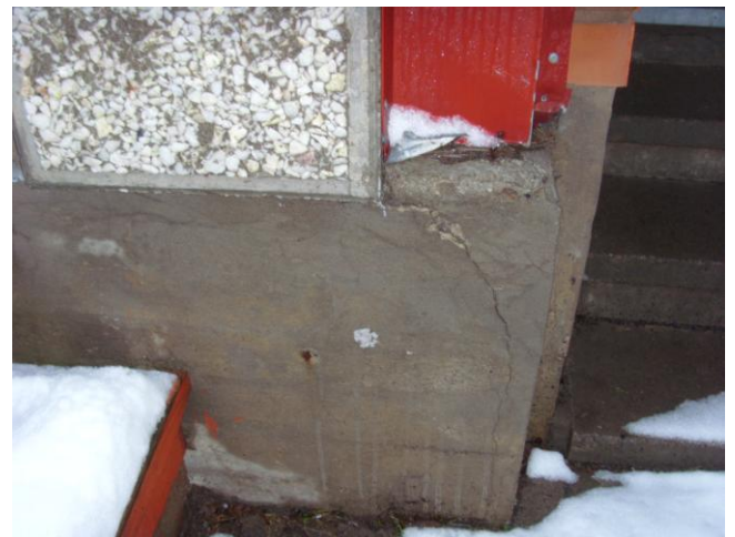
Kuva 6. Nurkan juuripelti on revitty pois, kertaalleen korjattu nurkka on rapautunut uudestaan
