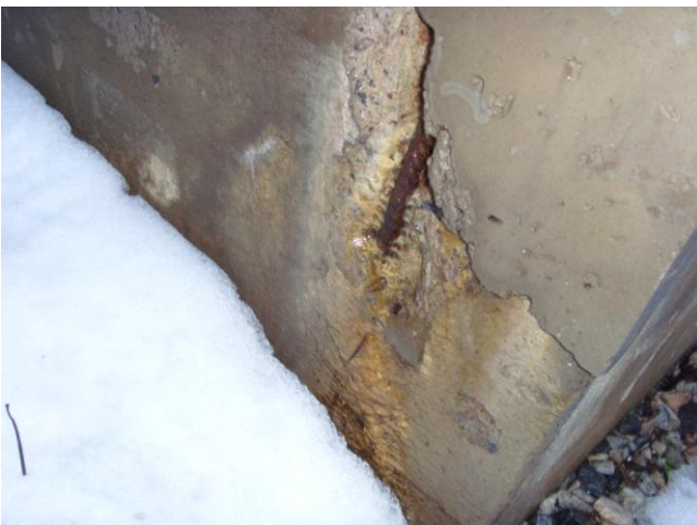
Kuva 9. Kosteuden aiheuttama kalkkisaostuma paikkauksen saumassa
