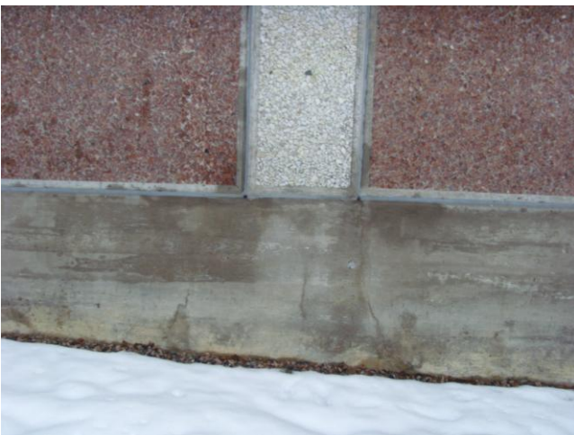
Kuva 8. Sokkelipinnoilla esiintyy halkeamia
