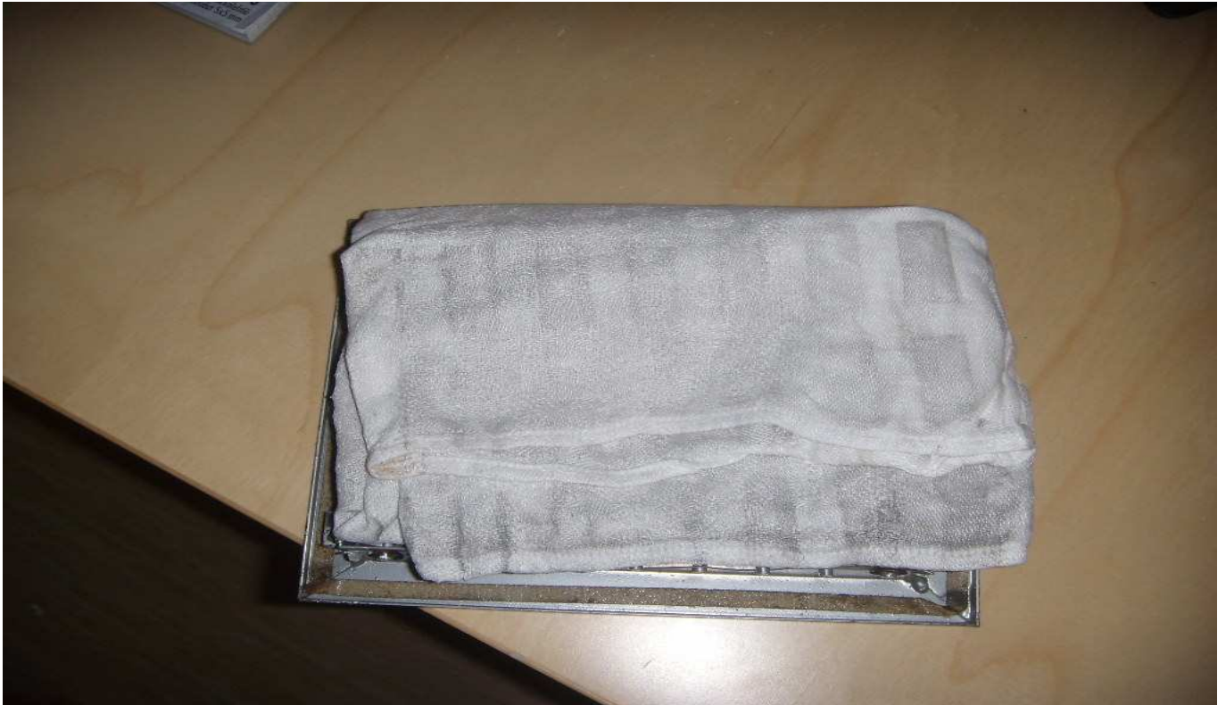
KUVA 1. Huoneen tuloilmaventtiili on tukittu pyyhkeellä.
