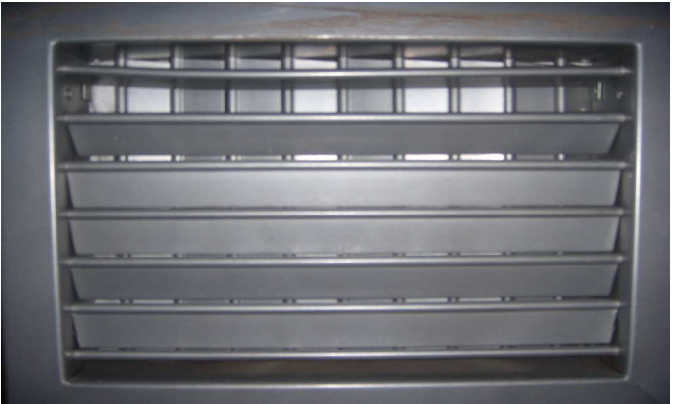
KUVA 2. Tuloilmaventtiin säädettävät ns. ritilät on suljettu.
