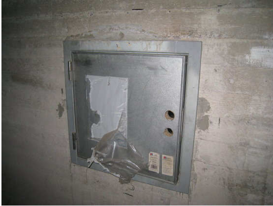
Kuva 1 Alustatilan lukkopesätön palo-ovi.
