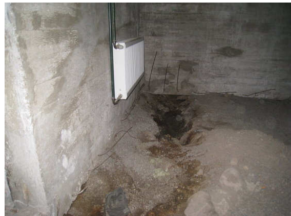
Kuva 6 Maapohjavarastossa kaivantoja, joissa täyttö kosteaa ja mikrobivaurioon viittaavaa kasvustoa. Tilassa on lämpöpatteri.
