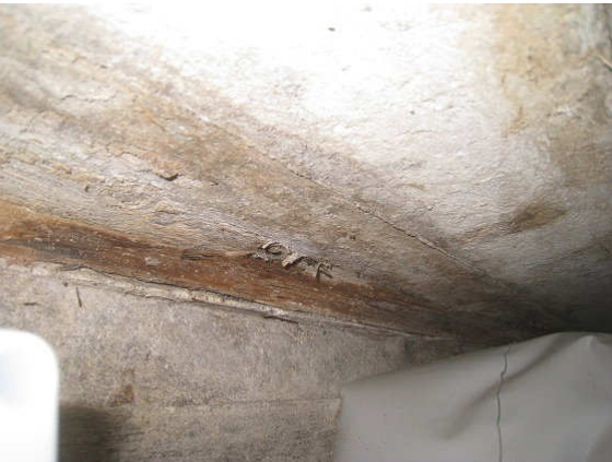
Kuva 9 Seinä- ja kattopinnan yhtymäkohdalla kosteus- ja mikrobivaurioitunutta muottilaudoitusta.
