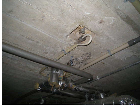
Kuva 14 Myöskään vanhoja sähköläpivientejä ei ole tiivistetty.
