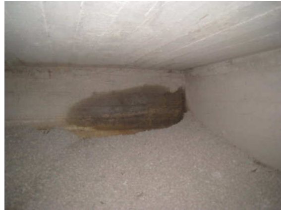
Kuva 4 Onkalon suuaukon yläpuolen betoni kosteaa kondenssista johtuen.
