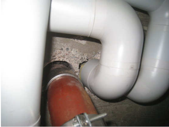
Kuva 13 Välipohjan läpivientejä ei ole tiivistetty.
