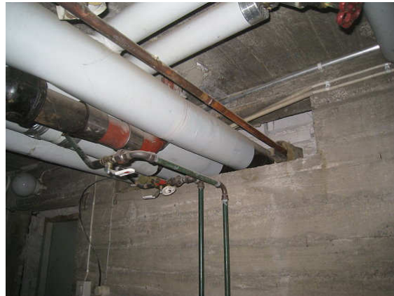
Seinän läpivientiä ei ole tiivistetty.
