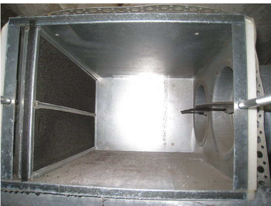
Kuva 11 Koneen lämmitysyksikön pohjalla ruostehilettä.
