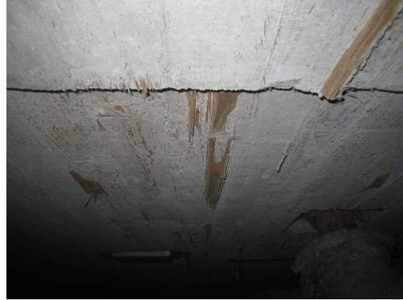
Kuva 8 Kattopinnassa monin paikoin muottilaudan kappaleita.
