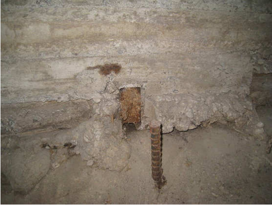
Kuva 7 Kosteus- ja mikrobivaurioitunutta alasideputta.
