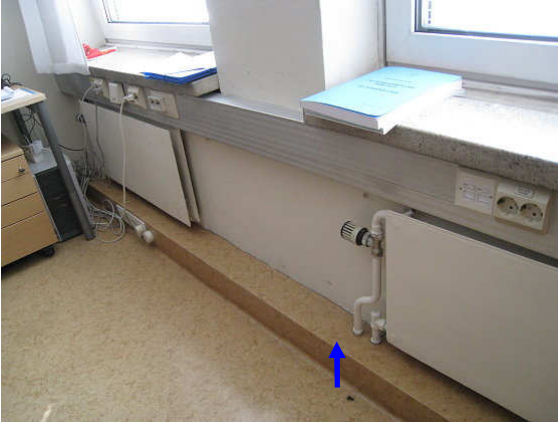
Kuva 5 1.kerros huone 604. Reikä lattiasa. Ilmaa virtaa voimakkaasti kellarikerroksesta. Kotelorakenne on kiviainen.
