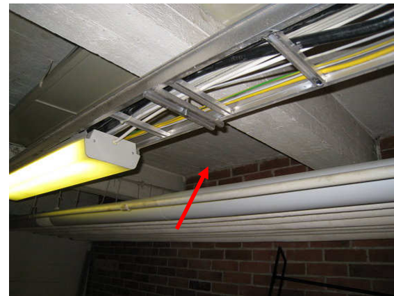
Kuva 4 Tilassa 014 läpäreikä 1.kerroksen huoneeseen 604. Voimakas ilmavirtaus.
