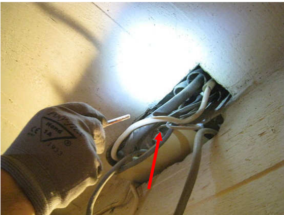
Kuva 7 Sähköputkien läpiviennissä havaittiin ilmavirtausta rakenteeseen päin.
