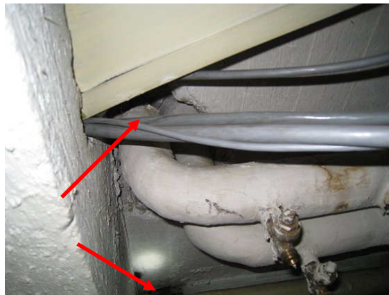
Kuva 3 Tiivistämättömiä putkiläpiviennitejä akkuhuoneessa, joista ilmavirtaus 1.kerroksen suuntaan. Putkissa on asbestia sisältävät eristeet.
