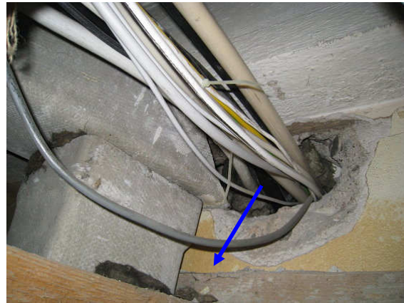
Kuva 2 Tilan 021 viereisessä akkuhuoneessa asbestisementtistä tuloilmakanavaa.
