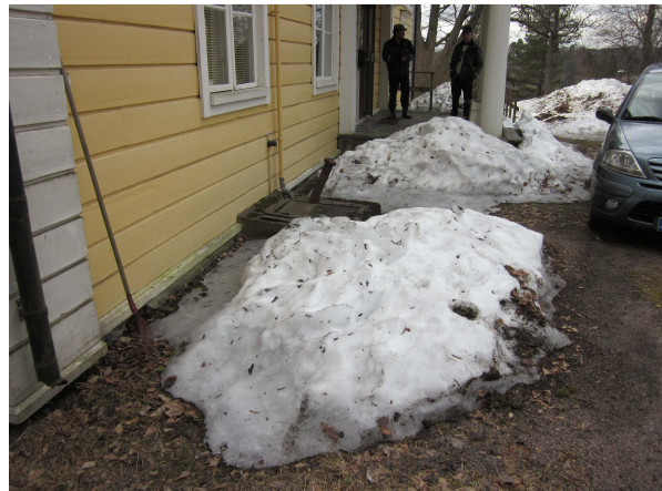
Kattovedet valuvat syöksytorstista rakennuksen vierustalle
