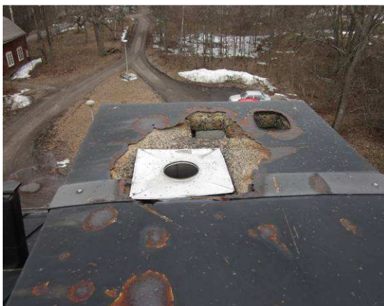
Hormien päällä ei ole suojahattuja
