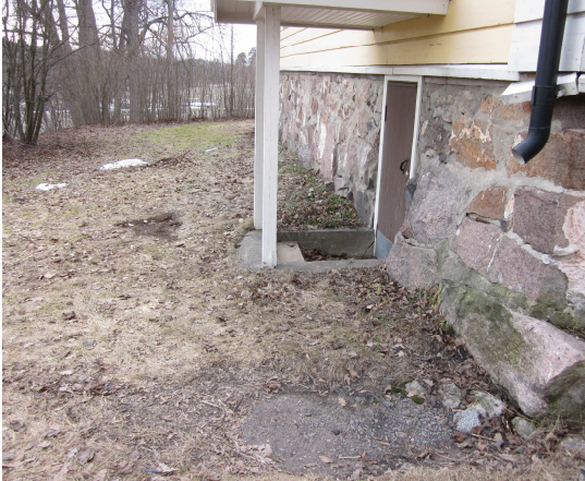
Kuvaa rakennuksen takapihalta, maanpinta kallistaa pois rakennuksesta
