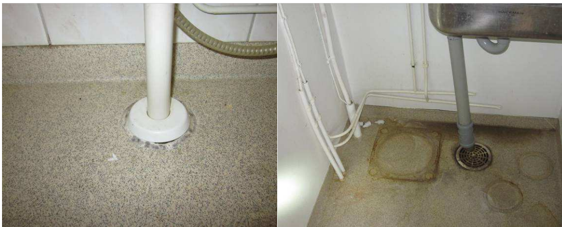
Puutteellisesti tiivistetystä läpivientikohdasta vesi on päässyt rakenteisiin, kohdassa aistittavissa mikrobiperäinen haju
