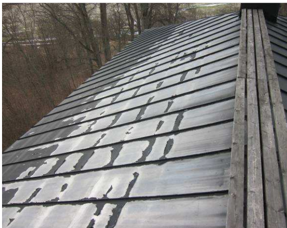
Yleiskuvaa vesikatolta. Maalipinnoite irronnut pahoin etelän puolelta
