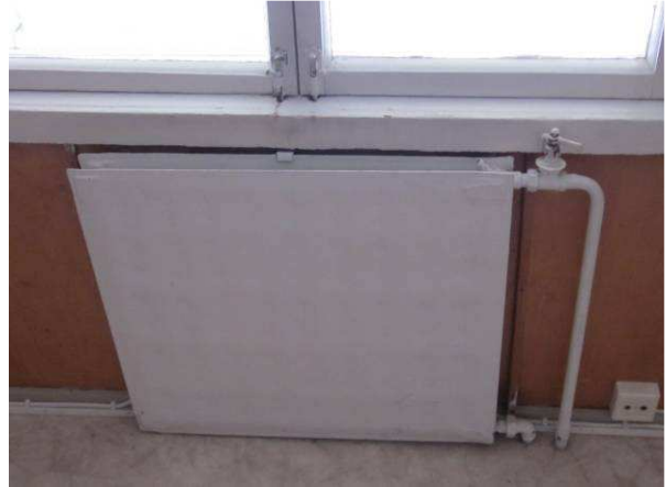
Alkuperäinen patteriventtiili, pattereiden kannakkeet laajasti irti
