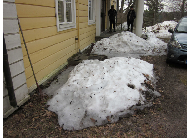
Etupihalla maanpinta kallistaa pahoin rakennuksen suuntaan
