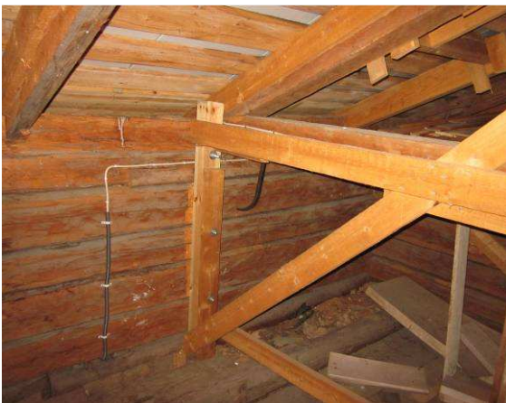
Hirsirungon yläpään leviäminen on estetty pulttaamalla ja lisätuilla
