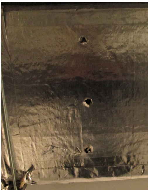
Kuva 3. IV-kanavassa reikiä. Reikiä havaittiin lukuisissa kanavissa IV-konehuoneissa.
