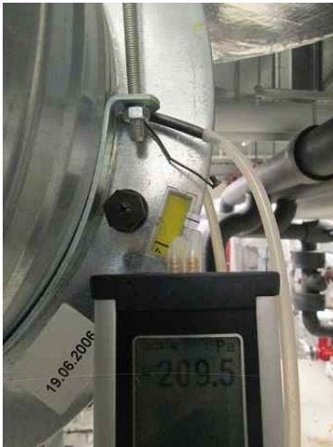
Kuva 5. Pienikin pellin säätö-arvon heitto muuttaa ilmamäärän tulkitsemista. Tämän vuoksi mittauksilokset runkokanavista on annettu 100 l/s tarkkuudella. Kuvan säätöpellin arvoksi oletettu 7-8 väli
