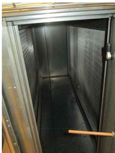
Kuva 1. TK12 Lämmityspatteria edeltävä tila oli hyvässä kunnossa ja toiminta moitteetonta.
