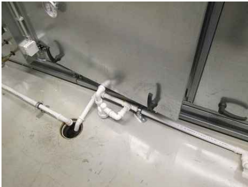
Kuva 2. TK21 levylämmönsiirtimen alaluokku ei auennut täysin muoviviemäröinnin ollessa asennettuna liian korkealle.
