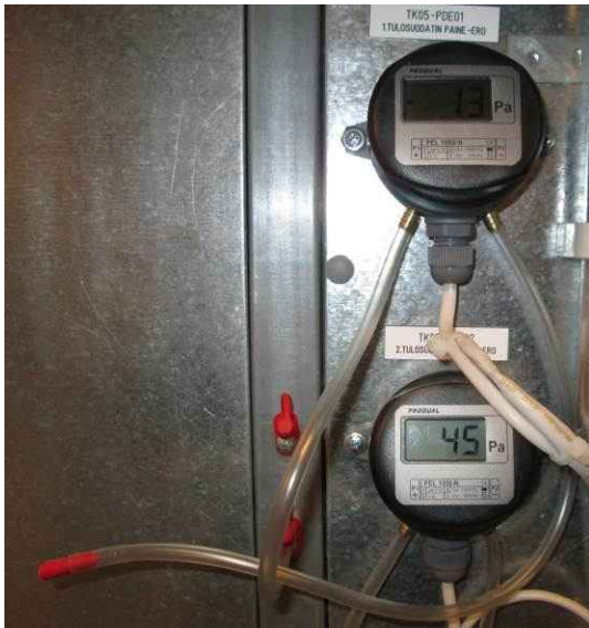
Kuva 15. TK5 tulosuodattimen paine-eromittauksen mittayhde katkennut.
