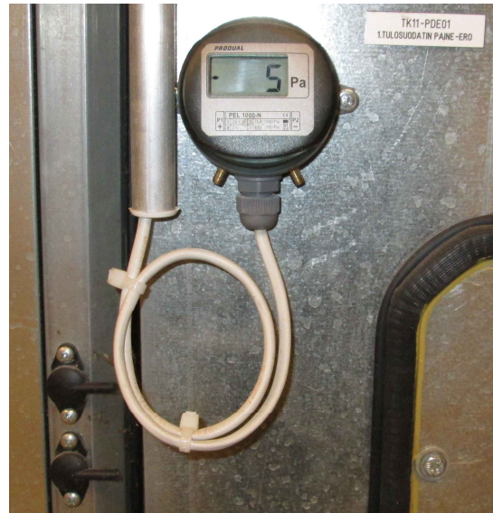
Kuva 16. TK11 tulosuodattimen paine-eromittauksen letkut kytkemättä.
