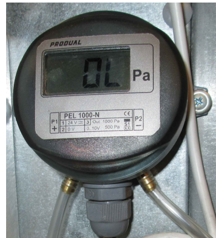
Kuva 18. TK4 tulopuhaltimen yli oleva paine menee yli lähtetimen asteikon. Sama tapahtuu myös poistopuhaltimen mittauksessa.
