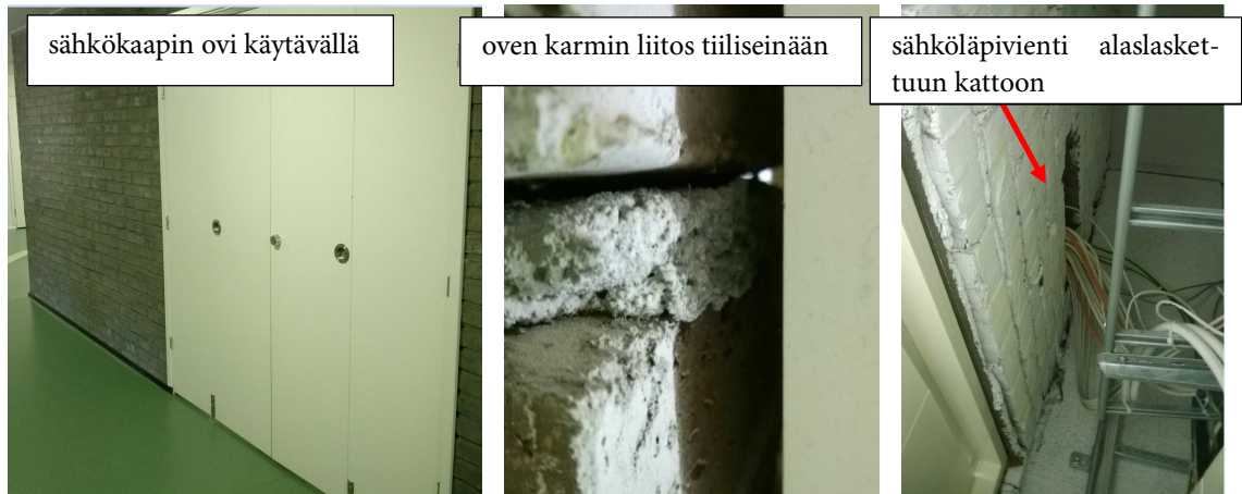
Kuvat 14–16. Alakoulun käytävällä olevan sähkökaapin rakenteet eivät ole ilmatiiviit. Keskellä esitetty oven karmin liitos tiiliseinään ja oikealla sähköläpivienti.
