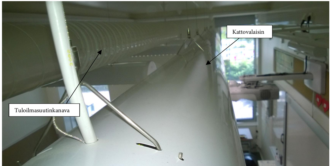
Kuva 40. Luokkatilojen tuloilmanvaihto ja valaisimet luokkatilan 2.088 katon rajassa.
