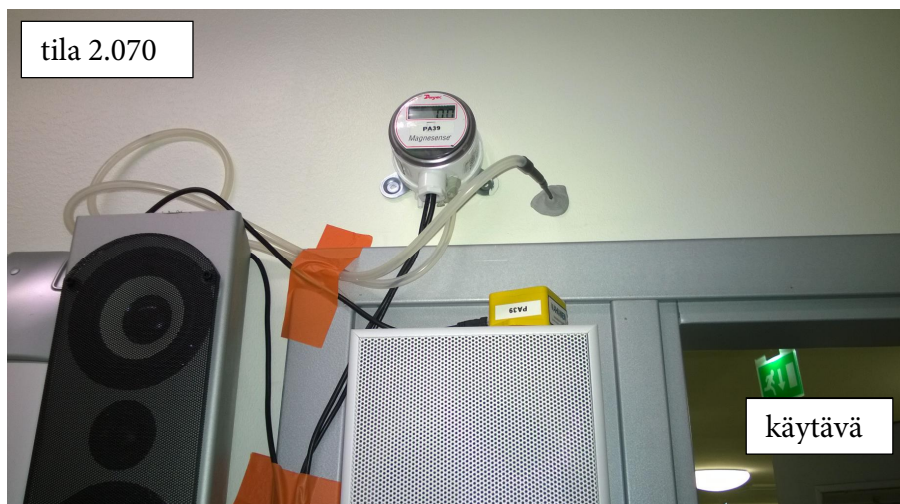
Kuva 13. Esimerkki paine-eromittauksesta tilan 2.112 ja viereisen käytävän välillä.
