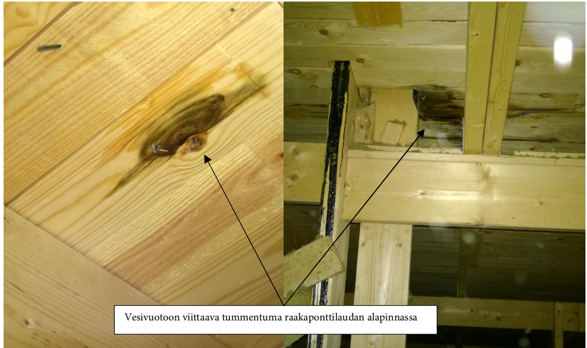
Kuvat 42–43. Ullakkotilassa havaittiin kosteusjälkiä raakaponttilaudan alapinnassa. Sijainnit on esitetty liitteessä 3.
