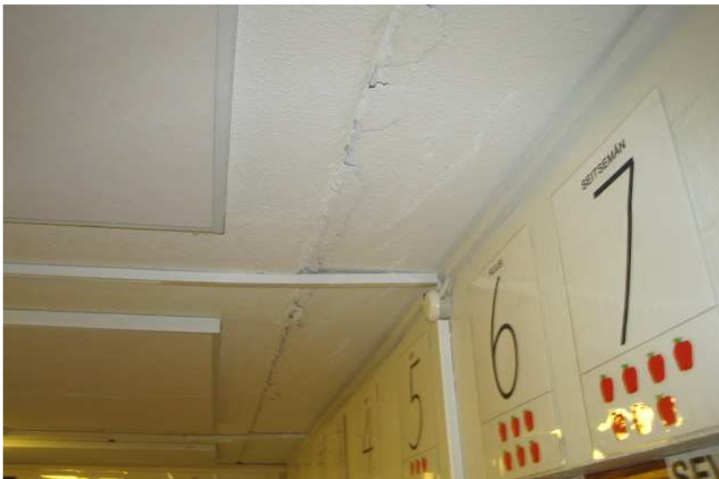
huoneessa 206 vanhoja nyt kuivia vauriojälkiä katossa
