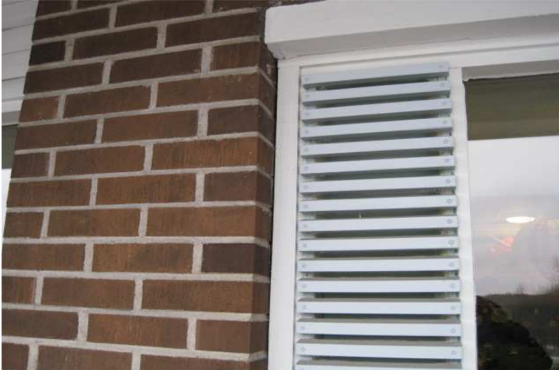
huoneen 108 ikkunan pielet tiivistämättä, raosta näkyy seinän eristeet
