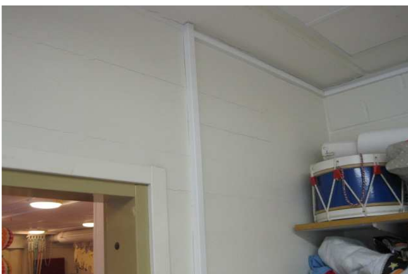
huone 216 verstaas, katossa vauriojälkiä sekä tiiliseinässä pinnoite halki tiilien kohdalta, seinävaurioiden syy todennäköisesti toiselle puolelle kiinnitettyjen seinä sänkyjen asennus
