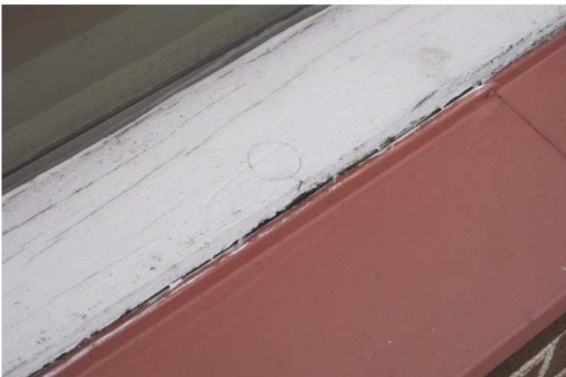
ikkuna pelleissä vuotokohtia
