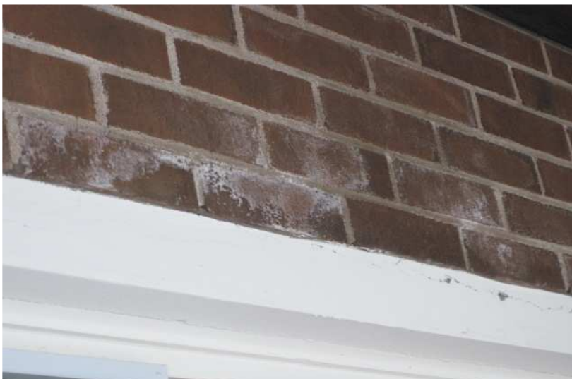
tiilet vesimärkiä, betonista irtoaa maali
