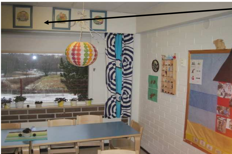
huone 108 rakenteet sisäpuolella mittauksin kuvia, kastunut alue nuolen kohdalla ulkopuolella
