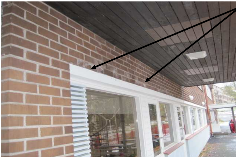
huoneen 108 kohdalla ikkuna yläpuoleiset tiilet sekä betonivalu märkää
