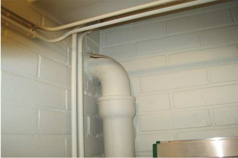
siivouskomoero huone 129 viemärin runkolinjassa vaurio
