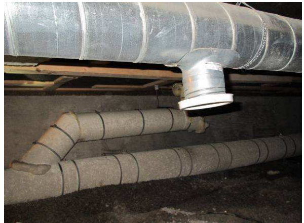
Alapohjatilan ilmanvaihto ei ollut kohdekäynnin aikana toiminnassa
