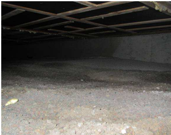
Sepelitäytön pinnassa hieman kosteutta alapohjatilassa
