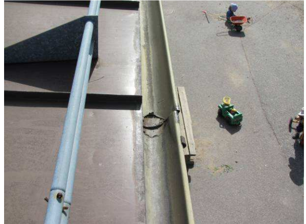
Räystäskouru vuotaa sisäpihan puolella
