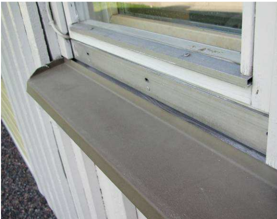
Ikkunapellitykset on toteutettu puutteellisesti
