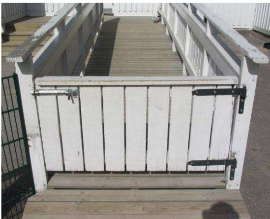
Puukaiteissa on huoltomaalaus ja kunnostustarvetta
