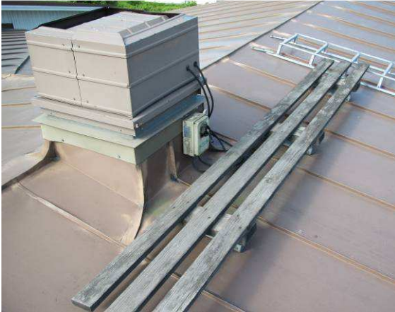
Puukattosilta on käyttöikänsä päässä
