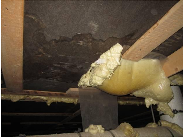
Kuva 21 Vanhoja vuotojälkiä Tk/ märkäeteinen 1 lattiakaivon luona. Muottina on käytetty muovikelmua.
