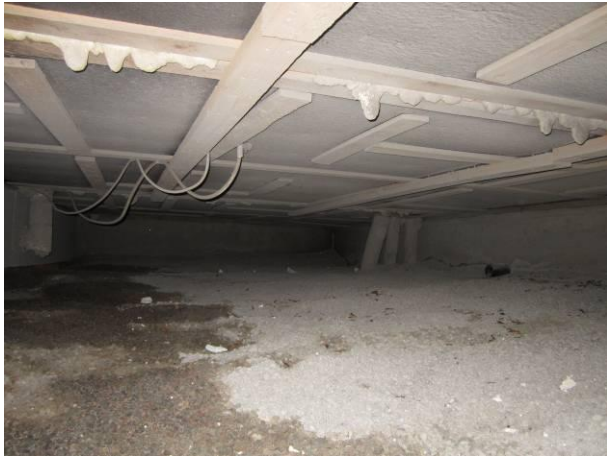
Kuva 15 Kosteudesta tummunutta sepeliä.
