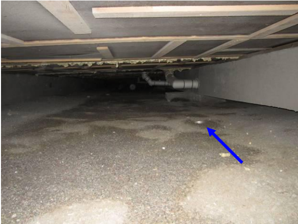
Kuva 3 Länsilohkon Vihertien puoleinen alustaontelo, jossa on salaojan tarkastusputki. Pohjasepelissä on hieman kasvustoa ja kosteuden takia tummumia.
