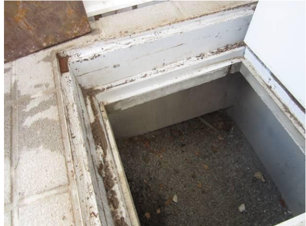
Kuva 12 Sisäänkäyntitason alaluukku on ok.
