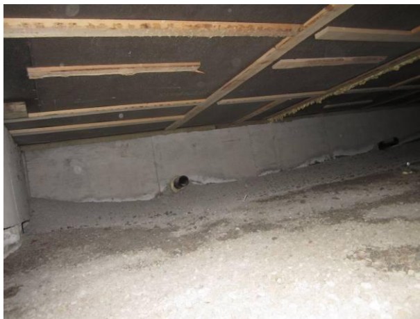
Kuva 9 Korvausilmaputkia sokkelipalkin ali. sokkelipalkit olivat pinnasta kuivia.
