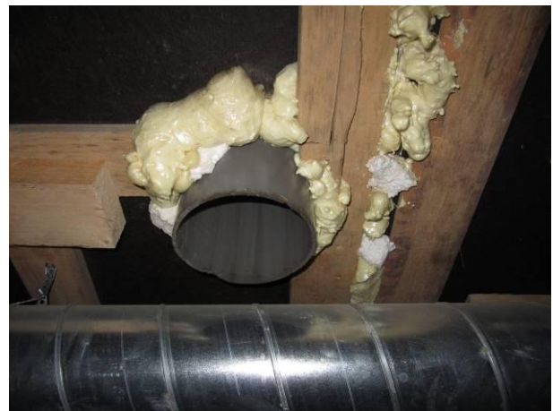
Kuva 10 Nivelalueen painovoimainen poistoilmaputki suoraan vesikatolle.
