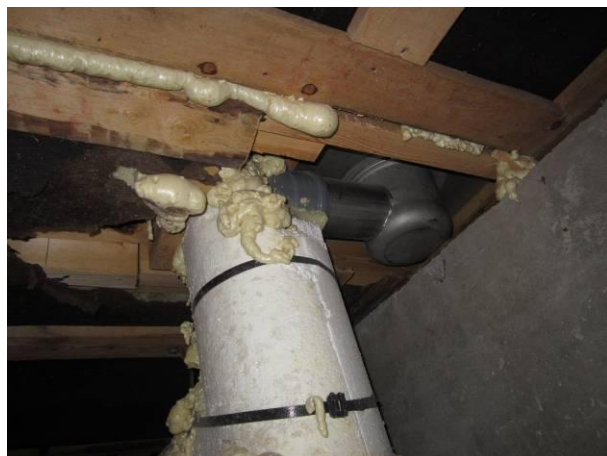
Kuva 19 Tuulisuojalevy rikki, eristeitä puuttuu, taustalla eristämätön rst-kaivo.
