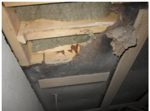
Kuva 20 Repeytynyt tuulisuojalevy, eristeitä puuttuu.
