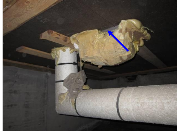
Kuva 22 Puutteellinen eristys rst-kaivon sivulla, Tk/ märkäeteinen 8
