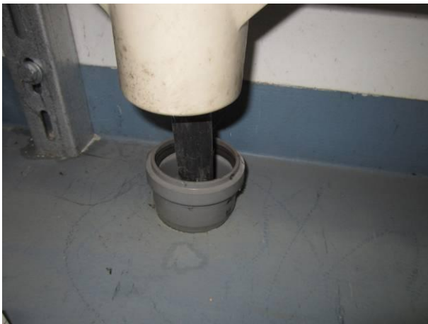
Kuva 13 Sähkökaapelin tiivistämätön läpivienti.
