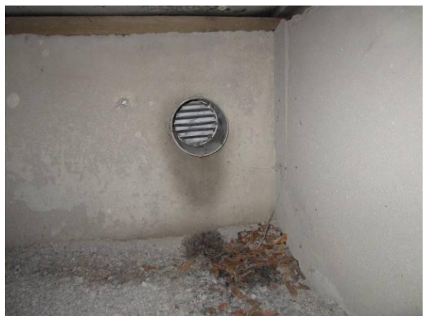
Kuva 6 Sokkelin venttiili oli tukossa lumen takia.
