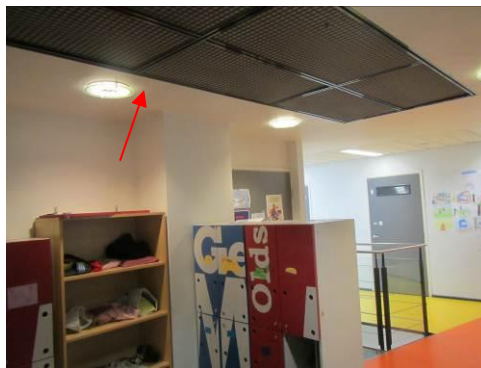
Kuva 12. Aulatilasta 2.31 alakatossa vesivuotojälkiä.
