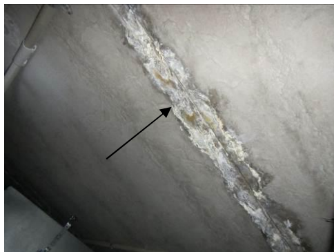
Kuva 45. Ontelolaattojen saumoista on ollut vesivuotoja.
