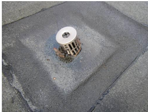
Kuva 26. Kattokaivojen siivilät ovat vain yksinkertaisia, mikä aiheuttaa helposti kaivojen tukkeutumista.
