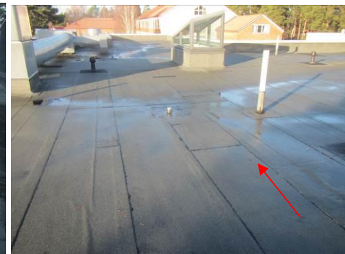
Kuva 25. Vesi lammikoituu katolle, joten kallistukset ja vedenpoisto katolta on puutteellinen.
