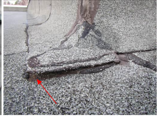
Kuva 23. Bitumikermissä on saumojen halkeilua/avautumista.
