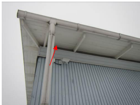
Kuva 72. Yläpohjan tuuletusaukot noin 50 mm on varustettu asianmukaisesti lintuverkoin.
