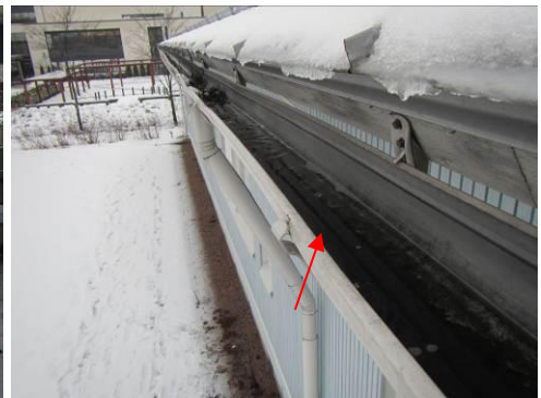
Kuva 75. Sadevesikourut ovat tukossa.
