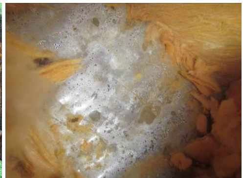
Kuva 33. Muovikalvon alla on kosteutta.
