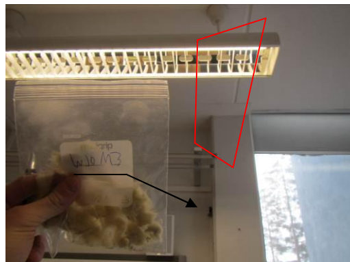
Kuva 16. Tilan 2.13 vesivuotokohdan (punainen raja) alapuolelta ulkoseinän eristevillasta otettiin yksi mikrobinäyte WJO M3.
