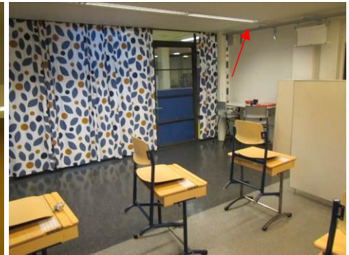
Kuva 6. Poistoilmaventtiilit sijaitsevat sisäänkäynnin vieressä alakatossa.
