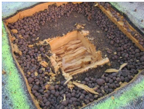
Kuva 30. Rakenneavaus RAK2. Mineraalivilla on avauskohdassa kostea.
