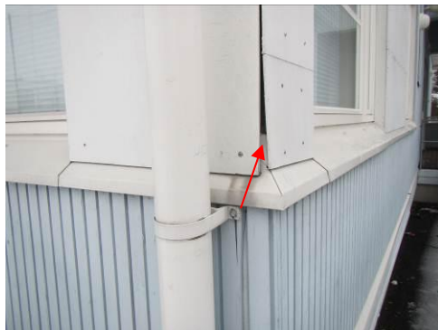
Kuva 74. Yksittäinen vaurio julkisivussa.
