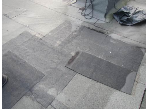
Kuva 22. Yksi vesikaton lukuisista paikatuista kohdista.
