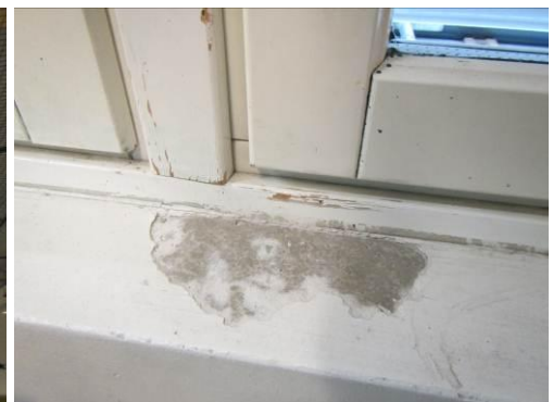
Kuva 10. Ikkunarakenteista on ollut vesivuotoja.
