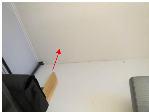
Kuva 3. Katossa pieniä tasoitevaurioita. liittymissä on halkeilua.
