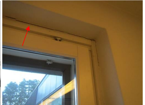
Kuva 8. Myös ikkunaliittymissä on epätiiviyyskohtia.
