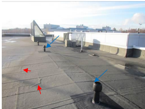
Kuva 18. Vesikaton bitumikermissä on paljon poimuuntumista. Poimuuntuminen johtuu paikoin mahdollisesti siitä, että kosteutta on päässyt kermin alle.
