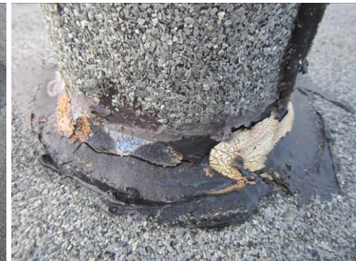
Kuva 27. Läpivienneissä on epätiiviyyskohtia.
