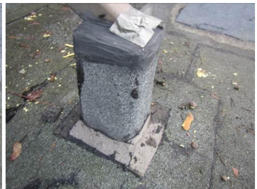
Kuva 21. Vesikatetta on jouduttu paikkaamaan myös mm. läpivientien kohdilta.
