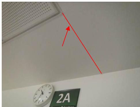
Kuva 14. Alakatossa näkyy maalausra- joja. Osa alakatosta on ilmeisesti korjattu/uusittu.
