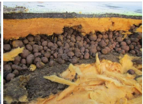
Kuva 31. Kevytsorakerroksen paksuus avauskohdassa RAK2 vain 50 mm.
