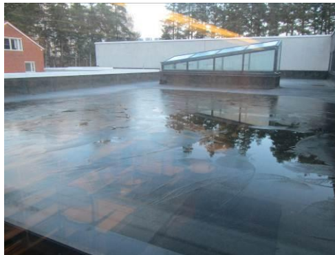
Kuva 24. Kattokaivojen tukkeutumisen aiheuttamaa veden patoutumista.
