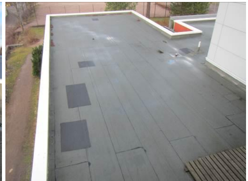
Kuva 19. Vesikatetta on jouduttu paikkaamaan monin paikoin ilkeivallan aiheuttamien vuotojen vuoksi.
