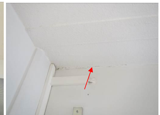
Kuva 4. Katon rajassa halkeilua/ epätiiviyyskohtia.
