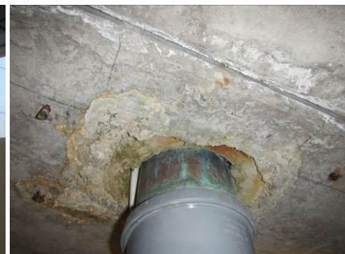
Kuva 51. Kattokaivon kohdalla ollut vesikattovuotoja.
