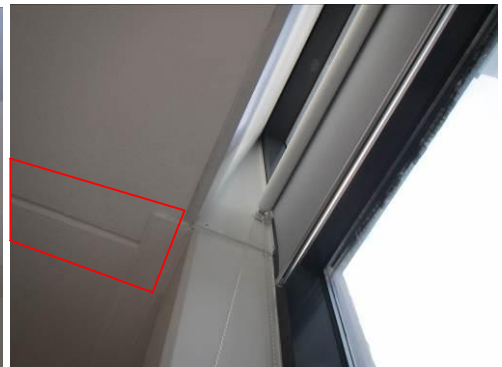
Kuva 2. Katossa on ollut vesivuotoja. Vuotojäljet on paikattu. Saatujen tietojen mukaan vuotoja on ollut useasti.
