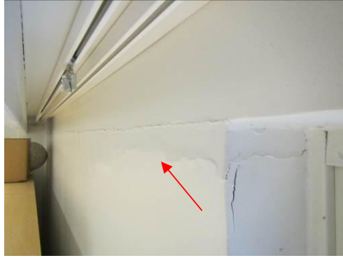
Kuva 11. Ulkoseinässä on halkeama- vaurioita
