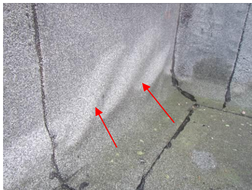
Kuva 20. Vesikaton bitumikermissä on paljon poimuuntumista. Kermi on valunut ylösnoston kohdalla eli kermin kiinnitys on todennäköisesti puutteellinen.
