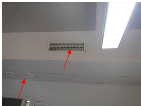
Kuva 1. Sekä tulo- että poistoilmalaitteet sijaitsevat alakäytävällä kotelossa.
