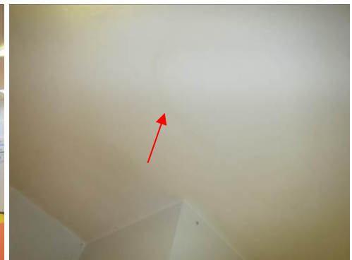
Kuva 13. Aulatilasta 2.31 alakatossa vesivuotojälkiä.
