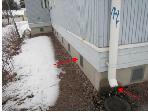
Kuva 70. Alapohjaan on riittävästi tuuletusaukkoja. Syöksytorvien kohdilla on kosteusrasitusta.
