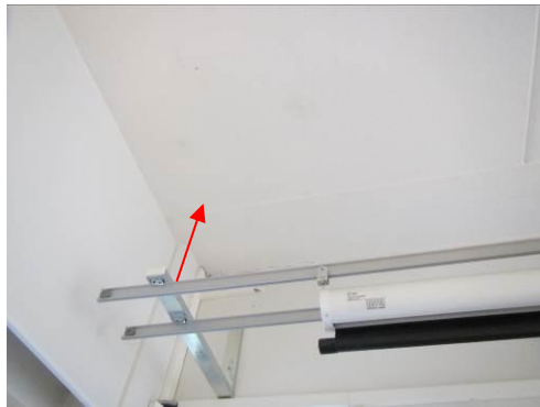
Kuva 7. Ulkoseinän ja yläpohjan liittymissä on halkeilua.
