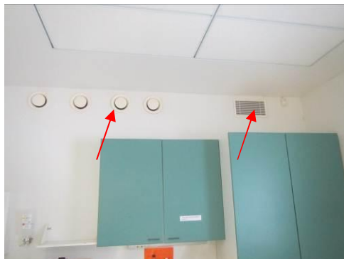
Kuva 76. Joissain tiloissa ilmanvaihdon tulo- ja poistoilmalimet ovat lähekkäin.
