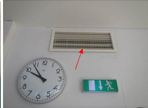
Kuva 77. Paikoin tuloilmalimet ovat likaisia/pölyisiä.
