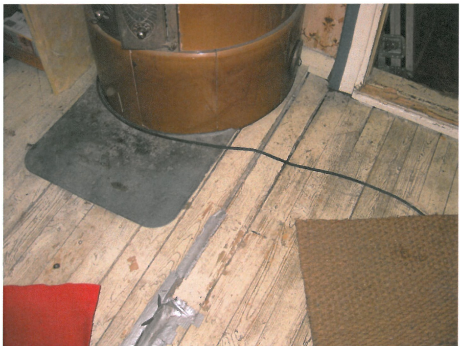
Kuva 6 Pohjakuvaan merkitty huone numero 3. Painunut välipohjarakenne kaakeliuunin vieressä.
