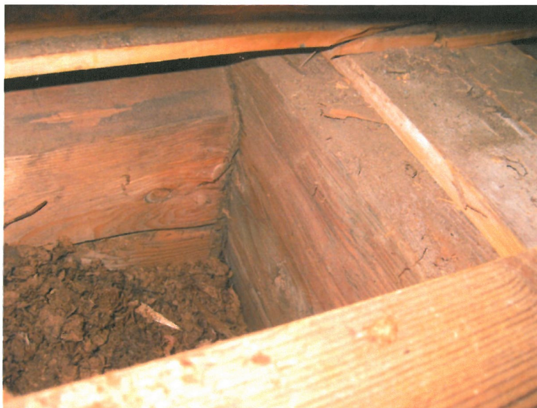
Kuva 9. Välipohjarakenteet ovat kaikissa avatuissa kohdissa hyväkuntoiset ja kuivat. Välipohjan ontto tila on täytetty mm. turpeella.
