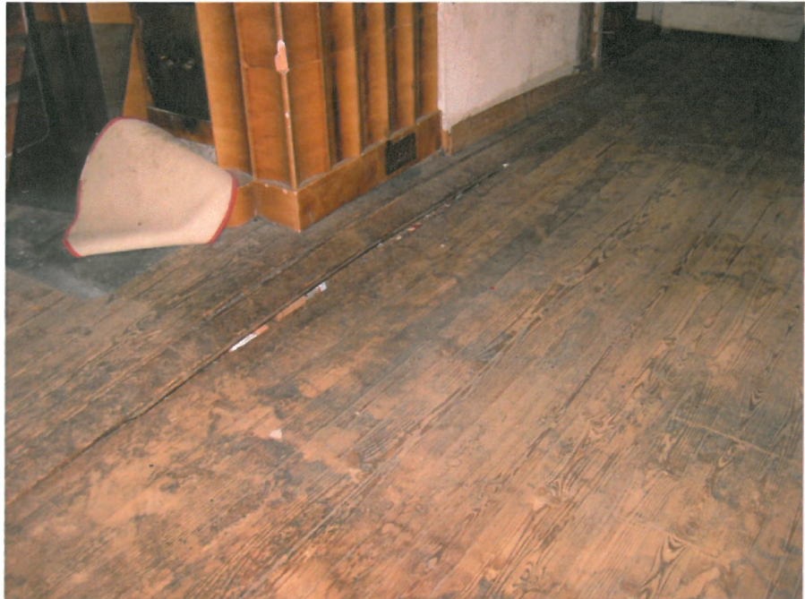
Kuva 2. Painunut välipohjarakenne pohjakuvaan merkityssä huoneessa numero 1.
