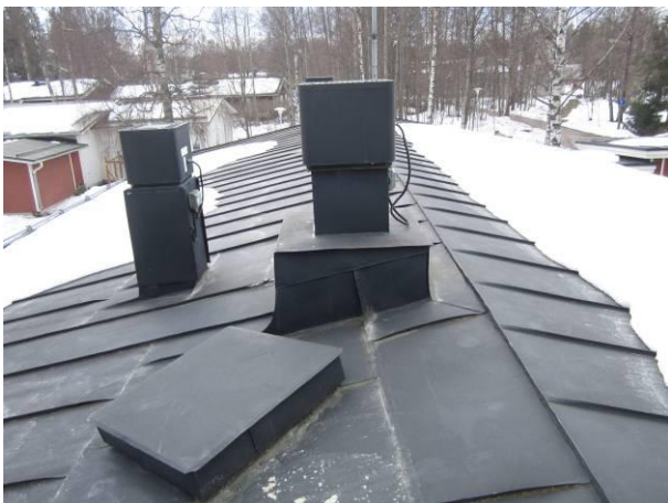
Kuva 17 Vesikatolla ei ole kulkusiltoja
