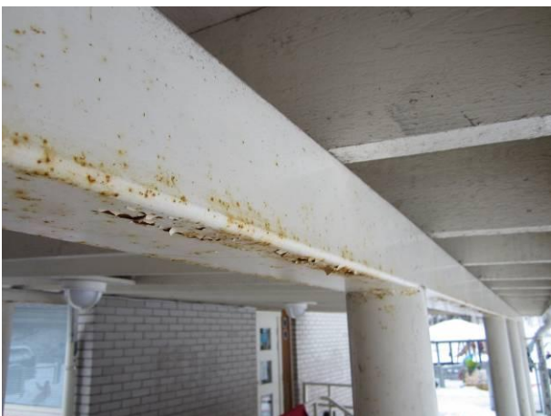
Kuva 5 Ruostevaurioita katoksen rungossa.
