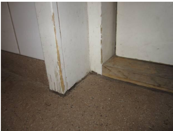
Kuva 35 Märkäeteisen 08 kulunut ulko-oven alareuna.
