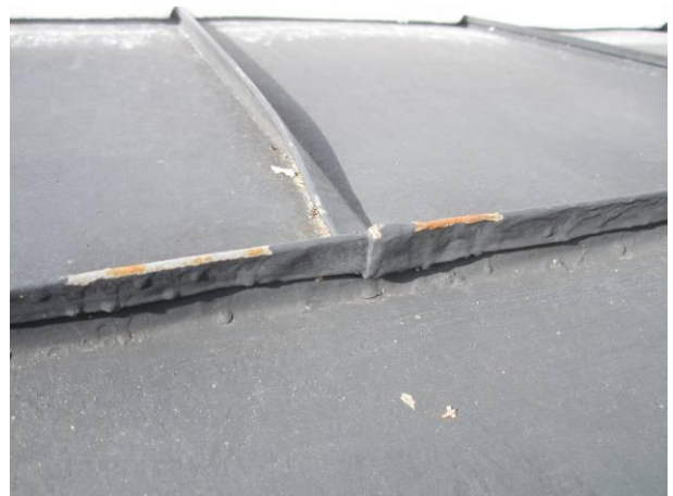
Kuva 18 Maali on paikoin kulunut, muuten ok.
