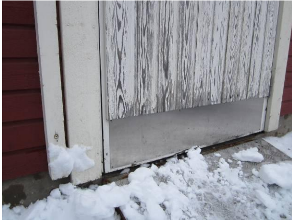
Kuva 7 Kulunut leikkivälinevaraston ovi
