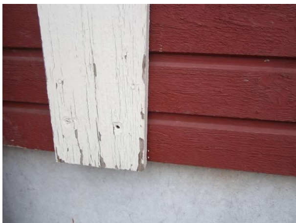
Kuva 11 Ulkoseinien pystylautojen maalipinta on kulunut.
