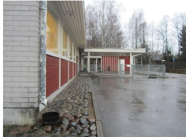
Kuva 2 Rännivesiä roiskuu yli ja kuluttaa hiekkasauvoja, kenttäkiviä puuttuu.
