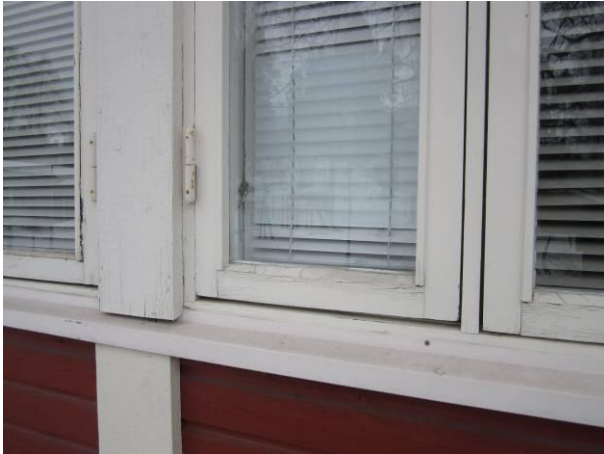
Kuva 13 Ikkunoiden maalipinnat ovat kuluneet.
