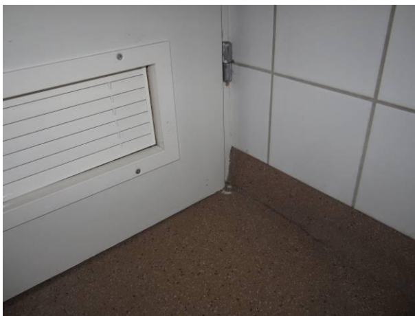
Kuva 27 Keittiön ovi on lähellä lattiaa
