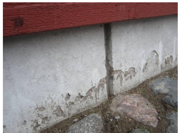
Kuva 10 Sokkelin paikallisia vaurioita, sokkelilevy on liian alhaalla.
