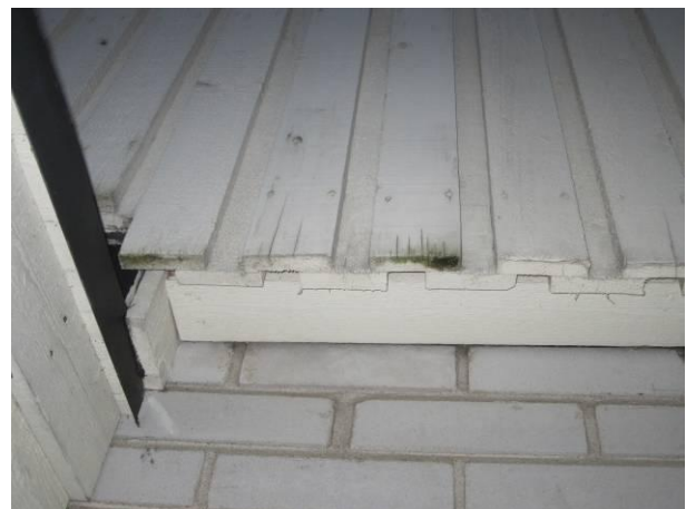
Kuva 12 Päätykolmion lautojen alapäävät ovat kärsineet kosteusrasitusta.
