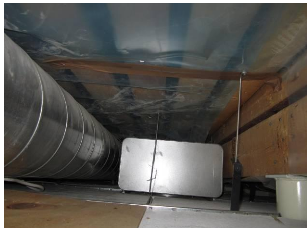
Kuva 36 Ryhmähuone 24 käytäväosan alakatto, jossa on erikoinen höyrösulkuviritys.
