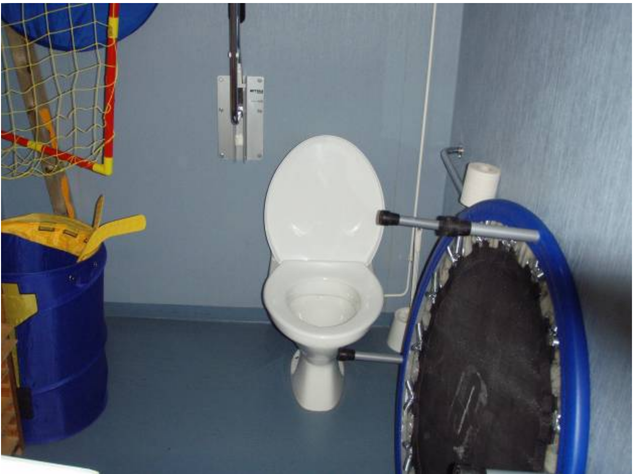
LVI-kuva 2. Yleiskuva wc-istuimista.
