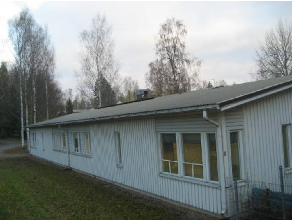
RAK-KUVA 5: Räystäskoururakenteissa esiintyy vaurioita ja ne arvioitiin edellyttävän kunnostusta lähivuosien aikana.
