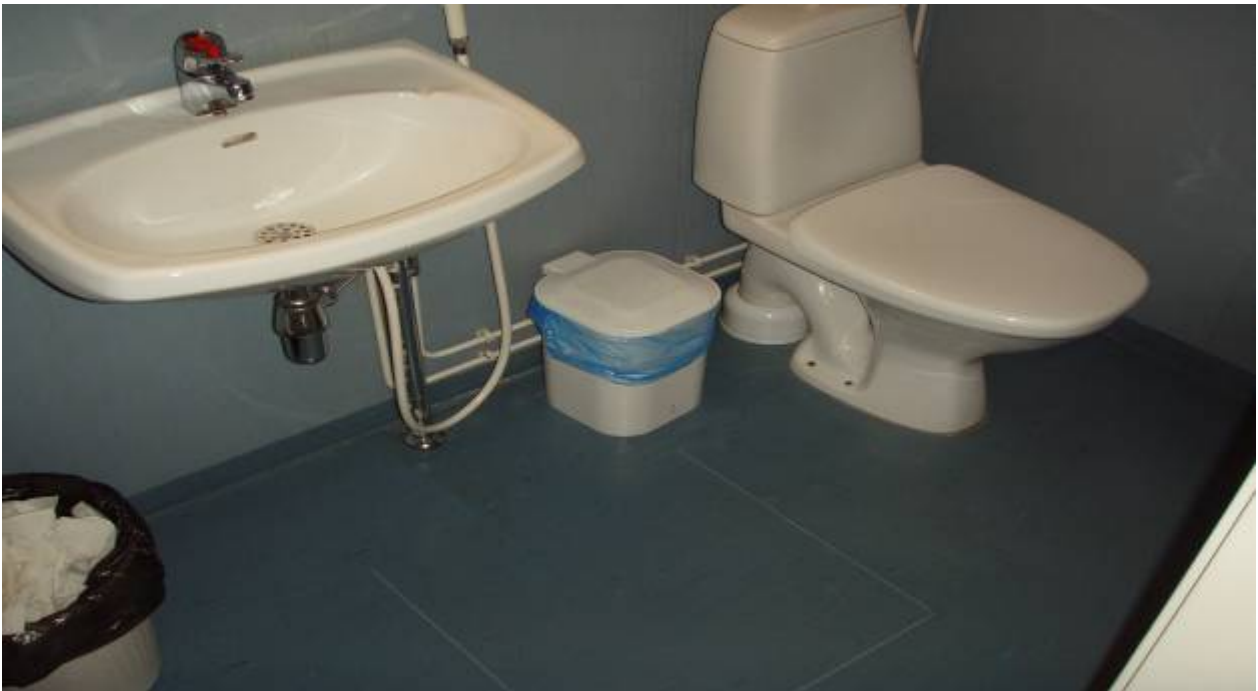
LVI-kuva 1. Yleiskuva vesikalusteista.
