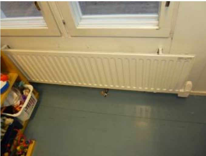
S-KUVA 10. Uusittu öljytäytteinen sähkölämmitin
