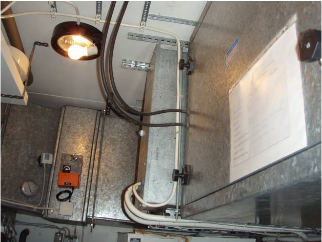
LVI-kuva 3. Yleiskuva IV- konehuoneesta.
