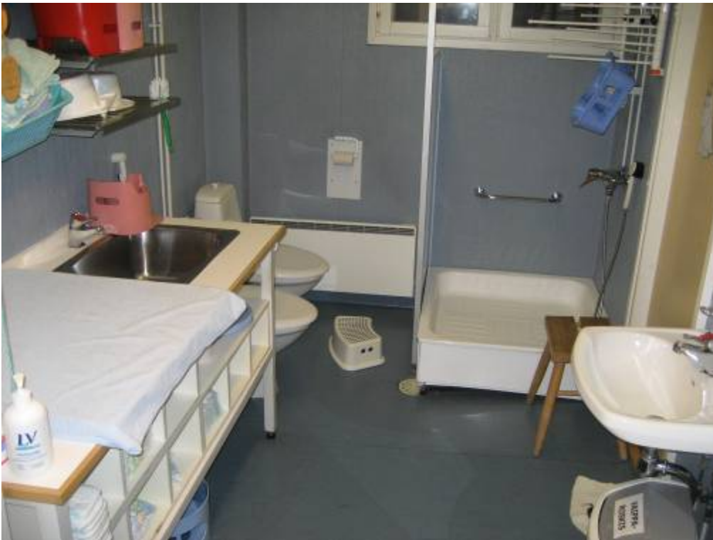
RAK-KUVA 7: Päiväkodin märkä- ja sosiaalitulat arvioitiin olevan nyt tyydyttävässä kunnossa mutta ikääntyneinä rakenteet suositellaan kunnostamaan lähivuosien aikana (ennen alustarakenteisiin syntyviä kosteusvaurioita).
