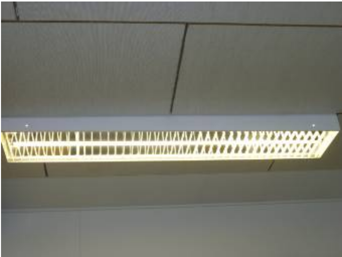
S-KUVA 8. Käytävän ja huoneiden valaisinmalli
