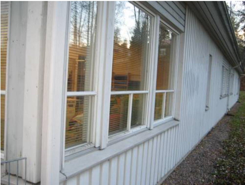
RAK-KUVA 3: Ikkunarakenteet arvioitiin edellyttävän huoltokunnostusta lähivuosien aikana.
