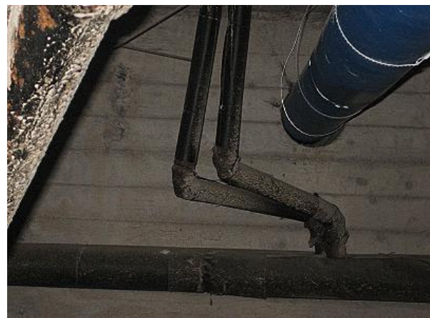
Kuva 6 Kanavapuhaltimelta poistoputki sokkeli-rakenteeseen.
