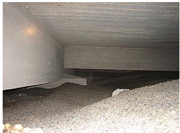
Kuva 12 Itäsvustan alustatila. Palkkien ja keskiosien kohdilla oli matalaa. Poistoilmavaihto puuttuu.
