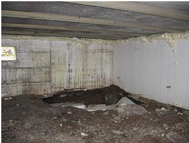
Kuva 27 Pohjoiskulmauksessa märkää sokkeli-rakennetta.
