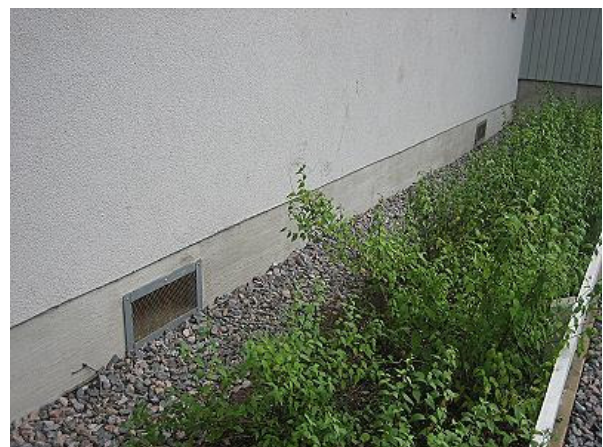
Kuva 30 Luoteispuolen korvausilmaritilät liian lähellä maanpintaa.
