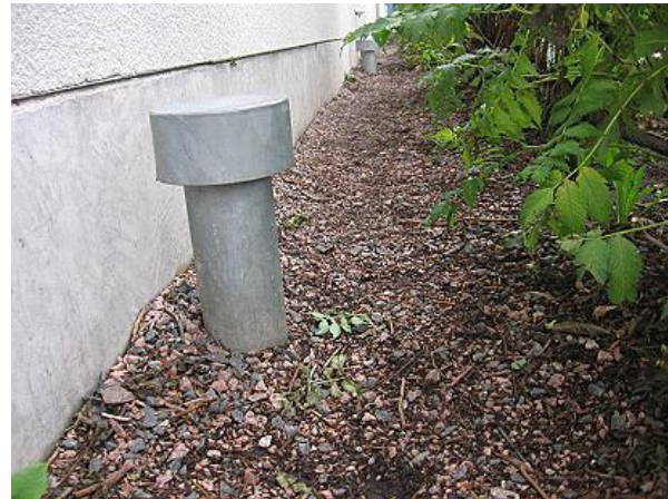
Kuva 34 C-osan tuuletusputket voivat matalasta korkeudesta johtuen peittyä talvikaudena.
