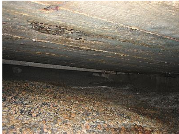
Kuva 10 OT3:n kohdalla putkikanaalissa oli putkivuoto. Betonirakenne ja sepelipohja oli märkä.
