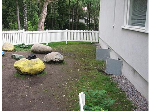
Kuva 32 Maanpinta viettää rakennukseen päin koillisen puolella päädyssä.
