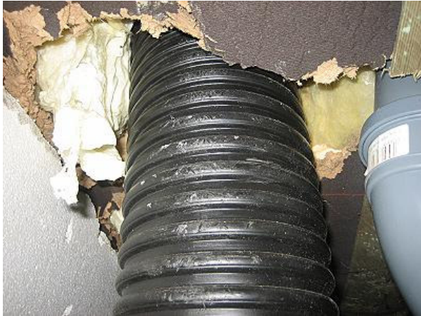
Kuva 25 Lämpivientejä ei oltu tiivistetty kauttaaltaan.
