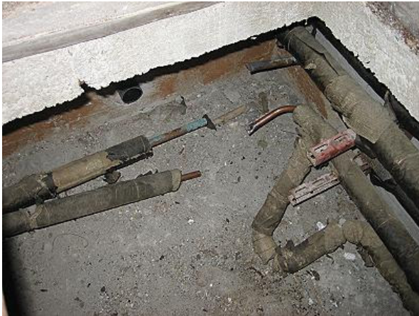
Kuva 3 Käytöstä poistetut putket tulisi poistaa.
