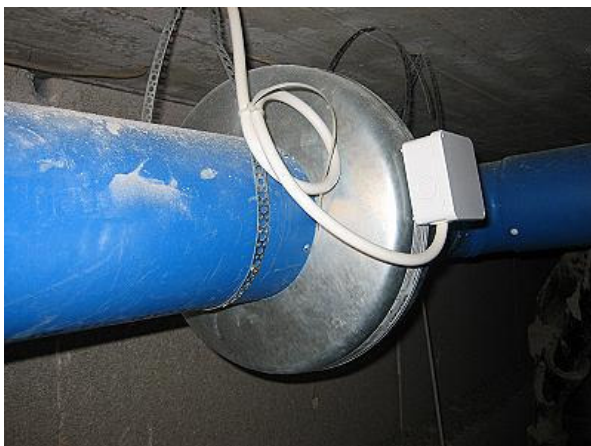
Kuva 5 Pukuhuoneen kohdalla alustatilassa on kanavapuhallin (Onninen CK-160C)
