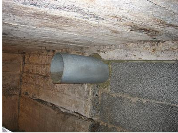
Kuva 8 Alustatilan tuuletusputki ja työaukko, joka on muurattu umpeen. Poistoilmavaihto puuttuu.
