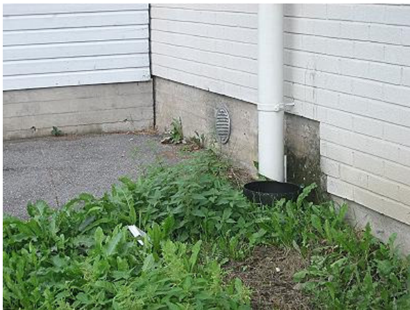
Kuva 33 A-osan alustatilan poistoilma ohjataan sokkelirakenteen kautta ulos. Säleikkö potkittu läjään, jolloin ilmanvaihto ei toimi täydellisesti.
