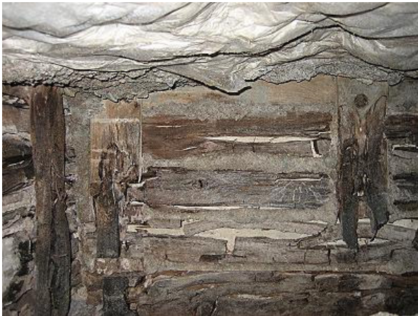
Kuva 15 Kulkuaukon kohdalta havainnoituna on kosteus- ja mikrobivaurioituneita muottilauoituksia.
