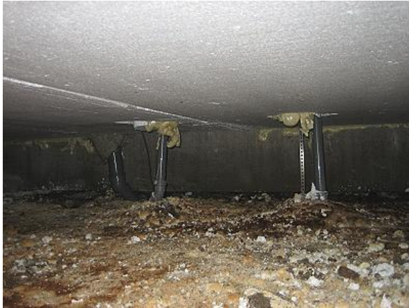
Kuva 19 Läpivientjä oli tiivistetty puutteellisesti. Polystyreeni-levyjien kappaleet poistetaan ja tilalle pursotetaan paisuvaa polyuretaanivaahtoa.
