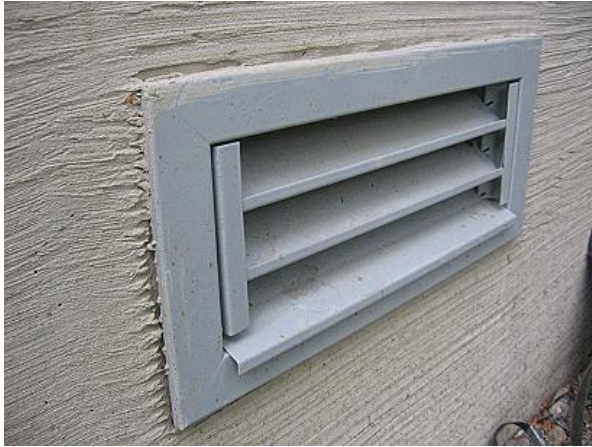
Kuva 31 korvausilmasäleikköjen asennus kehykseen tulisi tarkistaa (onko asennettu valmistajan ohjeiden mukaisesti).
