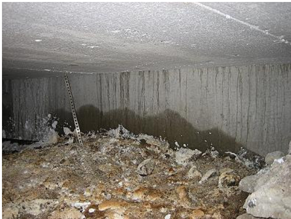
Kuva 21 Em. käytävän alueella alustatäytössä voimakas kosteustuotto.
