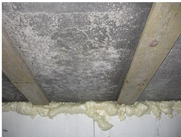
Kuva 29 Bituliitti-levyjen ja harvalaudoituksien pinnoilla koillisen puoleisella päätyosalla vaaleaa kasvustoa.
