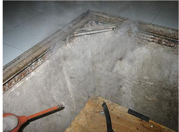
Kuva 20 Käytävän kohdalla alustatilassa oli voimakas ylipaine ja voimakas maan omainen haju. Luukkujen tiivistykset olivat puutteelliset.
