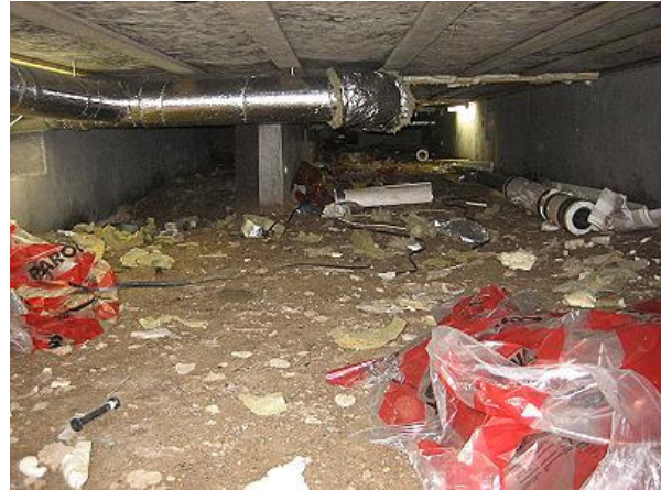
Kuva 26 Koillisen puolella päätyosalla on täyttönä hiekkaa. Pinnoilla on runsaasti rakennusaikaista jätettä, jotka tulee poistaa.
