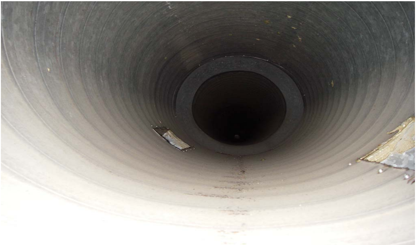
KUVA 8. Yleiskuva 2 krs. tuloilmakanavasta.
