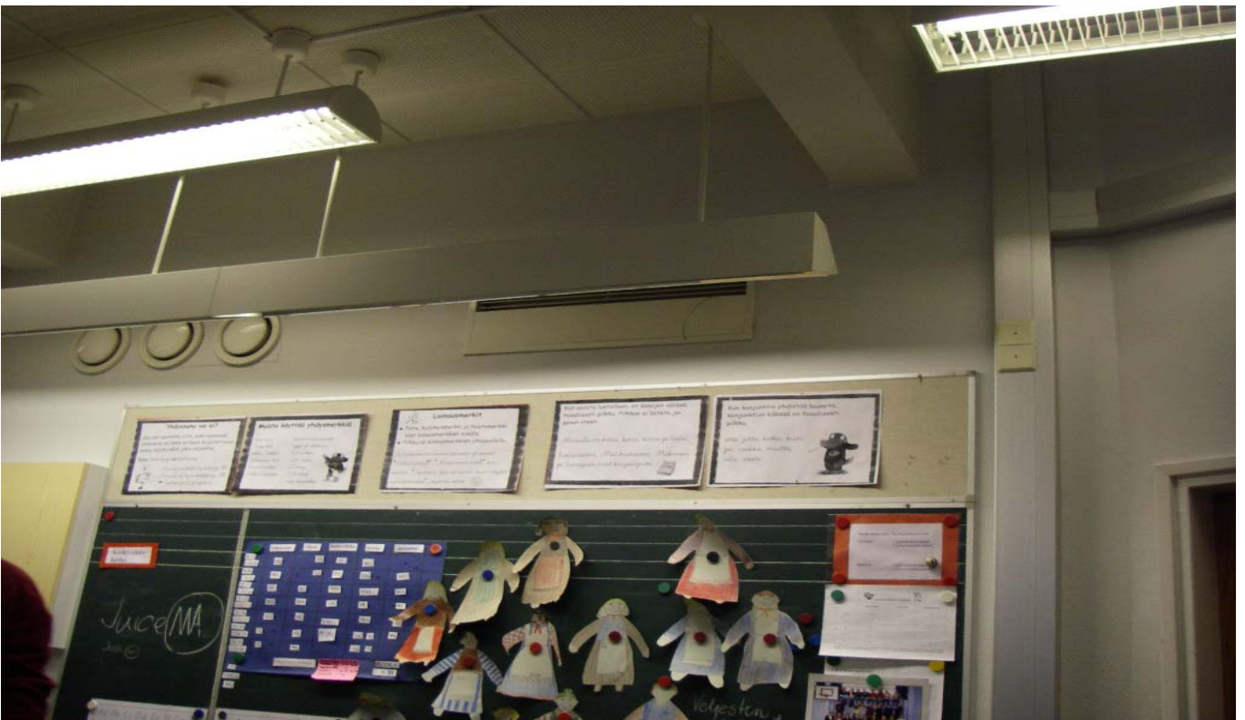
KUVA 14. Luokkahuoneessa n:o 203 tuloilmasäleikön eteen on asennettu valaisin.
