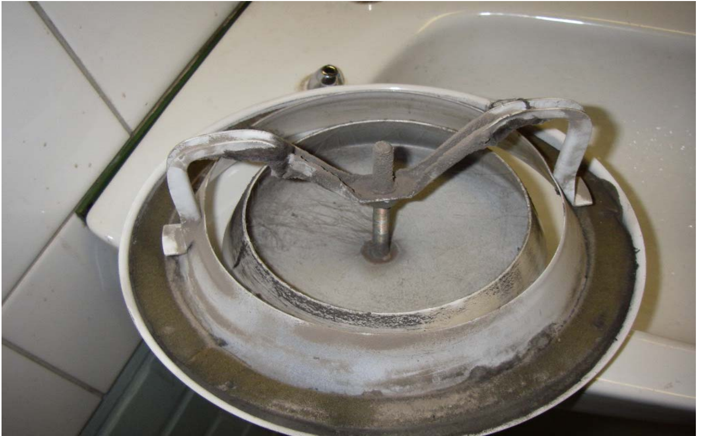
KUVA 15. Poistoilmaventtiilit ovat pölyisiä.
