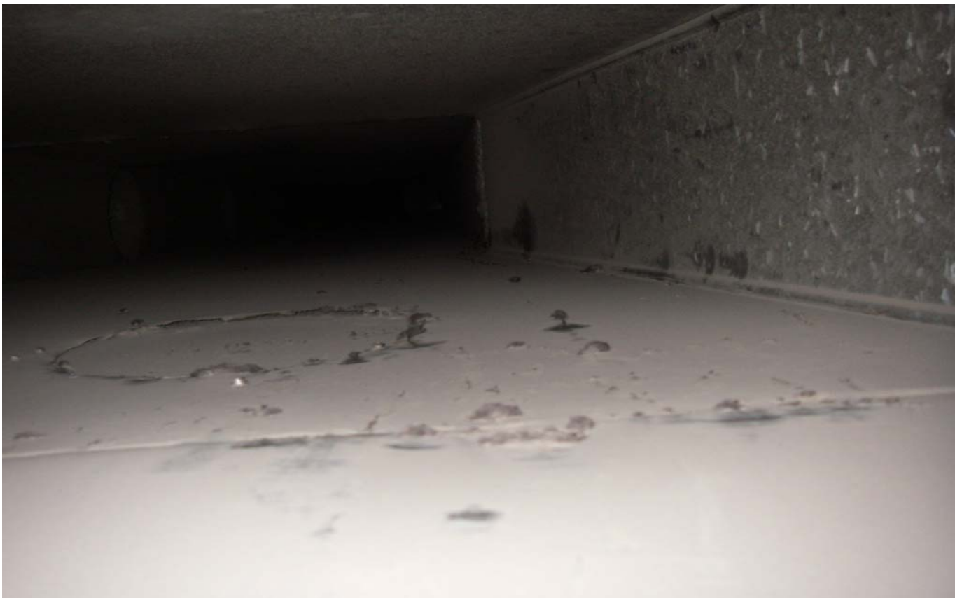
KUVA 12. Yleiskuva 1 krs. poistoilmakanavasta.
