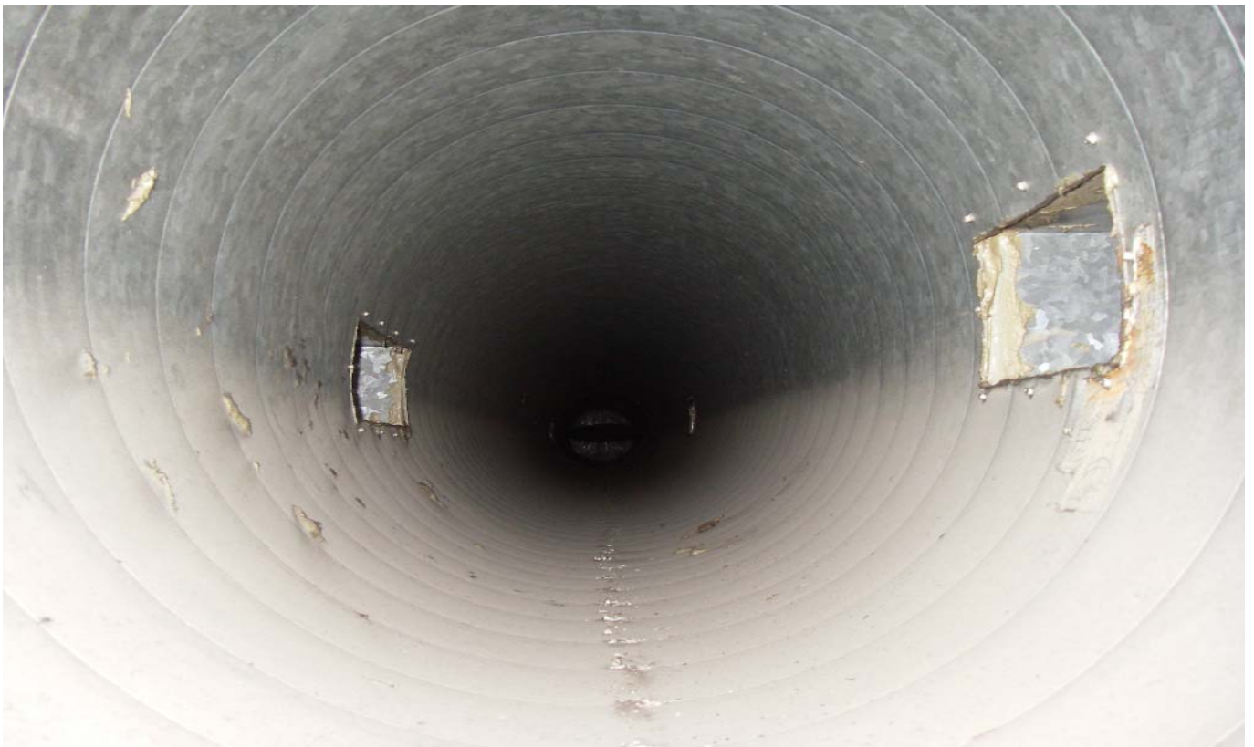
KUVA 10. Yleiskuva 1 krs. tuloilmakanavasta.
