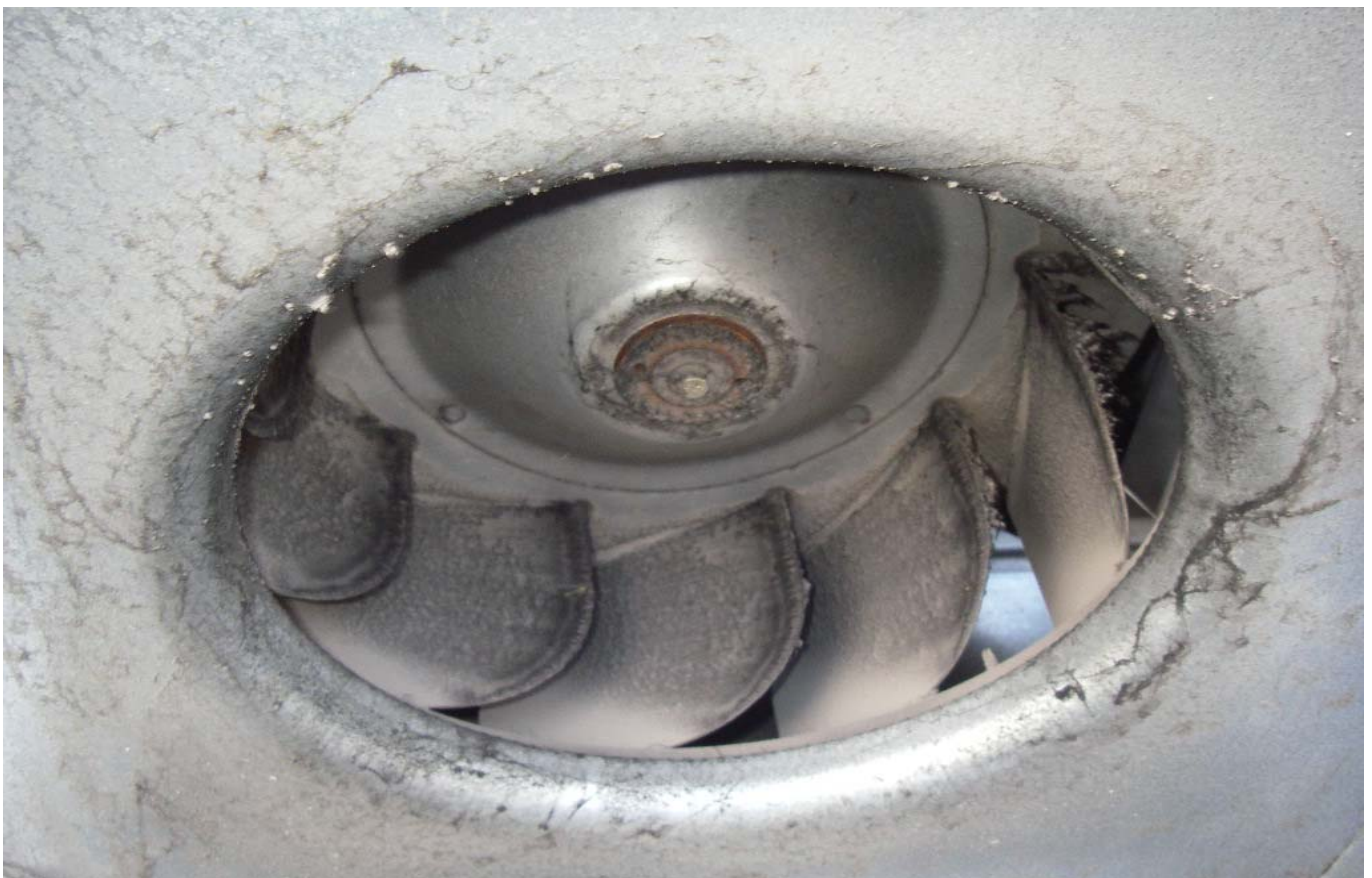
KUVA 6. Sosiaalitilojen poistoilmapuhallin on pölyinen.
