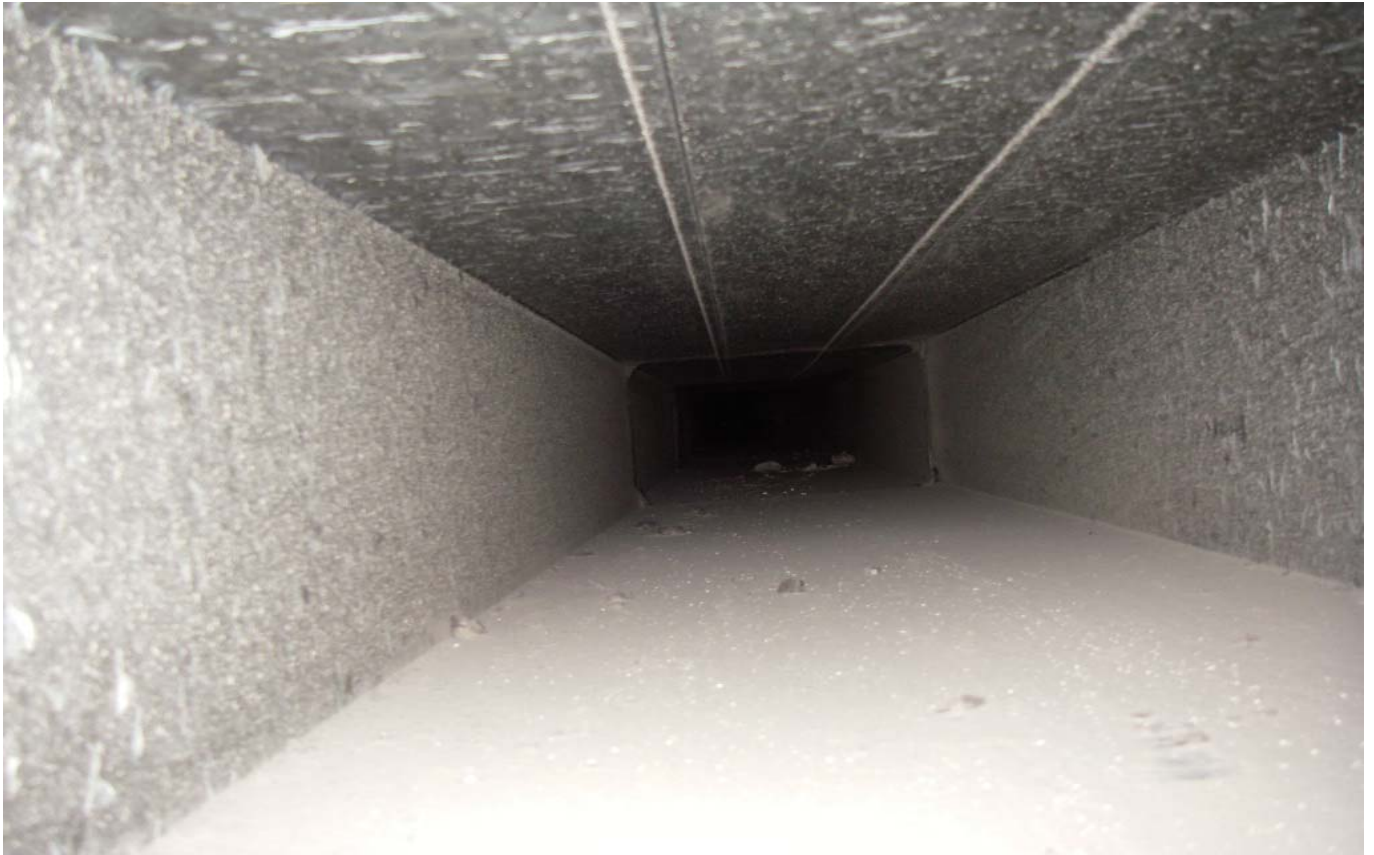
KUVA 11. Yleiskuva 2 krs. poistoilmakanavasta.
