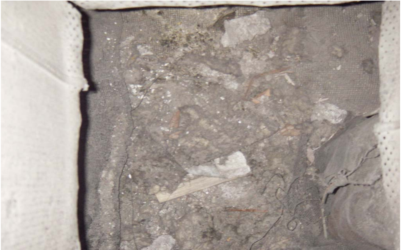
KUVA 7. Sosiaalitalan poistoilmakanavassa on hieman rakennusjätettä.
