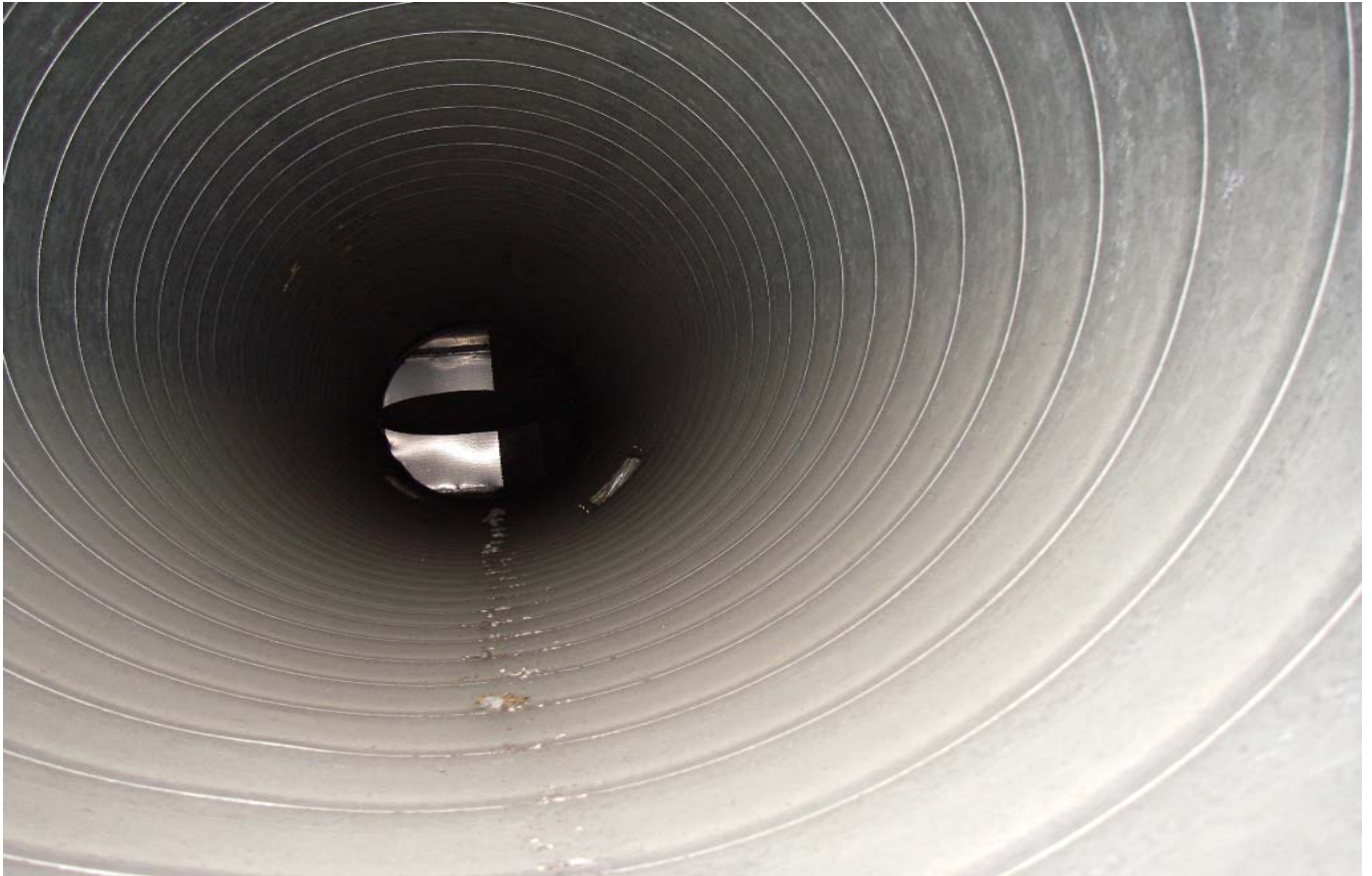
KUVA 9. Yleiskuva 2 krs. tuloilmakanavasta.
