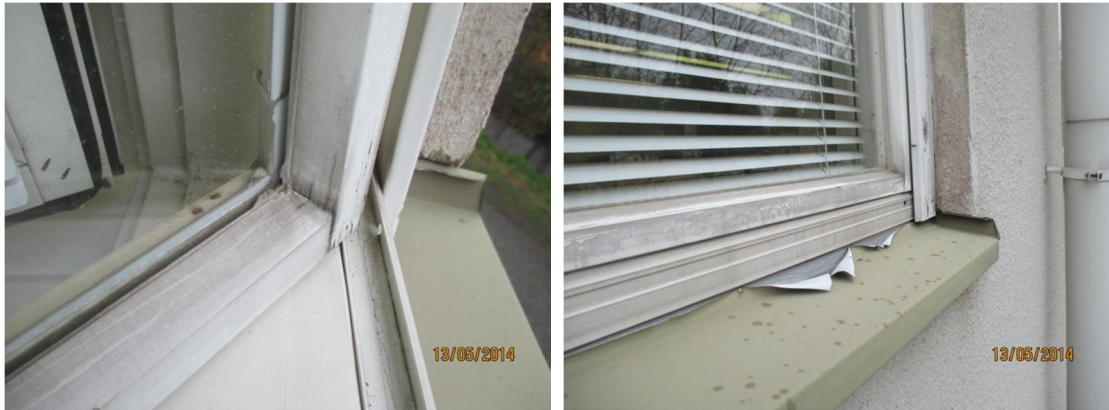
Kuvat 18a ja b. Kuvassa a on. musiikkiluokan kohdalla oleva ikkunan ulkokuite, jossa lasilista on irti lasista ja jää rako. Kohdalla on tehty tiivistyskittauksia. Kuvassa b on musiikkiluokan kohdalla olevan ikkunan vesipellitys, joka on jo kulunut.
